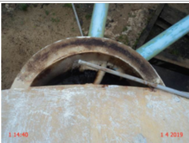
Foto 14 – RAP-01: abertura de inspeção na entrada de água sem tampa.
