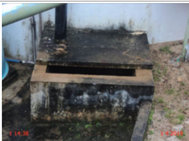
Foto 20 – RAP-01: caixa de inspeção com tampa parcialmente aberta.
