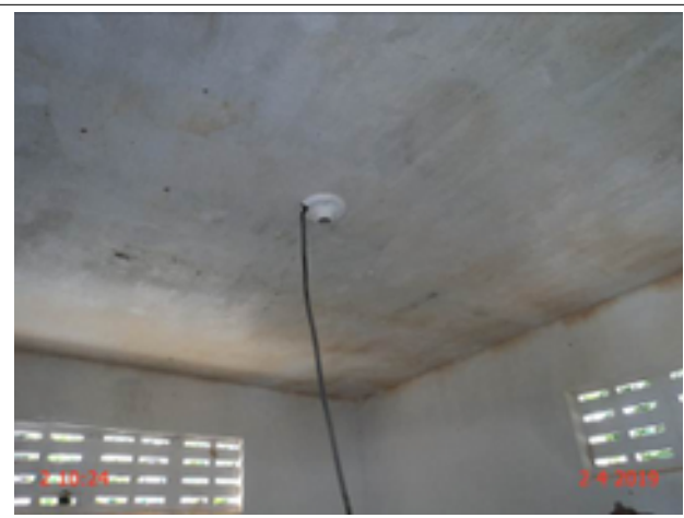
Foto 9 – ETE 13 de Maio: ausência de lâmpada na casa de abrigo do dosador de cloro.
