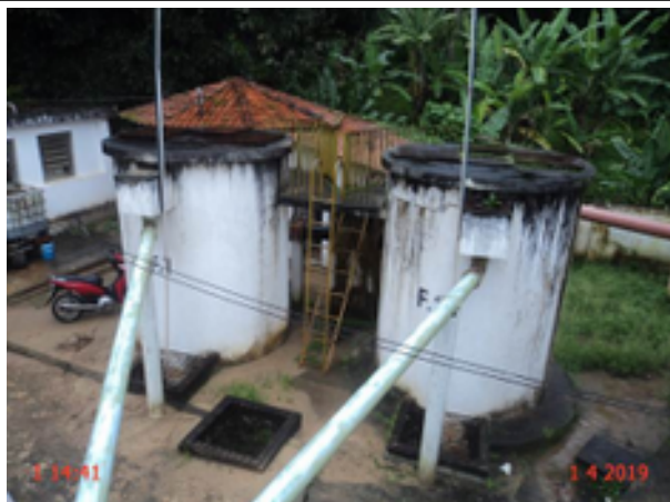
Foto 16 – ETA: filtros F-01 e F-02 com pintura deteriorada.
