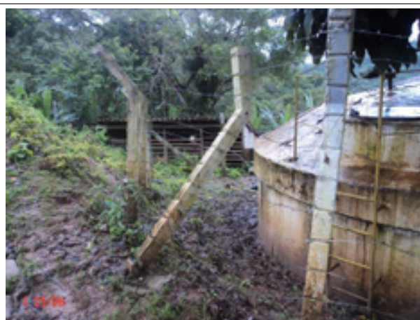
Foto 31 – RAP-03: cerca de delimitação danificada.
