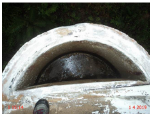
Foto 15 – RAP-02: abertura de inspeção sem tampa.
