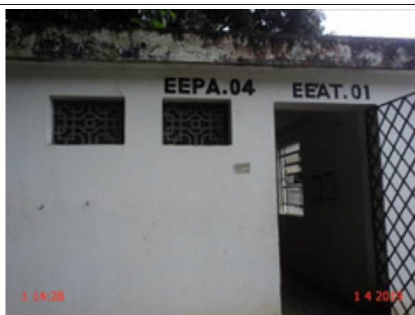
Foto 33 – Elevatórias de água: EEPR-04 com identificação divergente do CROQUI.
