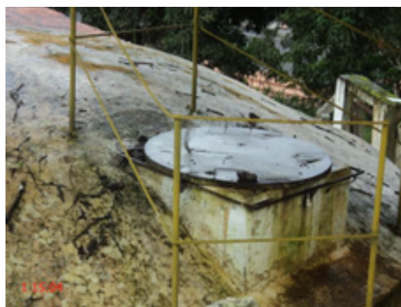
Foto 13 – RAP-03: tampa da abertura de inspeção em processo de corrosão.
