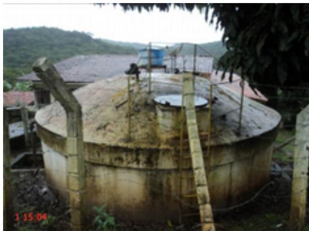
Foto 18 – RAP-03: pintura deteriorada.
