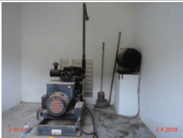
Foto 4 – EEE-01 – grupo gerador de energia elétrica com defeito e ausência de ponto de ligação de emergência.
