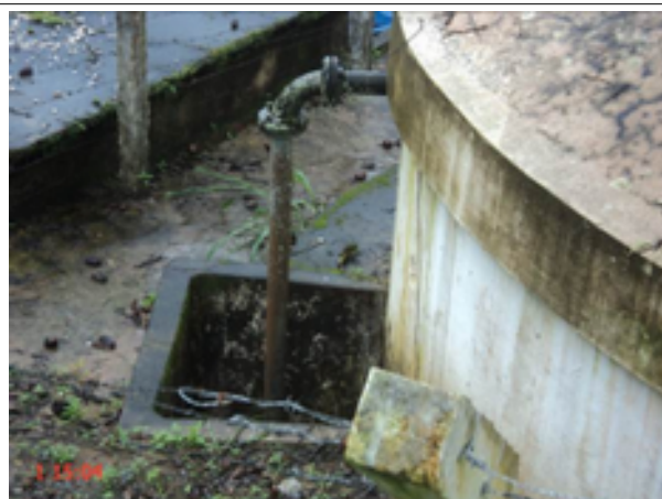
Foto 21 – RAP-03: caixa de inspeção sem tampa.
