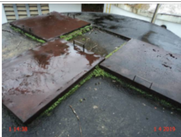
Foto 30 – ETA: tampas do filtro F-02 em processo de corrosão.
