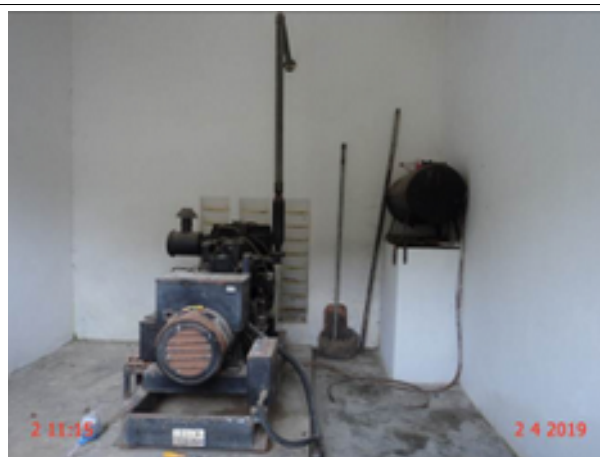
Foto 27 – ETE Alho – grupo gerador de energia elétrica com defeito e ausência de ponto de ligação de emergência.
