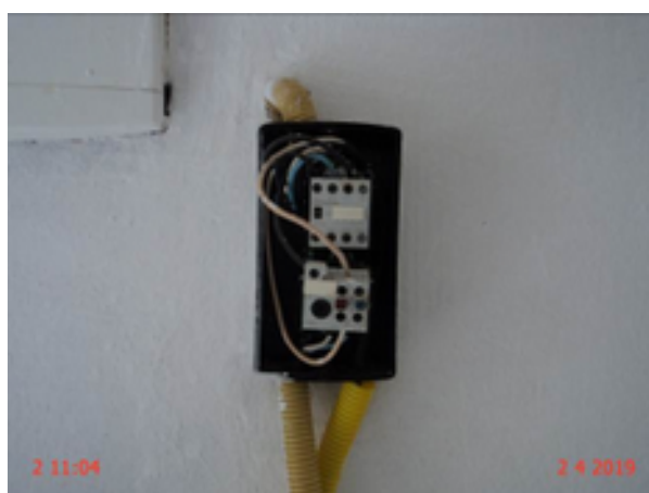
Foto 25 – ETE Alho: quadro de energia sem tampa na casa de abrigo.
