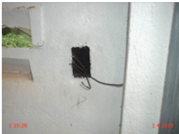
Foto 10 – Captação: instalações elétricas inadequadas no poço PT-10.
