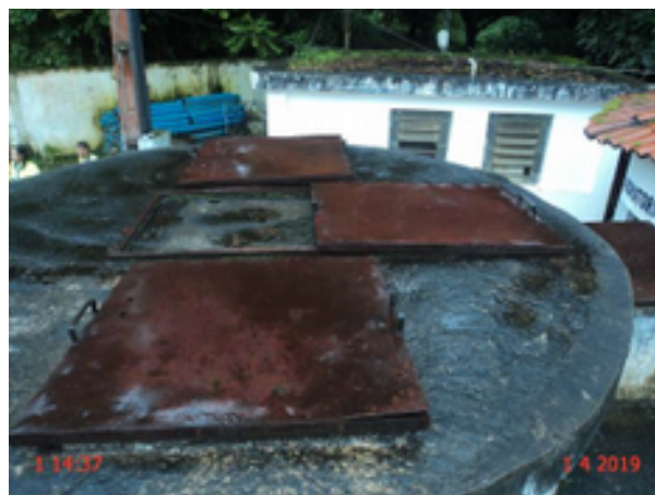
Foto 29 – ETA: tampas do filtro F-01 em processo de corrosão.
