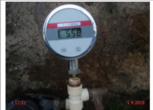
Foto 3 – RDA: medição de pressão instantânea no endereço Rua Pe. Constantino, nº 472.
