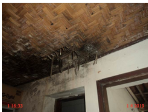
Foto 8 – Almoxarifado: forro danificado.
