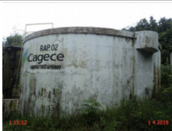
Foto 5 – RAP-02: pintura deteriorada e ausência de controle de nível e de tubulação de ventilação.
