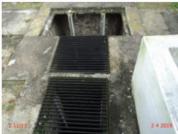
Foto 28 – EEE-01 – poço de sucção parcialmente sem grade de proteção.
