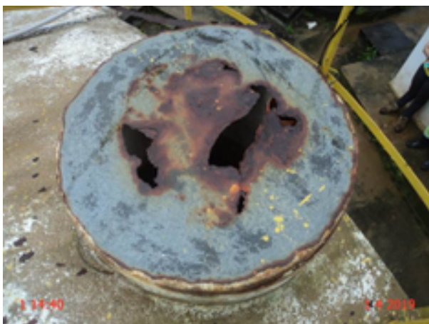
Foto 12 – RAP-01: tampa da abertura de inspeção em processo de corrosão.
