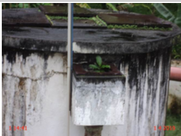
Foto 22 – ETA: tampa da calha de saída de água do filtro F-01 em processo de corrosão.
