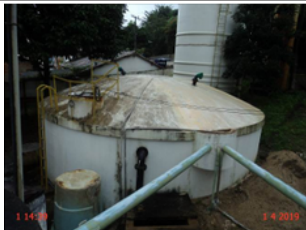
Foto 17 – RAP-01: pintura deteriorada.
