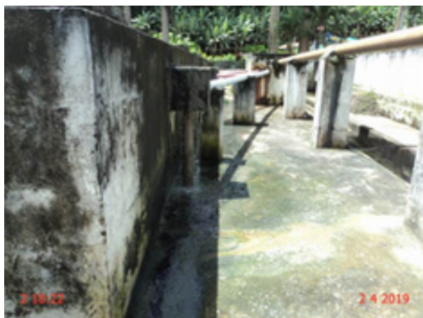
Foto 24 – ETE 13 de Maio: reator anaeróbico extravasando.
