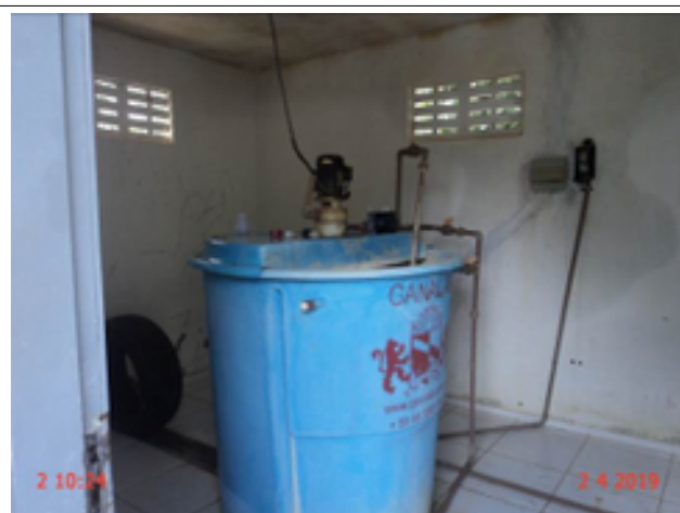
Foto 6 – ETE 13 de Maio: bomba dosadora de cloro com defeito.
