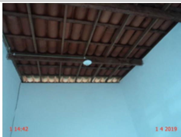
Foto 23 – ETA: almoxarifado de produtos químicos sem lâmpada instalada.
