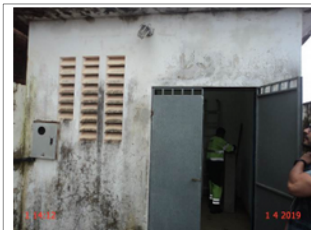
Foto 35 – Elevatórias de água: EERD-01, identificação pouco visível.
