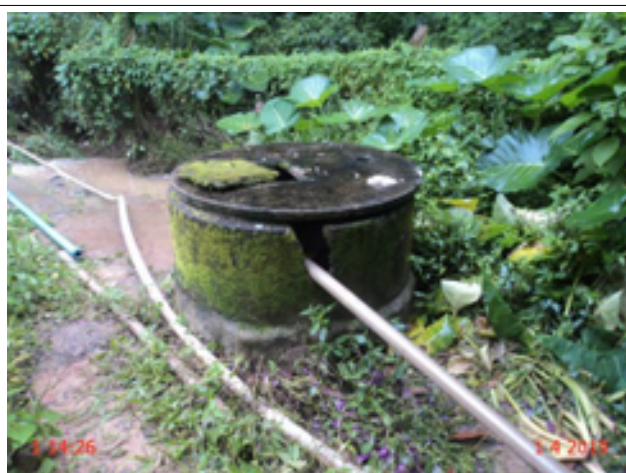
Foto 7 – Captação: poço PA-03 sem identificação.
