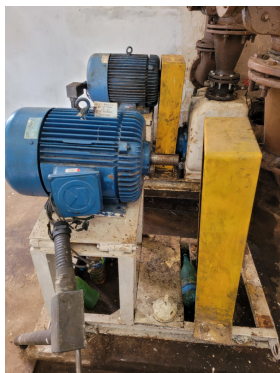
Foto 11 - EEE-01 - bomba reserva não está instalada.
