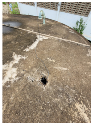
Foto 2 - ETA: RAP-02 possui uma perfuração na laje.
