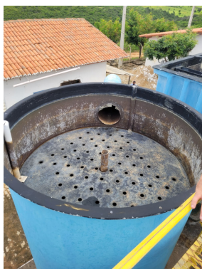
Foto 7 - ETA - Flocculadores desativados.
