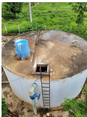
Foto 1 - ETA: RAP-01 não possui tampa.
