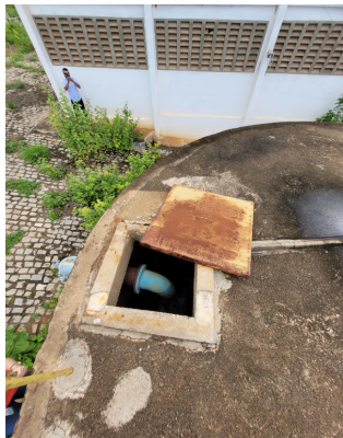
Foto 3 - ETA: tampa do RAP-02 com vedação inadequada.
