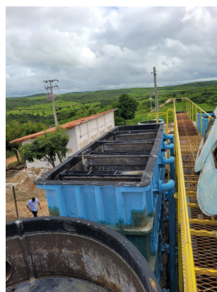
Foto 6 - ETA - Flocculadores desativados.
