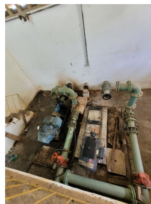
Foto 8 - ETA: EEAT-02 Bomba reserva não instalada.
