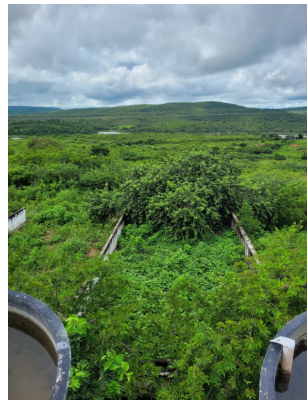
Foto 4 - ETA: Leito de secagem tomado por vegetação.
