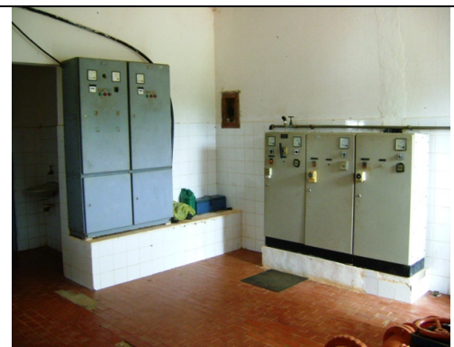
Foto 22 – Quadros de comando da EECS-01, EEAT-01 e EELF-01
