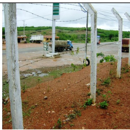
Foto 31 – RAP-01 - cerca de proteção danificada
