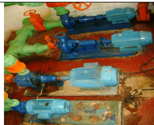
Foto 20 – Vista da EELF-01 e a EEAT-01 ao fundo
