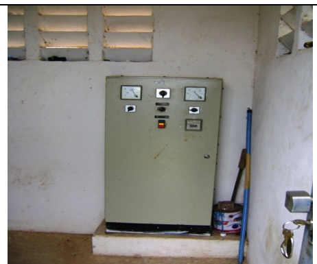
Foto 23 – Quadro de comando do booster
