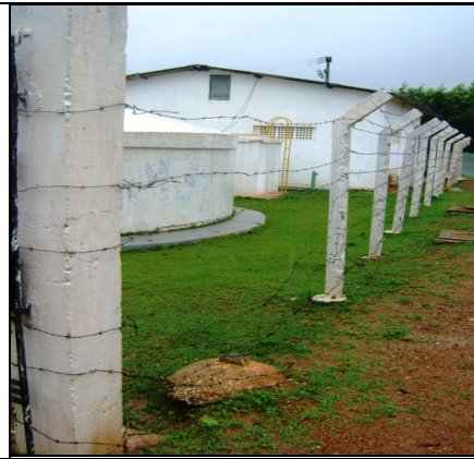
Foto 4 – Cerca de proteção danificada
