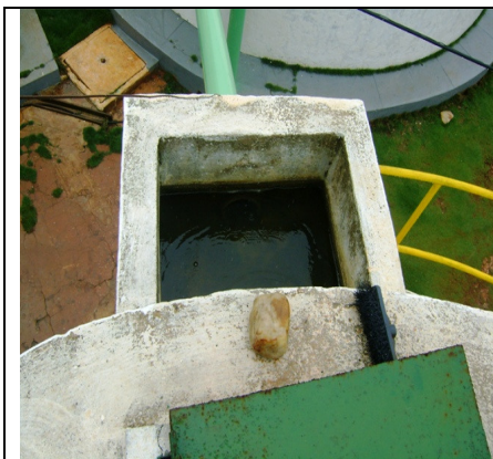
Foto 6 – Calha de saída de água filtrada sem tampa
