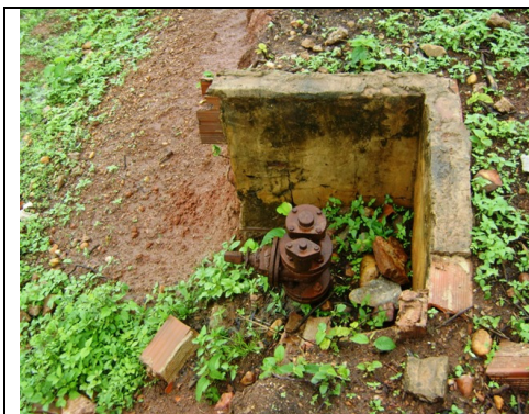
Foto 35 – Caixa de proteção danificada, próximo ao RAP-02
