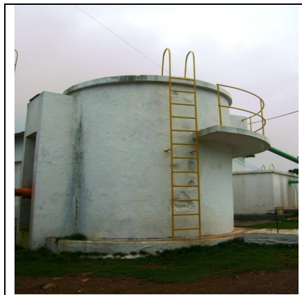
Foto 5 – Vista do filtro
