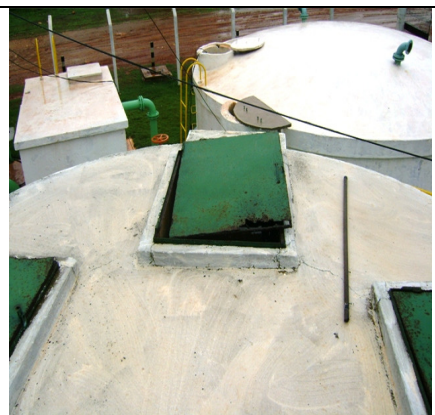
Foto 7 – Tampas do filtro com corrosão
