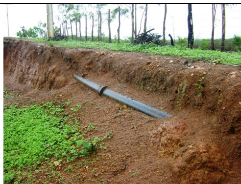
Foto 36 – Tubulação exposta da adutora de água tratada
