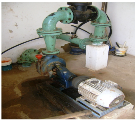
Foto 21 – Detalhe do booster
