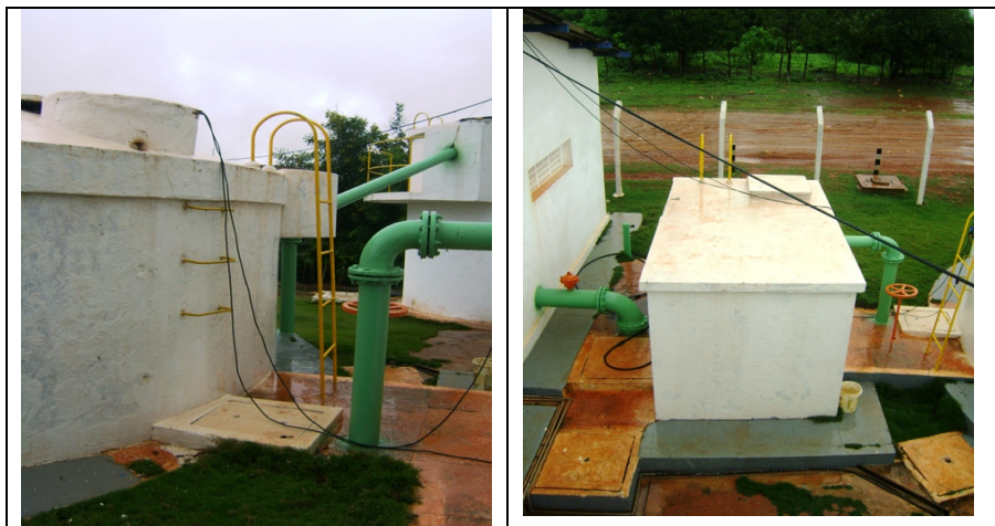
Fotos 28 e 29 – Fiação exposta saindo do RSE-01 e passando sobre o RSE-02
