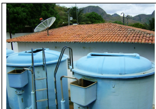
Foto 16 – Vistas superiores dos filtros
