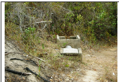
Foto 40 – Caixa de proteção de registro de descarga na adutora de água tratada
