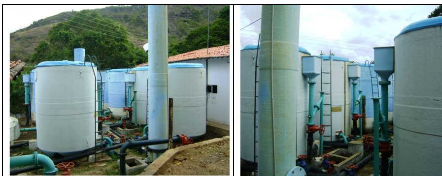
Fotos 14 e 15 – Vistas parciais dos filtros
