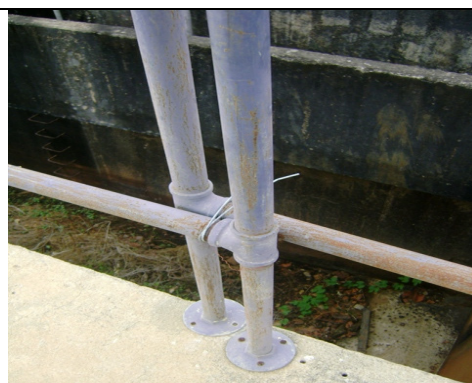
Foto 12 – Guarda-corpo sem fixação
