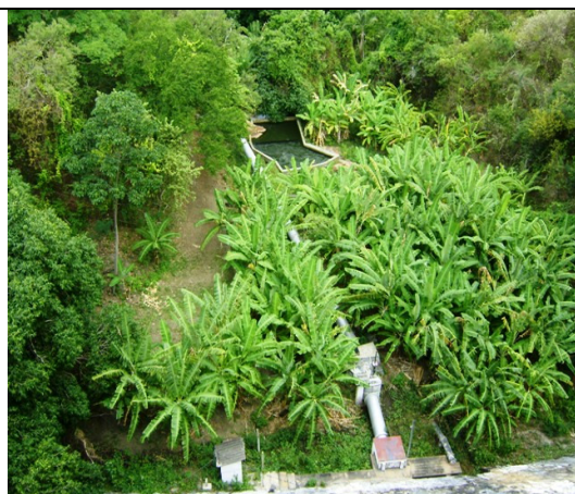
Foto 2 – Vista da adutora da COGERH
