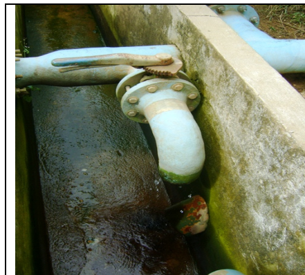
Foto 17 – Registros com vazamentos
