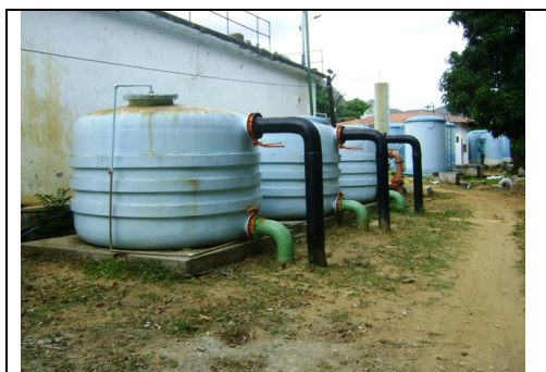
Foto 13 – Vista dos filtros de pressão
