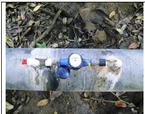
Foto 41 – Medidor proporcional na saída da ETA
