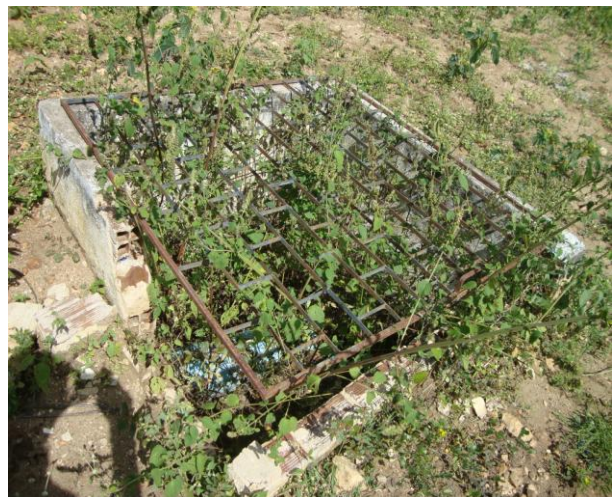
Foto 10 – Estação pitométrica com caixa danificada, próximo a captação.
