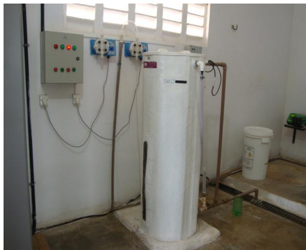
Foto 26 – Dosador de flúor.
