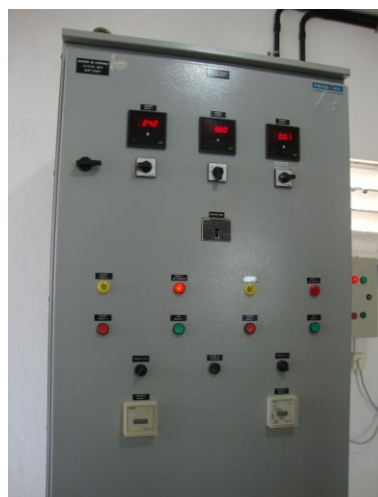
Foto 34 – Quadro de comando da casa de química.
