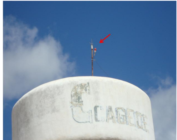
Foto 73- REL-02: com existência de para-raios e sinalização noturna.
