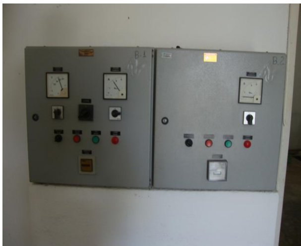
Foto 55 – Quadro de comandos das EEAT-01 e EEAT-02.
