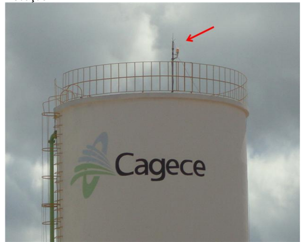
Foto 69 – REL-01: com existência de para-raios, guarda-corpo na laje e sinalização noturna.
