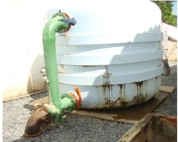
Foto 14 – Vista do filtro de pressão.
