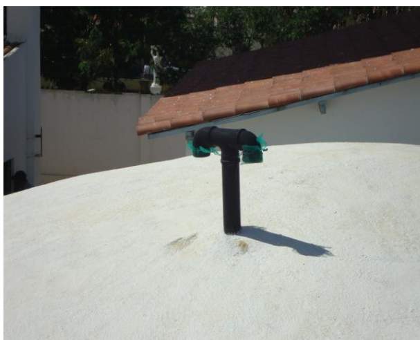
Foto 62 – Tubulação de ventilação do RAP-01 com tela de vedação.
