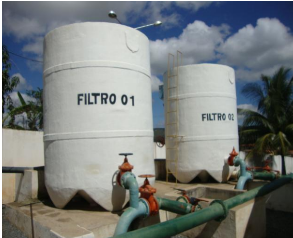
Foto 13 – Vista dos filtros ascendentes.
