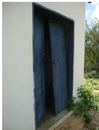
Foto 6 – Porta danificada da casa de abrigo do QC da EECS-01.
