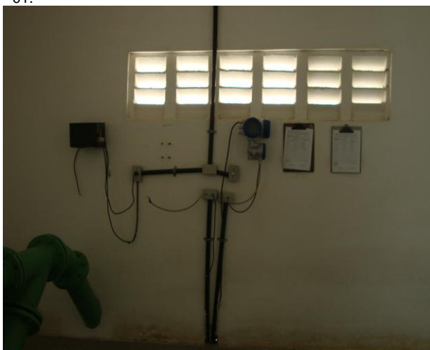
Foto 51 – Macromedidor de água tratada instalado no interior da casa de abrigo da EEAT.
