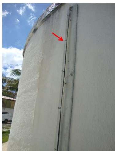
Foto 63 – RAP-01: Medidor de nível.
