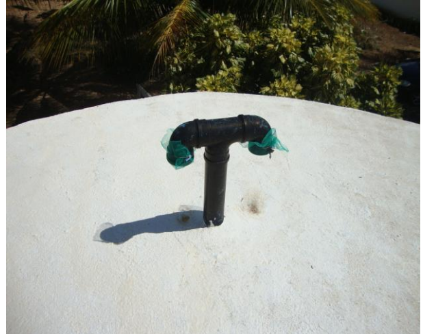
Foto 67– Tubulação de ventilação do RAP-02 com tela de vedação.
