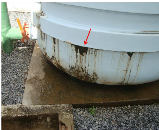
Foto 17 – Vazamento no filtro de pressão.
