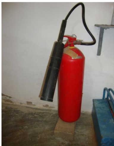
Foto 57 – Extintor de incêndio das EEAT com validade vencida em nov/2009.
