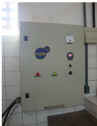
Foto 35 – Quadro de comando da casa de química.
