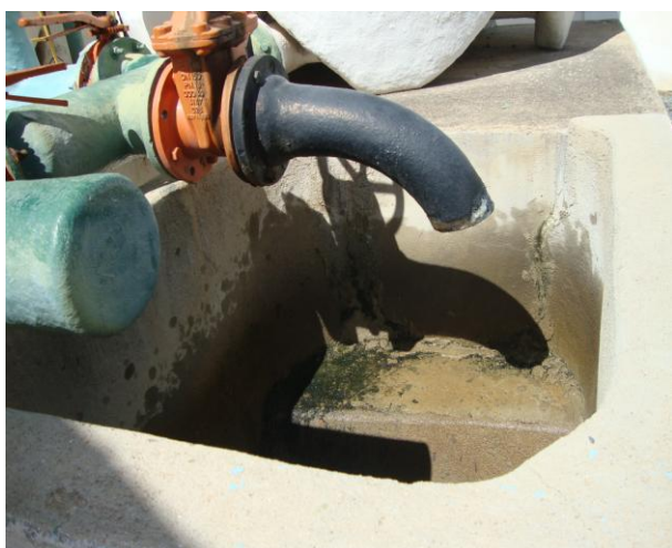
Foto 23 – Tubo de descarga do filtro-02.
