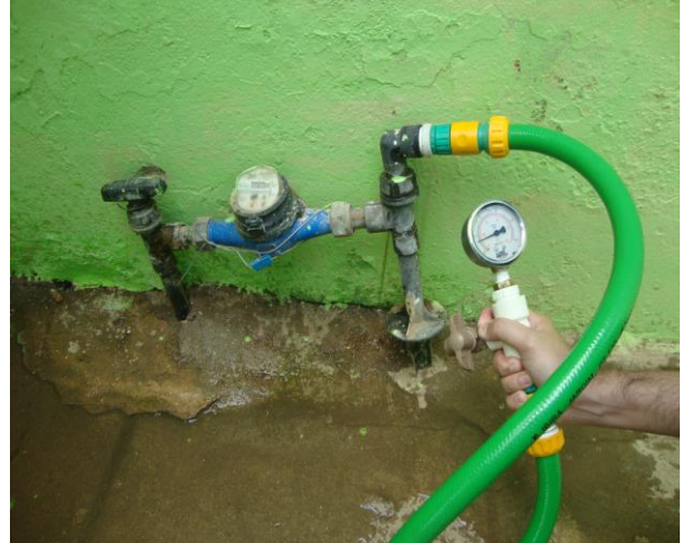
Foto 79 – Medição de pressão instantânea na Rua Salvador R. de Mesquita, nº 95 – Centro.
