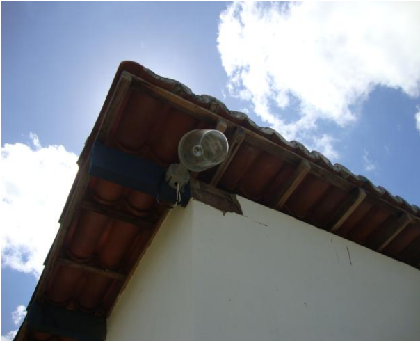
Foto 7 – Luminária sem lâmpada da casa de abrigo do quadro de comando da EECS-01.
