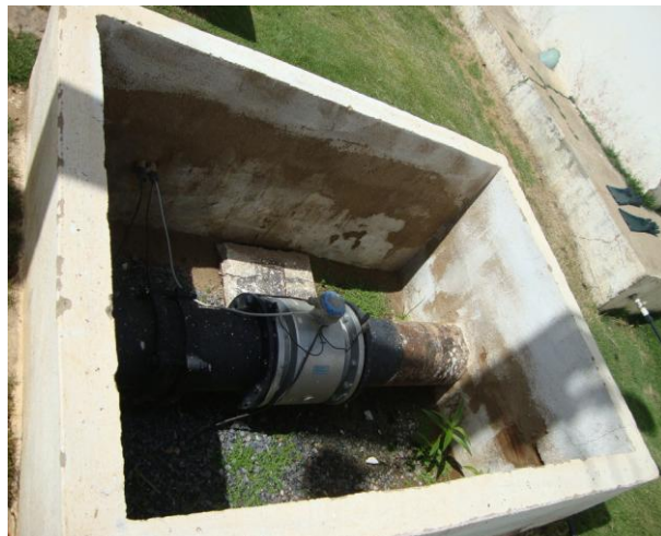
Foto 50 – Macromedidor de água tratada no interior da ETA.
