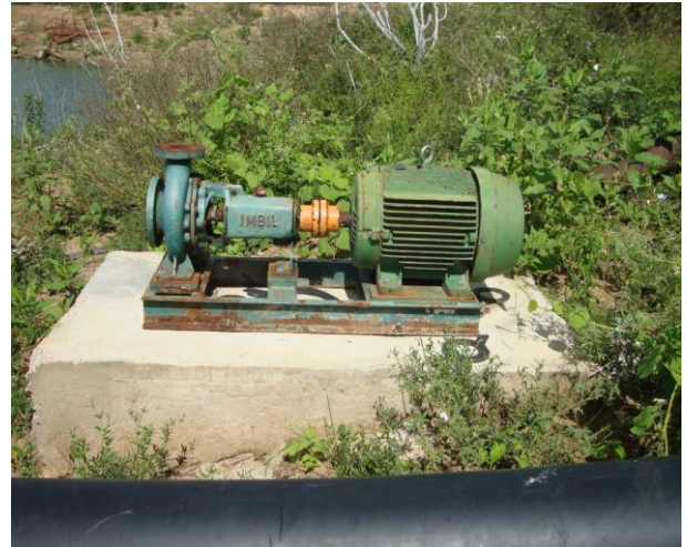
Foto 4 – Bomba reserva da captação.
