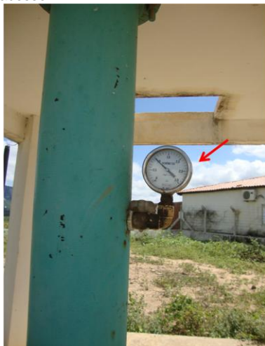
Foto 74 – Medidor de nível do REL-02.
