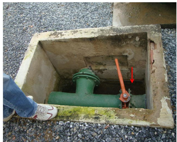
Foto 18 – Tubulação do filtro de pressão com vazamento.
