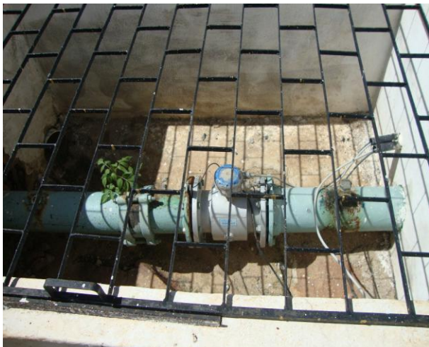
Foto 49 – Macromedidor de água tratada na entrada do REL-01.
