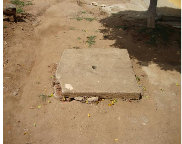
Foto 85 – Registro de descarga na Rua São Sebastião.
