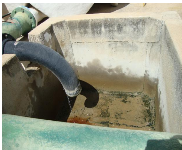
Foto 22 – Tubo de descarga do filtro-01.
