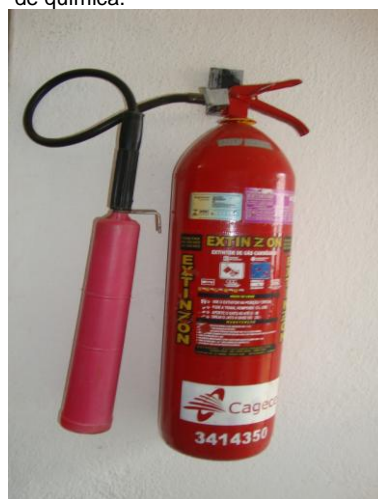
Foto 36 – Extintor de incêndio casa de química com validade vencida em julho/2011.
