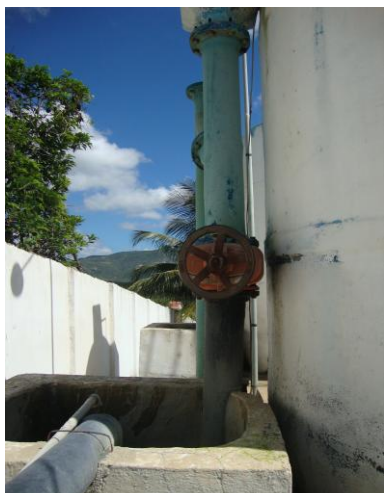
Foto 19 – Tubulação de descarga dos filtros.
