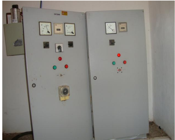
Foto 8 – Quadro de Comando da EECS-01.
