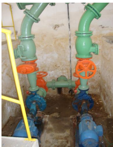
Foto 53 – Elevatória EEAT-01 com conjunto motor-bomba.
