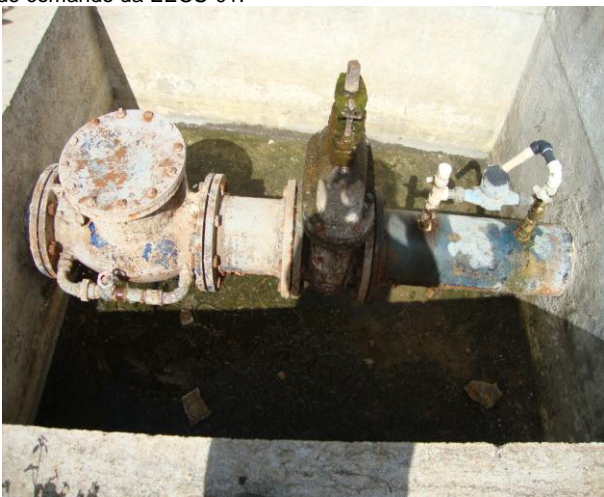
Foto 9 – Caixa de registro sem tampa ou grade de proteção, próximo à captação.
