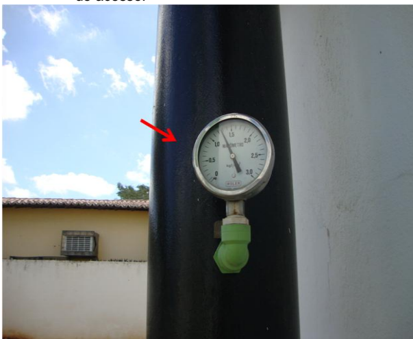
Foto 70 – Medidor de nível do REL-01.
