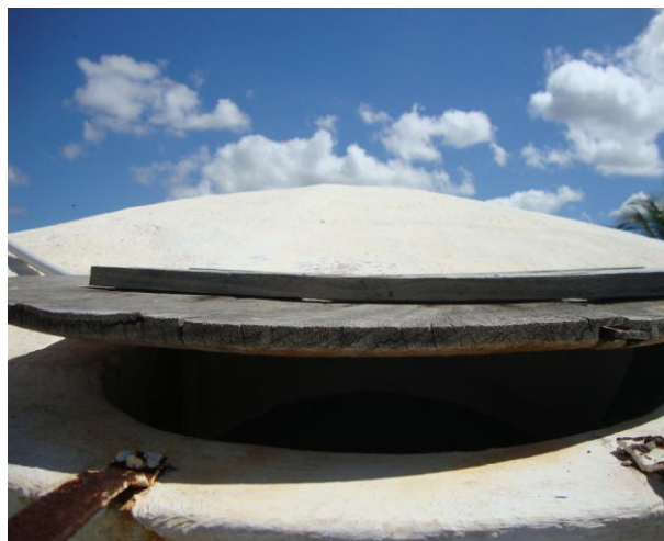
Foto 61 – RAP-01 com tampa de inspeção aberta.
