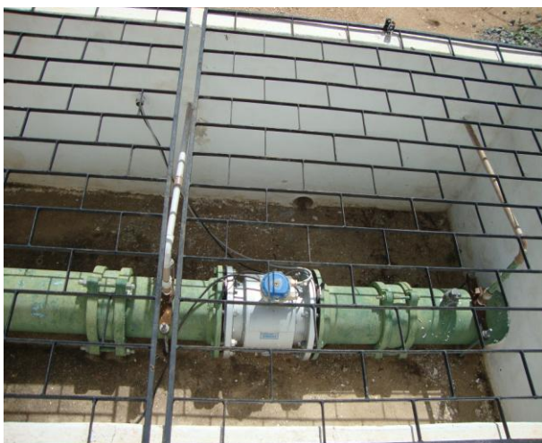
Foto 47 – Macromedidor de água bruta no interior da ETA.
