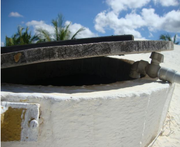
Foto 66 – RAP-02 com tampa de inspeção aberta.
