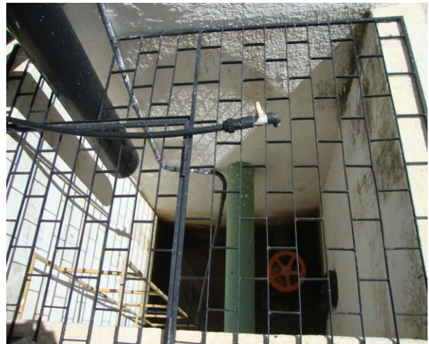
Foto 75 – Tubo extravasor e descarga dos RAP-01 e RAP-02.
