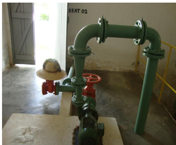
Foto 54 – Elevatória EEAT-02 com 1 (uma) bomba.
