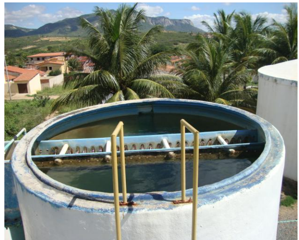
Foto 16 – Vista superior do Filtro-02.
