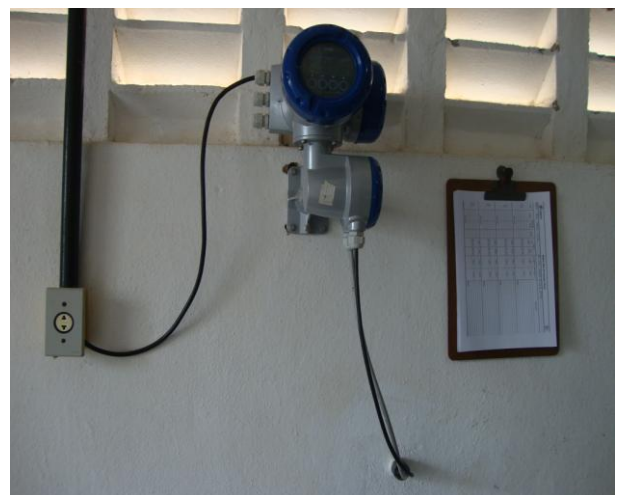
Foto 48 – Medidor eletromagnético de água tratada no interior da ETA.
