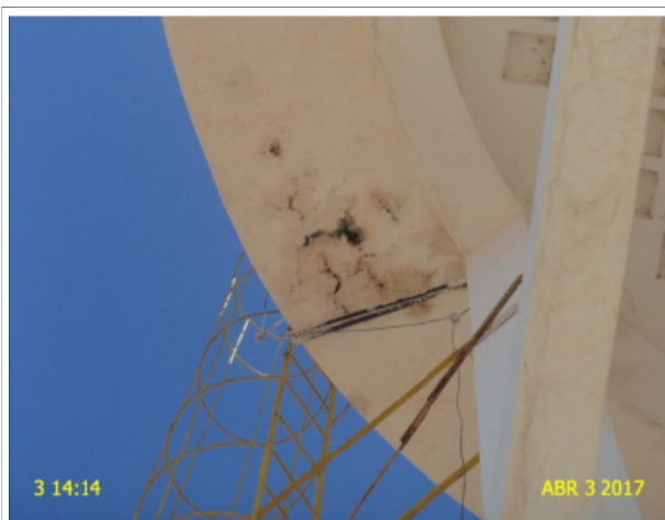
Foto 1 – Rel-01: sinais de infiltração.
