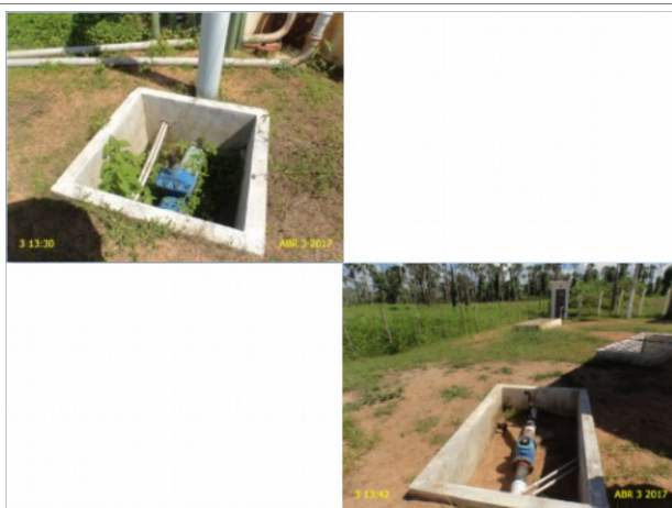
Foto 6 – AAB: caixas de inspeção na área da ETA sem tampa ou grade de inspeção.
