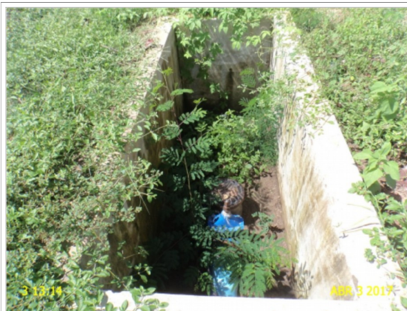
Foto 5 – AAB: caixa sem tampa ou grade de proteção, na área do PT-05.
