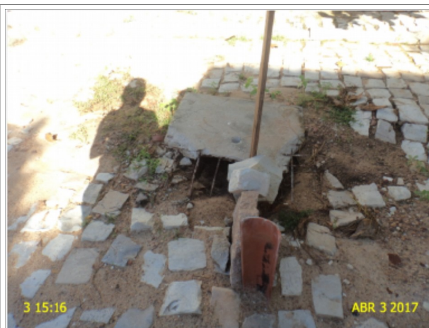
Foto 2 – RDA: tampa danificada na caixa do registro na Rua Hadoque Costa.
