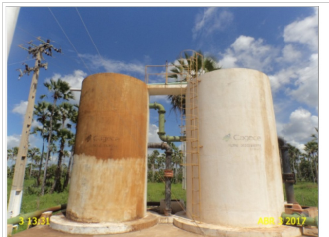
Foto 8 – Filtração: identificação apagada nos filtros e filtro de fluxo ascendente com pintura deteriorada.
