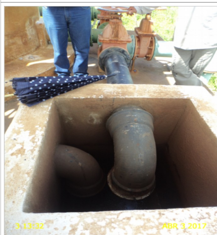
Foto 3 – Filtro de Fluxo Ascendente: tubulação com registro sem vedação.
