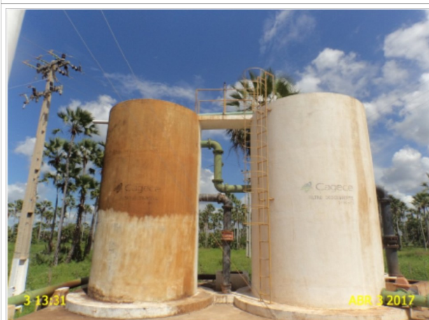
Foto 7 - Filtração: filtro de fluxo ascendente com pintura deteriorada
