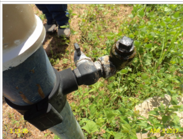
Foto 4 – PT-03: sinal de vazamento na tubulação.
