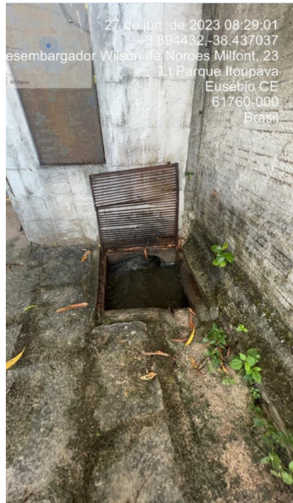
Foto 5 - Extravasamento de Esgoto na Propriedade.
