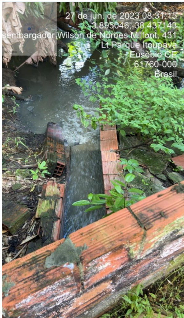
Foto 4 - Extravasamento de Esgoto junto ao córrego.
