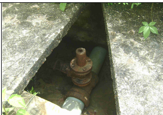
Foto 31 – Ventosa localizada entre a ETA e REL-01.
