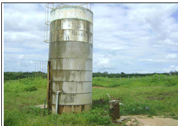
Foto 40 – EEAT-02: Sem identificação.
