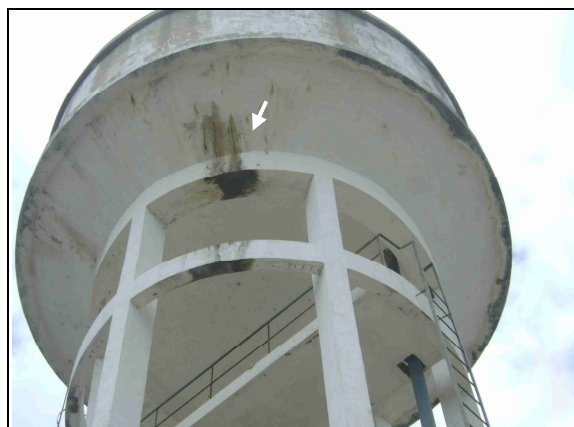
Foto 47 – REL-01: Sinal de vazamento.
