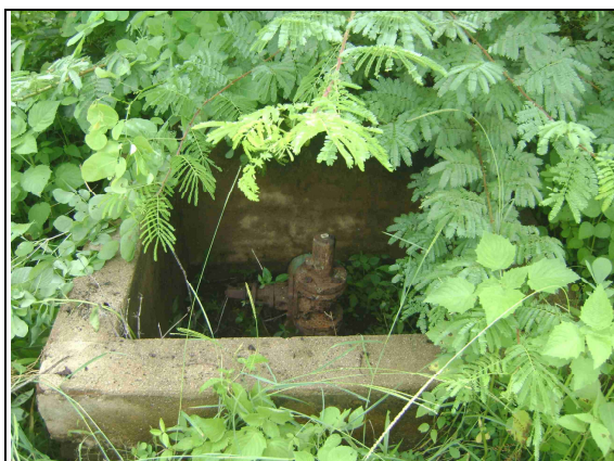
Foto 32 – Ventosa localizada entre a ETA e REL-01, sem tampa de proteção
