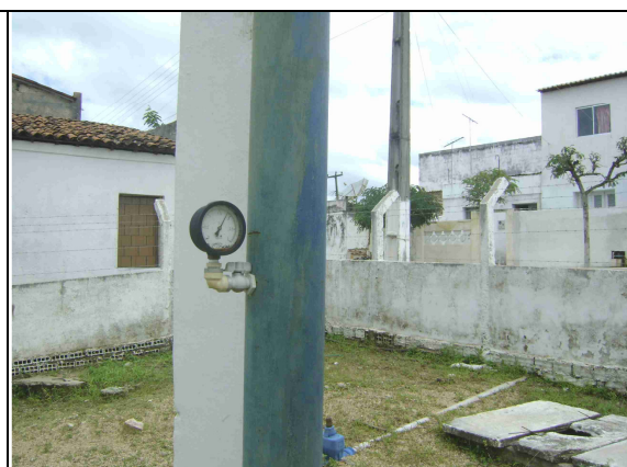
Foto 49 – REL-01: manômetro instalado na coluna de saída d'água.
