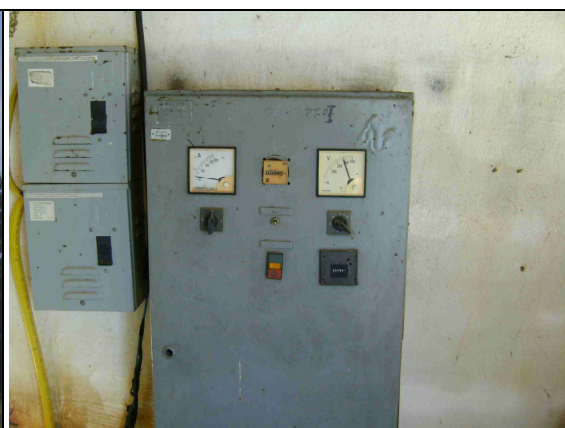
Foto 6 – Quadro de comando do PA-01.
