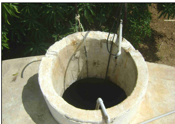
Foto 42 – RAP-01: Chaminé de acesso sem tampa de inspeção.
