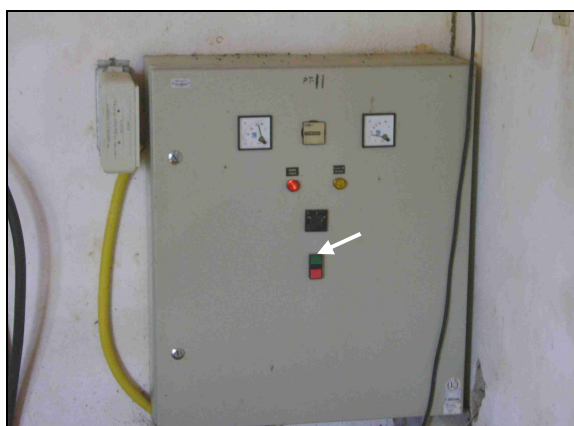
Foto 3 – PT-01: Quadro de comando.
