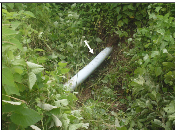
Foto 33 – Trecho de tubulação da adutora de água tratada, localizada entre a ETA e REL-01, exposta devido à erosão
