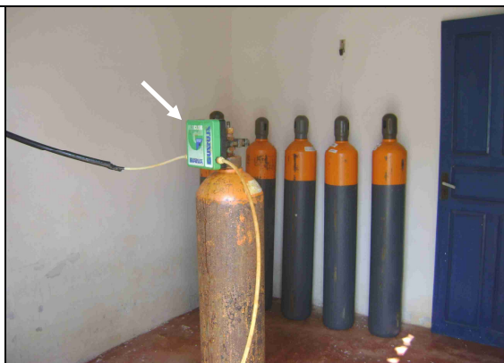
Foto 25 – Dosador e acondicionamento dos cilindros de cloro gasoso.
