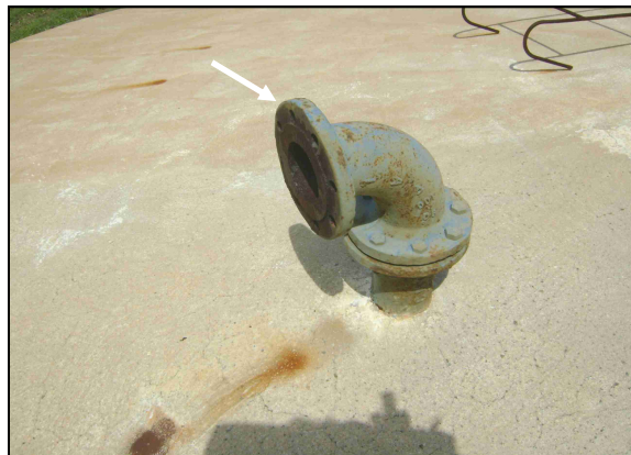
Foto 45 – RAP-01: Sem tela de proteção na tubulação de ventilação.
