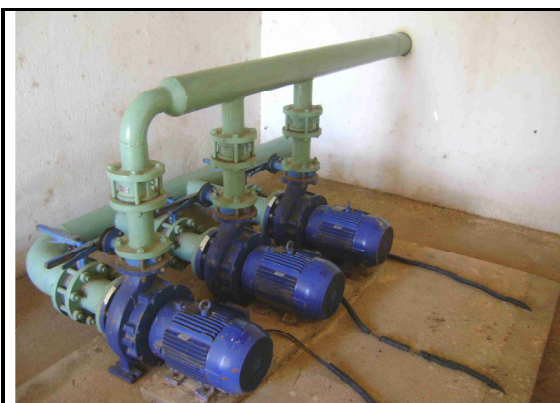
Foto 30 – Quadros de comando das EEAT-02 e EELF-01. Foto 36 – Conjunto moto-bomba da EELF-01.
