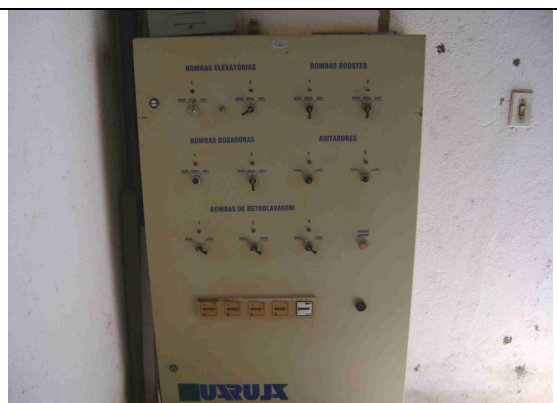
Foto 37 – Quadro de comando das EEAT-01 e EELF-01.
