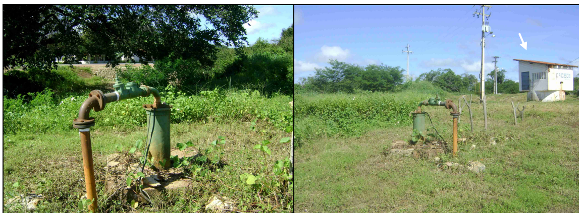
Foto 1 – PT-01: Sem identificação e cerca de proteção.
