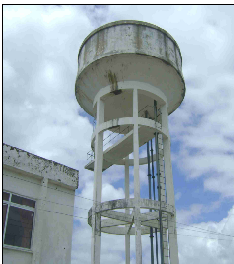
Foto 46 – REL-01: sem guarda-corpo na laje superior.
