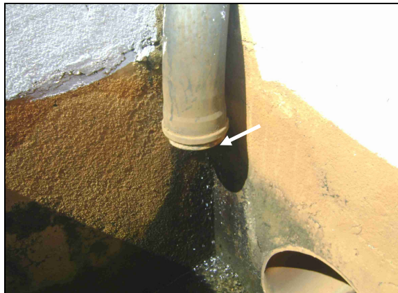
Foto 17 – Filtro 03: Vazamento no registro de descarga.
