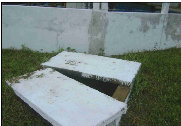
Foto 28 – Caixa de proteção da estação pitométrica, localizada na saída da ETA.
