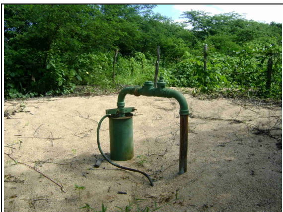
Foto 4 – PT-02: Tubulação de recalque.
