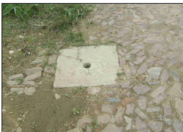
Foto 61 – Registro de descarga localizado na Rua Princesa Isabel.
