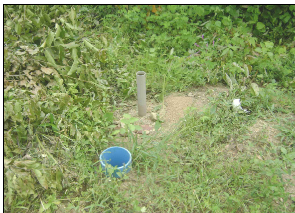
Foto 55 – Registro de descarga sem caixa de proteção, localizado na Rua José Antônio de Vasconcelos.
