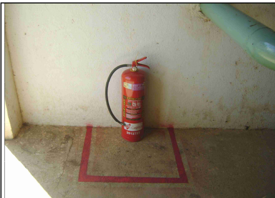
Foto 38 – Extintor de incêndio das EEAT-01 e EELF-01.
