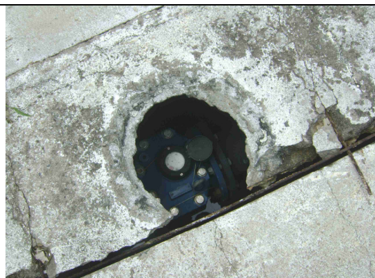
Foto 29 – Macromedidor localizado na chegada do REL-01.
