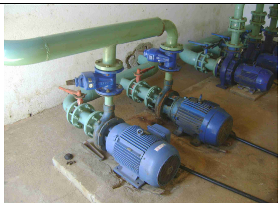
Foto 35 – Conjunto moto-bomba da EEAT-01.
