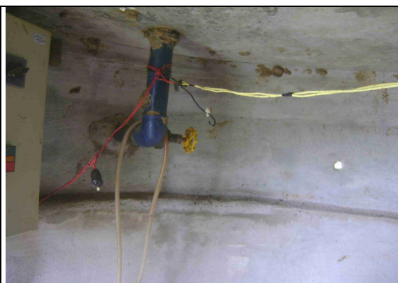
Foto 41 – EEAT-02: Fiação elétrica exposta.
