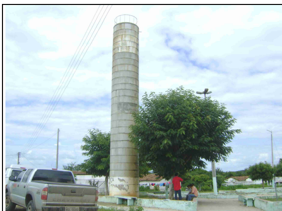
Foto 50 – REL-02: Sem identificação e cerca de proteção.
