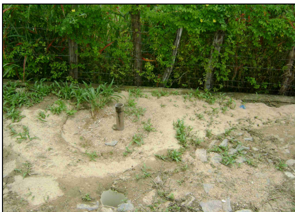
Foto 59 – Registro de descarga sem caixa de proteção, localizado na Rua Padre Mororó.
