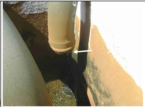
Foto 16 – Filtro 02: Vazamento no registro de descarga.
