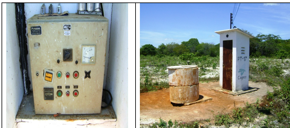
Fotos 48 e 49 – PT-17 - Quadro de comando e casa de proteção.
