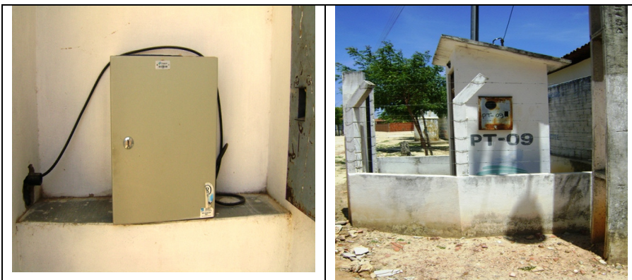
Fotos 36 e 37 – PT-09 - Quadro de comando e casa de proteção.
