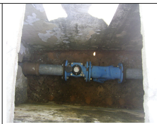
Foto 66 – Macromedidor na saída do RAP-02.
