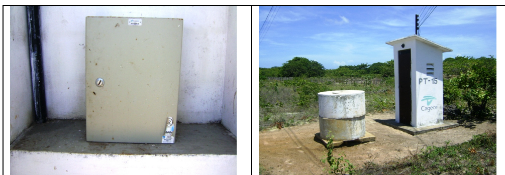
Fotos 46 e 47 – PT-15 - Quadro de comando e casa de proteção.
