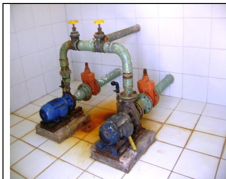
Foto 32 – EEAT-02 - conjuntos motores-bomba
