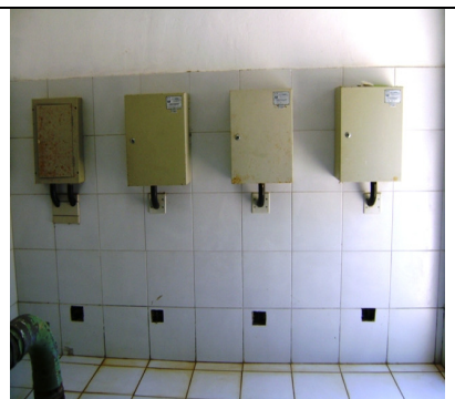
Foto 33 - Vista do Quadro de comando da EEAT-02 e PT-14
