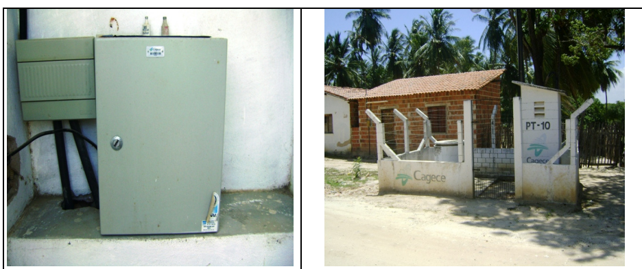
Fotos 38 e 39 – PT-10 - Quadro de comando e casa de proteção.
