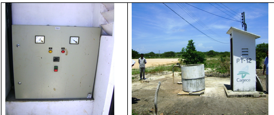
Fotos 42 e 43 – PT-12 - Quadro de comando e casa de proteção.
