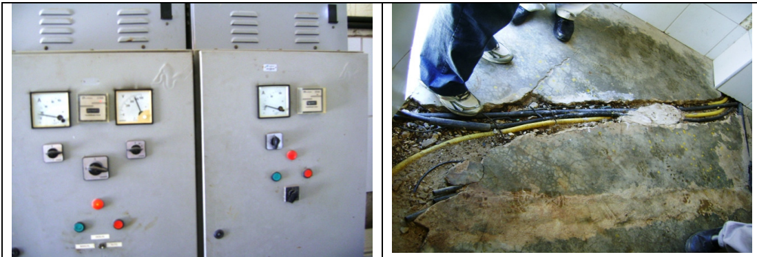
Fotos 30 e 31 – Quadro de comando da EEAT-01 com fiação exposta
