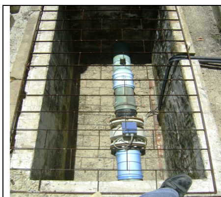
Foto 65 – Macromedidor na saída do RAP-01.
