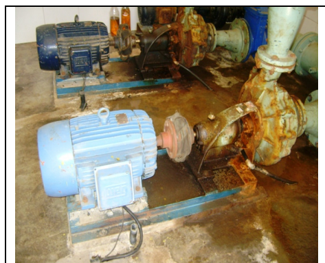
Foto 29 – EEAT-01 – conjuntos motores-bomba com vazamento
