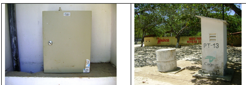
Fotos 44 e 45 – PT-13 - Quadro de comando e casa de proteção.
