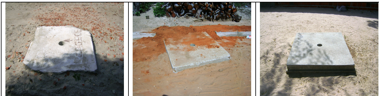
Fotos 67, 68 e 69 – Registros de descarga nas Ruas Jose B. Gondim, Poeira e próximo à Rodovia CE-040.
