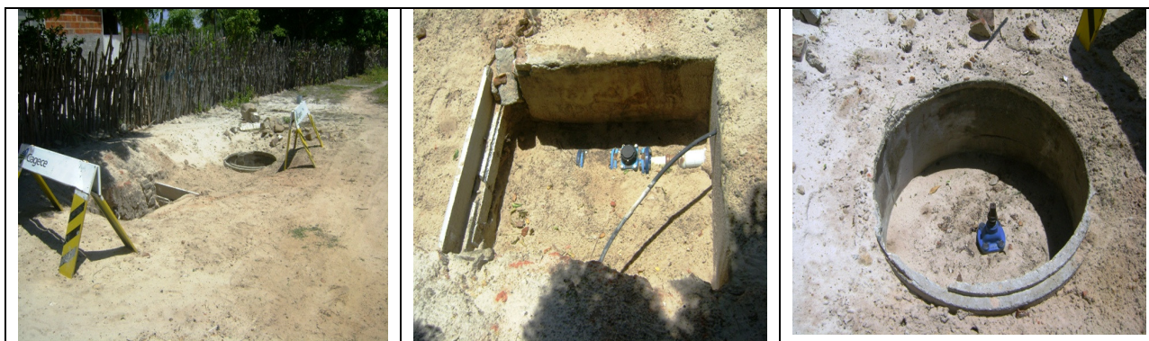
Fotos 62, 63 e 64 – Registro e macromedidor da adutora de água tratada, próximos ao RAP-01.
