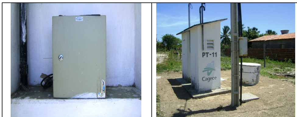
Fotos 40 e 41 – PT-11 - Quadro de comando e casa de proteção.
