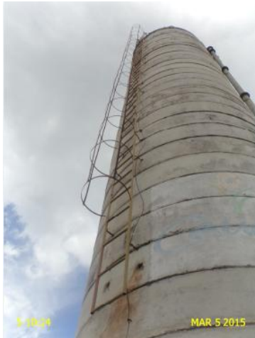
Foto 5 - REL-04: escada deteriorada e guarda-corpo em processo de corrosão.
