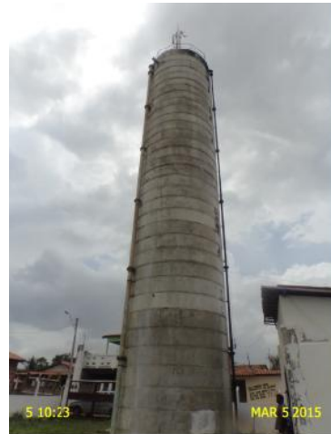
Foto 4 - REL-04: pintura deteriorada e ausência de identificação.
