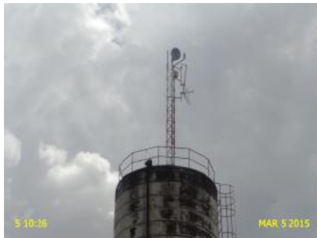
Foto 2 - REL-04: Ausência de para raios e sinalização noturna.
