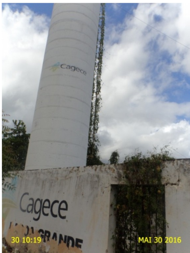
Foto 23 - REL-03: sem identificação e pintura deteriorada.
