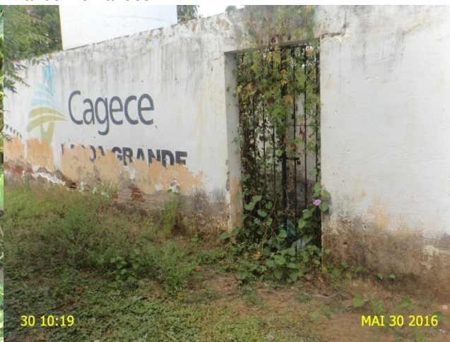
Foto 14 – REL-03: Vegetação excessiva na área do reservatório, impedindo o acesso.
