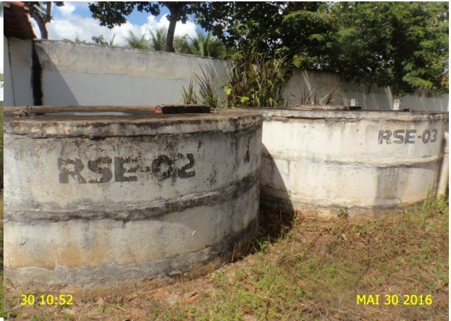
Foto 22 - RSE-02 e RSE-03: pintura deteriorada.
