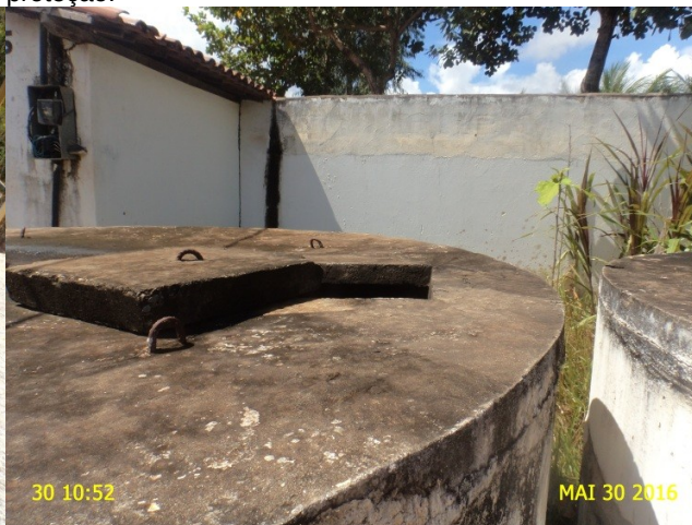
Foto 18 – RSE-02: tampa de inspeção sem vedação adequada.
