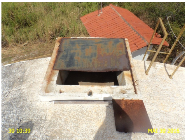
Foto 17 – RAP-13: tampa de inspeção sem vedação adequada.
