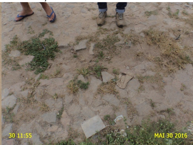
Foto 12 – RDA: Registro de descarga soterrado – Rua Manoel Fernandes.
