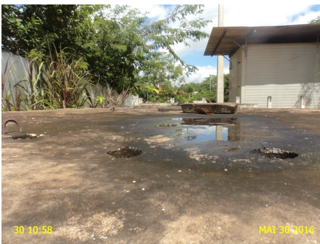
Foto 7 – RSE-03: laje de cobertura com acúmulo e entrada indevida de águas pluviais.
