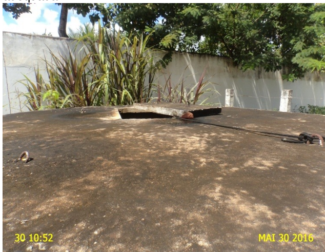
Foto 19 – RSE-03: tampa de inspeção sem vedação adequada.
