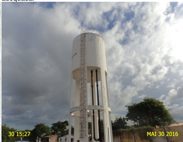
Foto 20 – REL-02: sem identificação e pintura deteriorada.
