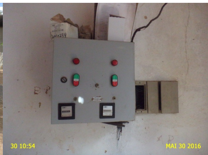
Foto 8 - EERD-05: Quadro de comando sem amperímetro e voltímetro.
