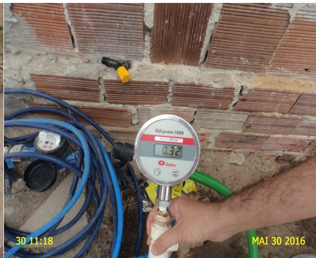
Foto 2 – RDA: Medição de pressão instantânea na rede de distribuição - Rua SDO 01 – Miraim 2.
