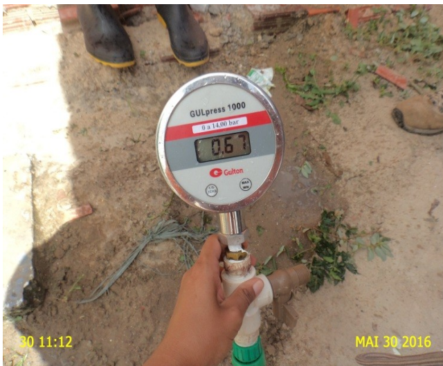
Foto 1 – RDA: Medição de pressão instantânea na rede de distribuição - Rua SDO 12 – Miraim 1.
