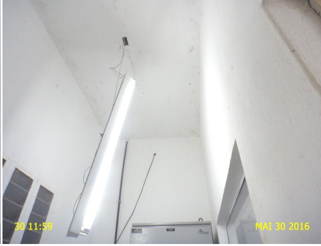
Foto 26 - EEE-01: instalação de iluminação inadequada.
