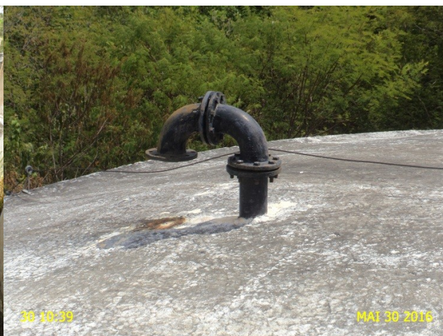
Foto 16 – RAP-13: Tubulação de ventilação sem tela de proteção.
