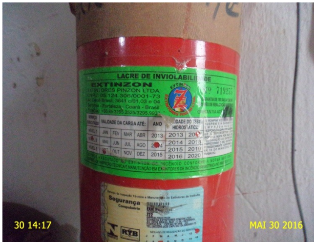
Foto 24 - Extintor de incêndio com data de validade da recarga fora do prazo.
