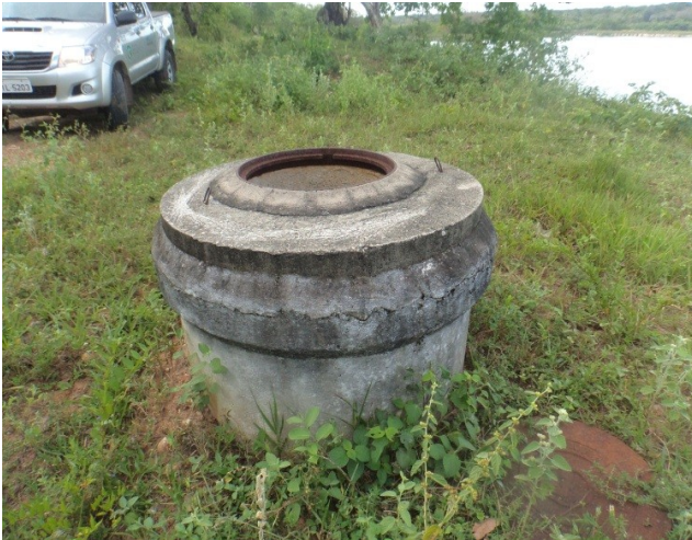
Foto 33 – ETE: poço de visita sem tampa.
