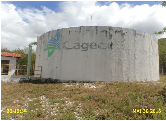
Foto 21 - RAP-13: sem identificação e pintura deteriorada.
