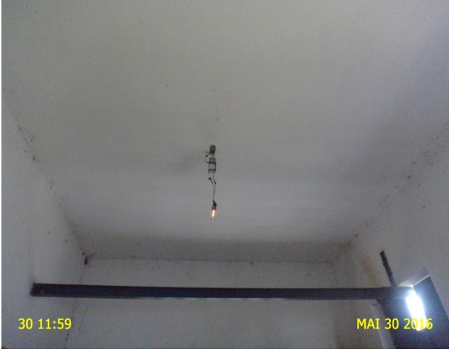
Foto 25 - EEE-01: instalação de iluminação inadequada.
