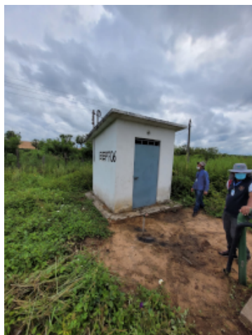
Foto 6 - PT-06: Iluminação inadequada.
