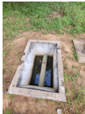
Foto 23 - ETA: Caixa de adutora sem tampa, com acúmulo de água pluvial (ao lado do PT-01).
