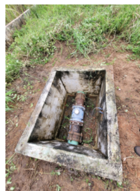
Foto 21 - ETA: Macromedidor sem tampa
