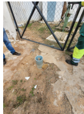
Foto 2 - PT-04: ponto de cloração na calçada e registro sem caixa de proteção.
