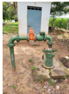
Foto 27 - PT-05: Laje de proteção danificada.
