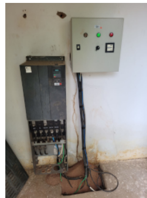
Foto 13 - PT-05: Instalação elétrica inadequada.
