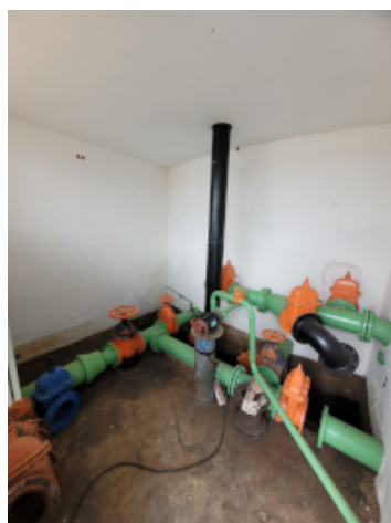
Foto 8 - RAP-03: Casa de bombas com iluminação inadequada.
