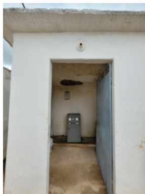
Foto 10 - PT-04: Iluminação inadequada.
