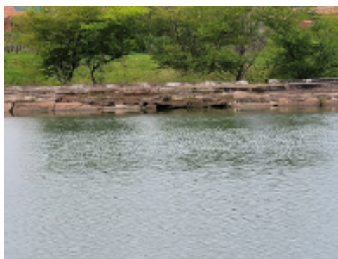
Foto 31 - ETE: Deslocamento da contenção/proteção de concreto na Lagoa Facultativa.
