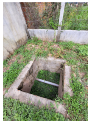
Foto 25 - PT-08: Caixa de proteção sem tampa.
