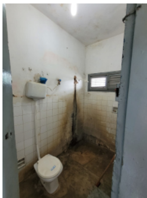
Foto 26 - ETA: Banheiro deteriorado.
