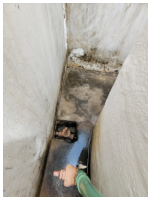
Foto 3 - RAP-04: Registro sem caixa de proteção e sem mobilidade.
