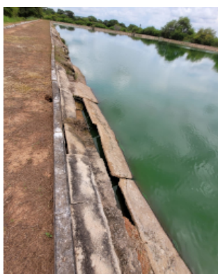
Foto 32 - ETE: Deslocamento da contenção/proteção de concreto na Lagoa Facultativa.
