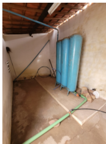
Foto 9 - RAP-04: Iluminação inadequada.
