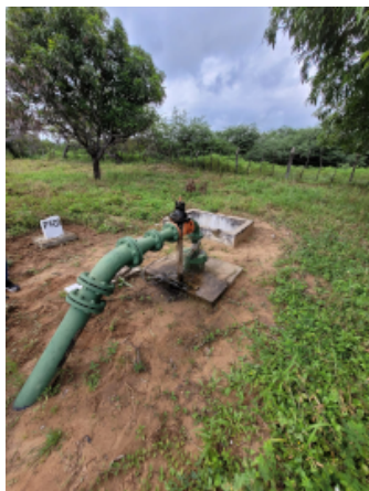
Foto 16 - PT-01: Instalação com vazamento .
