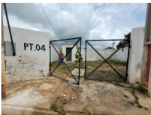
Foto 20 - PT-04: Necessidade de limpeza na área.
