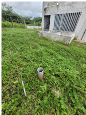
Foto 1 - PT-01: Registro sem caixa de proteção.
