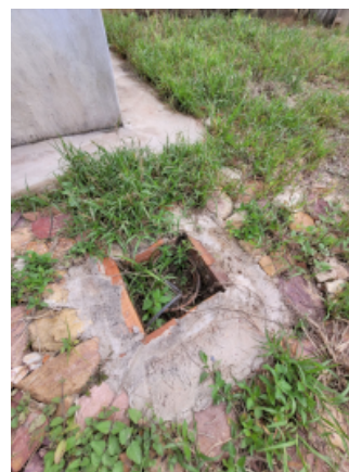
Foto 15 - PT-08: Instalação elétrica inadequada
