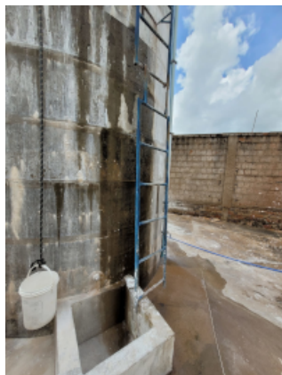
Foto 18 - RAP-05: Reservatório com vazamento.
