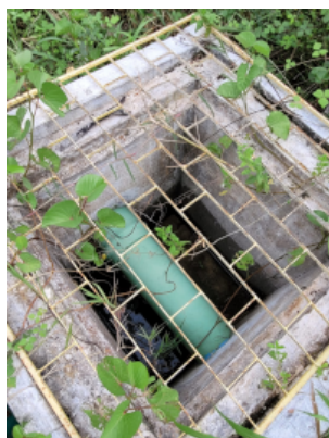
Foto 24 - ETA: Caixa de proteção com acúmulo de água pluvial (ao lado do RAP-01).
