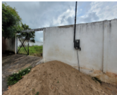
Foto 4 - RAP-03: ausência de identificação.
