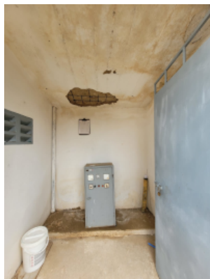
Foto 28 - PT-04: laje com aço aparente na casa de abrigo.
