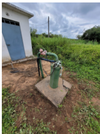
Foto 14 - PT-06: Instalação elétrica inadequada.
