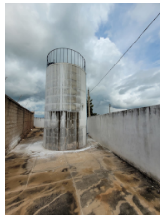
Foto 17 - RAP-05: Reservatório com vazamento.
