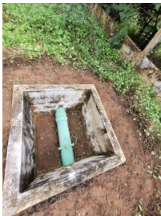
Foto 22 - ETA: Caixa de adutora sem tampa.
