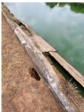
Foto 30 - ETE: Erosão do talude da Lagoa Facultativa.
