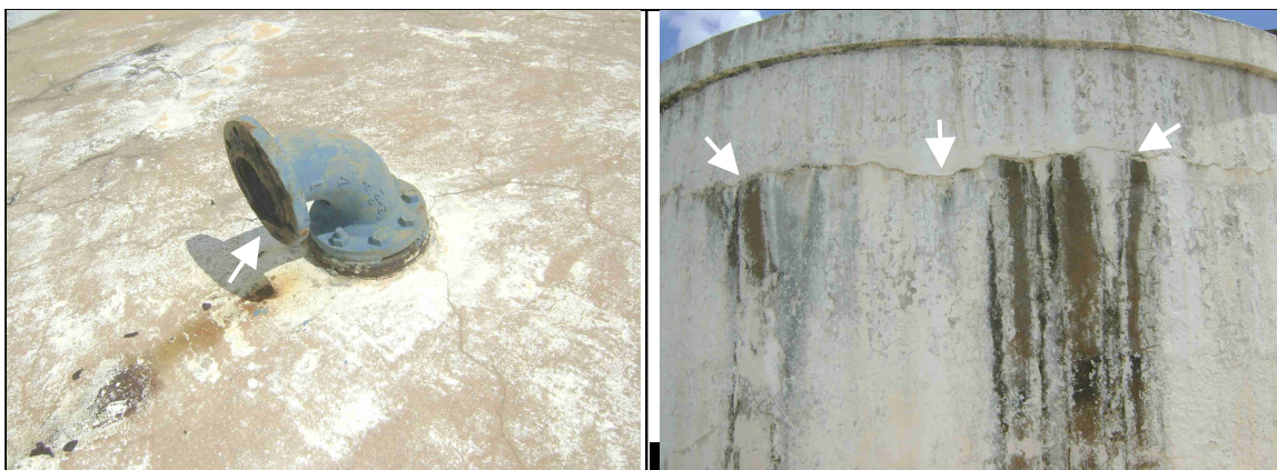
Foto 23 – Tubulação de ventilação sem tela de proteção – RAP-01.
