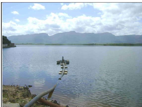
Foto 1 – Açude Várzea da Volta - Captação do SAA de Moraújo, Coreau e da localidade de Várzea da Volta.
