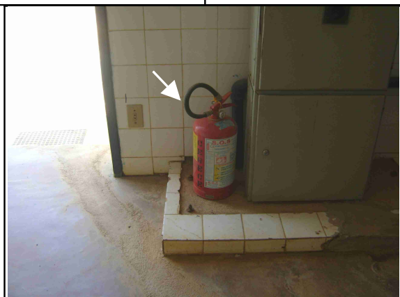
Foto 22 – Extintor de incêndio em local inadequado – EEAT-02.
