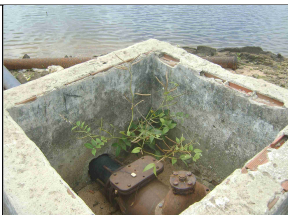
Foto 2 – Caixa da válvula de retenção sem tampa de proteção.
