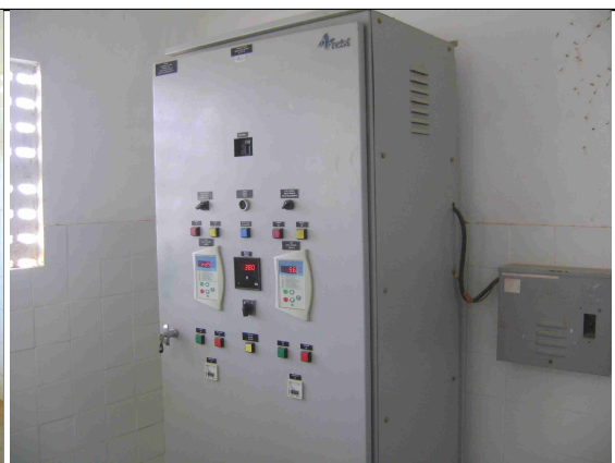
Foto 19 – Quadro de Comando da EEAT-01.
