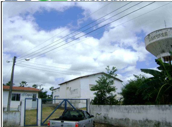
Foto 3 – Entrada da ETA com pintura e identificação deterioradas.
