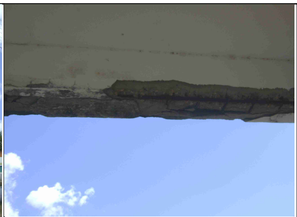
Foto 29 – Ferrugem aparente da estrutura do REL-02.
