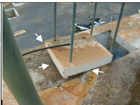
Foto 26 – Escada de acesso solta – REL-01.
