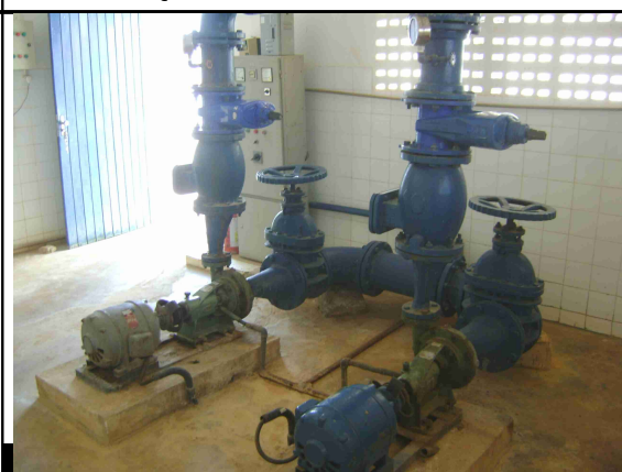
Foto 21 – Bombas da EEAT-02.
