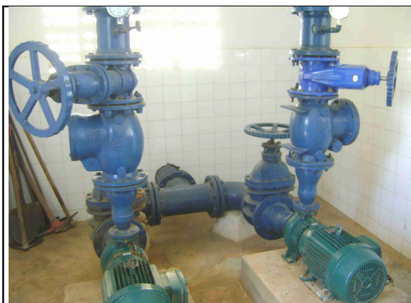
Foto 18 – Bombas da EEAT-01.
