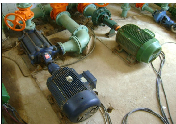
Foto 25 – EEAT-01: Conjuntos moto-bomba.
