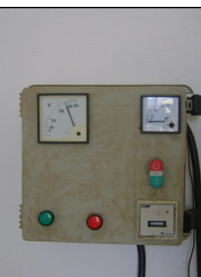
Foto 28 – EEAT-02: Quadro de comando.
