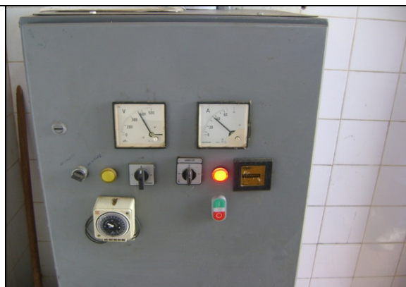
Foto 23 – EECS-01: Quadro de comando.
