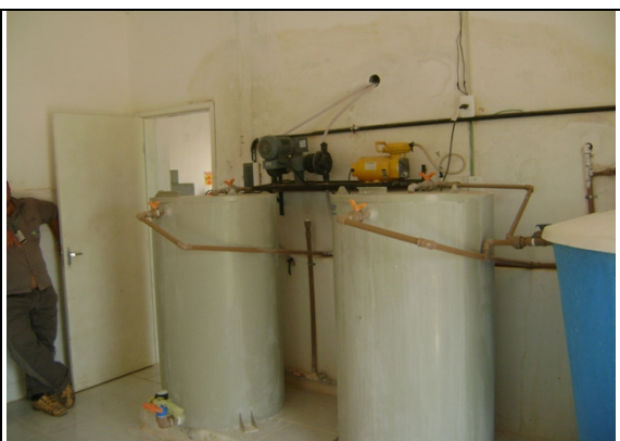
Foto 19 – Tanques de mistura de produtos químicos.
