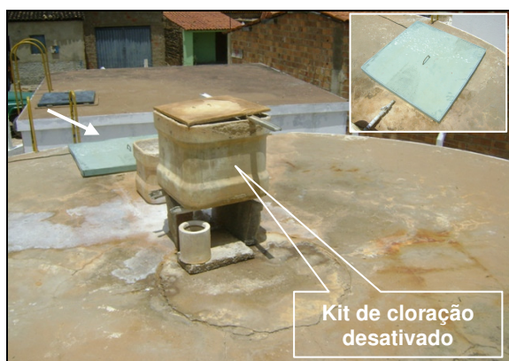
Foto 41 – RAP-02: Tampa de visita adequada, ausência de tubulação de ventilação e kit de cloração desativado.
