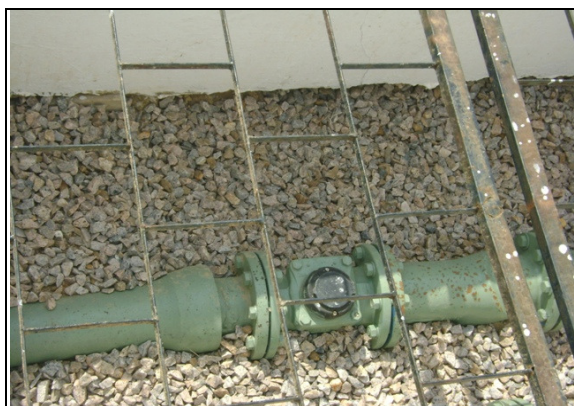
Foto 21 – Macromedidor de água tratada, localizado na saída da EEAT-02.
