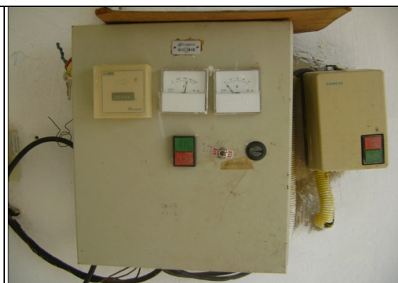
Foto 33 – EEAT-04: Quadro de comando.
