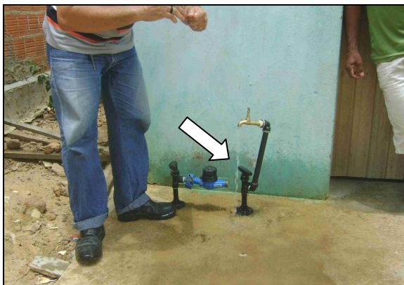
Foto 56 – Medição de pressão na Rua Dr. José Calazans G. Pena, nº 442 - Centro, antes do hidrômetro.
