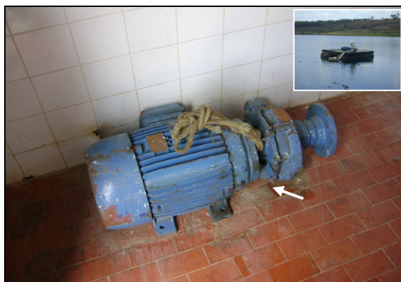
Foto 24 – EECS-01: Conjunto moto-bomba reserva, localizada na casa de comando.
