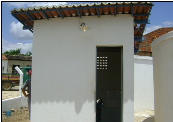
Foto 29 – EEAT-03: Sem identificação.
