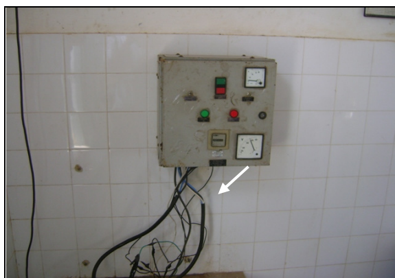
Foto 31 – EEAT-03: Quadro de comando apresentando fiação exposta.
