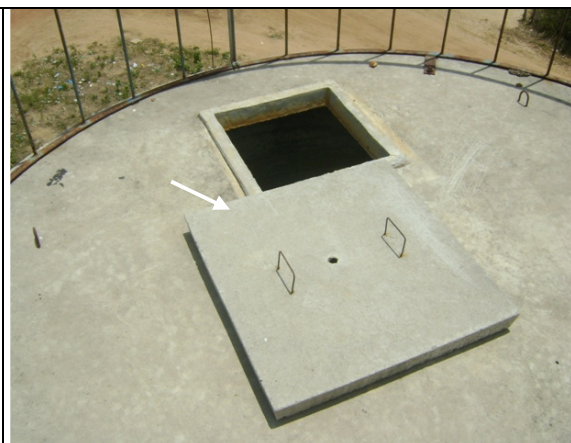
Foto 52 – REL-01: Ausência de tubulação de ventilação.
