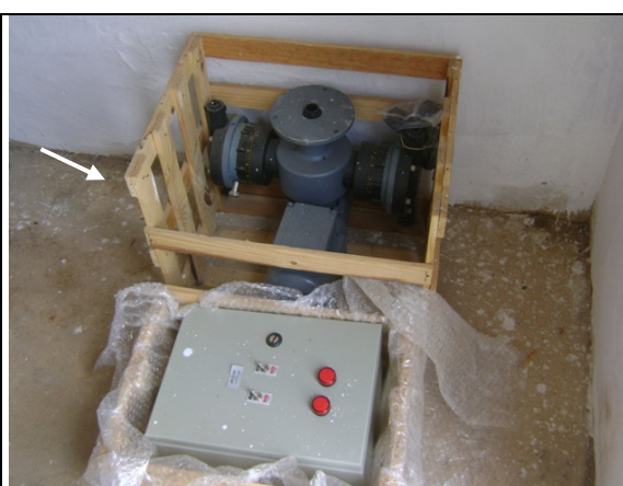
Foto 48 – Quadro de comando e bomba dosadora.
