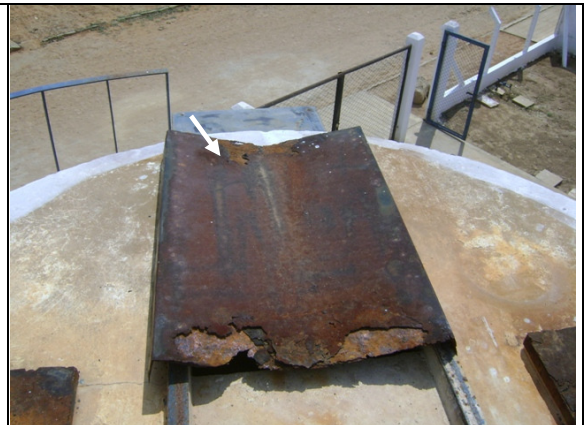
Foto 9 – Filtro 01: Tapa deteriorada pela corrosão.
