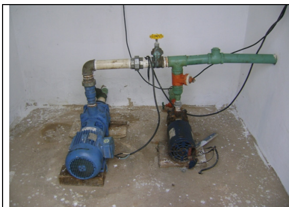
Foto 32 – EEAT-04: Conjuntos moto-bomba apresentando fiação expostas.
