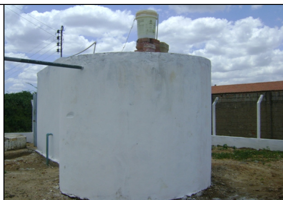
Foto 44 – RAP-05: Sem identificação e sem tubulação de ventilação.
