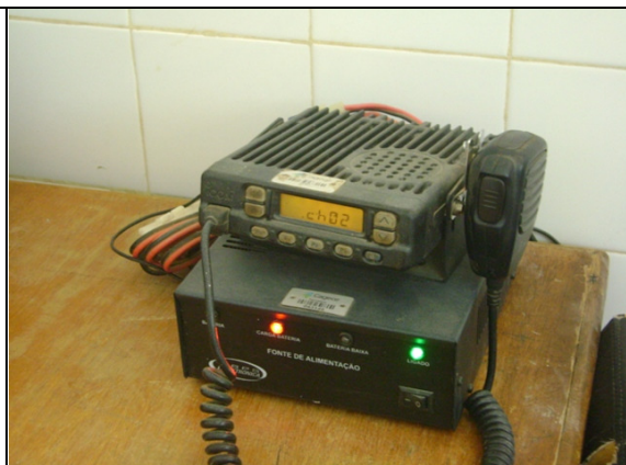
Foto 5 – Rádio da ETA.
