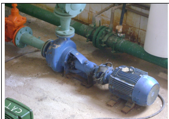
Foto 27 – EEAT-02: Conjunto moto-bomba.
