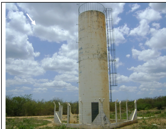
Foto 51 – REL-03: Sem identificação, pintura deteriorada e sem sinalizador noturno.
