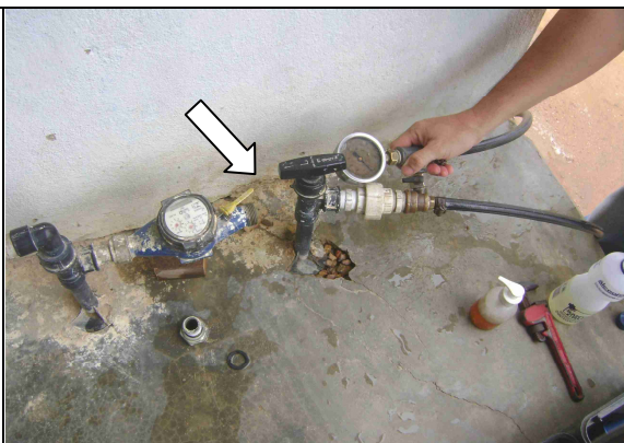
Foto 59 – Medição de pressão na Rua 105, nº 125 - COHAB 3, antes do hidrômetro.
