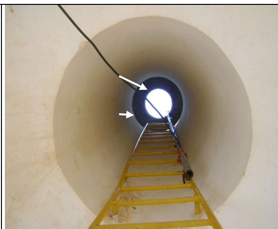
Foto 50 – REL-01: Ausência de tampa de inspeção na laje superior e de tela de proteção no acesso interno..
