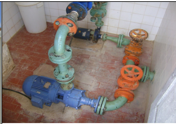
Foto 30 – EEAT-03: Conjuntos moto-bomba.
