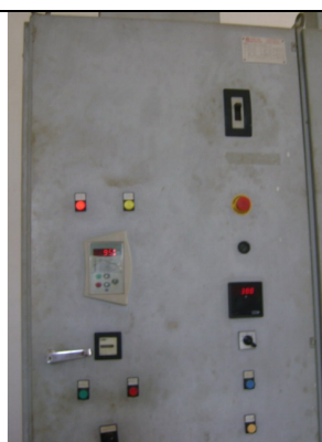
Foto 26 – EEAT-01: Quadro de comando.
