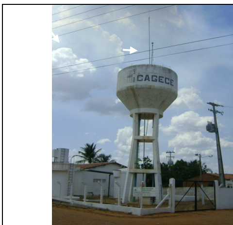
Foto 49 – REL-01: Ausência de sinalizador noturno.
