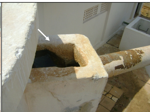
Foto 7 – Filtro 01: Sem tampa de proteção na caixa de saída da água tratada
