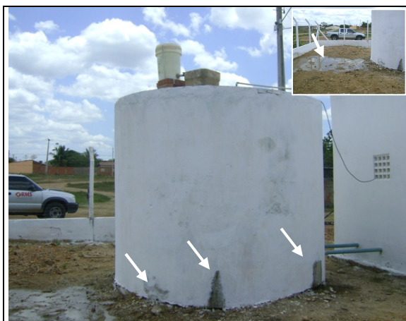
Foto 45 – RAP-05: Vazamentos em sua estrutura.
