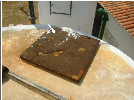
Foto 8 – Filtro 01: Tapa deteriorada pela corrosão.
