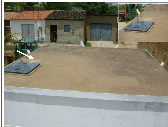
Foto 40 – RAP-03: Tampa de visita adequada e ausência de tubulação de ventilação.
