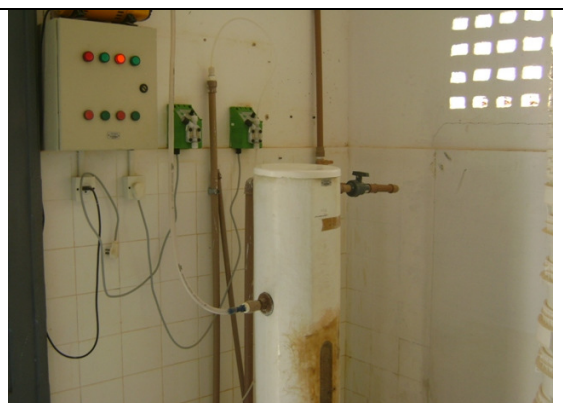
Foto 17 – Dosador de flúor.
