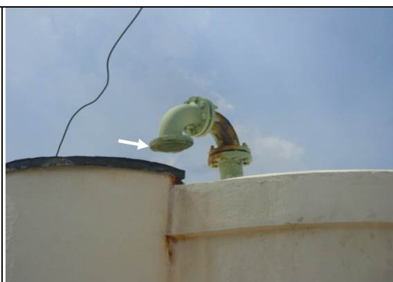
Foto 35 – RAP-01: Tubulação de ventilação com tela de proteção.
