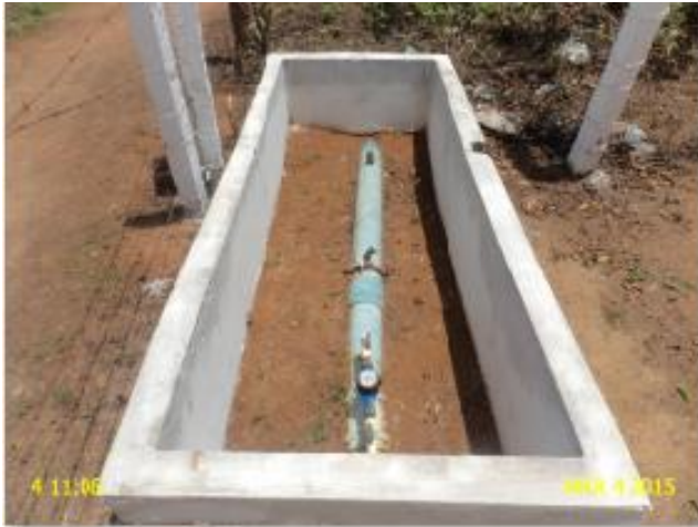
Foto 3 - AAT: registro sem tampa ou grade de proteção.
