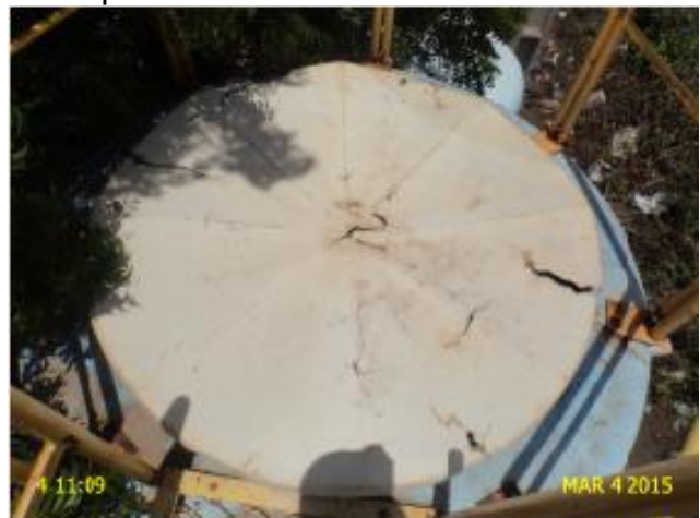
Foto 8 - Filtração: tampa deteriorada.
