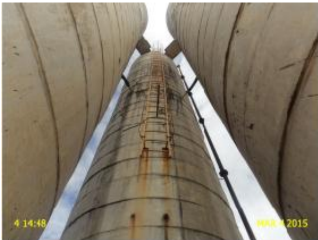
Foto 11 - Reservatórios: escada deteriorada com guarda-corpos em processo de corrosão.
