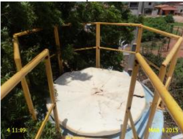
Foto 7 - Filtração: guarda-corpo em processo de corrosão.
