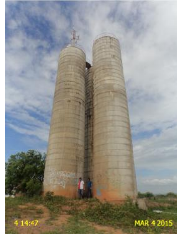
Foto 10 - Reservatórios: pintura deteriorada e ausência de identificação.
