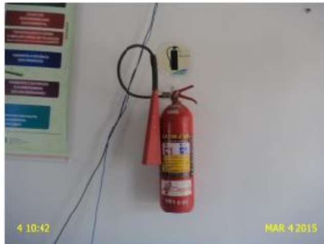
Foto 13 - Loja de atendimento: extintor com validade de carga vencida.
