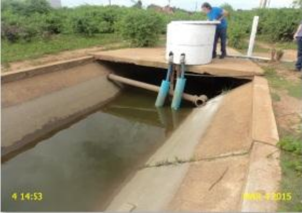
Foto 14 - Canal Sítios Novos: ausência de sinalização identificando a área da captação como destinada ao abastecimento público.
