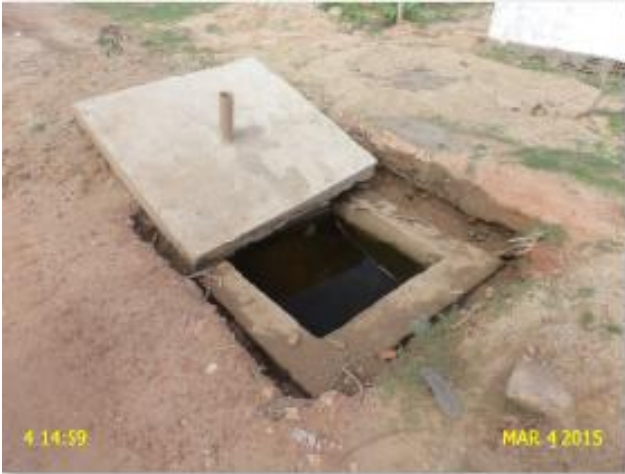
Foto 9 - RDA: registro de descarga com sinais de vazamento na Avenida Central.
