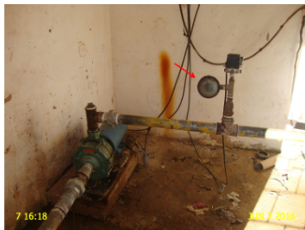
Foto 03 - Booster Sítio São José: ausência de bomba reserva e manômetro com defeito.
