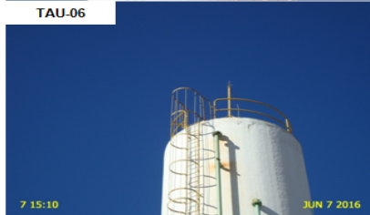
Foto 30 – TAU-05 e TAU-06: ausência de sinalizador noturno.
