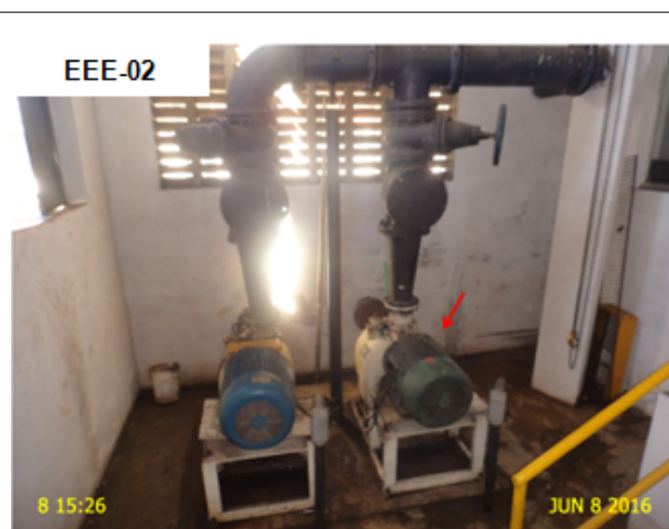
Foto 13 - EEE-02: bomba reserva sem funcionar.
