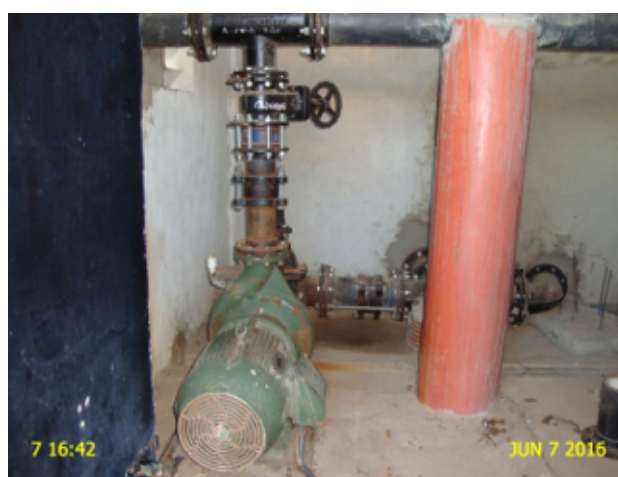
Foto 04 - EEAT-04 (Booster) (Tianguá): ausência de bomba reserva.
