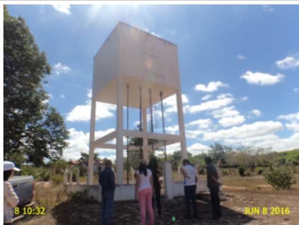
Foto 05 – REL (Tucuns): ausência de guarda-corpo.
