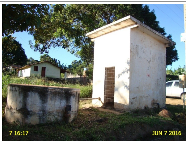
Foto 21 – Booster Sítio São José: ausência de identificação.
