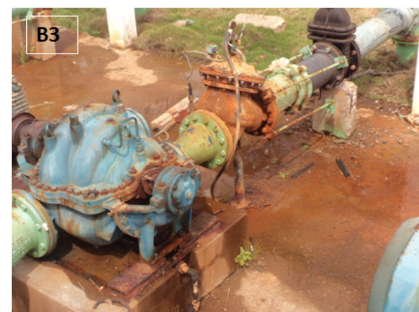
Foto 18 - EEAT-02 (Tianguá): apresenta vazamento na bomba B3.
