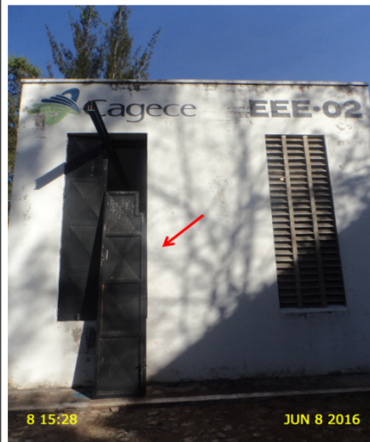
Foto 15 - EEE-02: porta danificada..
