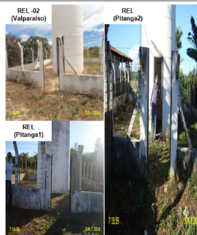
Foto 06 – REL-02 (Valparaíso), REL (Pitanga 1) e REL (Pitanga 2): não são dotados de portões de acesso.
