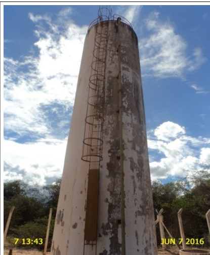
Foto 27 – TAU-01: apresenta escada e pintura deterioradas, identificação pouco visível, ausência de para-raio e sinalizador noturno.
