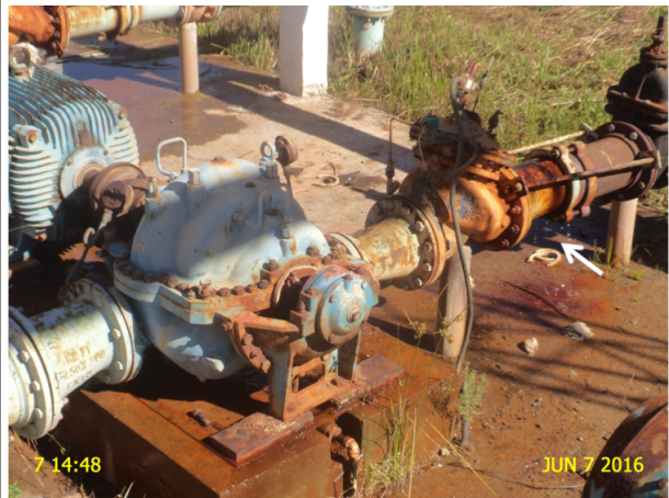
Foto 19 - EEAT-03 (Tianguá): apresenta vazamento na bomba B3.
