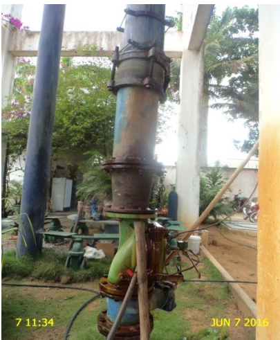
Foto 16 - REL-04 (Tianguá): tubulação de chegada com vazamento..
