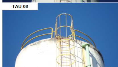
Foto 31 – TAU-07 e TAU-08: ausência de para-raio e sinalizador noturno.
