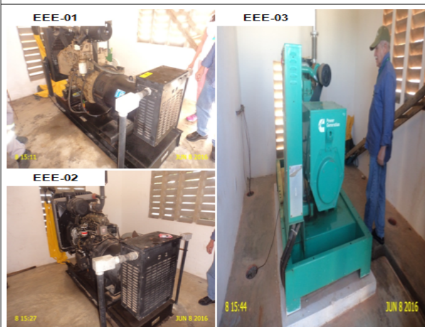
Foto 22 – EEE-01, EEE-02 e EEE-03: grupo gerador de energia elétrica sem funcionamento.
