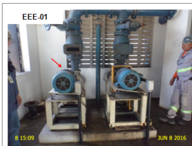
Foto 12 – EEE-01 bomba reserva sem funcionar
