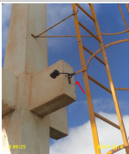
Foto 26 – REL (Aeroporto): escada sem apoio na estrutura do reservatório.
