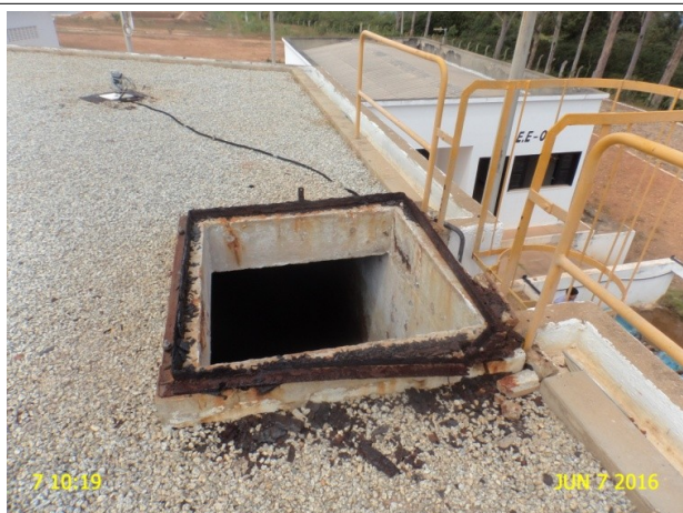
Foto 07 – RAP-01: ausência de tampa de inspeção.
