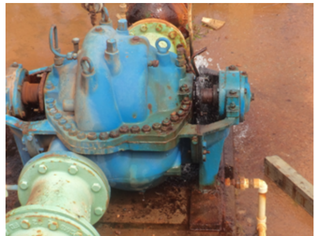
Foto 17 - EEAT-02 (Tianguá): apresenta vazamento na bomba B1.
