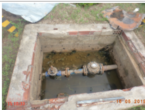
Foto 8 - Caixa: Caixa do medidor que abastece o SISAR está sem tampa ou grade de proteção.
