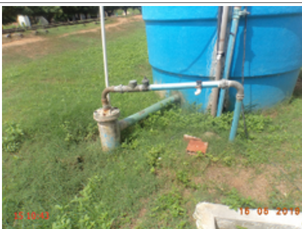
Foto 7 - EEAT-03: A elevatória EEAT-03 não está identificada.
