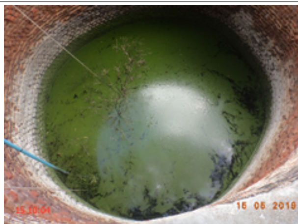
Foto 3 - Captação: O poço PA-04 apresenta impurezas na superfície da água.
