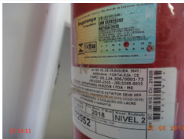
Foto 6 - Escritório: Extintor com recarga vencida.
