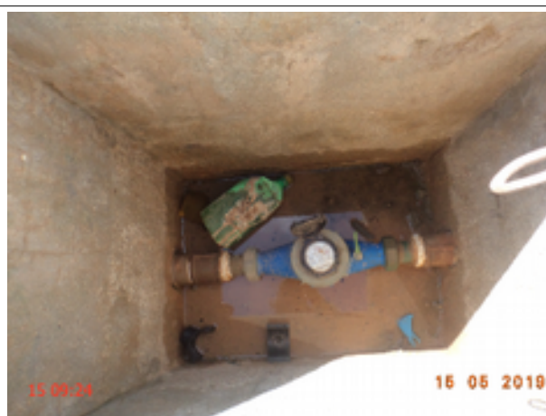
Foto 2 - Captação: O poço PT-02 apresenta vazamento no medidor.
