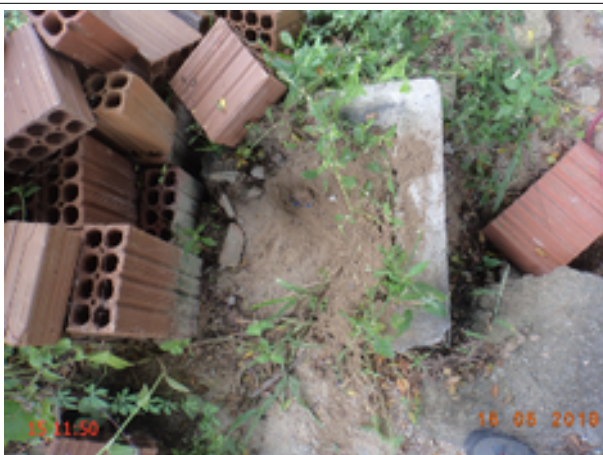
Foto 5 - Descarga: Localizada na Rua da Creche está soterrada e sem caixa de proteção.
