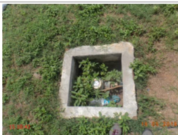
Foto 1 - RAP-05 Caixa sem tampa ou grade de proteção.
