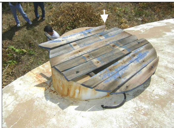
Foto 2 – Tampa de inspeção inadequada.
