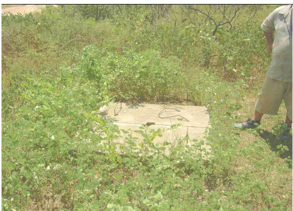
Foto 8 – Registro de descarga localizado na Rua Bregedo.
