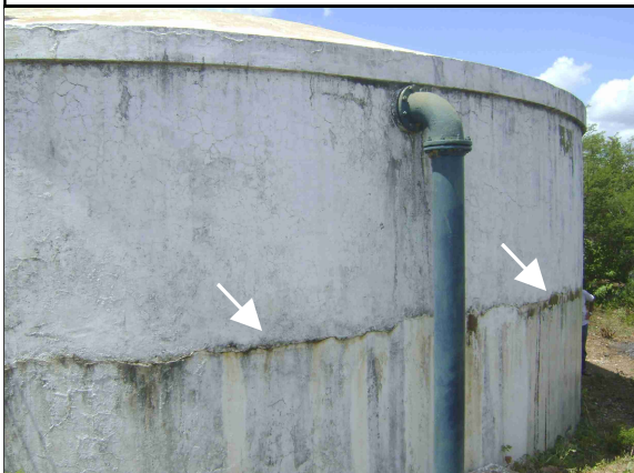
Foto 3– Vazamento do RAP-02.
