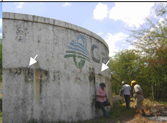
Foto 4– Outra vista do vazamento - RAP-02.
