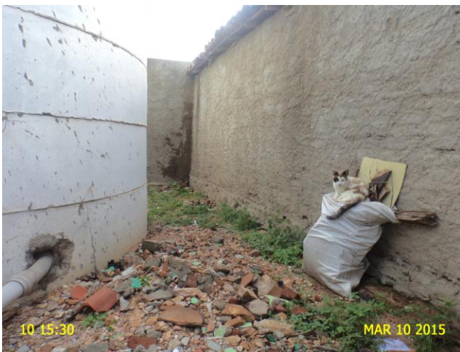
Foto 21 – REL-02: inadequadas condições de limpeza e manutenção.
