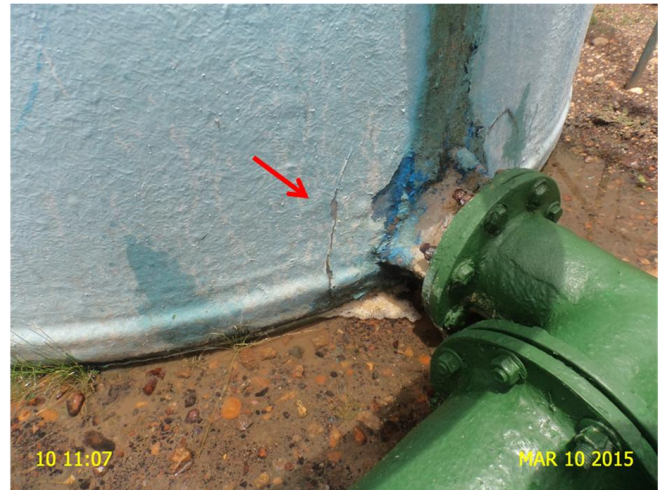
Foto 14 – ETA: filtro F-01 com fissura.
