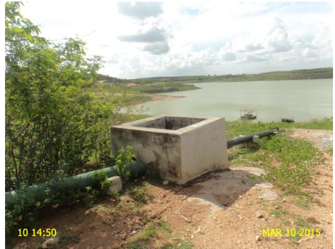
Foto 8 – Captação Superficial: área destinada à captação.
