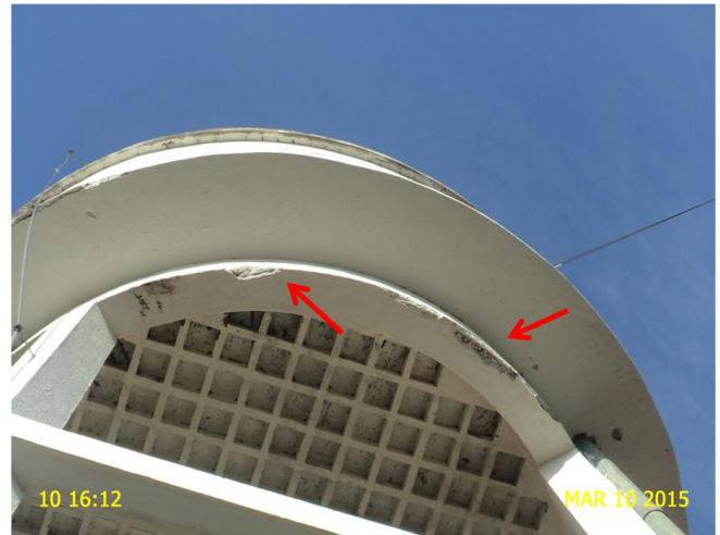
Foto 32 – REL-01: estrutura deteriorada.
