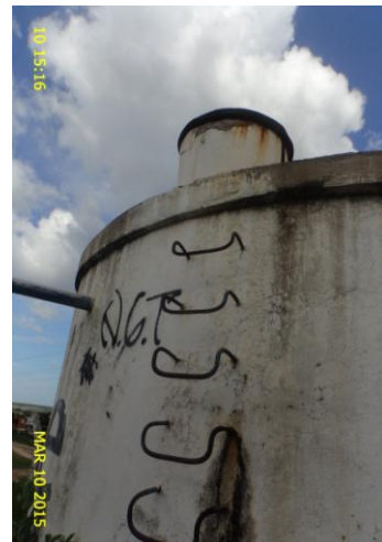
Foto 28 – RAP-02: escada de acesso inadequada.
