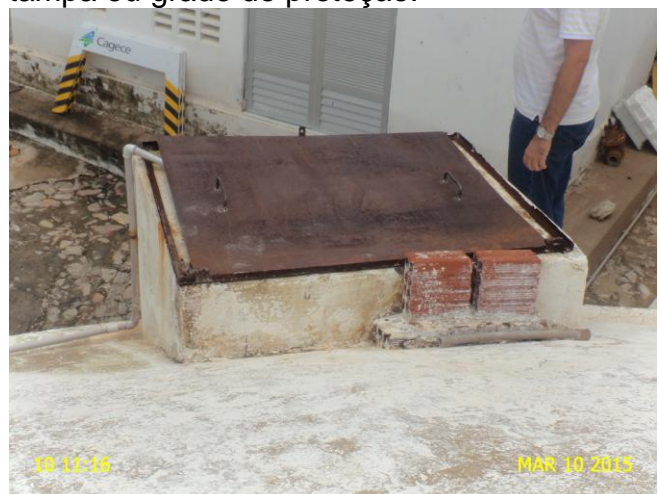
Foto 24 – RSE-01: tampa em processo de corrosão e sem a adequada vedação.
