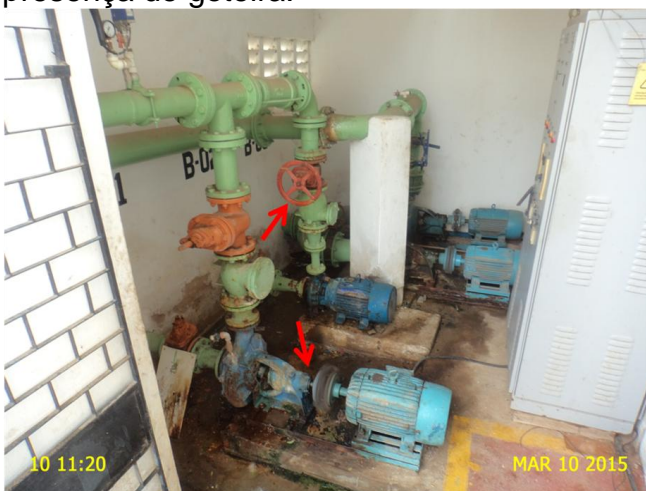
Foto 11 – EEAT-02: bombas com problemas na gaxeta e no registro.
