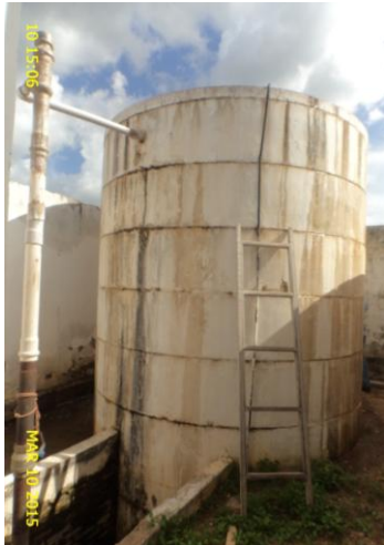
Foto 31 – RAP-03: escada de acesso inadequada e pintura deteriorada.
