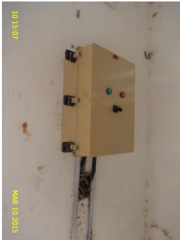
Foto 1 – EEAT-03: quadro de comando sem horímetro.
