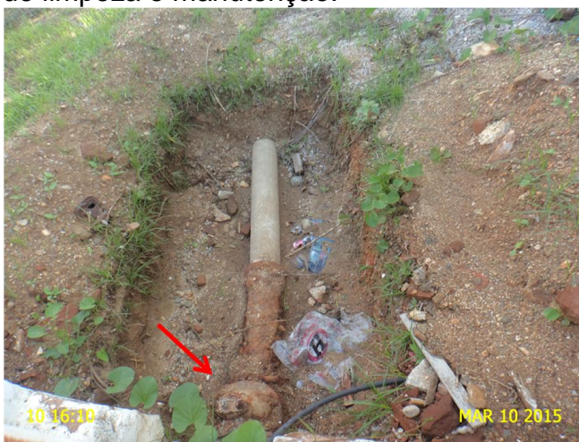
Foto 23 – REL-01: registro sem caixa de inspeção.
