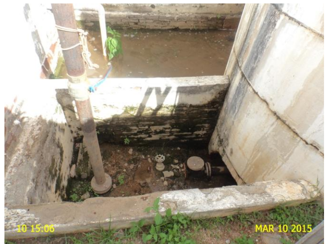
Foto 22 – RAP-03: caixa de inspeção sem tampa ou grade de proteção.
