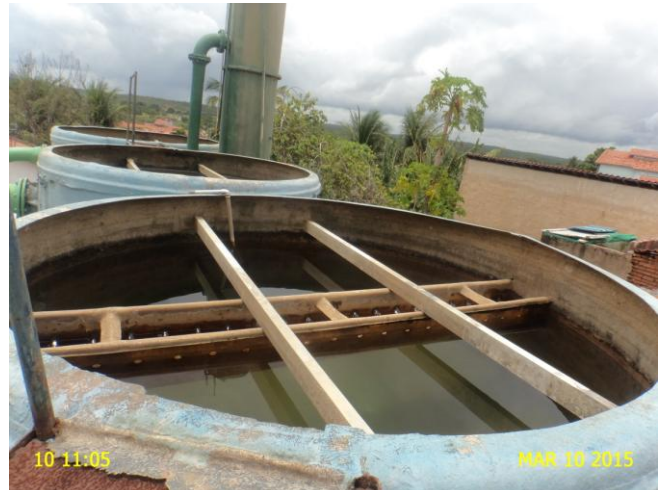
Foto 2 – ETA: filtros F-01, F-02 e F-03 sem tampa.
