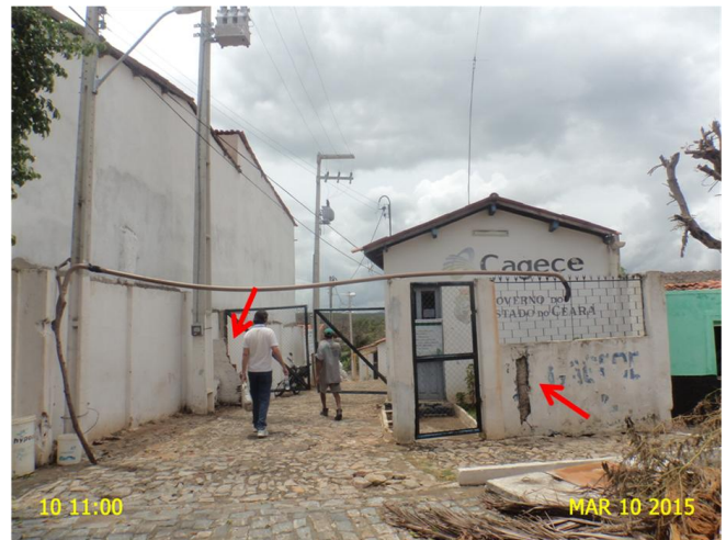
Foto 16 – ETA: estrutura deteriorada.
