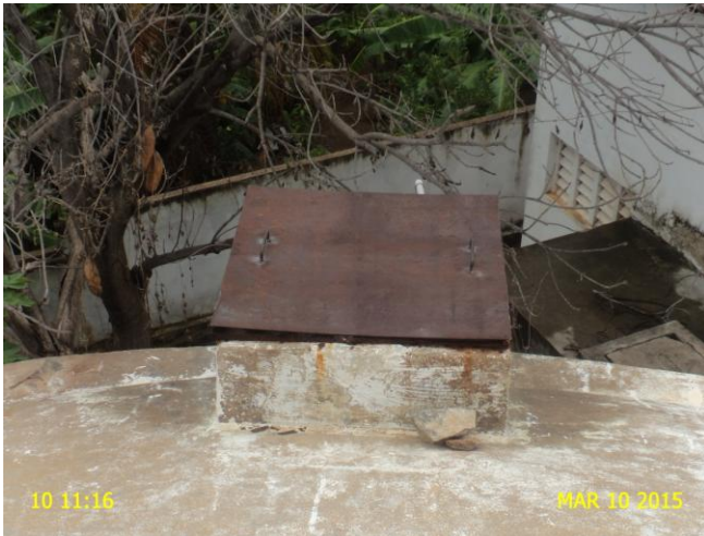
Foto 25 – RSE-01: tampa em processo de corrosão e sem a adequada vedação.
