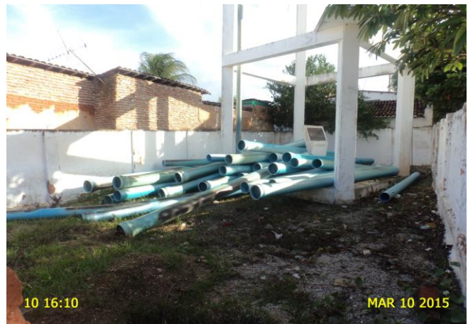
Foto 20 – REL-01: inadequadas condições de limpeza e manutenção.
