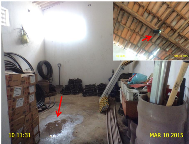
Foto 9 – Almoxarifado: sem luz e com a presença de goteira.
