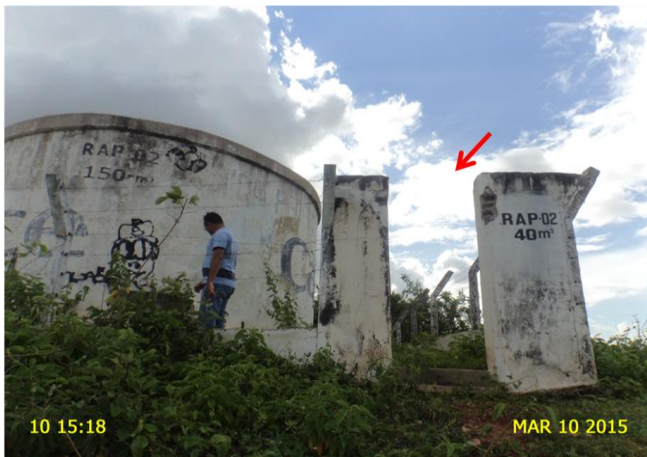
Foto 19 – RAP-02: inadequadas condições de limpeza e manutenção, pintura e estrutura deterioradas.
