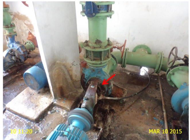
Foto 10 – EEAT-01: bomba com problema na gaxeta.
