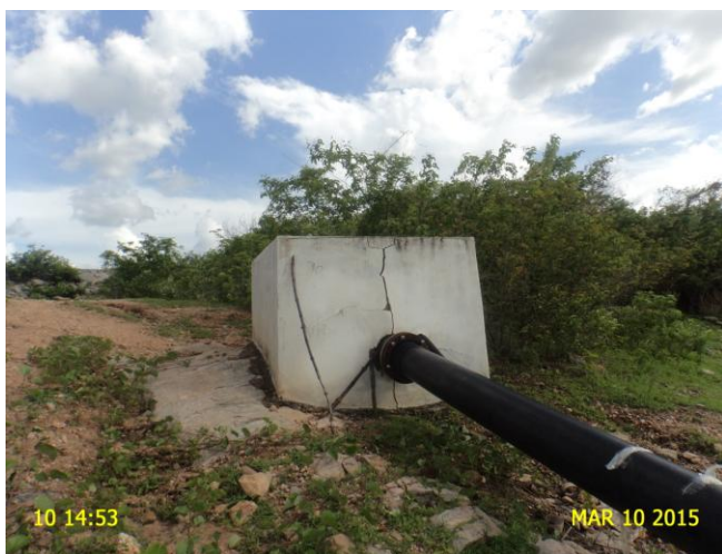
Foto 5 – Captação Superficial: caixa de inspeção da adutora de água bruta com estrutura danificada.
