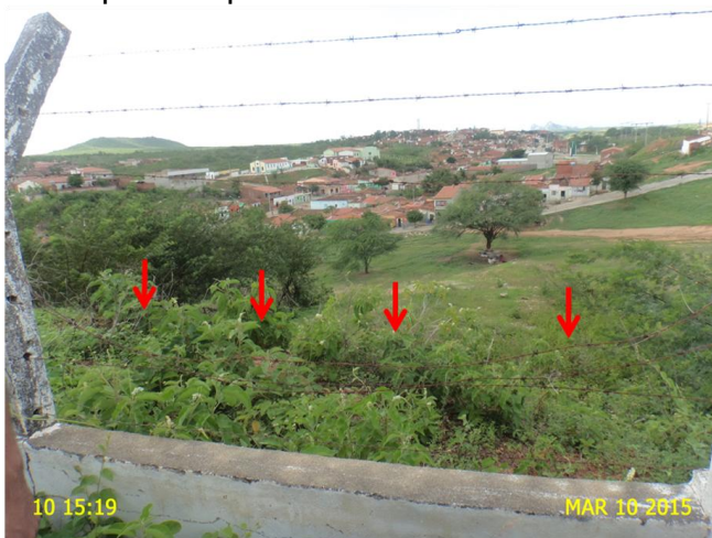
Foto 29 – RAP-02: cerca de proteção danificada.
