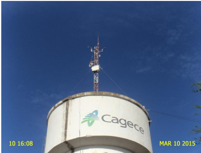
Foto 3 – REL-01: ausência de para-raios e guarda-corpo na laje de cobertura.
