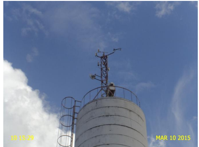
Foto 4 – REL-02: ausência de sinalizador noturno.
