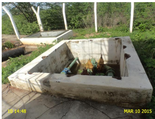
Foto 6 – Captação Superficial: caixa de inspeção da adutora de água bruta sem tampa ou grade de proteção.
