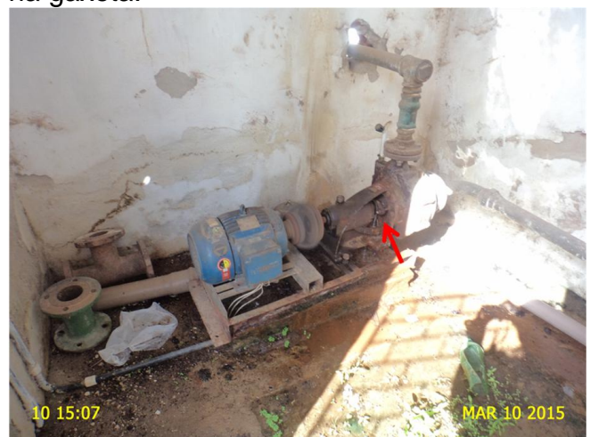
Foto 12 – EEAT-03: bomba com problema na gaxeta.
