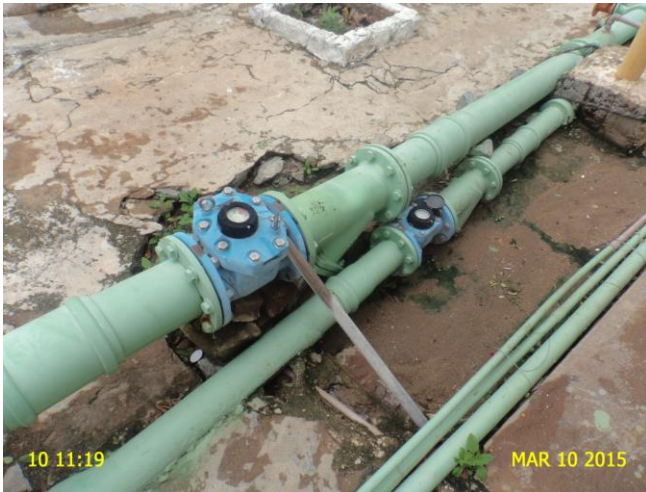
Foto 7 – Adutora de água tratada: macromedidor sem caixa de proteção na saída da ETA.
