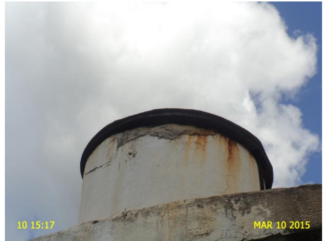
Foto 26 – RAP-02: tampa em processo de corrosão.
