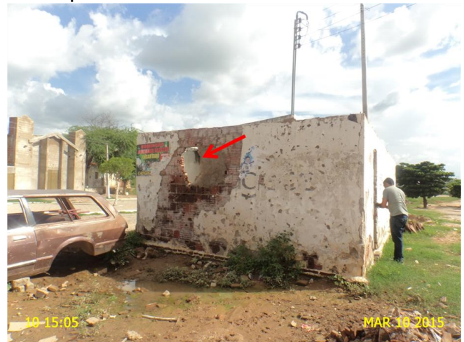
Foto 30 – RAP-03: estrutura deteriorada.
