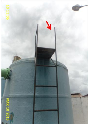
Foto 15 – F-01: escada de acesso com haste de apoio danificada.
