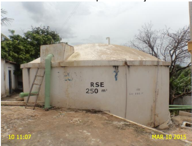
Foto 27 – RSE-01: escada de acesso inadequada e pintura deteriorada.
