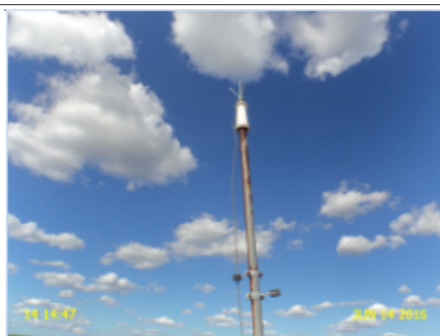
Foto 02 - REL-03: ausência de sinalizador noturno.
