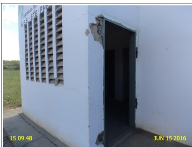
Foto 05 - EEE-01: estrutura da casa de abrigo deteriorada, com rachaduras.
