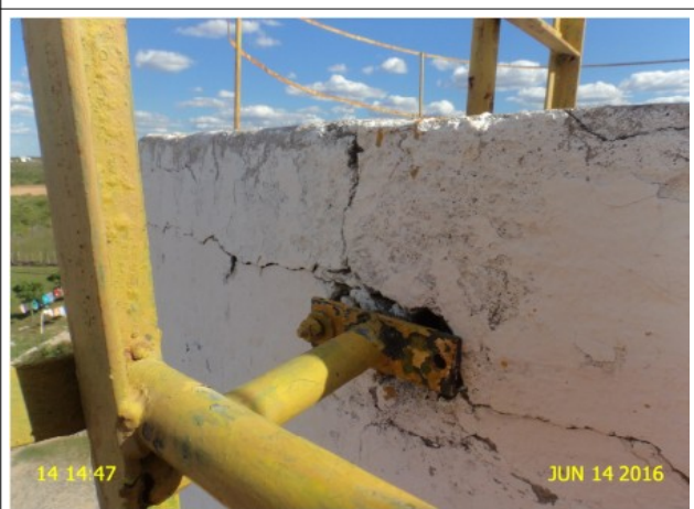
Foto 08 - REL-03: apresenta rachaduras na estrutura.
