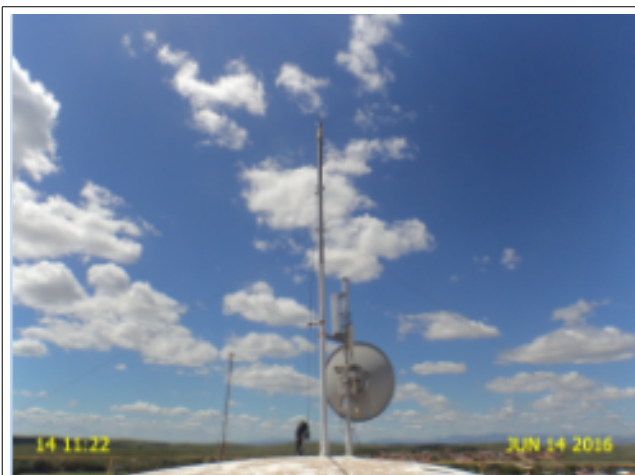
Foto 01 - REL-01: ausência de sinalizador noturno.
