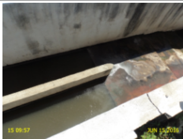
Foto 13 - ETE: caixa de areia deteriorada.
