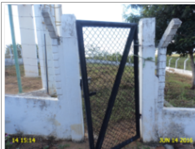
Foto 03 - REL-02: portão danificado.
