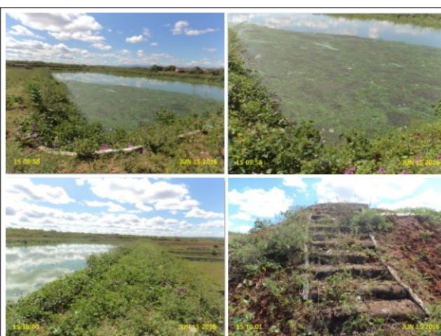
Foto 06 - ETE: taludes cobertos por vegetação, acúmulo de sobrenadantes e escada deteriorada.
