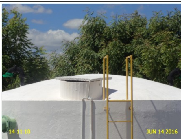
Foto 10 - RAP-02: tampa inadequada.
