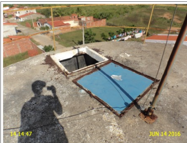
Foto 09 - REL-03: tampa inadequada, em processo de corrosão.
