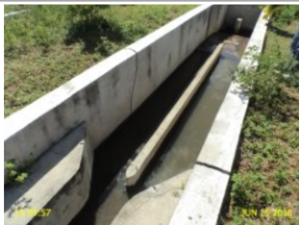
Foto 14 - ETE: caixa de areia deteriorada.
