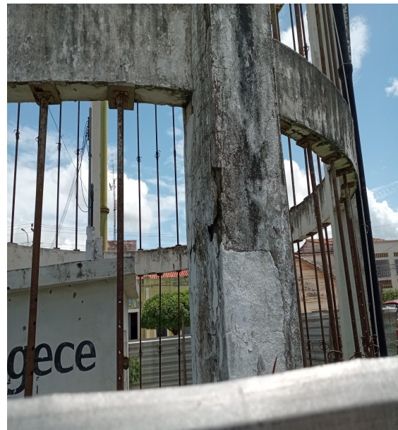
Foto 20 - REL-01: Escoramento e estrutura deteriorada.
