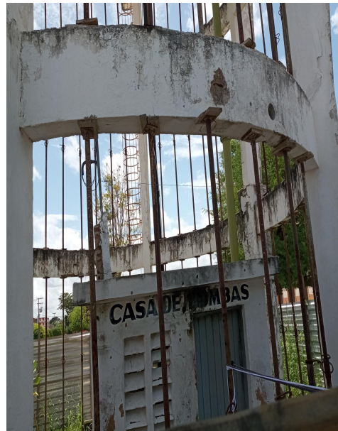
Foto 22 - REL-01: Escoramento e estrutura deteriorada.
