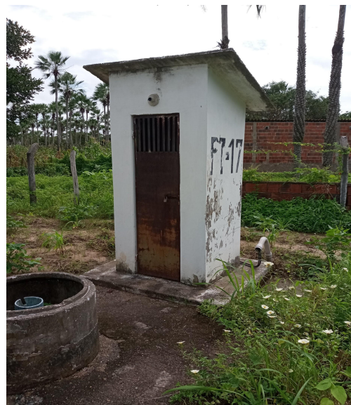
Foto 4 - PT-17: Ausência de lâmpada.
