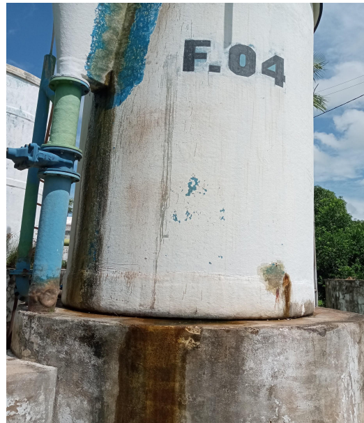
Foto 10 - ETA F-04: Vazamento na base.
