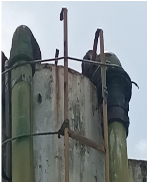
Foto 17 - ETA: Torre de equilíbrio com escada corroída.
