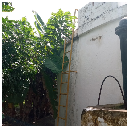
Foto 28 - RAP-01: Escada sem gaiola de proteção.
