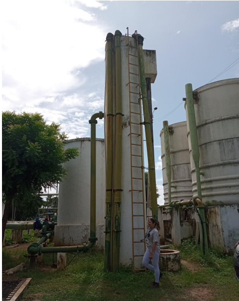
Foto 1 - ETA: Torre de equilíbrio com escada sem proteção.
