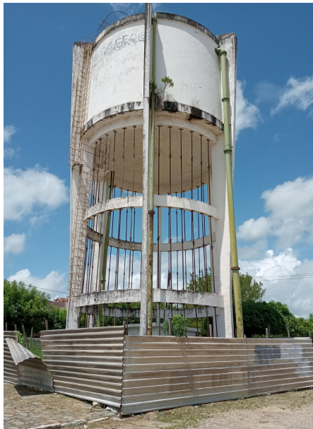
Foto 21 - REL-01: Escoramento e estrutura deteriorada.
