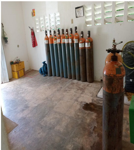
Foto 19 - ETA: Kit de emergência em local indevido.
