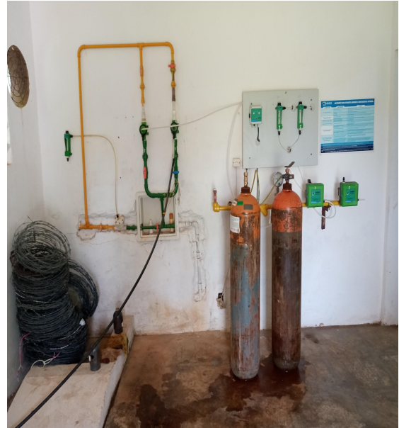
Foto 2 - ETA: Instalações de cloração..
