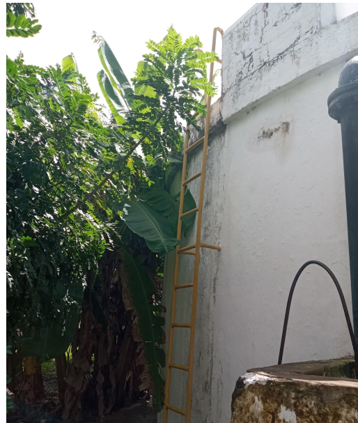
Foto 18 - RAP-01: Escada corroída.
