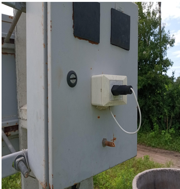
Foto 5 - PT-16: Ausência de abrigo.
