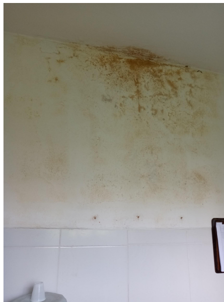
Foto 14 - ETA: Infiltração devido ao vazamento da caixa d'água.
