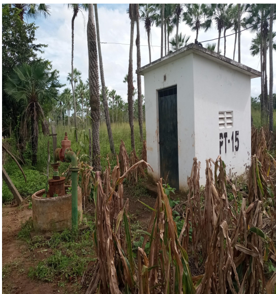
Foto 3 - PT-15: Ausência de lâmpada.
