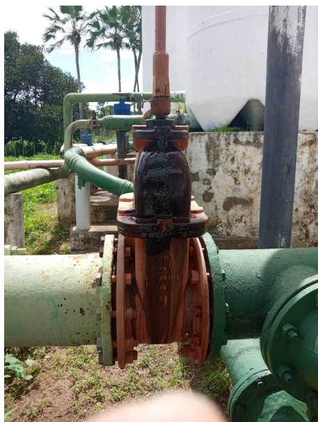
Foto 7 - ETA F-02: Vazamento do registro.
