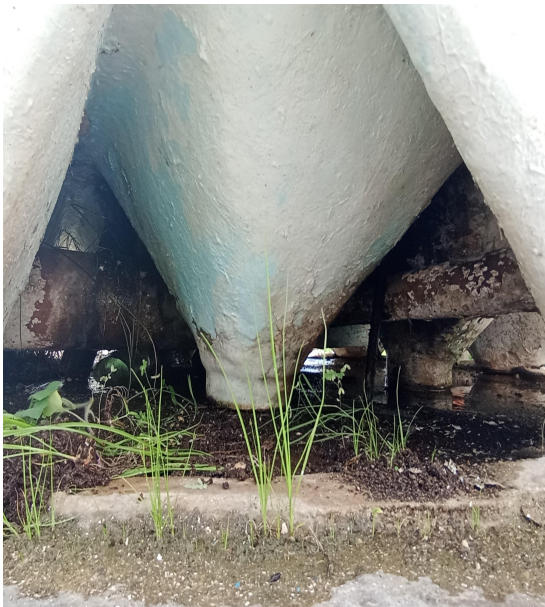
Foto 9 - ETA F-03: Vazamento na base.
