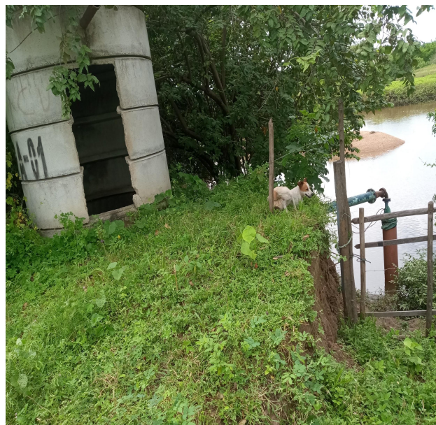
Foto 16 - PT-20: Tubulação com registro sem proteção contra acesso de estranhos.
