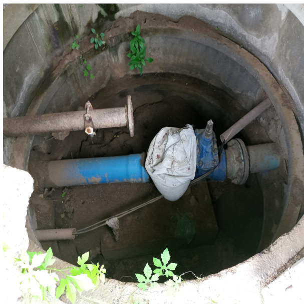
Foto 15 - PT-20: Tubulação com registro sem proteção contra acesso de estranhos.
