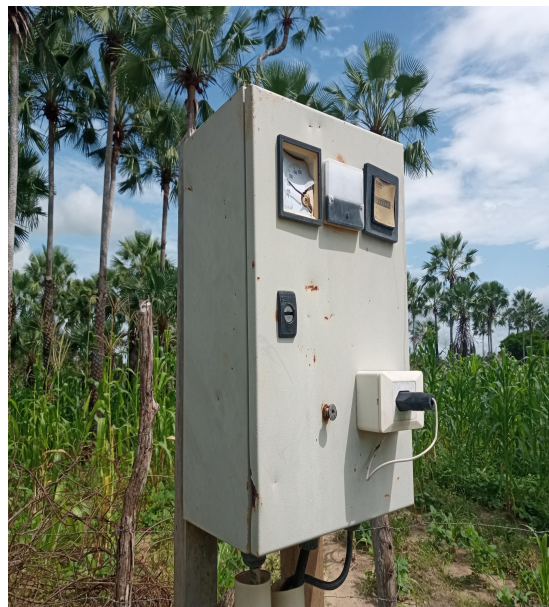
Foto 6 - PT-19: Ausência de abrigo.
