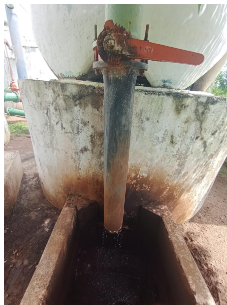
Foto 8 - ETA F-03: Vazamento do registro.
