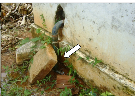
Foto 33 – Tubulação com vazamento na EERD-01.
