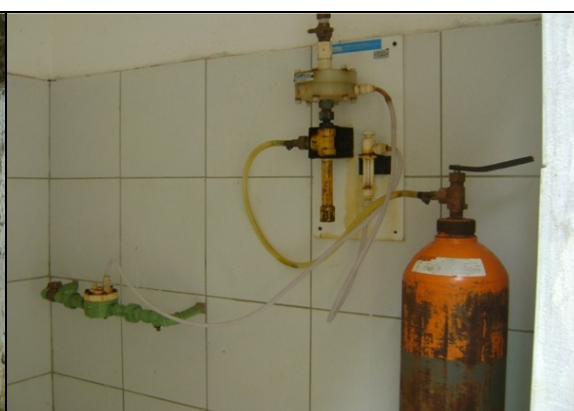
Foto 14 – Dosador de cloro gasoso.
