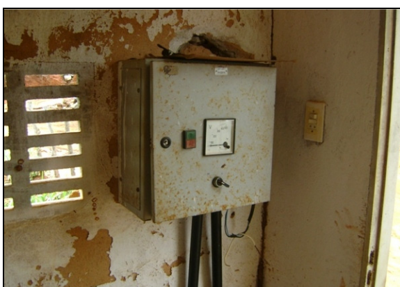
Foto 44 – Quadro de comando da EERD-05.
