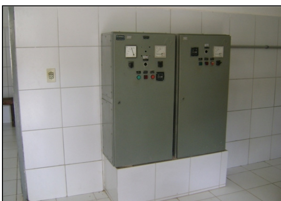
Foto 28 – Quadros de comando das EELF-01 e EEAT-01.
