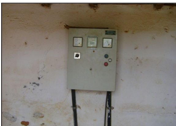
Foto 35 – Quadro de comando da EERD-02.
