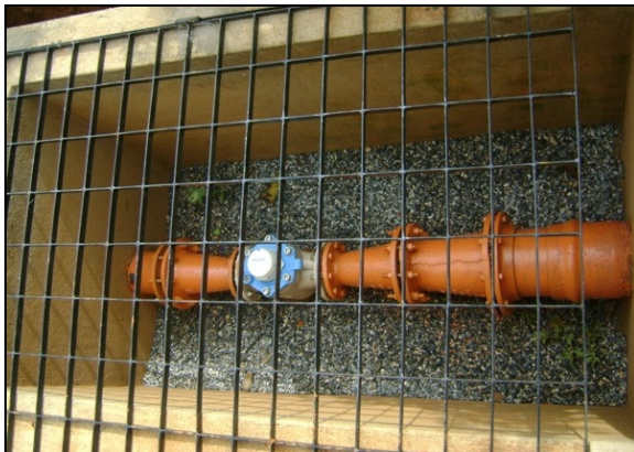
Foto 62 – Macromedidor na saída da captação.
