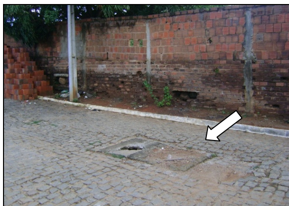
Foto 69 – Registro de descarga na Rua Francisco Brandão, Centro.
