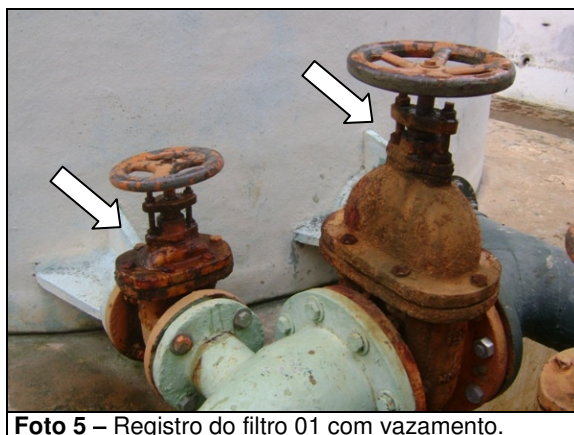
Foto 5 – Registro do filtro 01 com vazamento.
