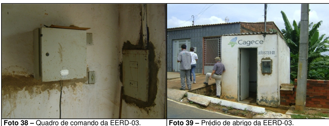
Foto 38 – Quadro de comando da EERD-03.
