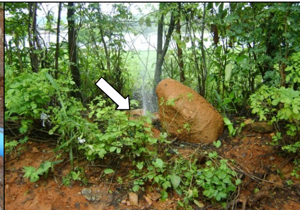
Foto 61 – Vazamento na adutora de água bruta.
