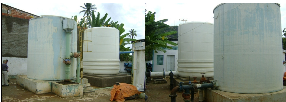
Fotos 3 e 4 – Vistas dos filtros.
