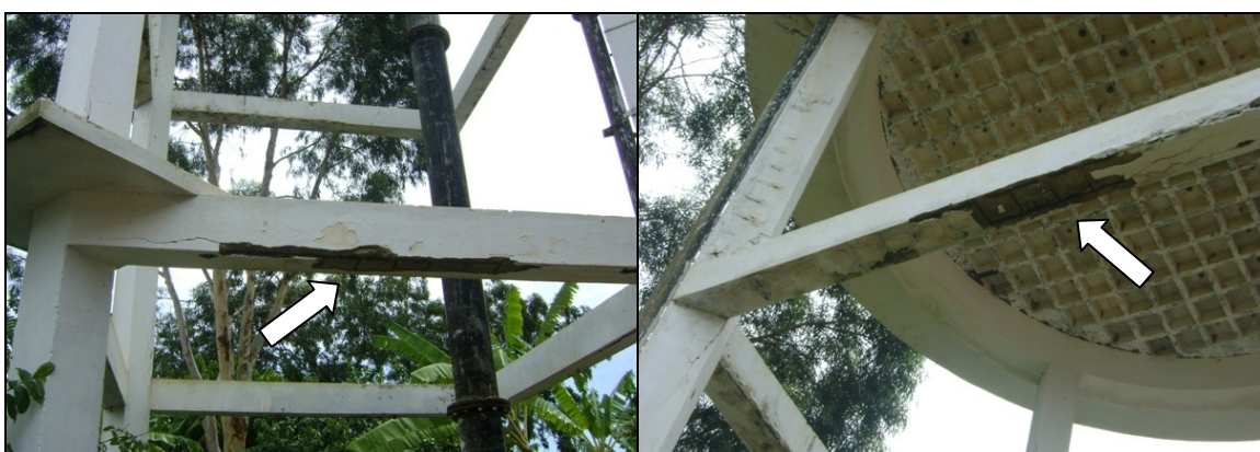
Fotos 51 e 52 – Armadura exposta do REL-01.
