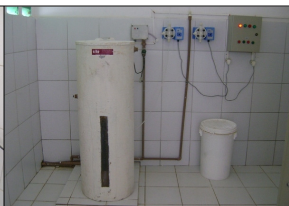
Foto 8 – Dosador de flúor.
