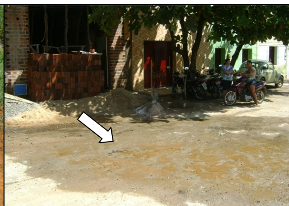
Foto 66 – Vazamento na rede de distribuição na Rua Coronel Porto, Centro.
