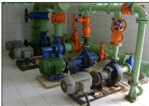
Foto 27 – Elevatórias EELF-01 e EEAT-01.
