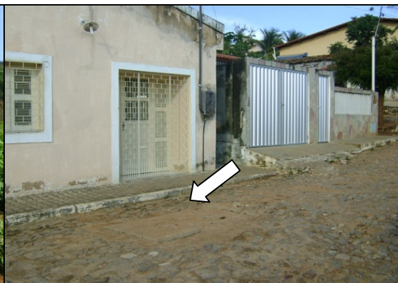
Foto 68 – Registro de descarga na Tv. Benevenuto Cavalcante, Centro.
