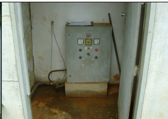
Foto 25 – Quadro de comando da EECS-01.
