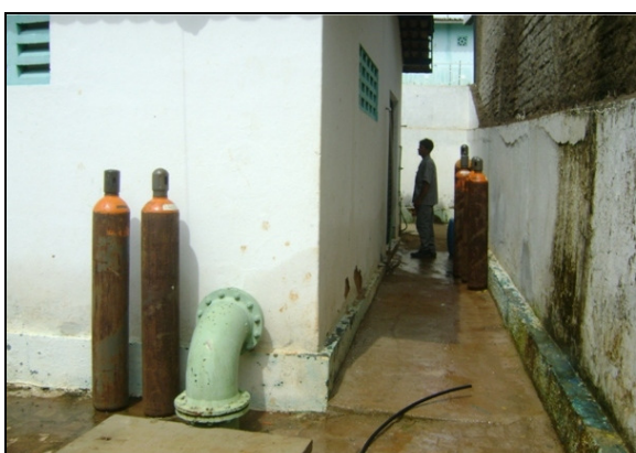
Foto 13 – Cilindros de cloro gasoso.
