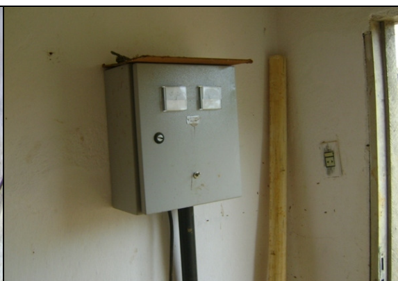
Foto 31 – Quadro de comando da EERD-01.
