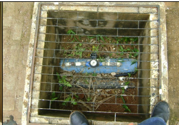
Foto 63 – Medidor proporcional na entrada da ETA.
