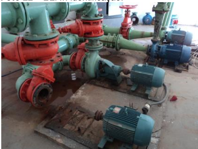
Foto 24 – EEAT: conjunto moto-bomba.
