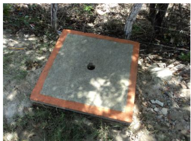
Foto 38 – Rede de distribuição: registro de descarga na Rua Jaca Paraíba (2).
