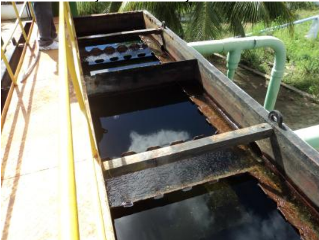
Foto 6 – Filtração: vista superior - ausência de tampas.
