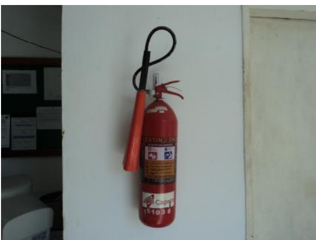
Foto 56 – Loja de Atendimento: extintor de incêndio dentro do prazo de validade.
