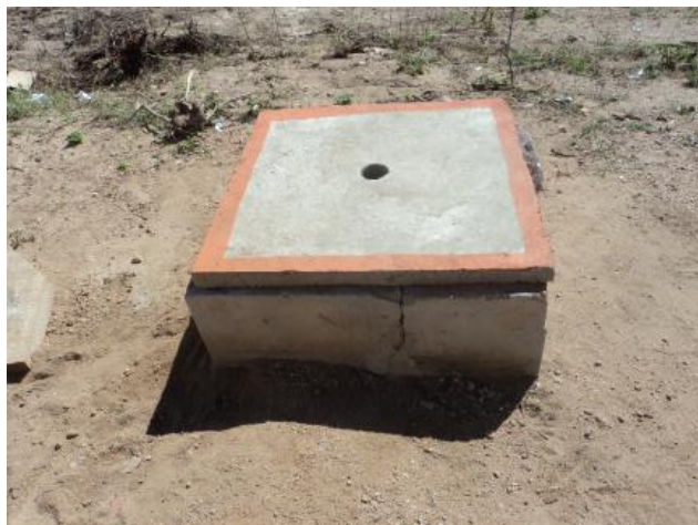
Foto 40 – Rede de distribuição: registro de descarga na Rua SDO-23.
