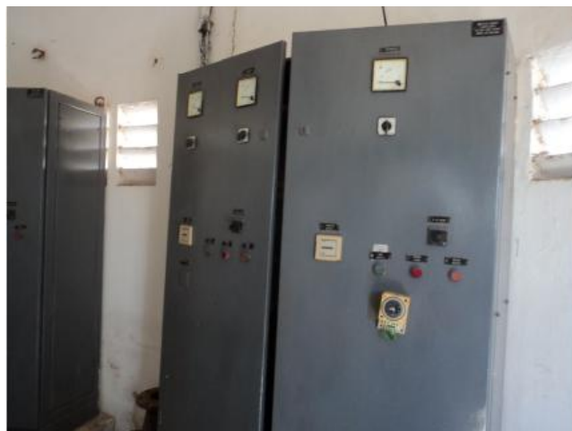
Foto 23 – EEAT: quadro de comando.
