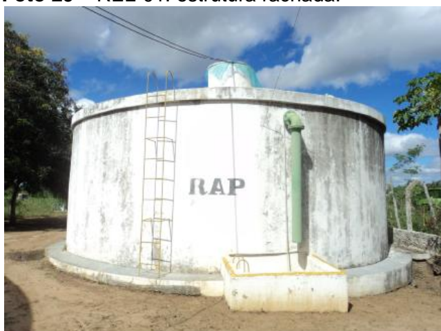
Foto 31 – RAP-01: pintura deteriorada.
