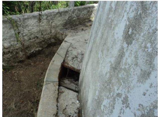
Foto 34 – RAP-01: estrutura deteriorada na base do reservatório.
