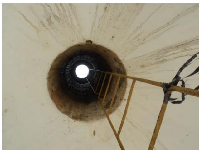
Foto 26 – REL-01: ausência de tampa de inspeção.
