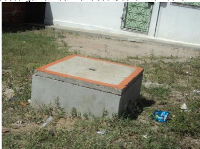
Foto 41 – Rede de distribuição: registro de descarga na Rua Antonio Teixeira Barros.
