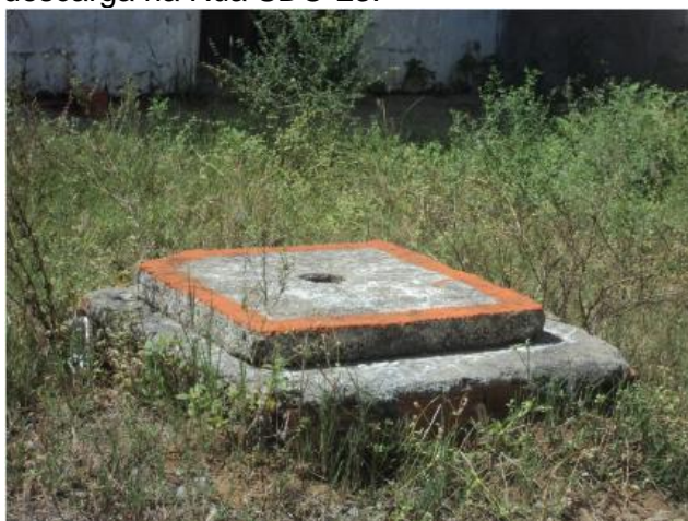
Foto 42 – Rede de distribuição: registro de descarga na Rua Frederico Pontes.
