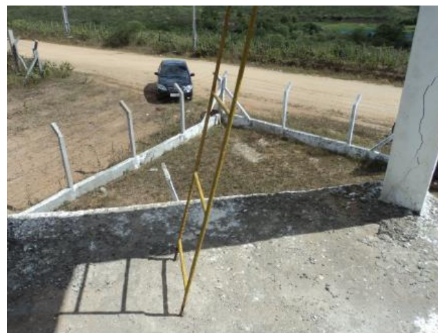
Foto 30 – REL-01: escada solta.
