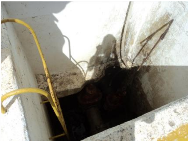
Foto 35 – RAP-01: registro sem grade na caixa de proteção.
