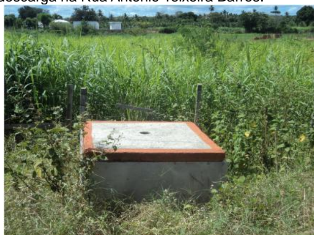
Foto 43 – Rede de distribuição: registro de descarga na Rua 25 de Janeiro.
