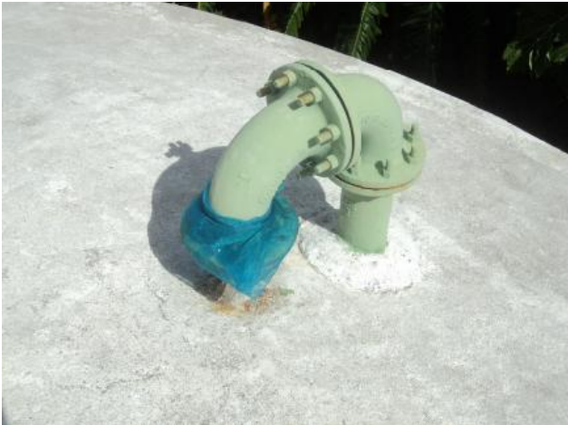
Foto 33 – RAP-01: tubulação de ventilação com teia de proteção.
