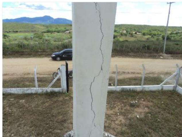
Foto 28 – REL-01: estrutura rachada.
