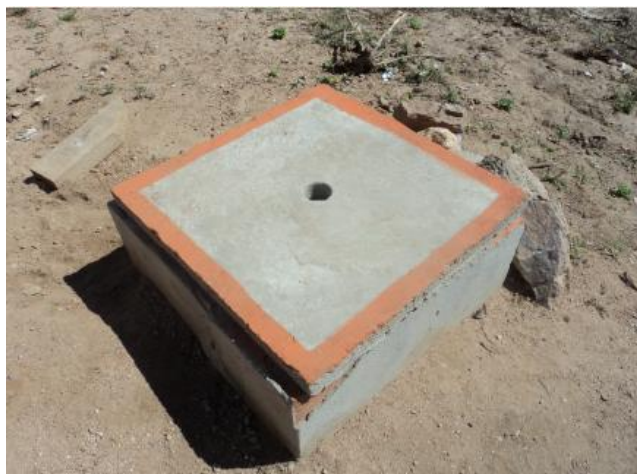
Foto 39 – Rede de distribuição: registro de descarga na Rua Francisco Océlio Pitombeira.
