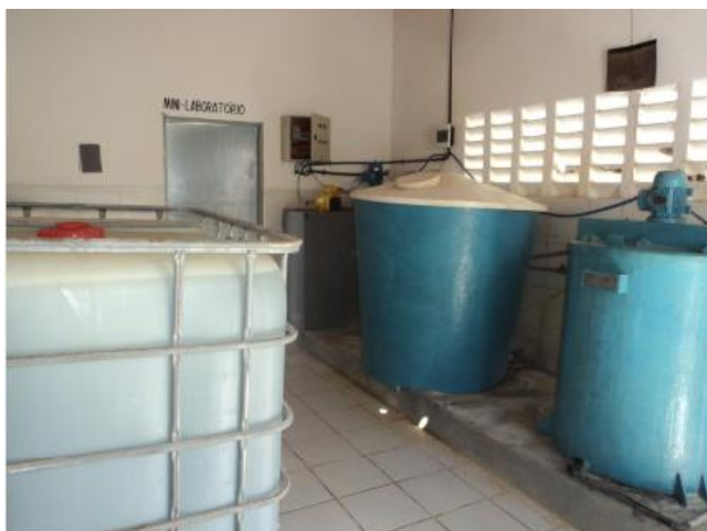
Foto 12 – Casa de química: tanques de dosagem e bombas dosadoras.
