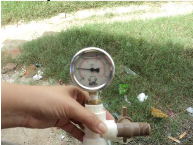
Foto 49 – Medição instantânea de pressão na Rua José Roberto, 35.
