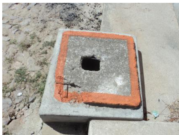
Foto 37 – Rede de distribuição: registro de descarga na Rua Jaca Paraíba (1).
