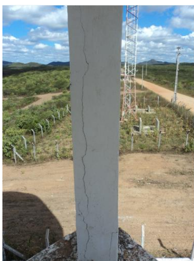
Foto 29 – REL-01: estrutura rachada.
