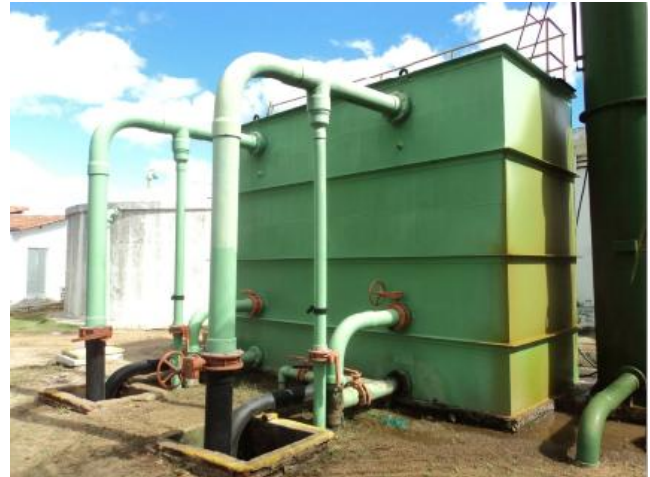
Foto 5 – Filtração: filtros F-02 e F-01.
