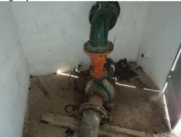
Foto 3 – PA: conjunto moto-bomba.
