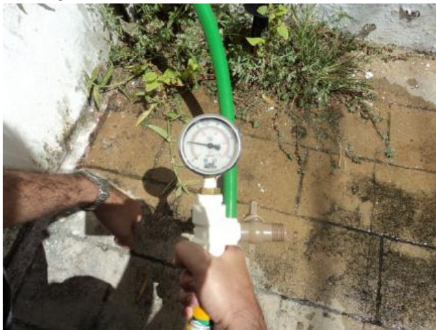
Foto 47 – Medição instantânea de pressão na Rua 15 de agosto, 43.
