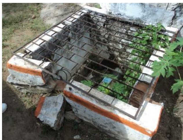
Foto 21 – ETA: medidor com caixa de proteção deteriorada.
