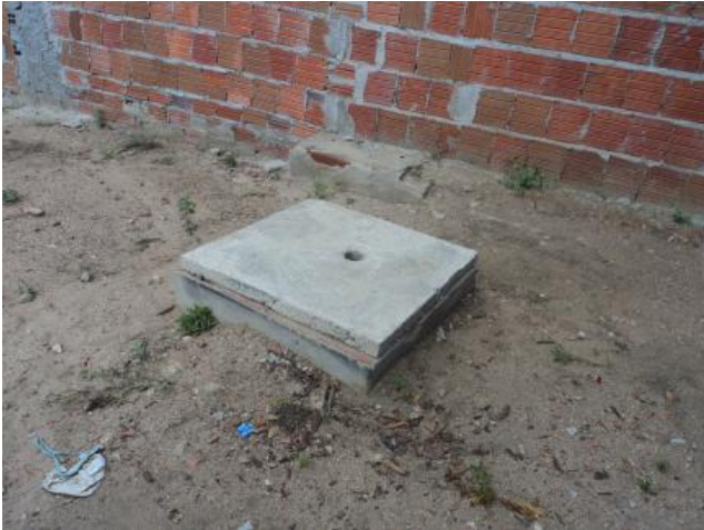
Foto 45 – Rede de distribuição: registro de descarga na Rua Isaac de Castro.
