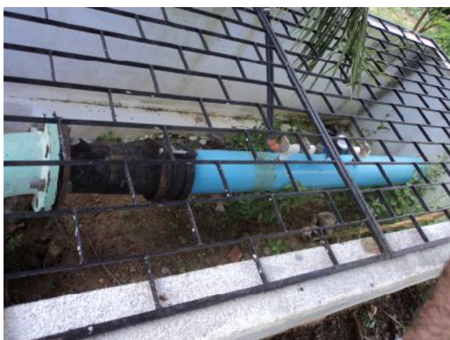
Foto 20 – ETA: medidor proporcional com caixa e grade de proteção.
