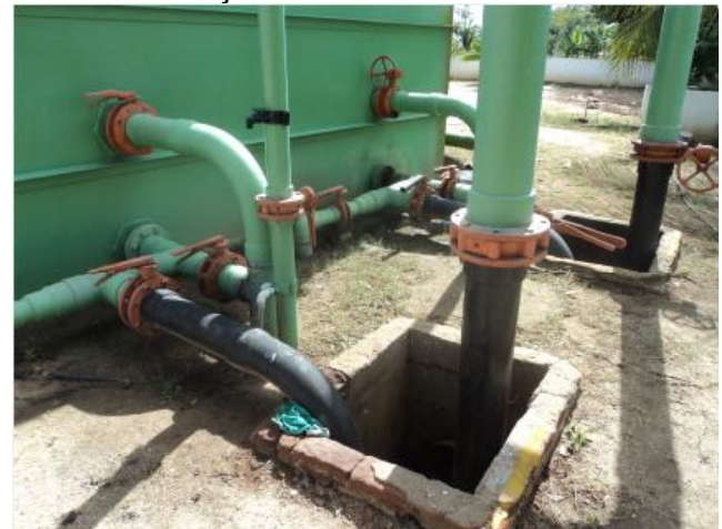
Foto 7 – Filtração: tubulações e registros.
