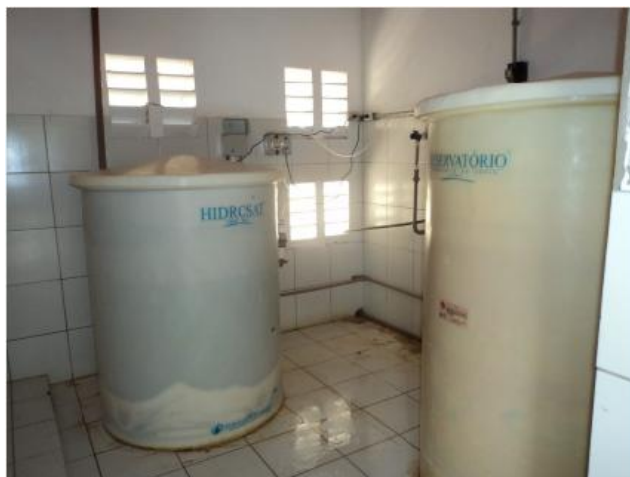
Foto 11 – Casa de química: produção de hipoclorito de sódio.
