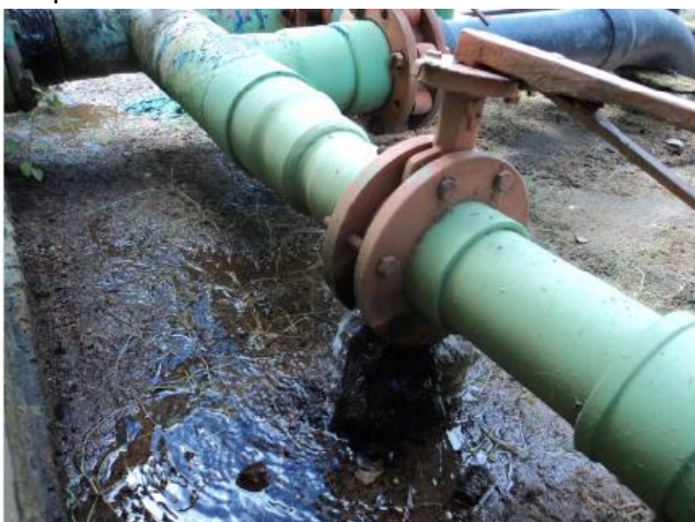
Foto 8 – Filtração: vazamento na tubulação.
