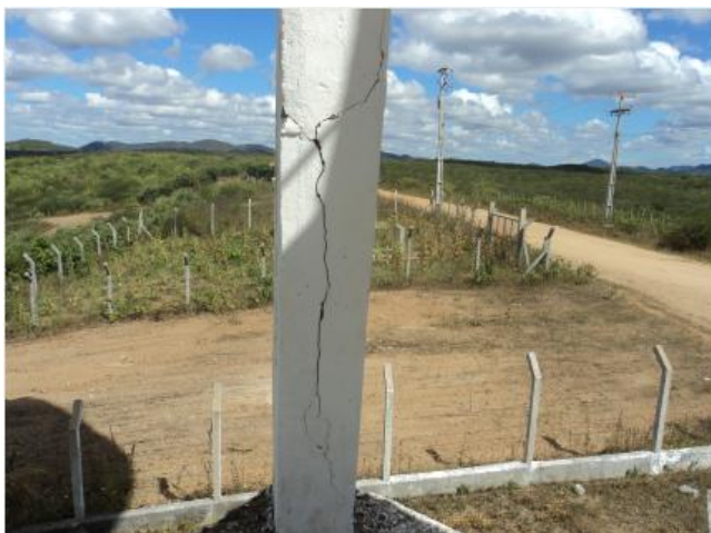
Foto 27 – REL-01: estrutura rachada.
