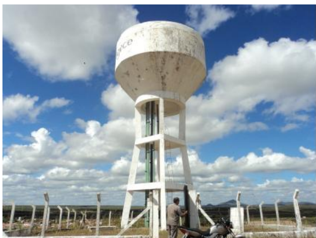
Foto 25 – REL-01: ausência de identificação.
