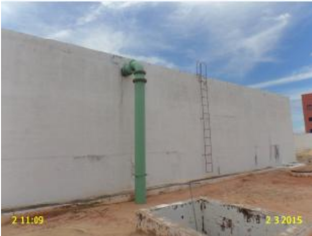
Foto 3 – RAP-Icaraí I: escada sem guarda-corpos e identificação.
