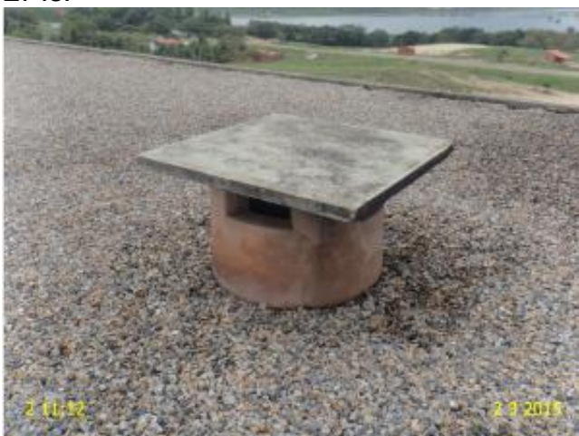
Foto 14 – RAP-Icaraí I: tubulação de ventilação sem tela de proteção.
