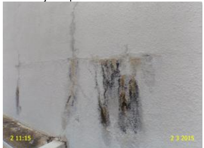
Foto 21 – RAP-Icaraí I: sinais de vazamento.
