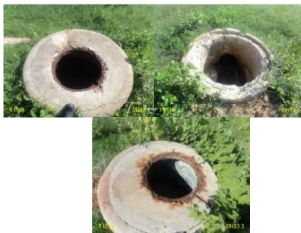
Foto 13 – ETE-Marechal Rondon: aberturas de inspeção sem tampa.
