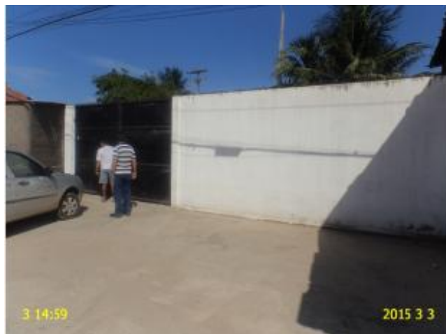
Foto 7 – EEE-Rondon II: ausência de identificação.
