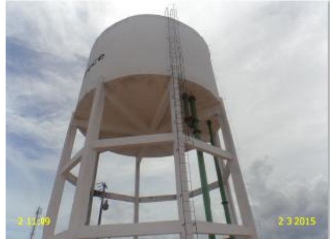
Foto 4 – REL-Icaraí I: ausência de guarda-corpo na laje de cobertura e em parte da escada.
