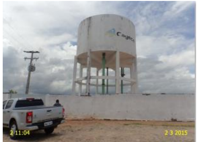
Foto 19 – REL-Icaraí I: ausência de identificação e pintura deteriorada.
