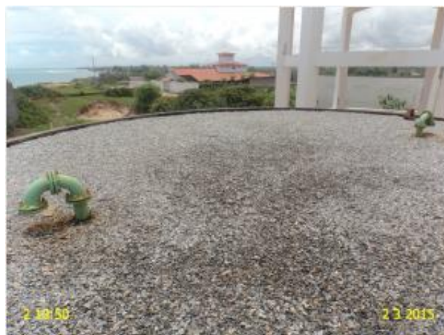
Foto 15 – RAP-Icaraí II: tubulação de ventilação sem tela de proteção.
