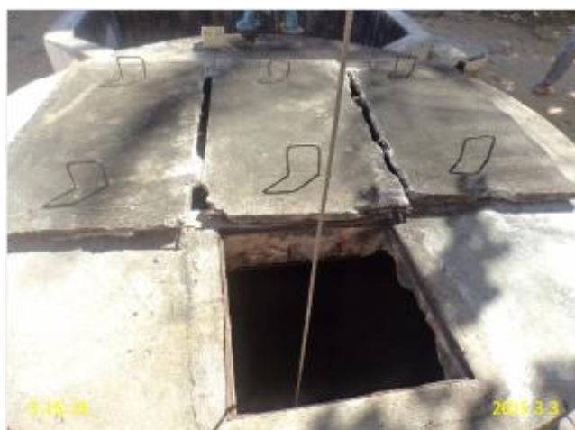
Foto 11 – EEE-Rondon III: ausência de tampa.
