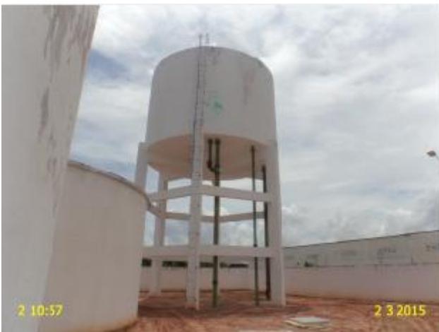
Foto 5 – REL-Icaraí II: ausência de para-raios e sinalização noturna, e de guarda-corpo na laje de cobertura e em parte da escada.
