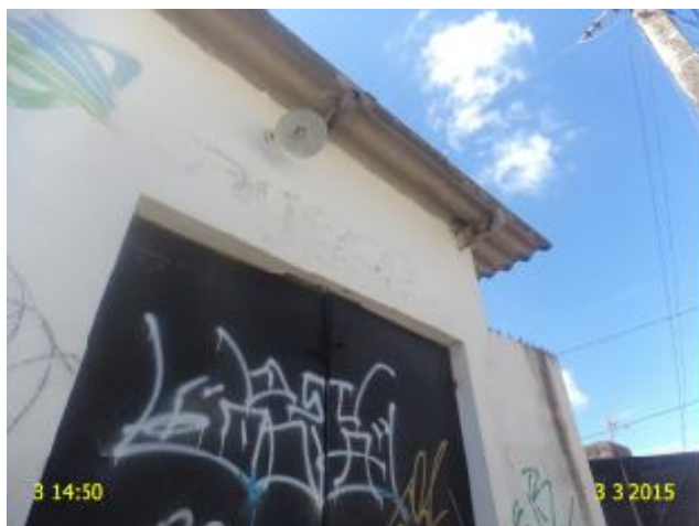
Foto 6 – EEE-Rondon I: ausência de identificação..
