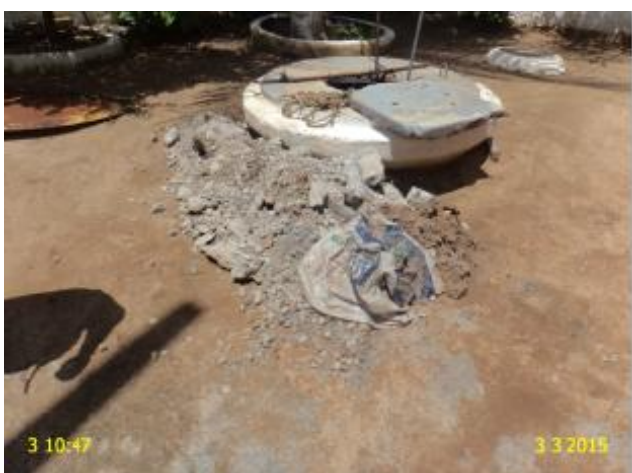
Foto 1 – EEE-06: acúmulo de areia.
