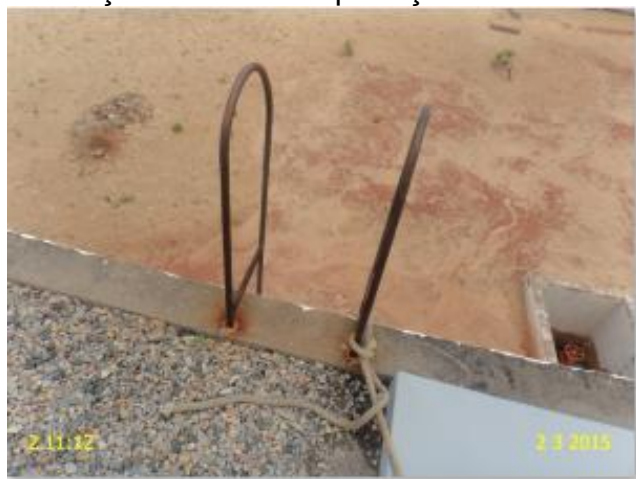
Foto 17 – RAP-Icaraí I: escada em processo de corrosão.
