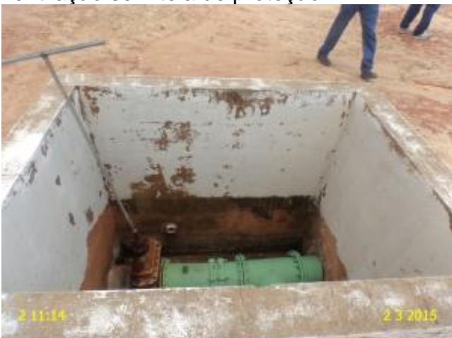
Foto 16 – RAP-Icaraí I: caixa sem tampa ou grade de proteção.
