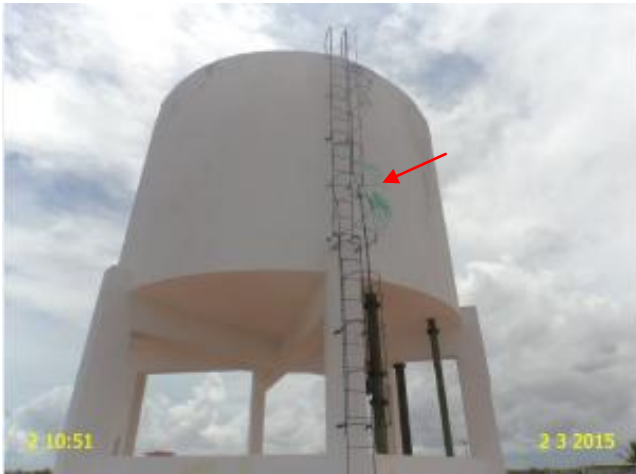
Foto 18 – REL-Icaraí II: guarda-corpos deteriorado e ausência de identificação.
