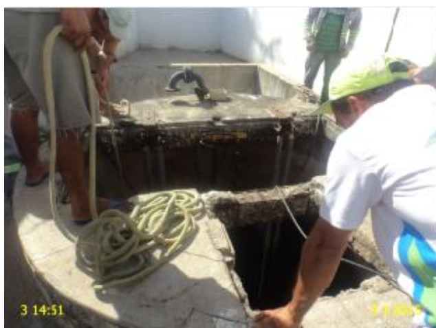
Foto 10 – EEE-Rondon I: ausência de tampas.
