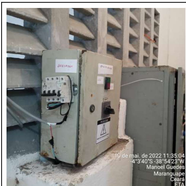
Foto 3 - Acionamento manual da bomba de drenagem.
