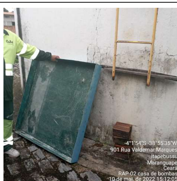
Foto 12 - RAP-02: tampa do reservatório fora do lugar.
