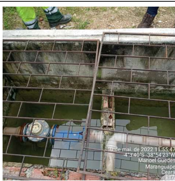
Foto 6 - ETA: caixa de proteção com água acumulada.
