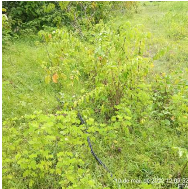
Foto 1 - Captação: instalação elétrica sem proteção ou isolamento da área.
