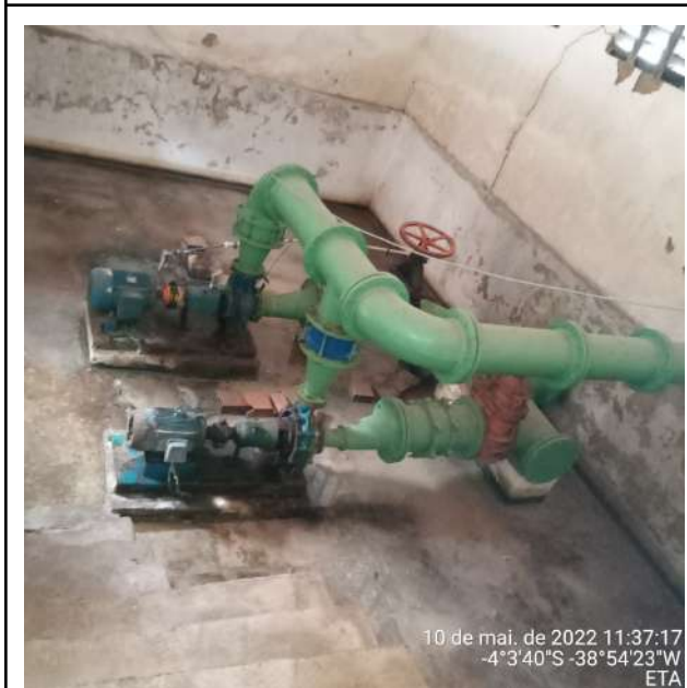
Foto 5 - ETA: casa de bombas inundada
