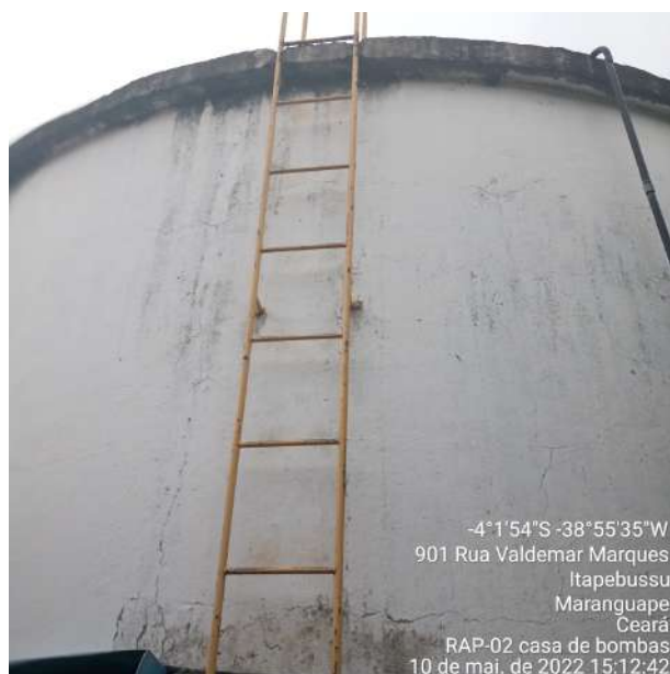
Foto 20 - RAP-02: escada sem gaiola de proteção.
