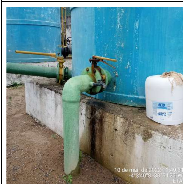
Foto 9 - ETA (Filtro): vazamento
