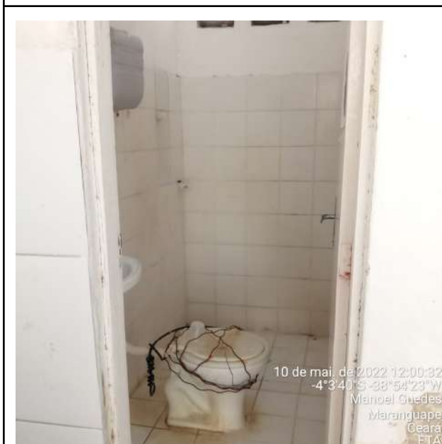
Foto 13 - ETA: banheiro interditado.
