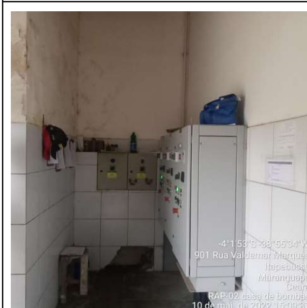
Foto 17 - RAP-02: material armazenado sobre os quadros de bombas.
