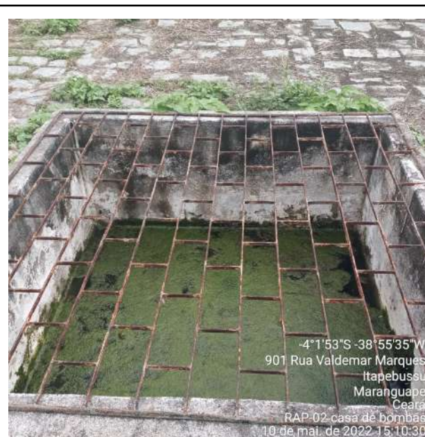
Foto 8 - RAP-02: caixa de proteção com água acumulada.
