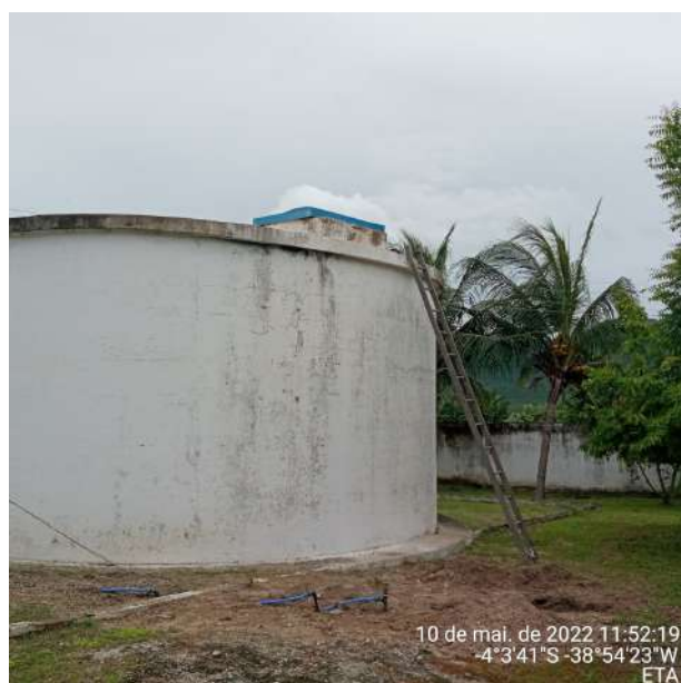
Foto 19 - RAP-01: ausência de escada sem gaiola de proteção.
