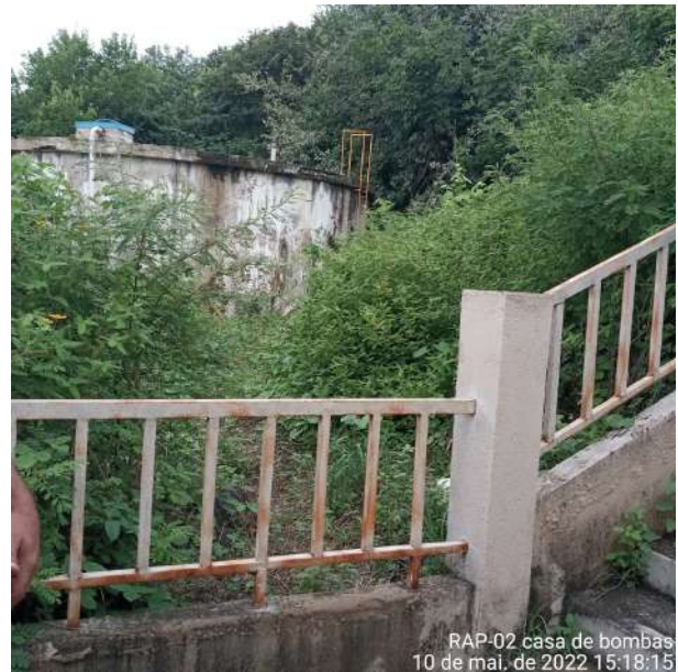
Foto 2 - RAP-03: ausência de acesso e proteção ou isolamento da área.
