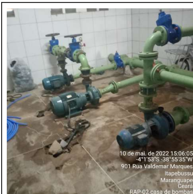
Foto 15 - RAP-02: piso danificado, instalações elétricas expostas e água acumulada na casa de bombas.
