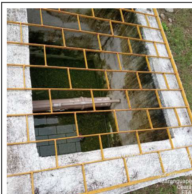
Foto 7 - ETA: caixa de proteção com água acumulada.
