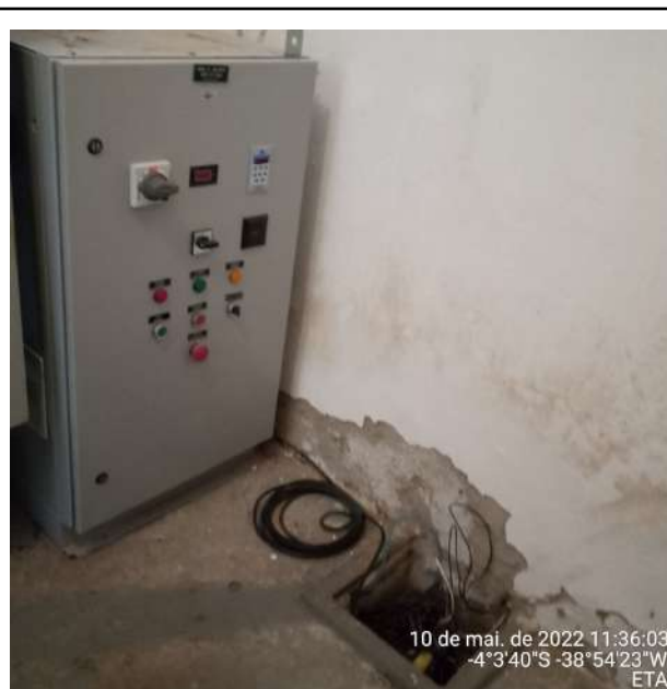
Foto 4 - Quadro de comando: Instalações elétricas inadequadas e caixa sem tampa.
