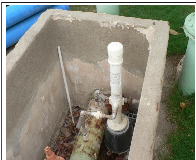
Foto 03 – Dosador para reforço do cloro.
