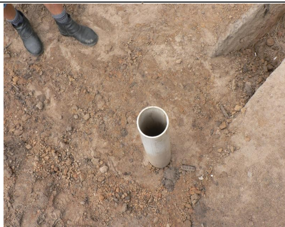
Foto 05 – Registro de descarga localizada na rua SDO 27, sem caixa de inspeção.
