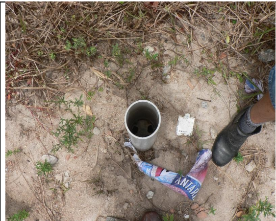
Foto 04 – Registro de descarga localizada na CE354, sem caixa de inspeção.
