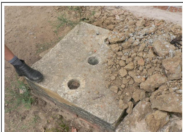
Foto 06 – Registro de descarga localizada na rua Mestre Zé, com caixa de inspeção.
