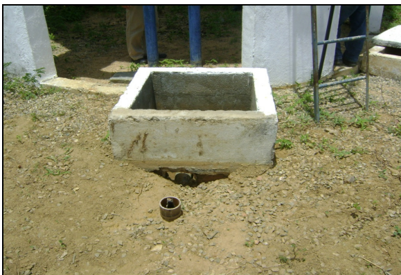
Foto 35 – REL-03 – caixa sem tampa.
