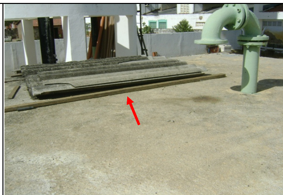
Foto 20 – RAP-01 – tampa de inspeção.
