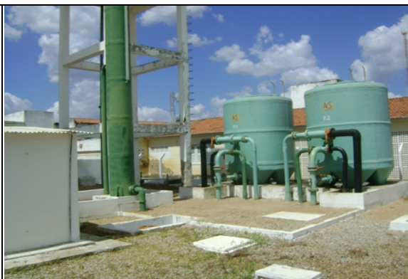
Foto 9 – Identificação dos filtros.
