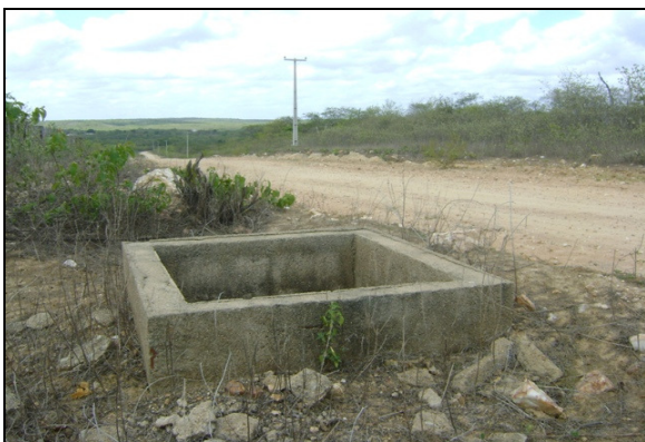
Foto 41 – Caixa de proteção de registro de descarga na AAB.
