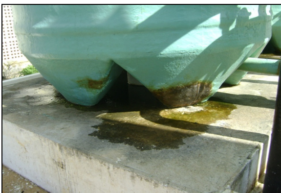
Foto 12 – Vazamento no filtro 01.
