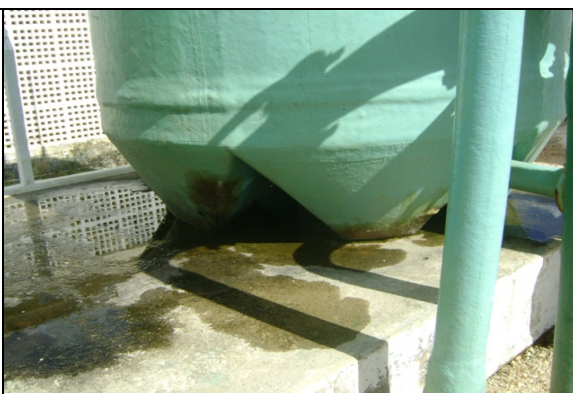
Foto 13 – Vazamento no filtro 02.
