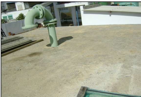
Foto 19 – RAP-01 – tubulação de ventilação.
