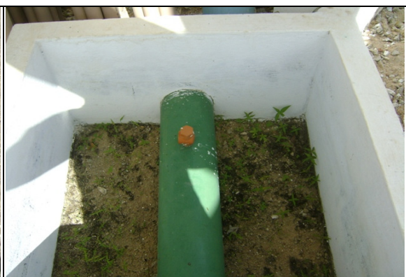
Foto 44 – Caixa de proteção da estação pitométrica - AAB.
