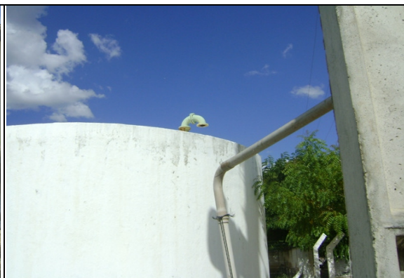
Foto 22 – RAP-02 – tubulação de ventilação.
