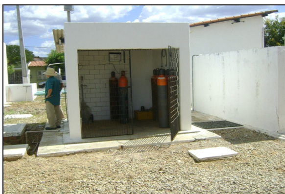
Foto 14 – Sistema de cloro gasoso.
