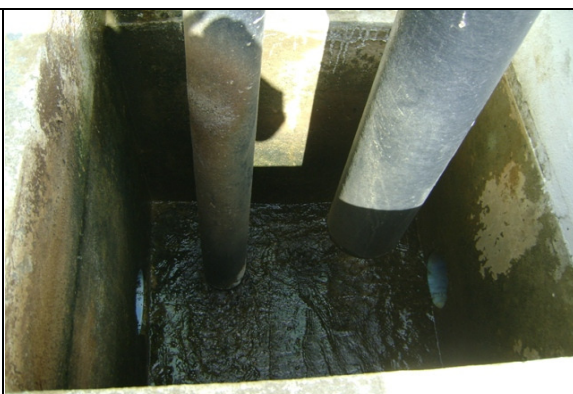
Foto 11 – Registro de descarga sem vedação.
