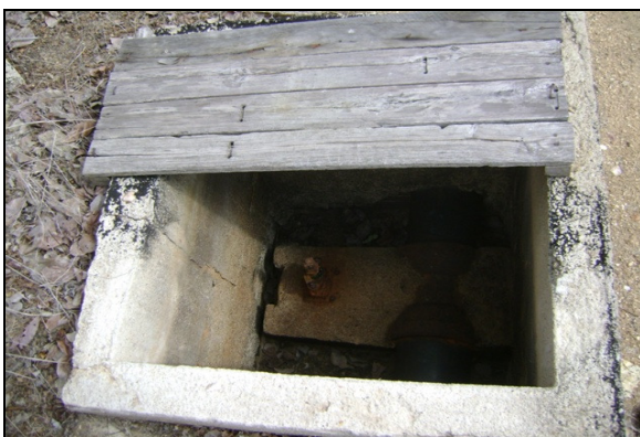
Foto 43 – Caixa de proteção de registro de descarga na AAB – indício de utilização.
