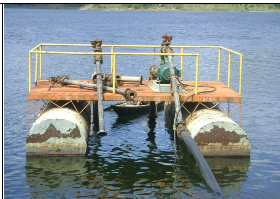
Foto 2 – Conjunto motor-bomba no flutuante.
