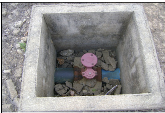
Foto 42 – Caixa de proteção de ventosa na AAB.
