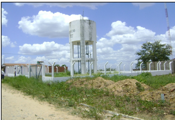
Foto 33 – REL-03 – sem guarda corpo.
