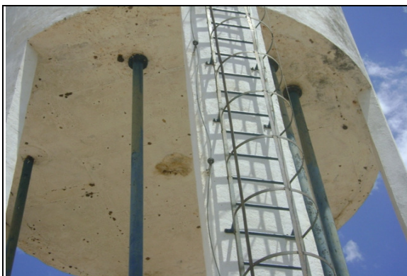
Foto 29 – REL-02 – laje inferior danificada, pontos de corrosão.
