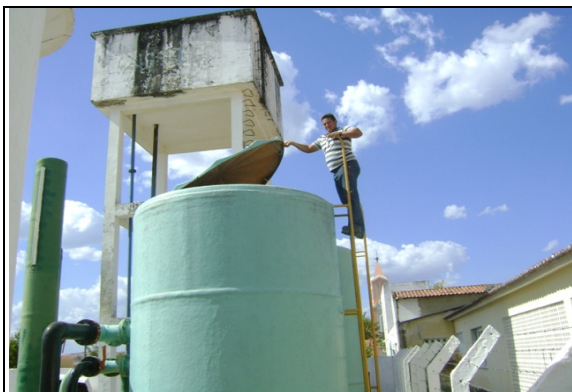
Foto 8 – Filtros com tampas e escadas.
