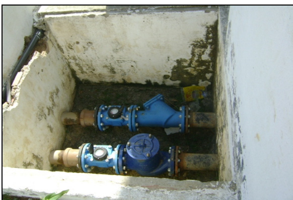
Foto 39 – Macromedidores eletromagnéticos - REL-02 e REL-03.
