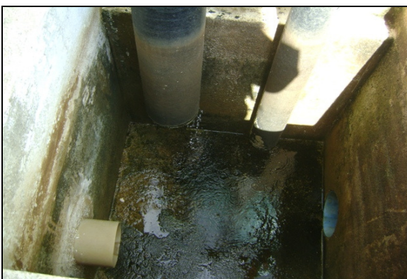
Foto 10 – Registro de descarga sem vedação.
