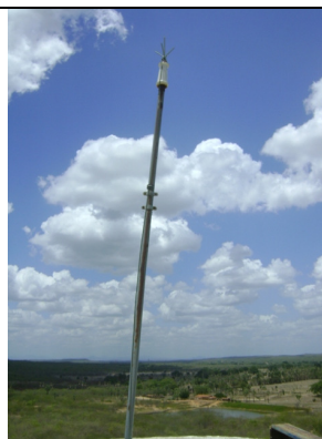
Foto 34 – REL-03 – sem sinalização noturna.
