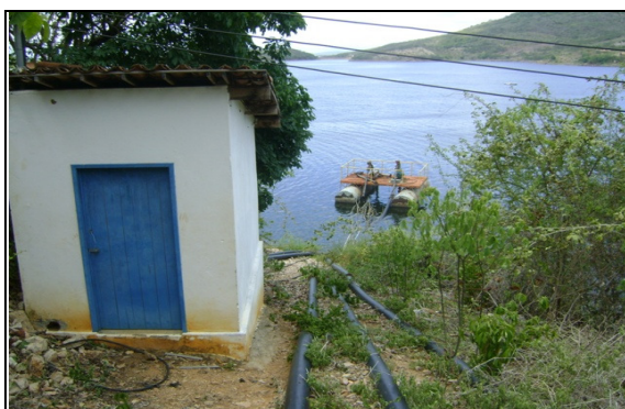
Foto 3 – Vista geral da área da captação sem cerca de proteção.
