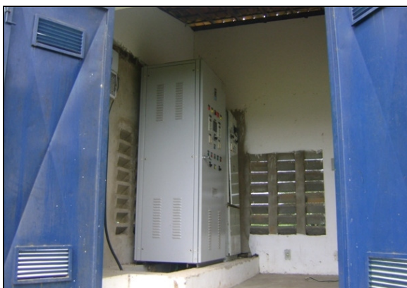
Foto 32 – Quadro de comando da EEPA-01.
