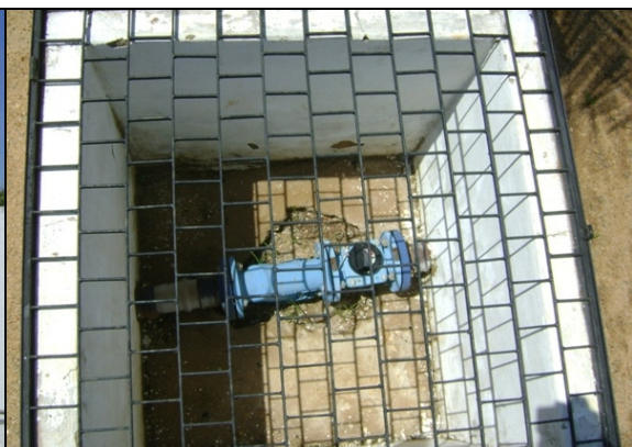
Foto 56 – Macromedidor para abastecimento de carro-pipa.
