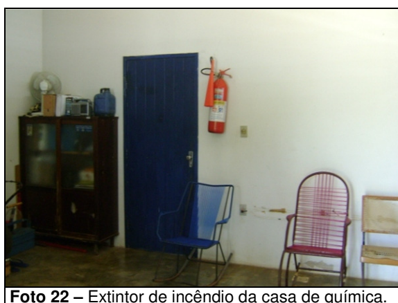
Foto 22 – Extintor de incêndio da casa de química.
