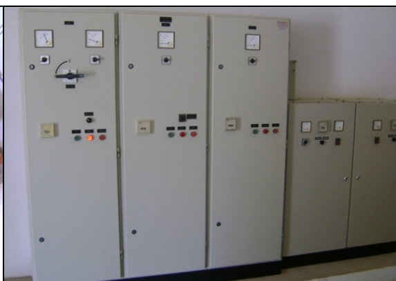
Foto 35 – Quadro de comando das EEAT-01 e EELF-01.
