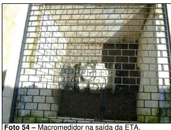
Foto 54 – Macromedidor na saída da ETA.
