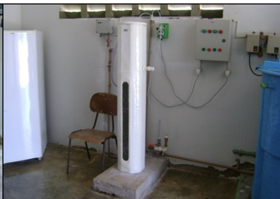
Foto 13 – Dosador de flúor.
