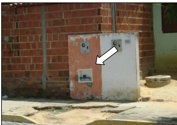
Foto 57 – Caixa de hidrômetro sem tampa, na Av. Maria Diorgenes, Centro.
