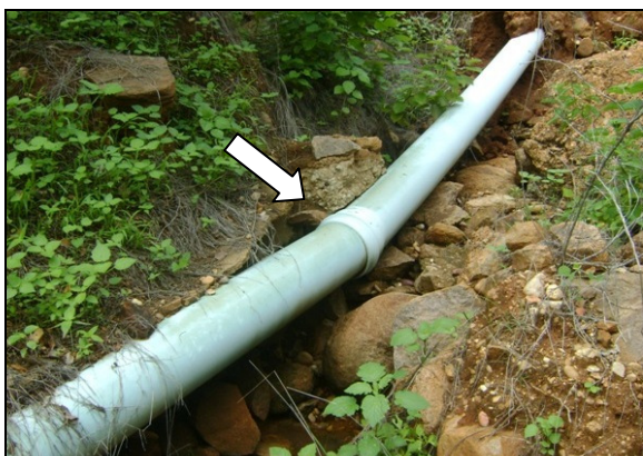
Foto 52 – Adutora de água bruta exposta.
