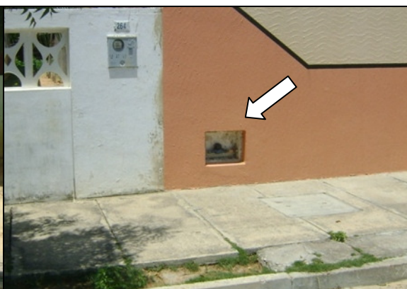
Foto 58 – Caixa de hidrômetro sem tampa, na Rua Zé Parente, Centro.
