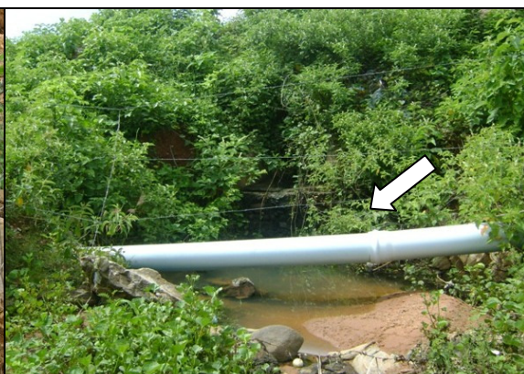
Foto 53 – Adutora de água bruta exposta.
