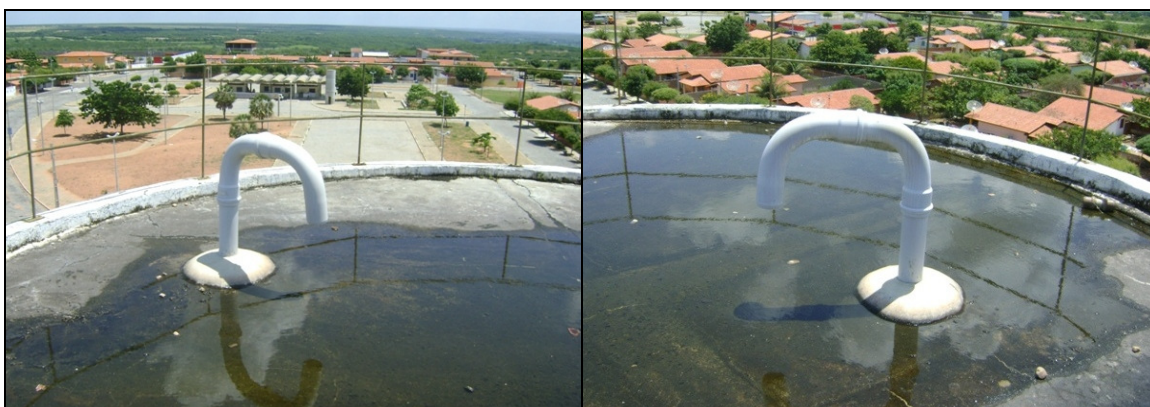
Fotos 49 e 50 – Ventilações do REL-01.
