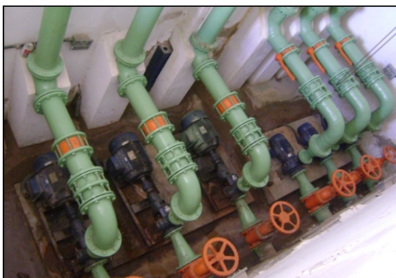
Foto 34 – Elevatórias EEAT-01 e EELF-01.
