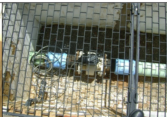
Foto 10 – Macromedidor para lavagem dos filtros.
