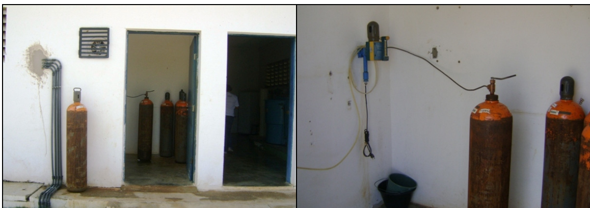
Foto 18 – Cilindros de cloro gasoso.
