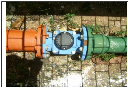
Foto 35 – Macromedidor na chegada do REL-01
