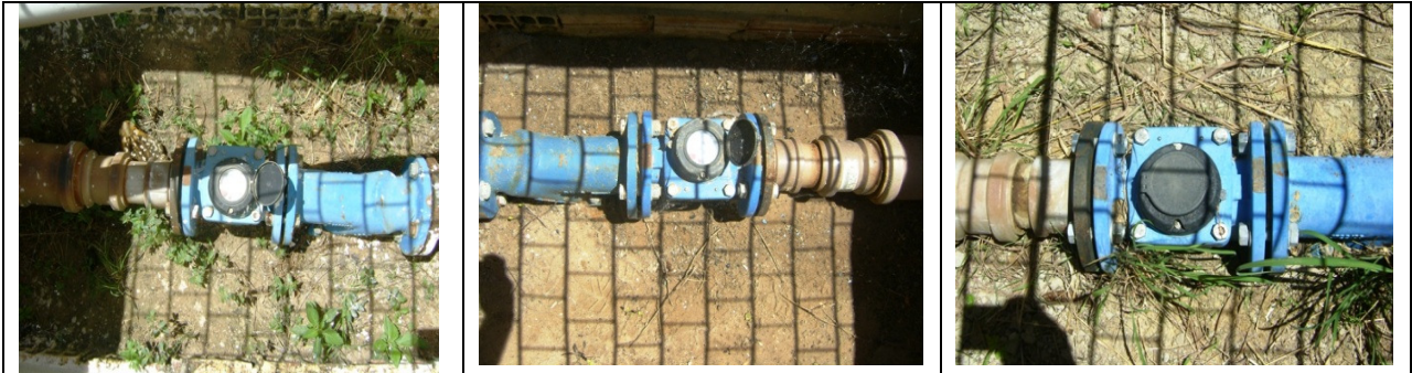
Fotos 32, 33 e 34 – Macromedidores nas saídas dos poços PT-04, PT-05 e PT-06.
