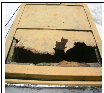
Foto 29 – REL-01 – tampa inspeção danificada.
