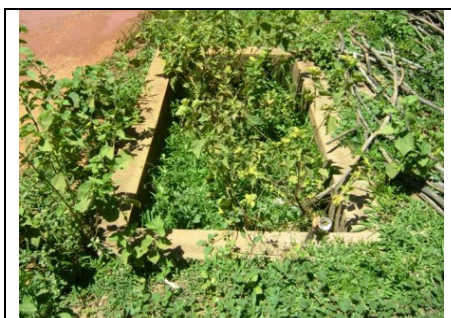
Foto 31 – Caixa de proteção de registro na adutora de água bruta
