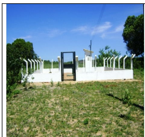
Foto 4 – Vista externa da área do PT-05.
