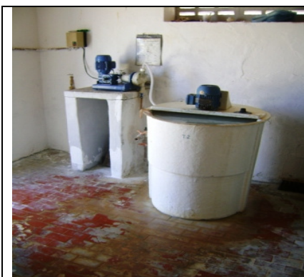
Foto 10 – Tanque de preparação e bomba dosadora de hipoclorito da cálcio
