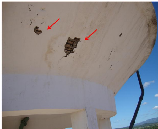
Foto 54 – REL-01: estrutura com armadura exposta.
