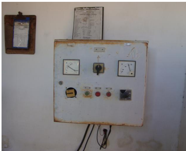
Foto 3 – Quadro de comando do poço PT-01.
