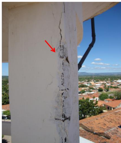
Foto 53 – REL-01: estrutura com armadura exposta.
