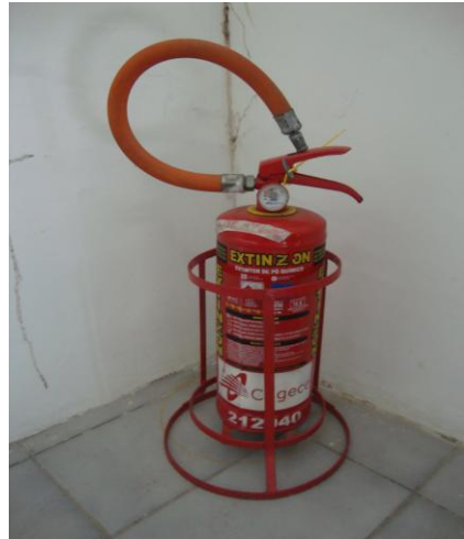
Foto 77 – Extintor de incêndio com prazo de validade até dez/2015.
