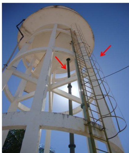
Foto 51 – Vista do REL-01 com guarda-corpo na escada de acesso e tubo extravasor.
