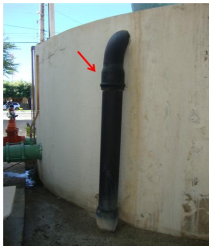
Foto 47 – RAP-01: Tubo extravasor.
