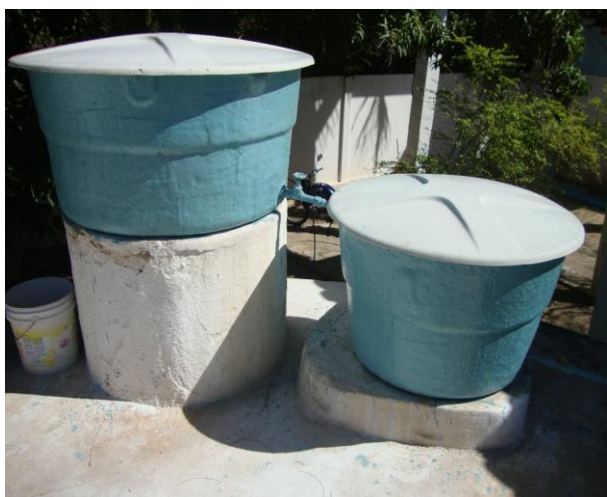
Foto 23 – Cloração no RAP-01.
