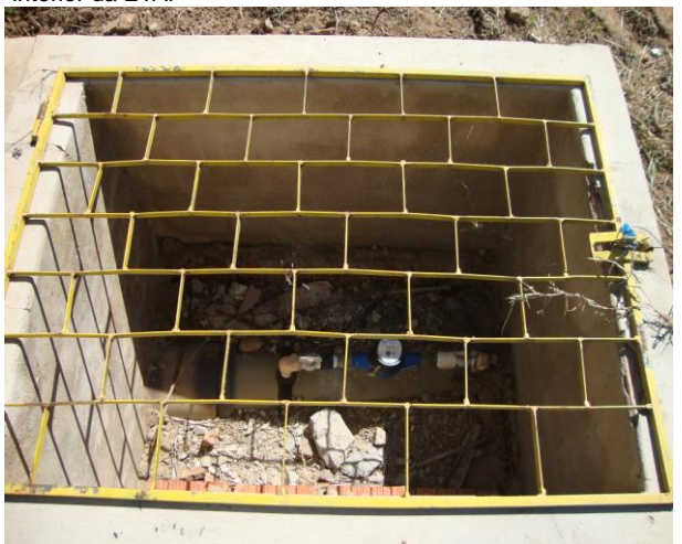
Foto 35 – Macromedidor de água tratada na entrada do REL-01.
