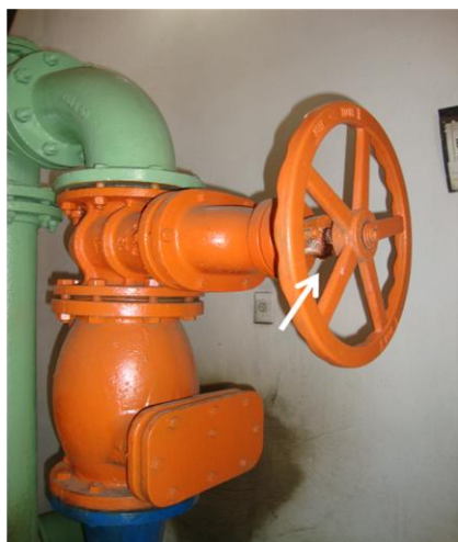
Foto 38 – Registro com vazamento.
