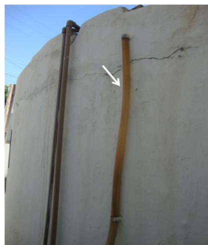
Foto 46 – RAP-01: Medidor de nível.
