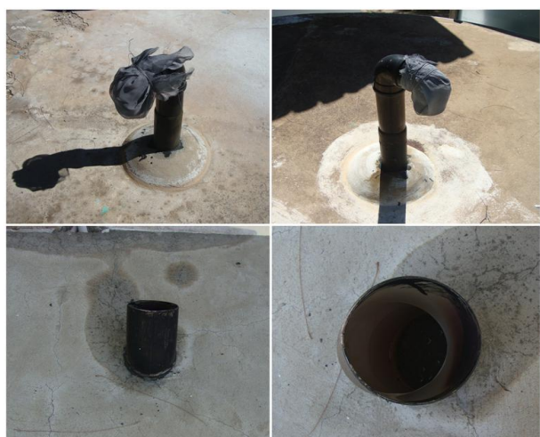
Foto 45 – Tubulações de ventilação do RAP-01 com tela de vedação.
