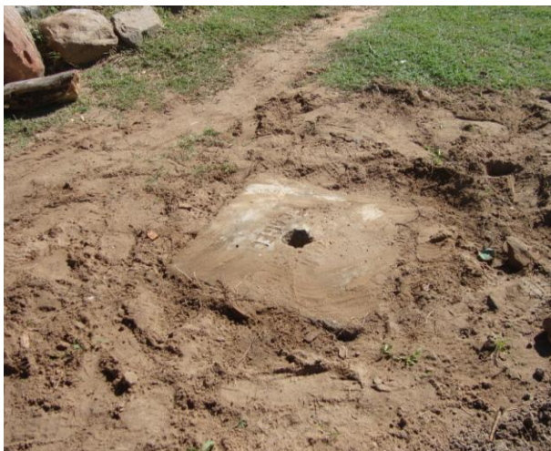
Foto 66 – Registro de descarga na Rua Juviano Lins, nº 309.
