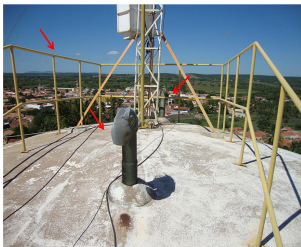
Foto 56 – REL-01: Tubulações de ventilação com tela de vedação e guarda-corpo na laje de cobertura.
