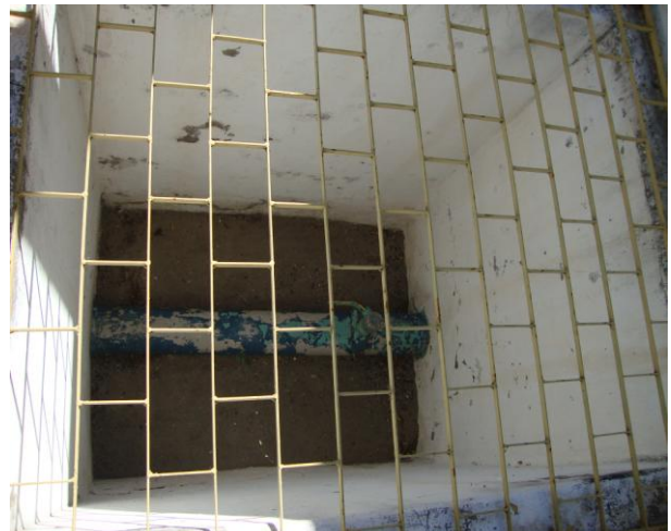
Foto 33 – Estações pitométrica na adutora de água tratada no interior da ETA.
