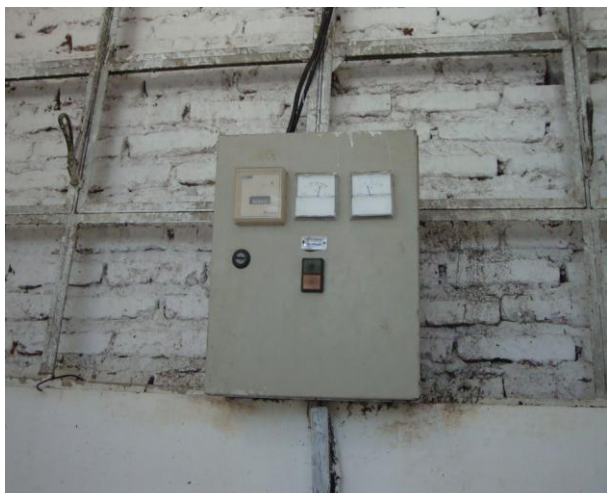
Foto 42 – Quadro de comando do Booster 01.
