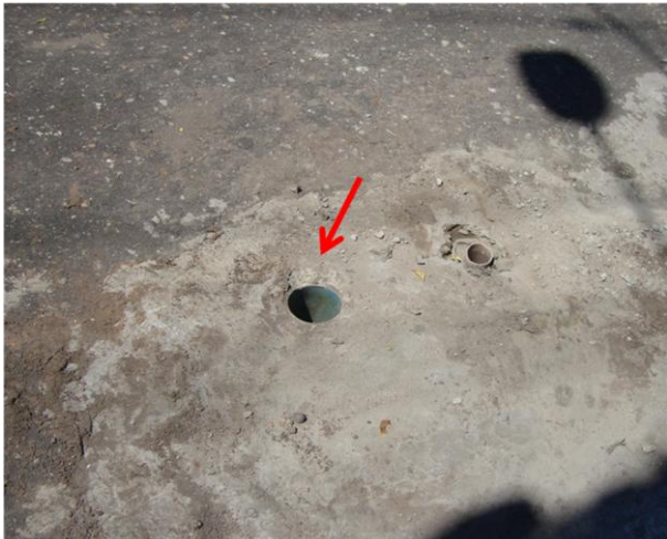
Foto 70 – Registro de descarga na Rua Antônio Napoleão de Araújo, nº 208.
