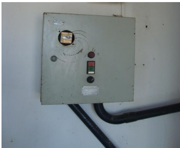
Foto 13 – Quadro de comando do poço PT-04.
