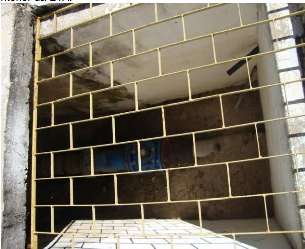
Foto 34 – Macromedidor na adutora de água tratada no interior da ETA.
