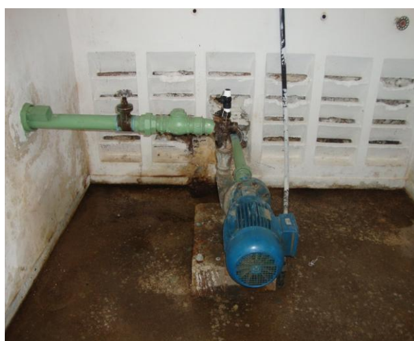
Foto 41 – Bomba do Booster 01.
