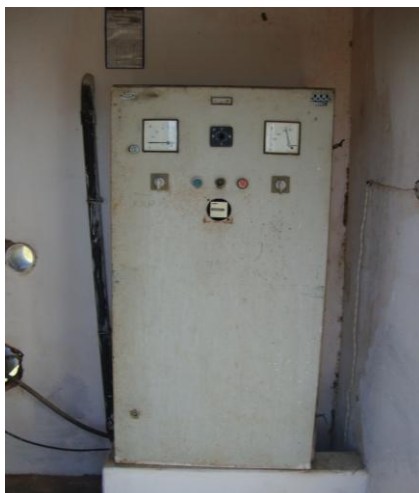
Foto 7 – Quadro de comando do poço PT-02.
