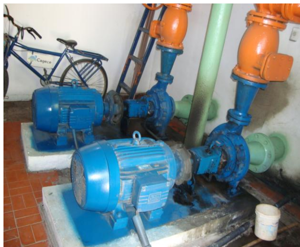
Foto 37 – Elevatória EE-06 com conjunto motor-bomba.
