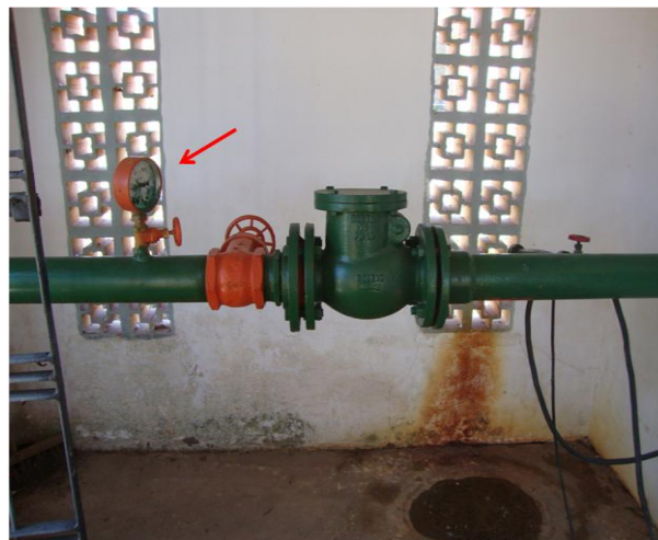
Foto 4 – Macromedidor e ventosa do poço PT-01.
