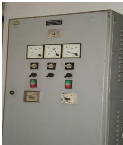
Foto 39 – Quadro de comando da EE-06.
