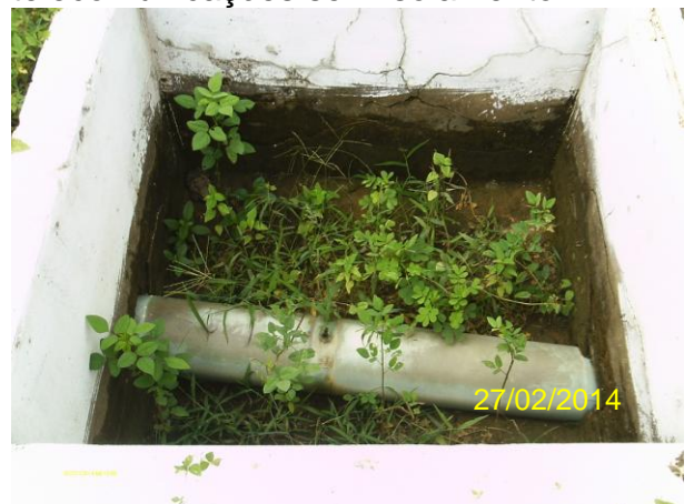
Foto 64 - REL-02: medidor na saída desativado sem tampa ou grade de proteção.
