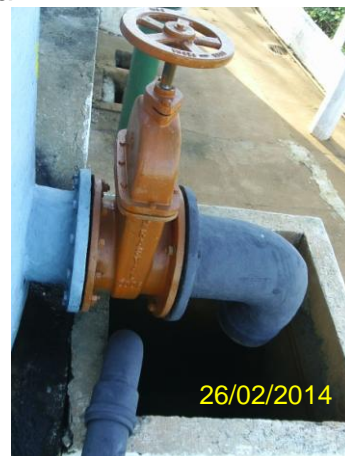
Foto 18 - ETA filtração: descarga de fundo do F-01.
