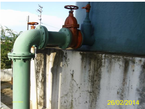
Foto 17 - ETA filtração: tubulação e registro do F-01.
