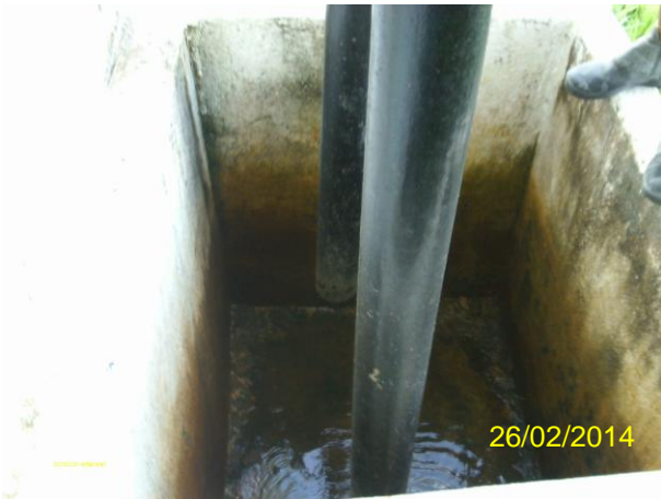
Foto 15 - ETA decantação: descarga de fundo sem grade de proteção.
