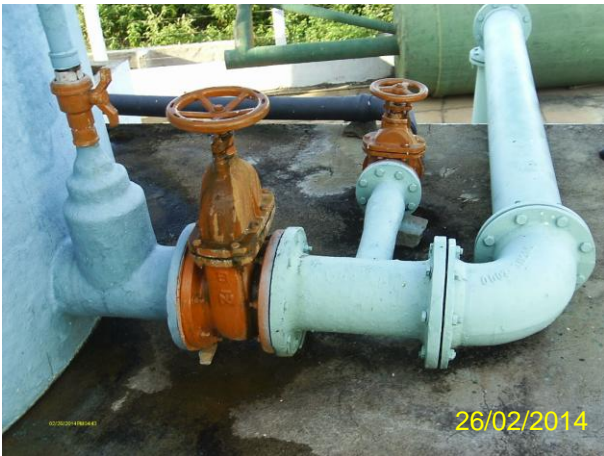
Foto 21 - ETA filtração: vazamento no registro do F-02.
