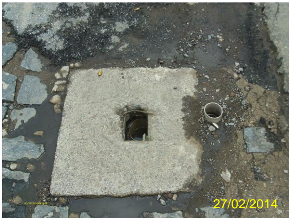
Foto 82 - Registro de descarga na rede de distribuição: Av. João Joaquim com recuperação inadequada do pavimento em volta.
