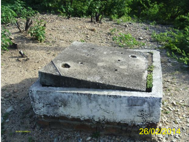
Foto 42 - AAB-01: ventosa com tampa parcialmente retirada.
