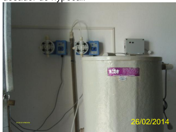
Foto 28 - ETA casa de química: tanque dosador de flúor.
