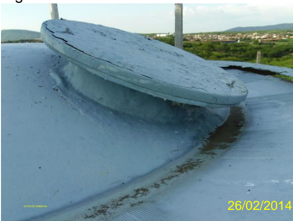
Foto 23 - ETA filtração: tampa do F-02 danificada.
