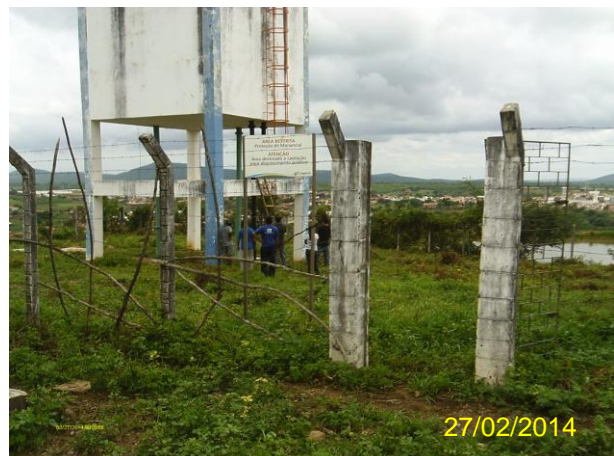
Foto 58 - REL-02: cerca de delimitação da área do reservatório danificada, vegetação excessiva no entorno do reservatório.
