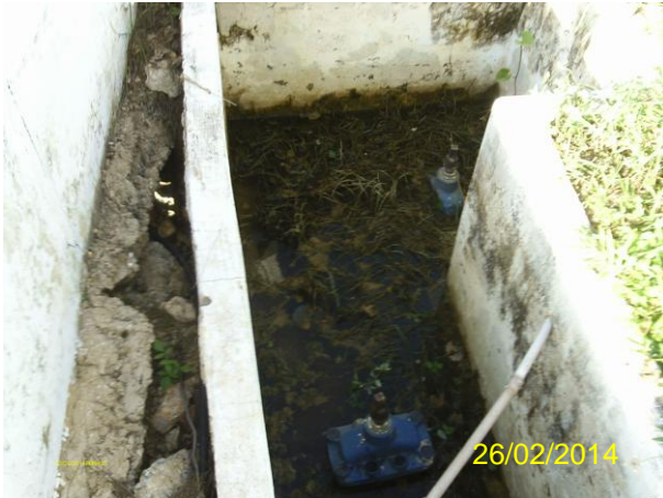
Foto 44 - AAB-01: caixa do registro da linha de chegada da ETA sem tampa ou grade de proteção e com acúmulo de água.
