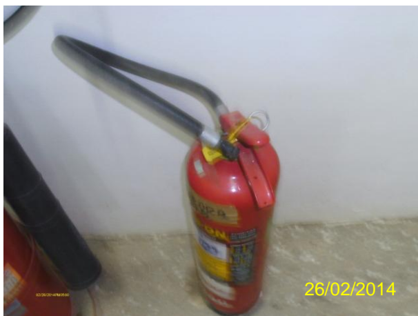
Foto 55 - Extintor em água dentro da data de validade.
