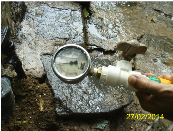
Foto 76 - Medição instantânea de pressão na rede de distribuição: Av. João Joaquim, S/N.
