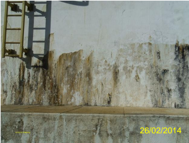
Foto 13 - ETA decantação: escada de acesso e sinais de vazamento na parede lateral.
