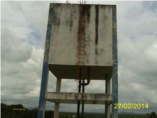
Foto 59 - REL-02: ausência de identificação, ausência de guarda-corpo na laje de cobertura, pintura deteriorada e escada de acesso sem apoio para a subida.
