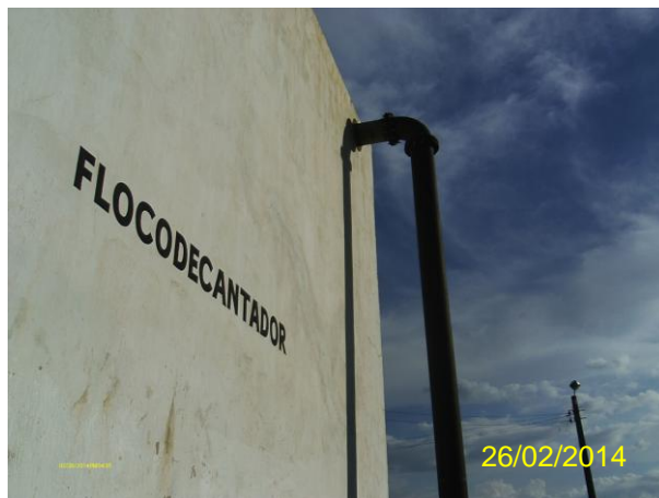
Foto 12 - ETA decantação: pintura deteriorada e identificação.
