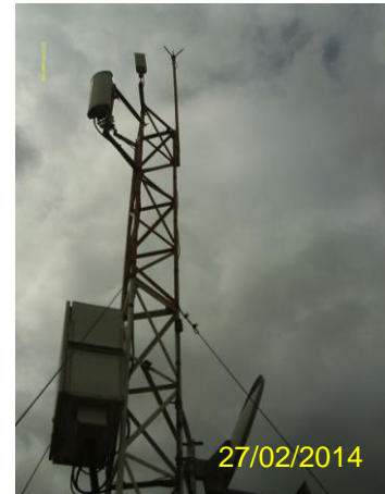
Foto 62 - REL-02: pára-raio da torre de telecomunicações sem isolamento.
