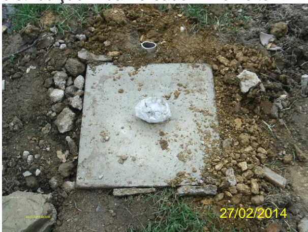
Foto 80 - Registro de descarga na rede de distribuição: Rua SDO - Conj. Habitat.
