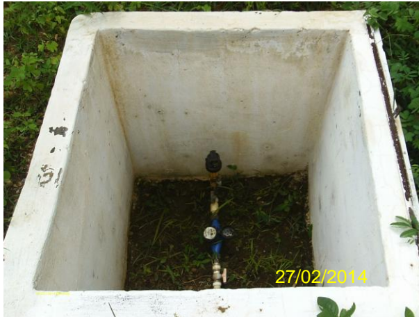
Foto 48 - AAT-01: medidor proporcional instalado com caixa mas sem tampa ou grade de proteção na área do REL-02.
