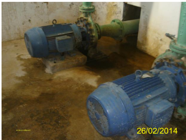
Foto 49 - EEAT-01: conjunto moto-bomba com reserva.
