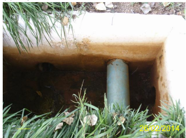
Foto 24 - ETA filtração: tubulação de saída das águas de lavagem dos filtros F-01 e F-02.
