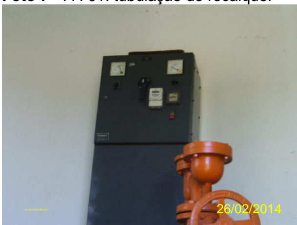
Foto 9 - PA-01: quadro de comando.
