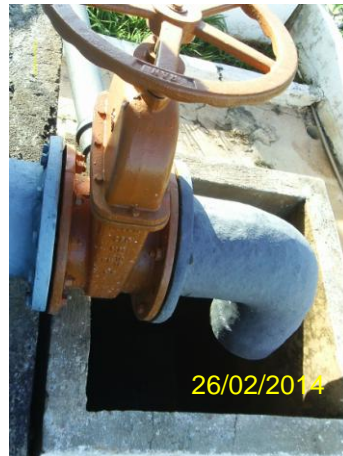
Foto 22 - ETA filtração: descarga de fundo do F-02.
