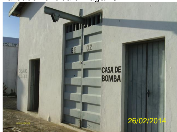
Foto 56 - Ausência de identificação das estações elevatórias na casa de bombas.
