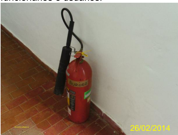
Foto 92 - Escritório/almojarifado: extintor de incêndio dentro do prazo de validade.
