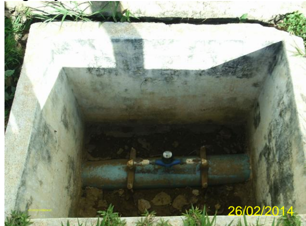
Foto 45 - AAB-01: medidor proporcional instalado com caixa mas sem tampa ou grade de proteção na chegada da ETA.
