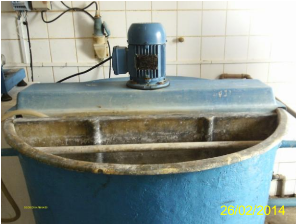
Foto 25 - ETA casa de química: tanque dosador de cloro sem tampa.
