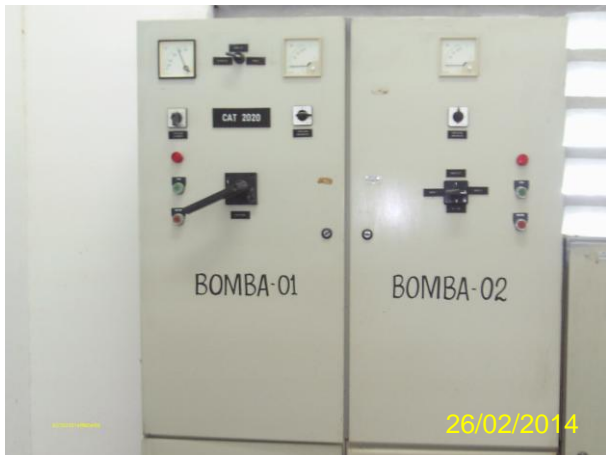
Foto 51 - EEAT-01: quadro de comando.
