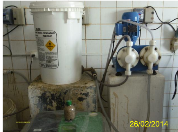
Foto 26 - ETA casa de química: tanque dosador de hypocal.
