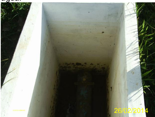
Foto 46 - AAB-01: estação pitométrica implantada com caixa mas sem tampa ou grade de proteção na chegada da ETA.
