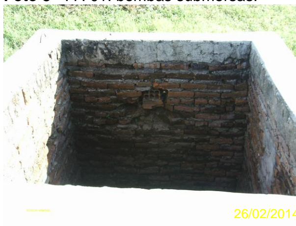
Foto 10 - PA-01: cacimba localizada na área do PA-01 sem tampa ou grade de proteção.
