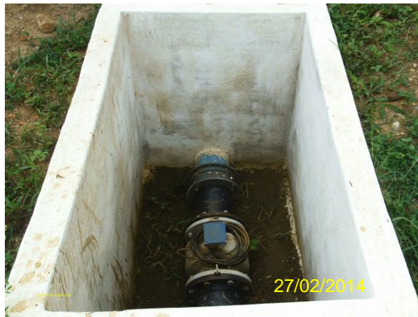
Foto 66 - REL-02: instalação da automação do reservatório inacabada e caixa sem tampa ou grade de proteção.
