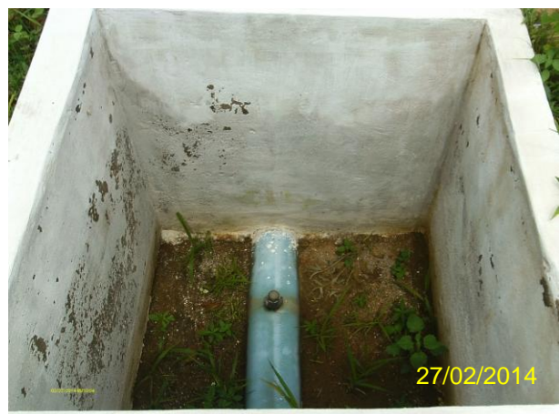
Foto 47 - AAT-01: estação pitométrica implantada com caixa mas sem tampa ou grade de proteção na área do REL-02.
