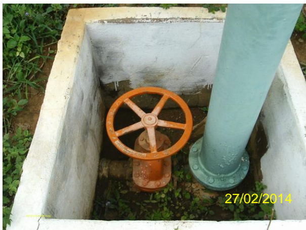
Foto 63 - REL-02: caixa do registro de saída sem tampa ou grade de proteção.
