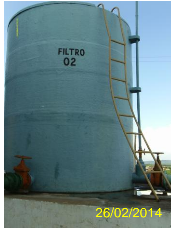
Foto 20 - ETA filtração: identificação do F-02; escada envergada e sem fixação adequada.
