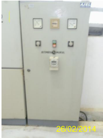
Foto 53 - EELF-01: quadro de comando.
