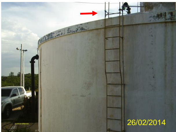
Foto 69 - RAP-02: tubo extravasor, sem medidor de nível e escada de acesso fixada inadequadamente.
