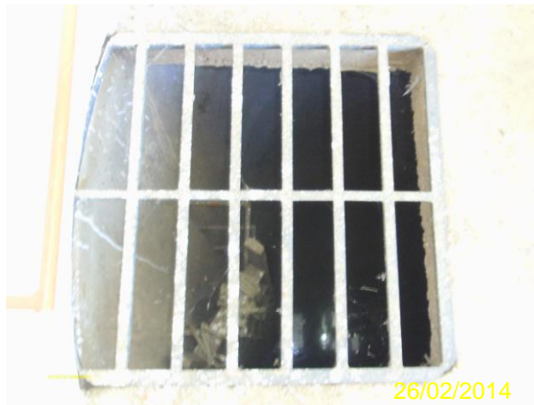
Foto 8 - PA-01: bombas submersas.
