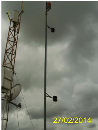
Foto 61 - REL-02: pára-raio desativado.
