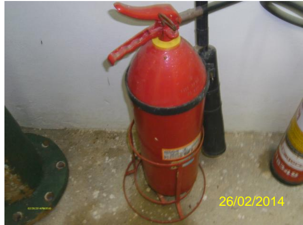
Foto 54 - Extintor em pó com data de validade vencida em ago/13.
