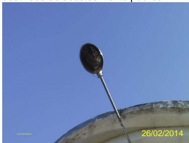
Foto 4 - PA-01: iluminação externa.
