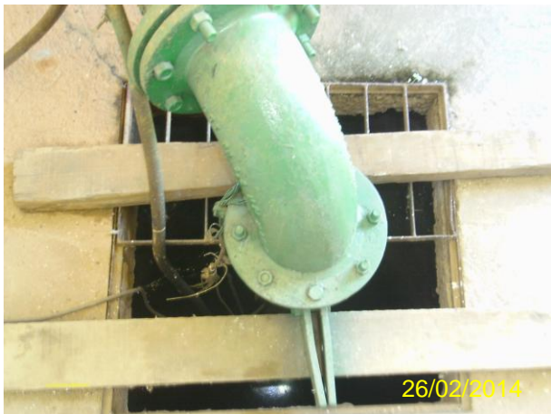
Foto 7 - PA-01: tubulação de recalque.
