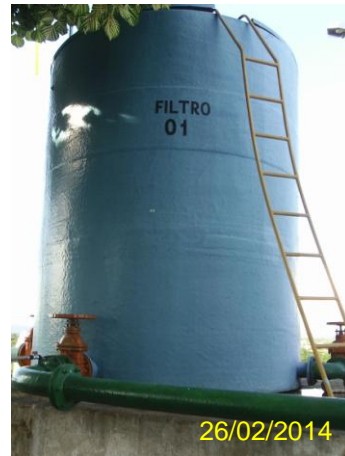
Foto 16 - ETA filtração: identificação do F-01; escada envergada e sem fixação adequada.
