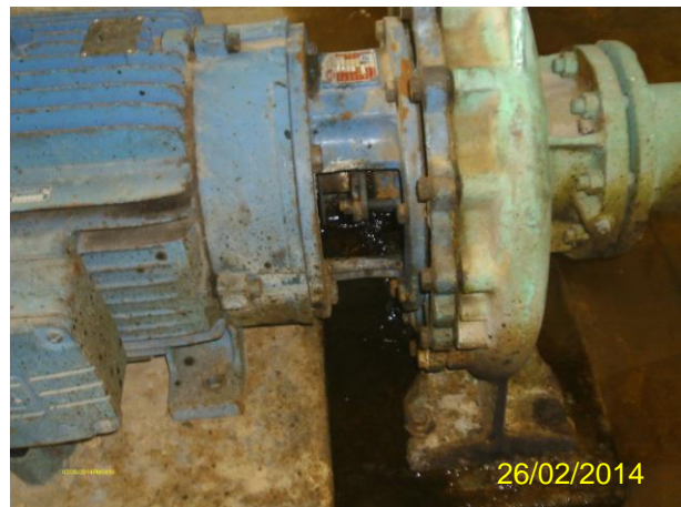
Foto 50 - EEAT-01: vazamento na gaxeta.
