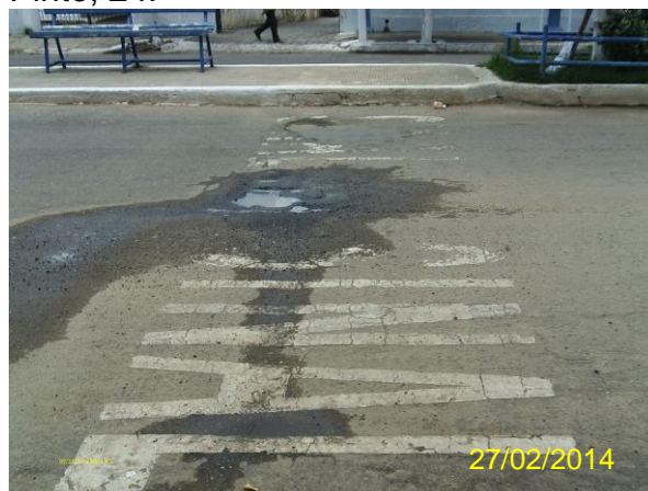
Foto 87 - Recuperação inadequada do pavimento após retirada de vazamento na rede de distribuição: Av. Antônio Carlos, 42.
