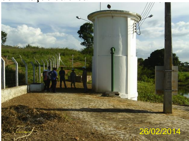
Foto 3 - PA-01: ausência de identificação.
