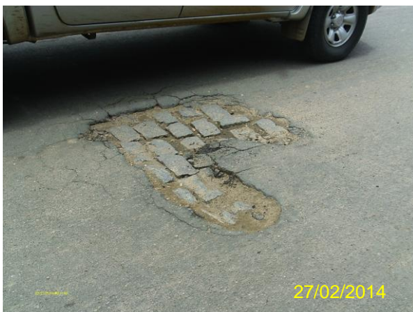
Foto 86 - Recuperação inadequada do pavimento após retirada de vazamento na rede de distribuição: Av. Antônio Carlos, 42.
