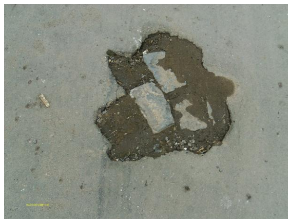
Foto 85 - Recuperação inadequada do pavimento após retirada de vazamento na rede de distribuição: Travessa Antônio Pinto, 24.
