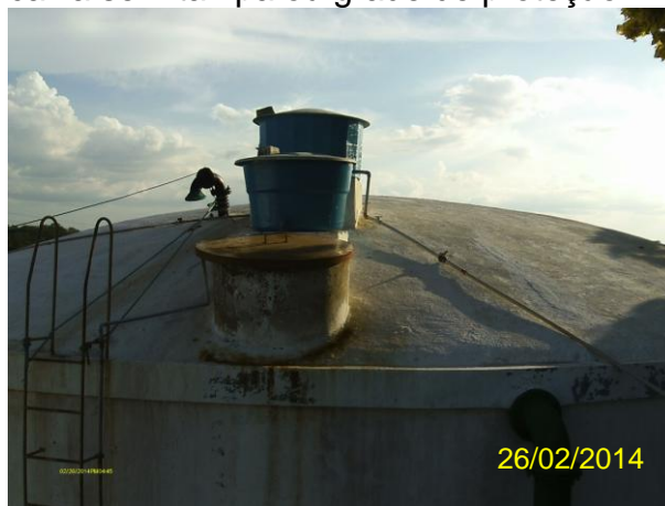
Foto 68 - RAP-02: tampa de inspeção, entrada de produtos químicos e tubulação de ventilação sem tela de proteção.
