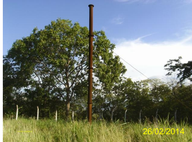
Foto 43 - AAB-01: torre piezométrica com pintura deteriorada e área tomada por vegetação.
