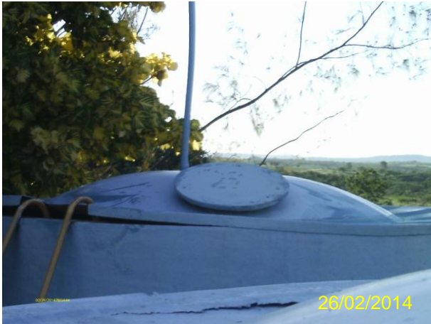
Foto 19 - ETA filtração: tampa do F-01 danificada.
