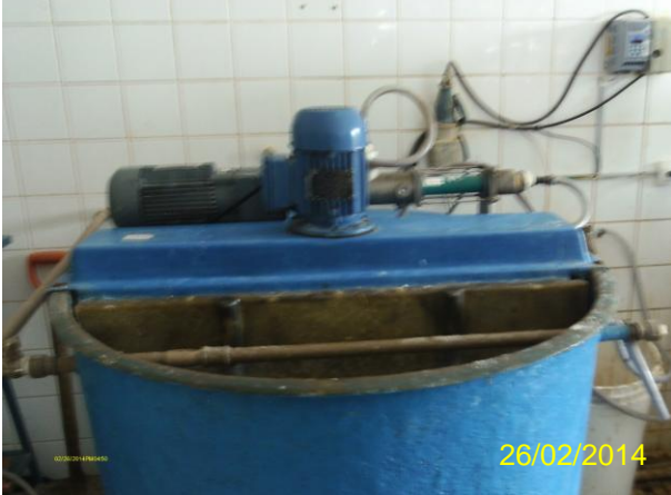
Foto 27 - ETA casa de química: tanque dosador de polímero sem tampa.
