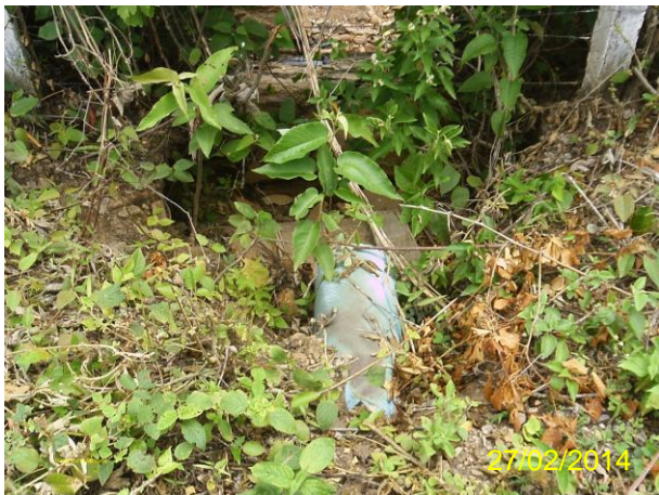
Foto 65 - REL-02: tubo extravasor.
