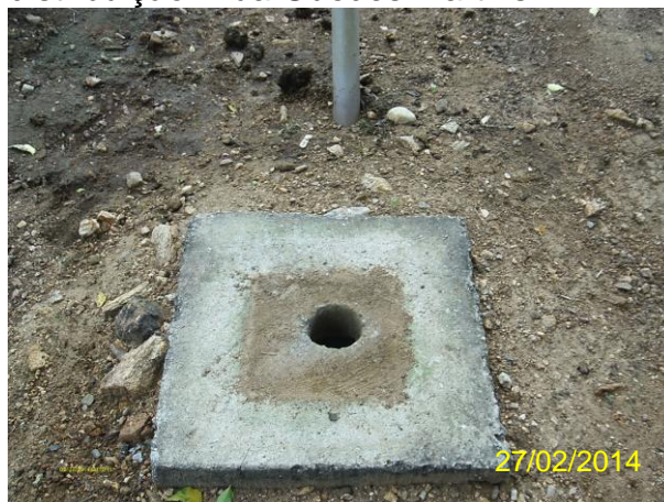
Foto 81 - Registro de descarga na rede de distribuição: Rua Miguel Rodrigues.
