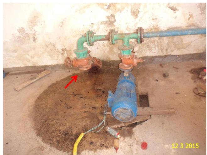
Foto 2 – EEAT-05: sem bomba reserva e com vazamento no registro.
