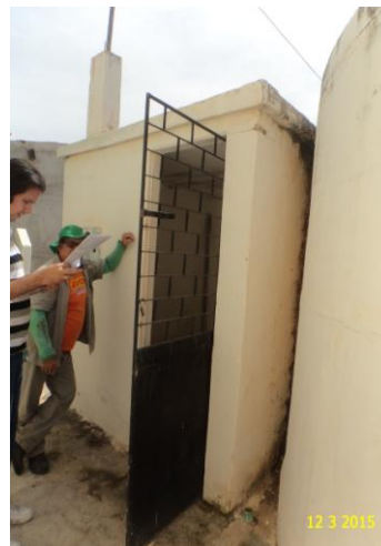
Foto 14 – EEAT-06: sem identificação.
