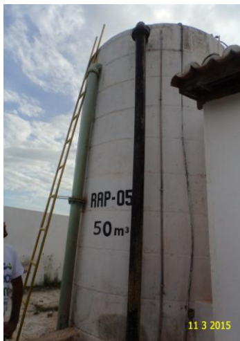
Foto 39 – RAP-05: com extravazamento.
