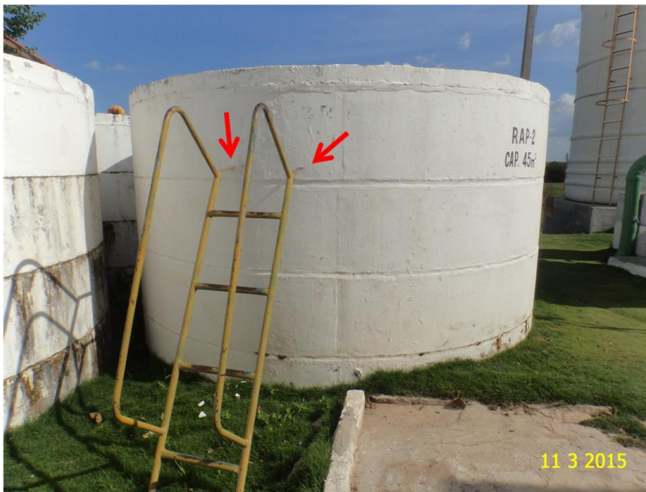
Foto 31 – RAP-01, RAP-02 e RAP-03: escada de acesso sem fixação na estrutura.
