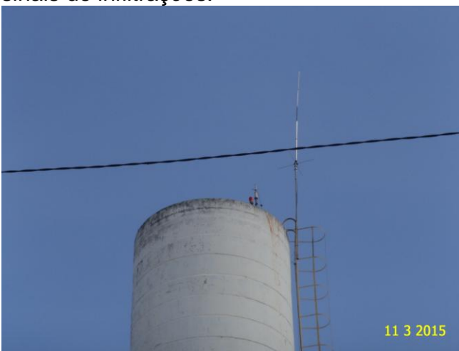
Foto 7 – REL-01: ausência de guarda-corpos.
