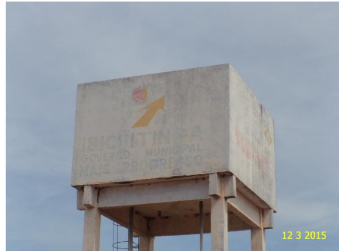
Foto 10 – REL-08: ausência de para-raios, sinalizador noturno e guarda-corpos na laje de cobertura.
