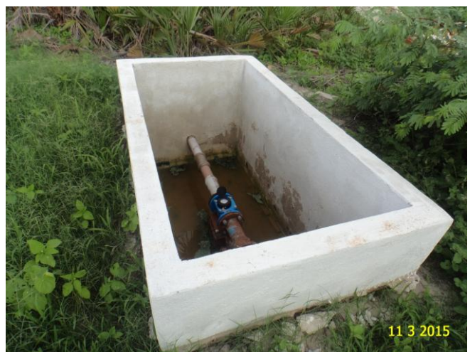
Foto 22 - RAP-05: caixa de inspeção sem tampa ou grade de proteção.
