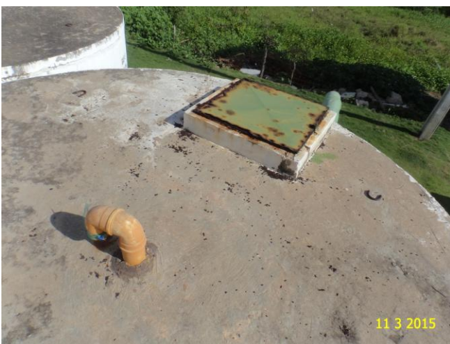
Foto 33 – RAP-02: tampa corroida.
