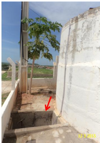
Foto 25 – RAP-08: caixa de inspeção sem tampa ou grade de proteção.
