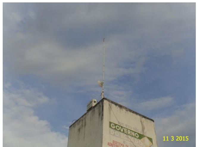
Foto 8 – REL-04: ausência de para-raio, sinalizador noturno e guarda-corpos.
