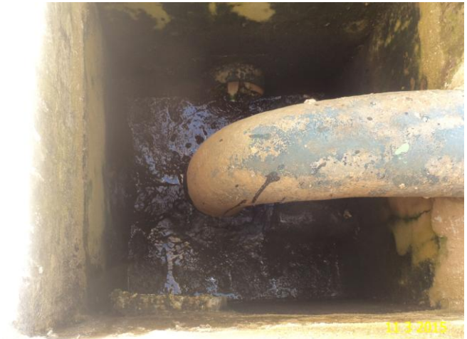
Foto 18 - ETA: registro do F-01 com vazamento.
