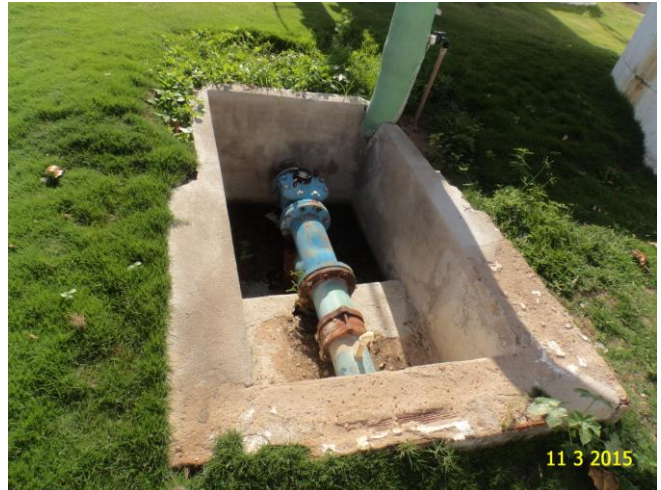
Foto 20 - ETA: caixa de inspeção sem tampa ou grade de proteção.
