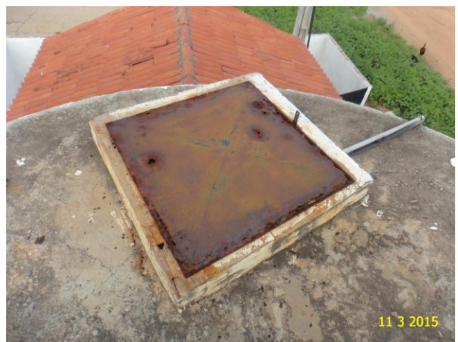
Foto 34 – RAP-04: tampa em processo de corrosão.
