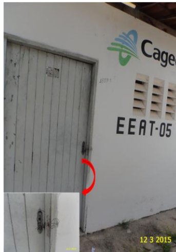
Foto 40 – EEAT-05: fechadura danificada.
