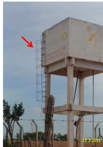
Foto 32 – REL-08: escada de acesso e guarda-corpos em processo de corrosão.
