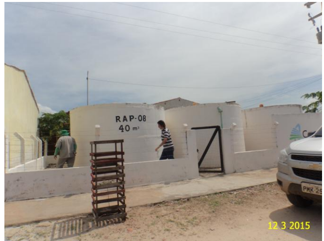
Foto 6 – RAP-08: sem escada de acesso
