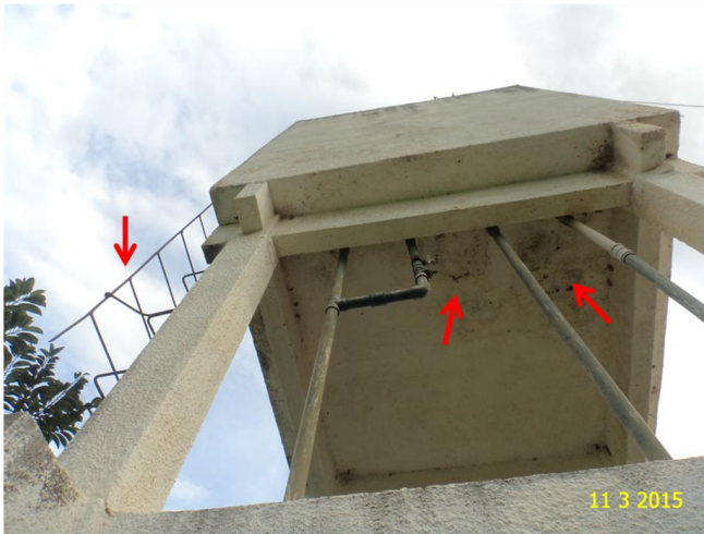
Foto 9 – REL-04: ausência de guarda-corpos na escada de acesso e estrutura deteriorada.
