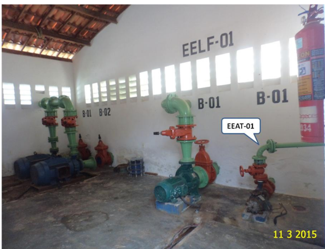
Foto 1 – EELF-01 e EEAT-01: sem bomba reserva.
