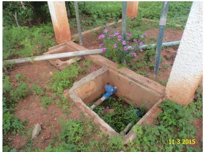
Foto 26 – REL-04: caixa de inspeção sem tampa ou grade de proteção.
