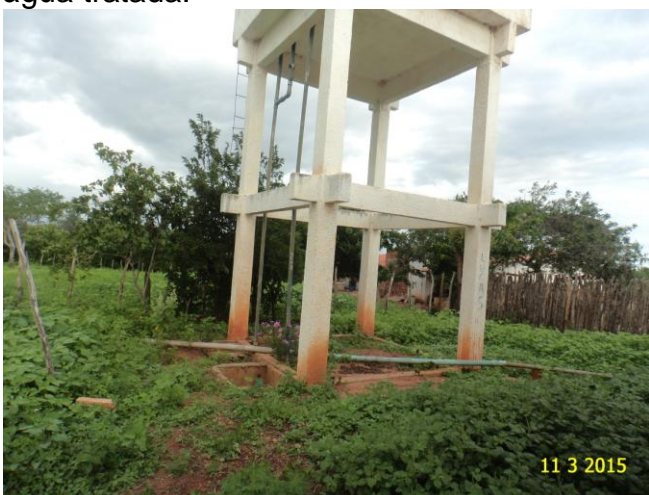
Foto 21 - REL-04: inadequadas condições de limpeza e manutenção.
