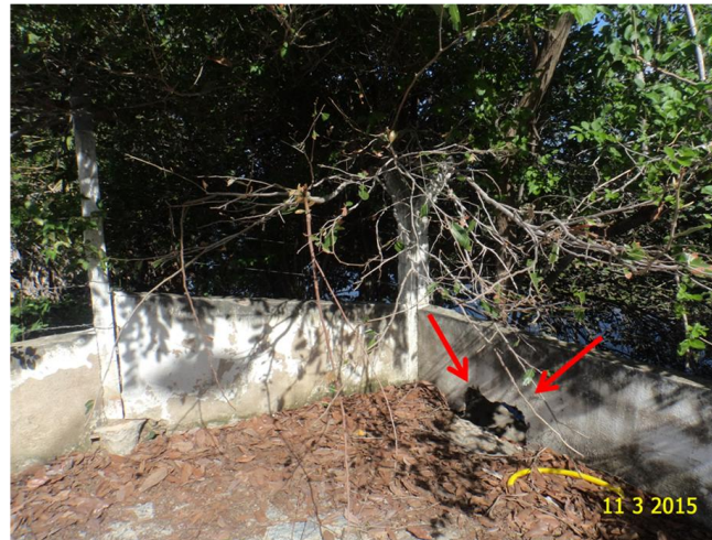
Foto 12 – EECS-01: mureta danificada.
