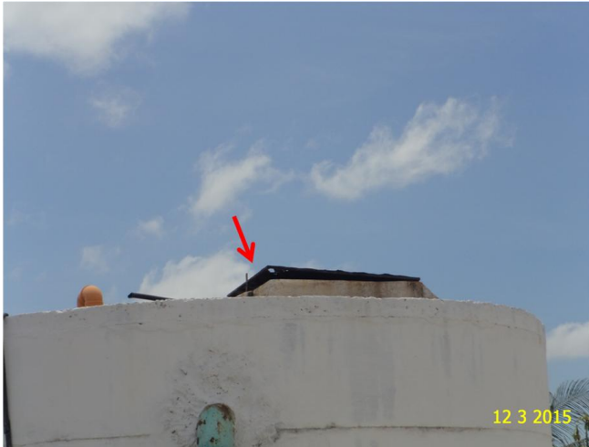
Foto 35 – RAP-07: tampa em processo de corrosão e sem a adequada vedação.
