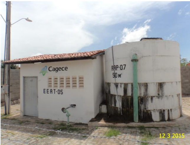
Foto 5 – RAP-07: sem escada de acesso e sinais de infiltrações.
