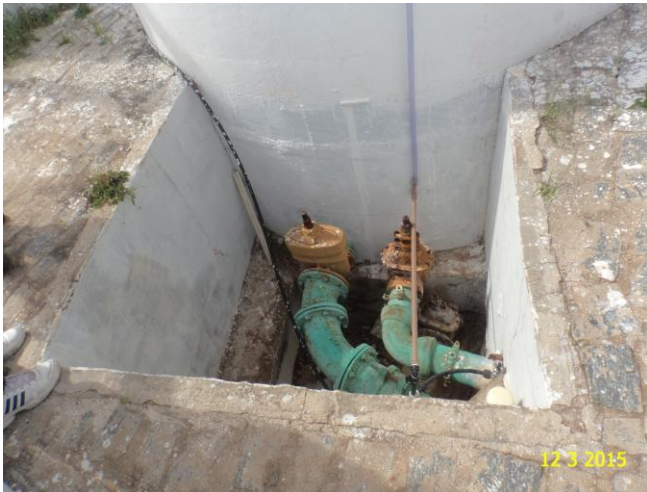
Foto 23 – RAP-06: caixa de inspeção sem tampa ou grade de proteção.
