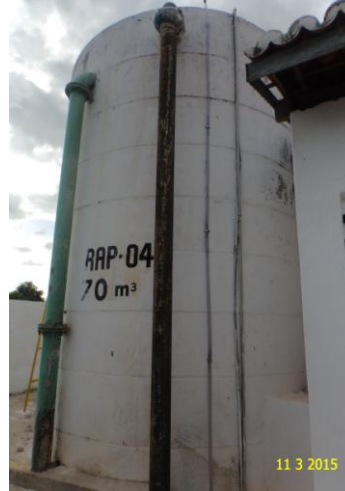
Foto 38 – RAP-04: com extravazamento.
