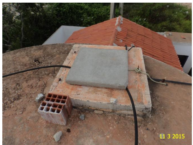
Foto 28 – RAP-05: tampa de inspeção em condições inadequadas de vedação.
