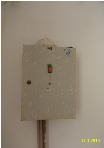
Foto 3 – EEAT-06: quadro de comando sem horímetro.
