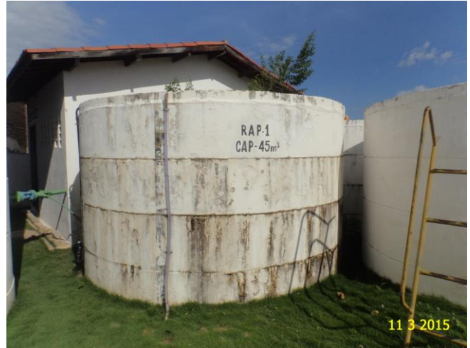
Foto 36 – RAP-01: pintura deteriorada e com sinais de infiltrações.
