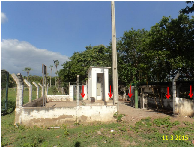
Foto 11 – EECS-01: mureta e cerca danificadas.
