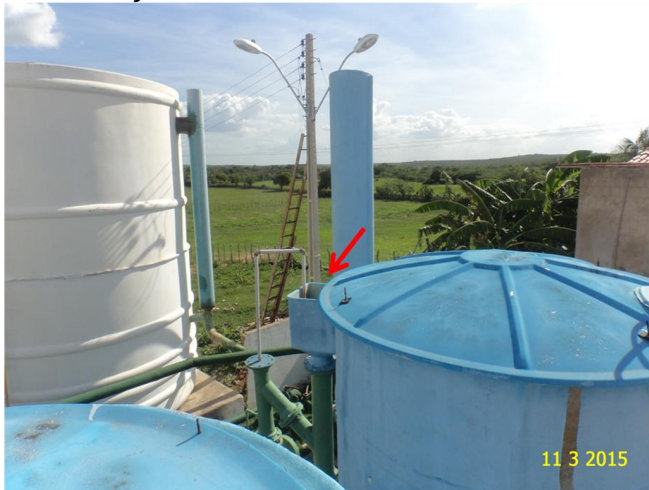
Foto 19 - ETA: filtros F-01, F-02 e F-03 sem tampa de proteção nas caixas de saída da água tratada.
