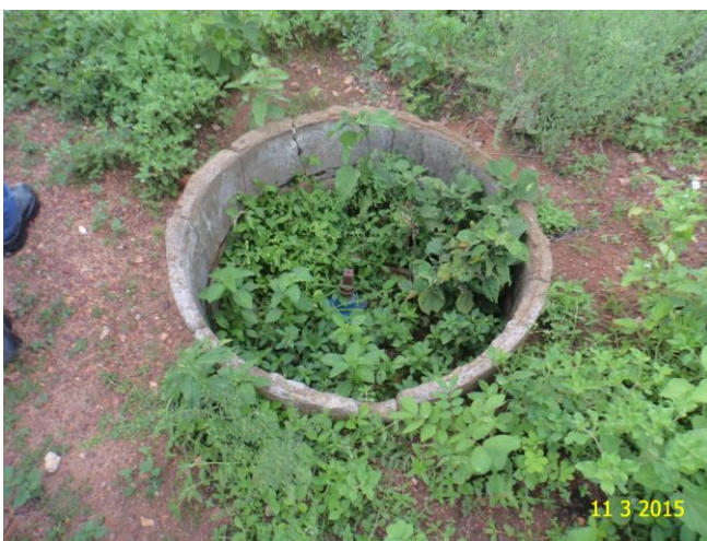
Foto 27 – REL-04: caixa de inspeção sem tampa ou grade de proteção.
