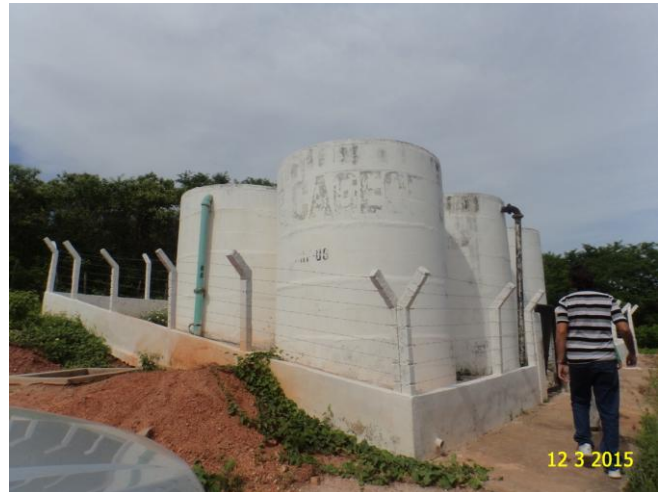
Foto 4 – RAP-06: sem escada de acesso, pintura deteriorada e identificação com pouca visibilidade.
