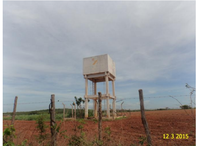
Foto 30 – REL-08: área sem portão de acesso e identificação.
