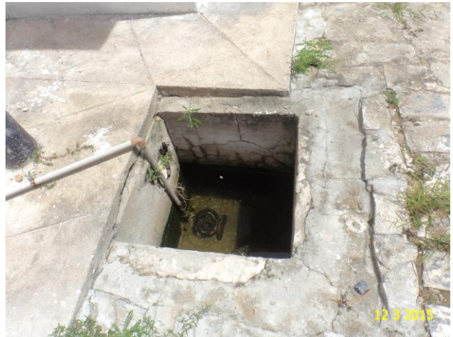
Foto 24 – RAP-07: caixa de inspeção sem tampa ou grade de proteção.
