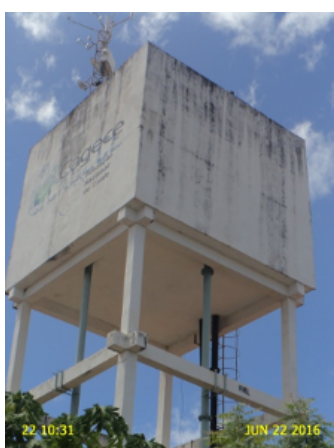
Foto 07 - REL-01: pintura deteriorada
