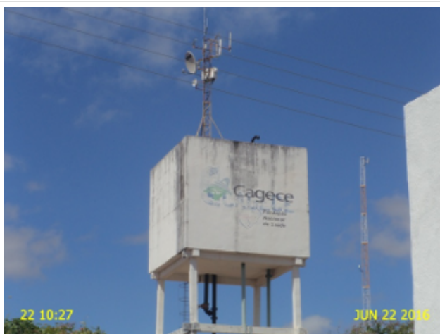
Foto 06 - REL-01: ausência de guarda corpo na laje de cobertura.
