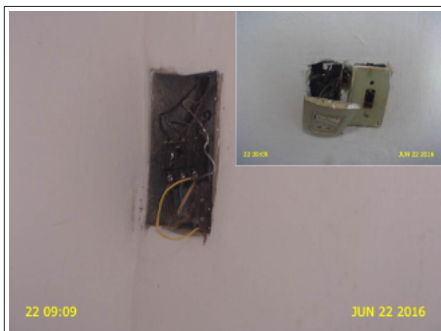
Foto 01 - PA-02: instalações elétricas inadequadas.
