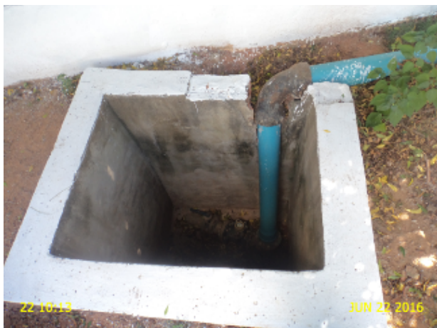
Foto 03 – ETA: caixa do medidor proporcional está sem tampa ou grade de proteção
