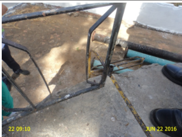
Foto 05 - Grade de proteção da área do PA-02 sem fixação.
