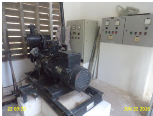
Foto 04 – ETE: Grupo gerador de energia elétrica com defeito.
