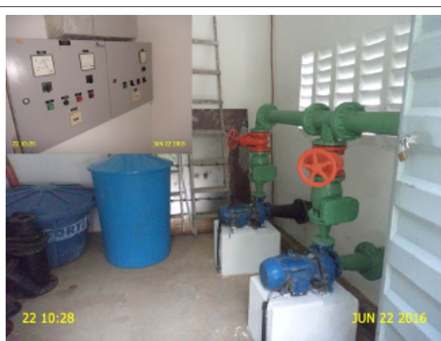
Foto 02 - EEAT-01: Quadro de Comando com defeito.
