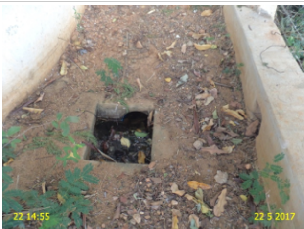
Foto 9 - RAP-03: caixa de inspeção sem tampa ou grade de proteção.
