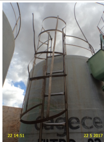
Foto 12 - F-03: guarda-corpo da escada de acesso danificado.
