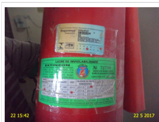
Foto 3 – Escritório/ Almojarifado da Cagece: extintor de incêndio com data de validade da recarga vencida.
