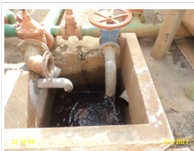
Foto 11 - F-02: registro sem vedação.
