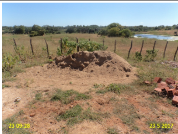
Foto 8 - RDA: registro de descarga sem caixa e soterrado, localizado no endereço Rua Alípio Oliveira, nº 345-1.
