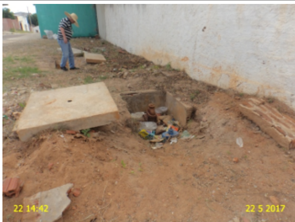
Foto 5 - ETA: caixas dos registros da AAT na chegada da ETA estão danificadas e descobertas.
