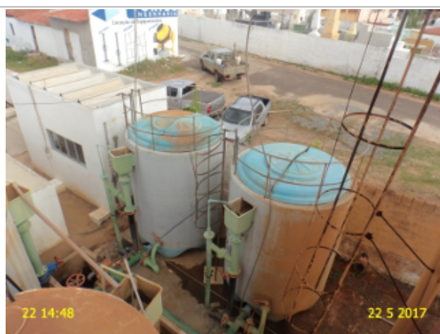
Foto 2 - Filtros F-03 e F-04: calha de saída de água sem tampa.
