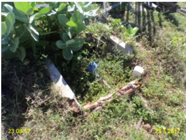
Foto 7 - RDA: registro de descarga com caixa danificada localizado no endereço Rua José Ferreira.
