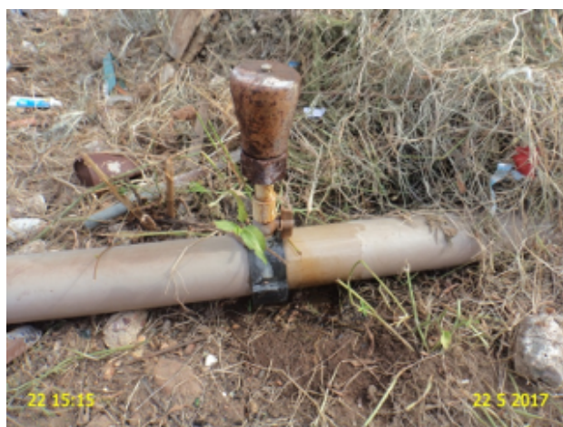
Foto 4 – AAT: vazamento na ventosa localizada na área do reservatório REL-01.
