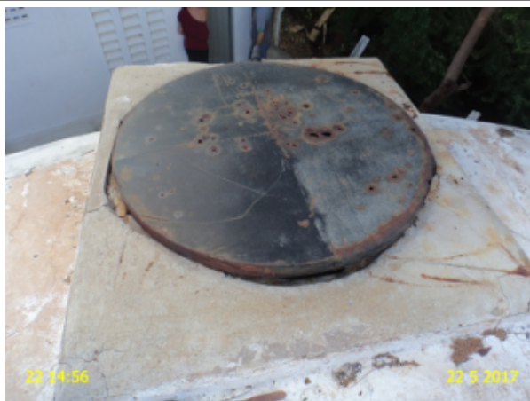
Foto 6 - RAP-03: tampa de inspeção em processo de corrosão.
