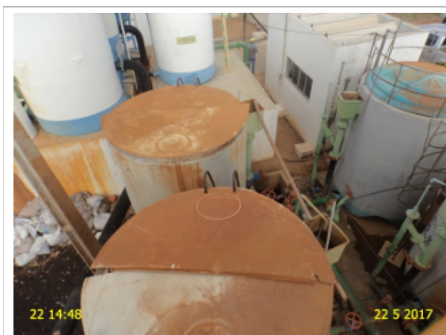
Foto 1 - Filtros F-01 e F-02: calha de saída de água sem tampa.
