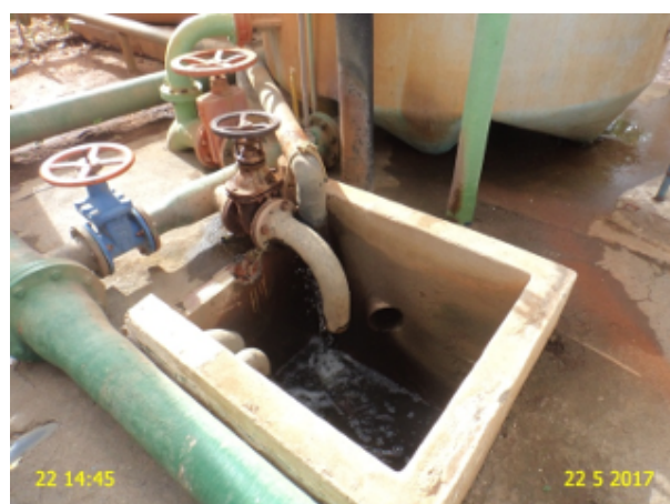
Foto 10 - F-01: registro sem vedação.
