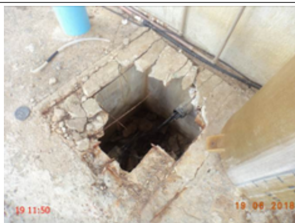
Foto 88 – ETA (Tapuiará): caixa de inspeção com tampa danificada.
