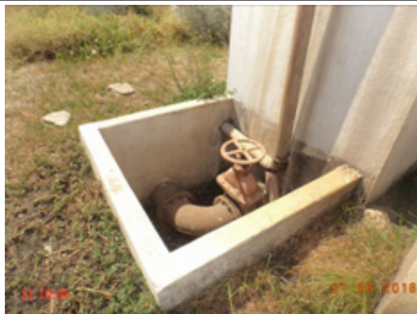
Foto 30 – ETE Herval: caixa de inspeção sem tampa ou grade danificada.
