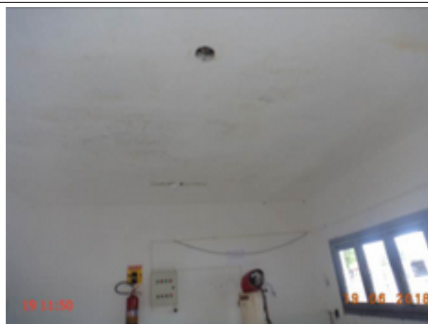
Foto 108 - ETA/Almoxarifado (Tapuiará): sem lâmpada instalada.
