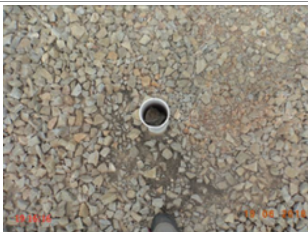
Foto 41 – RAP-03 (Sede): tubulação de ventilação inadequada.
