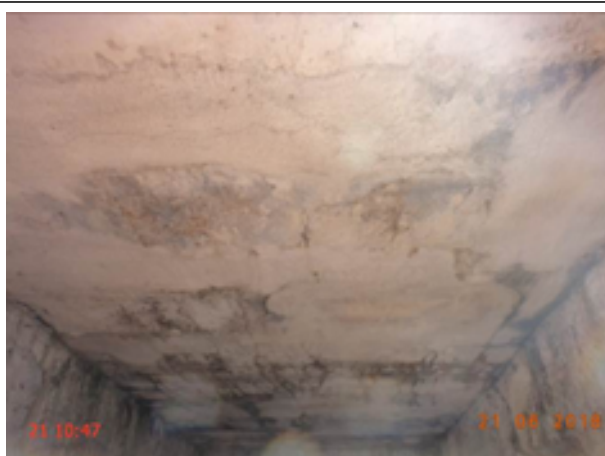
Foto 45 – EEE-06: pintura e reboco deteriorados e sem iluminação na casa de abrigo do quadro de comando.
