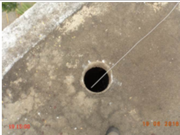
Foto 15 – REL-01 (Sede): ausência de tubulação de ventilação/perfuração na laje favorecendo a entrada indevida de águas pluviais.
