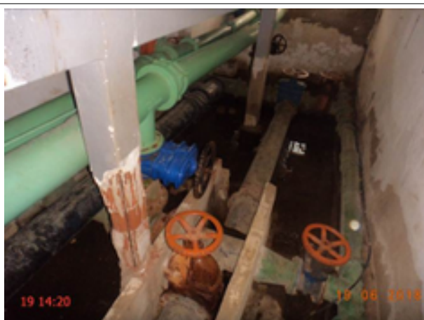
Foto 61 – ETA/Filtração (Sede): F-02 sinais de infiltração de água na parede e vazamento no registro..
