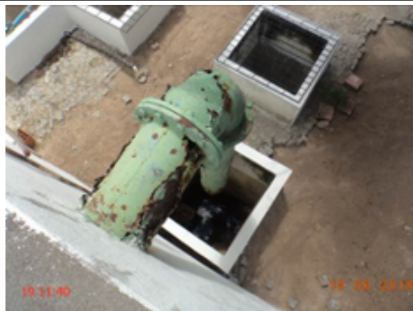
Foto 24 – RSE-02 (Tapuiará): tubo extravasador em processo de corrosão/ caixa de inspeção sem tampa ou grade de proteção.
