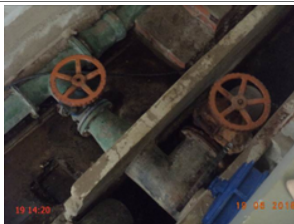
Foto 60 – ETA/Filtração (Sede): F-01 sinais de infiltração de água na parede e vazamento no registro..
