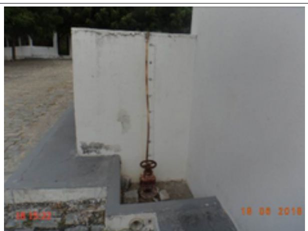
Foto 22 – RSE-01 (Juatama): caixa de inspeção sem tampa ou grade de proteção.
