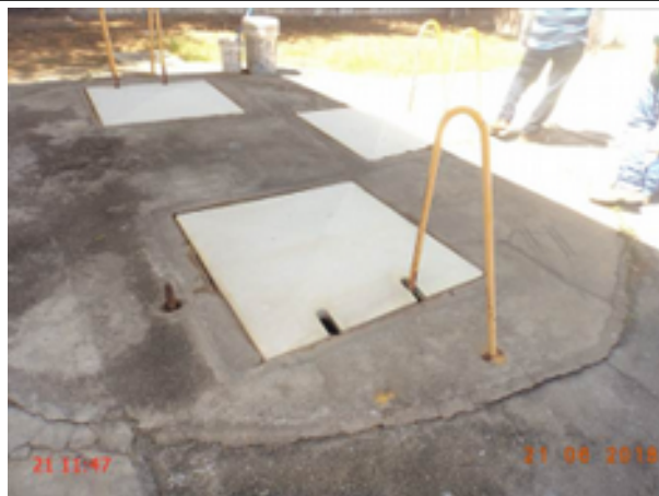
Foto 96 – EEE-01: escada do poço de sucção danificada.
