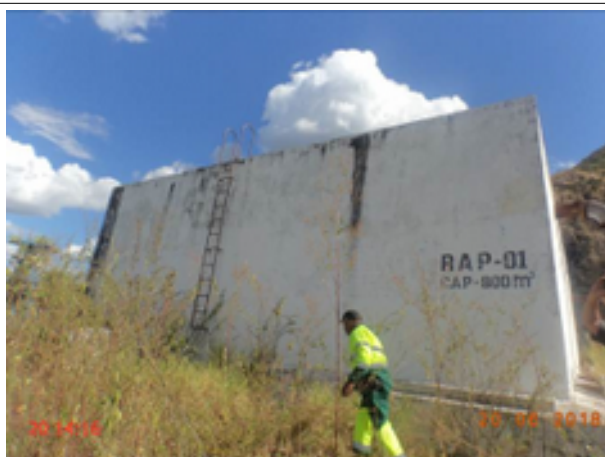
Foto 83 – RAP-01 (Sede): pintura deteriorada e vegetação excessiva.
