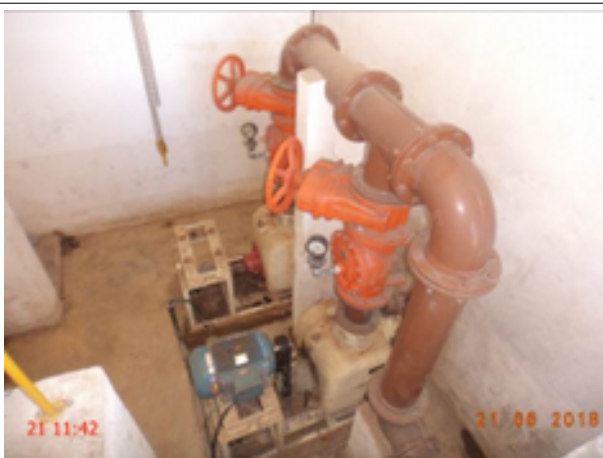
Foto 5 – EEE-02 (Sede): apenas uma das bombas instalada.
