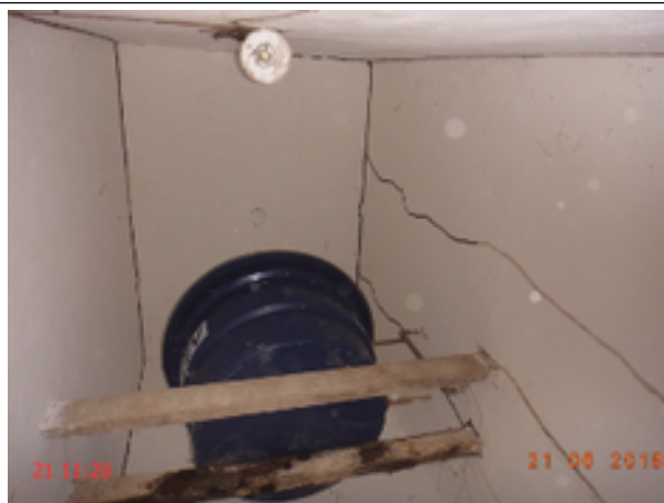
Foto 100 – EEE-04 (Sede): a lâmpada do banheiro não acende
