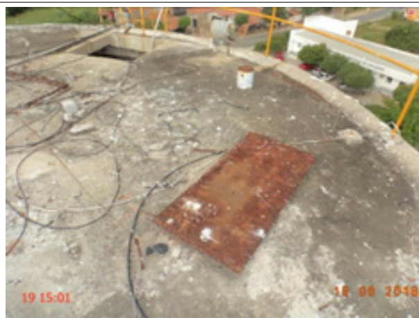
Foto 86 – REL-01 (Sede): acúmulo de lixo na laje de cobertura.
