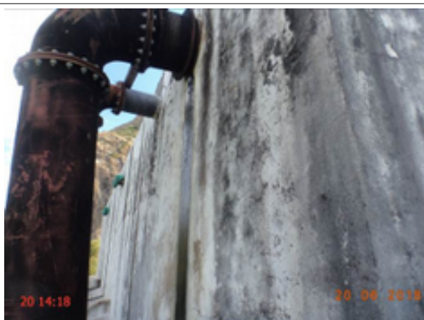
Foto 43 – RAP-01 (Sede): vazamento.
