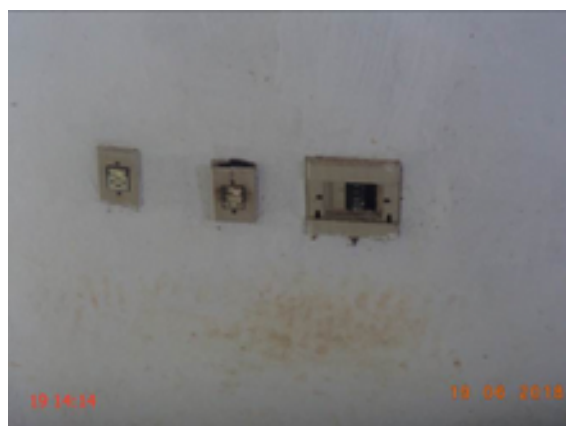
Foto 63 – ETA/Filtração (Sede): F-04 caixa de disjuntor sem tampa.
