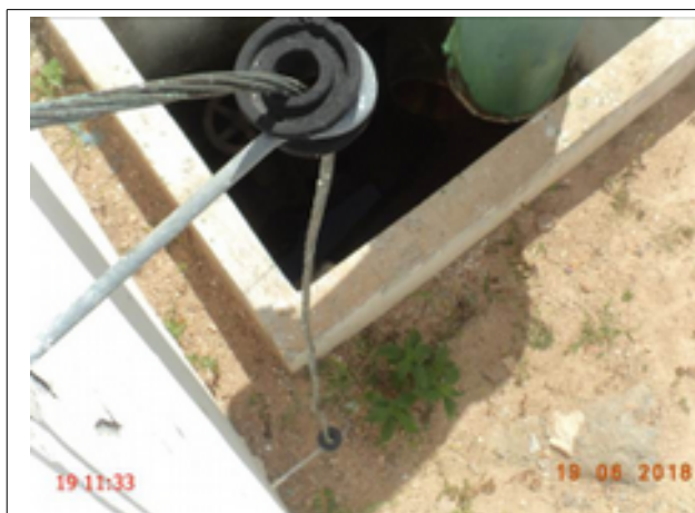
Foto 21 – RSE-01 (Tapuiará): instalação do para-raios sem isolamento.
