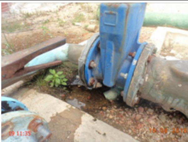
Foto 67 - ETA/Filtração (Tapuiará): F-01 vazamento no registro.
