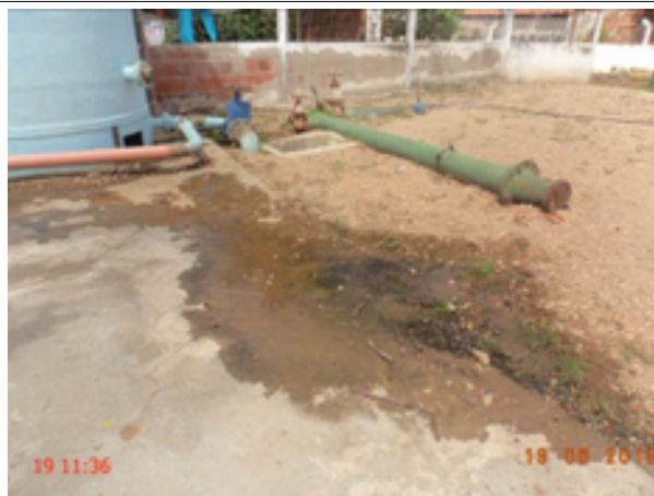
Foto 68 - ETA/Filtração (Tapuiará): vazamento entre a EELF-01 e o filtro F-01.
