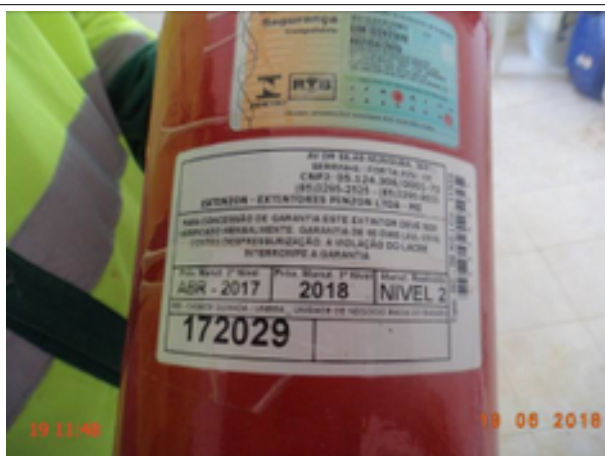
Foto 109 - ETA/Almoxarifado (Tapuiará): extintor de incêndio com data de validade da recarga vencida.
