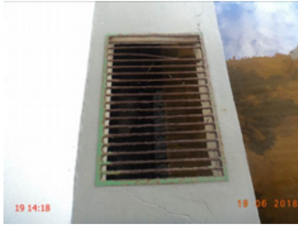
Foto 58 – ETA/Filtração (Sede): F-03 grade danificada.
