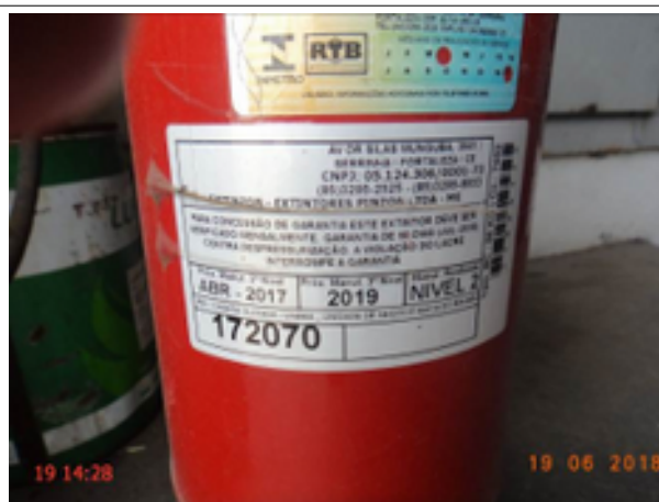
Foto 50 - EEAT-01/02 (Sede): extintor com data de validade vencida.
