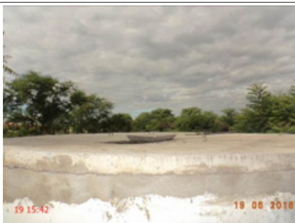
Foto 93 – RAP-04 (Sede): tampa aberta/sem tubulação de ventilação.
