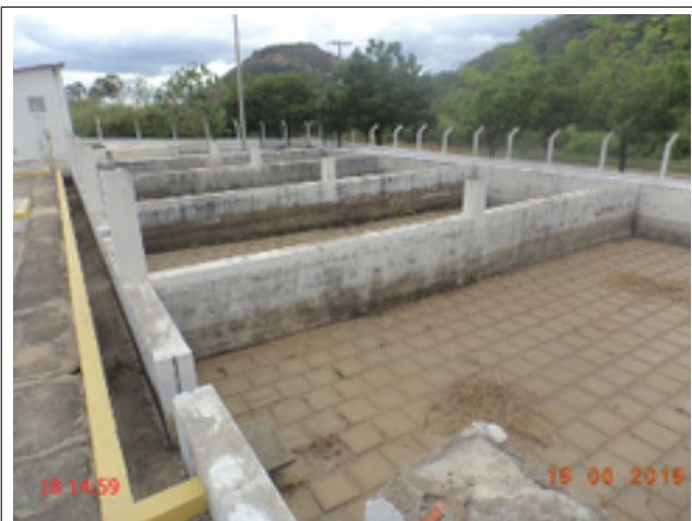
Foto 116 – ETA (Juatama) ETRG desativada.
