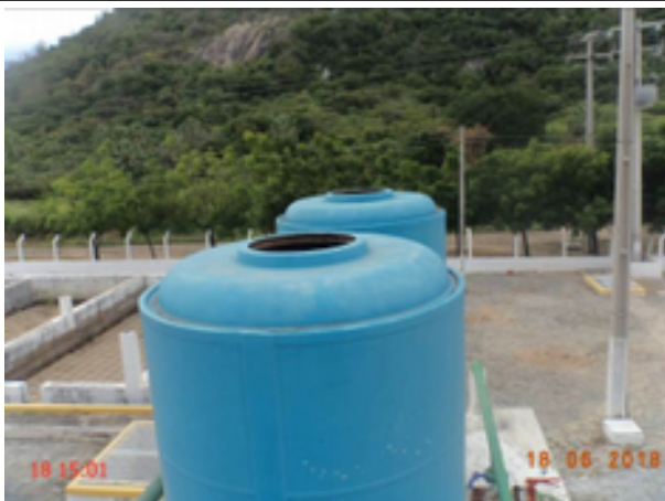
Foto 3 – ETA/Filtração (Juatama): F-02 e F-03 com abertura de inspeção sem tampa.
