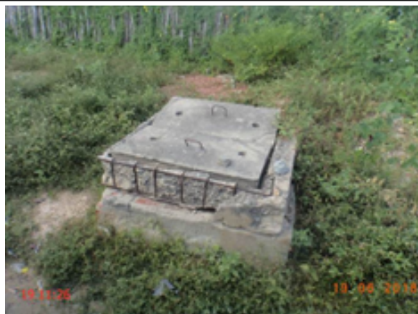
Foto 106 – AAB (Tapuiará): caixa do registro de descarga danificada.
