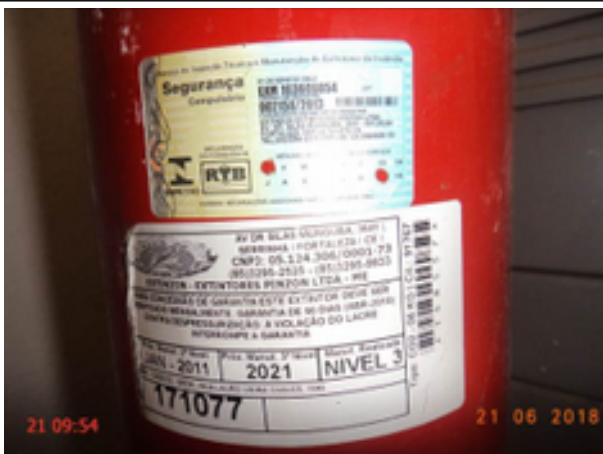
Foto 105 – EEE-ETE Herva (Sede): extintor de incêndio com data de validade da recarga vencida.
