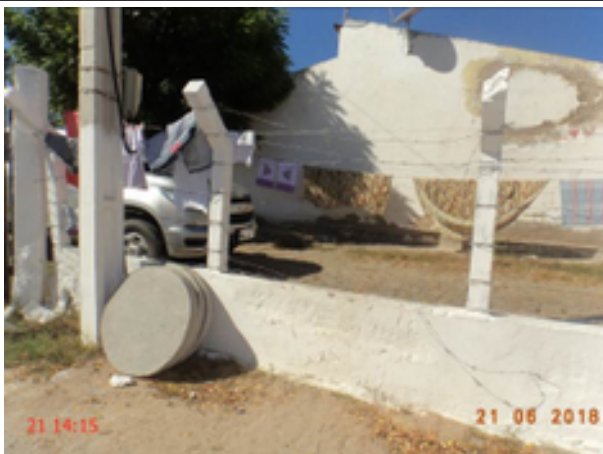
Foto 29 – ETE : Chico Braz: cerca danificada.
