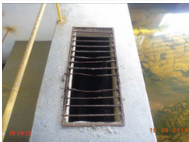
Foto 59 – ETA/Filtração (Sede): F-06 grade danificada.
