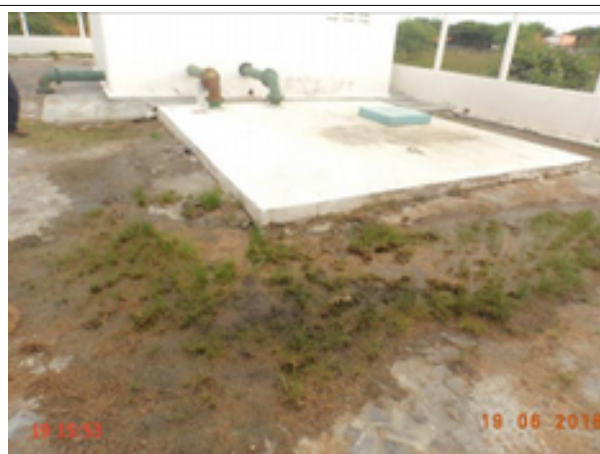
Foto 14 – REN-01 (Sede): sem identificação/ sem tubulação de ventilação/ sinais de vazamento.
