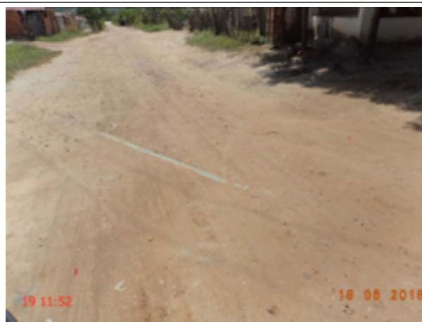
Foto 74 – RDA (Tapuiará): tubulação exposta.
