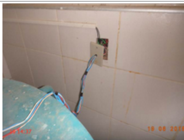
Foto 112 - ETE/Casa de química (Sede): instalações elétricas inadequadas.
