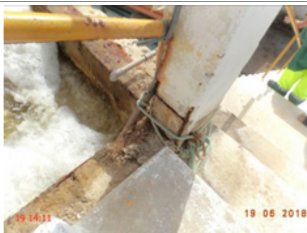
Foto 98 – ETA/Decantação (Sede): armaduras expostas na coluna da escada de acesso do decantador.
