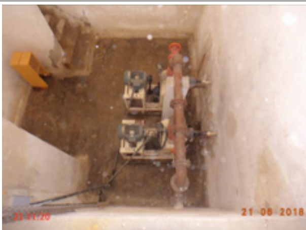
Foto 7 – EEE-04 (Sede): apenas uma das bombas instalada.
