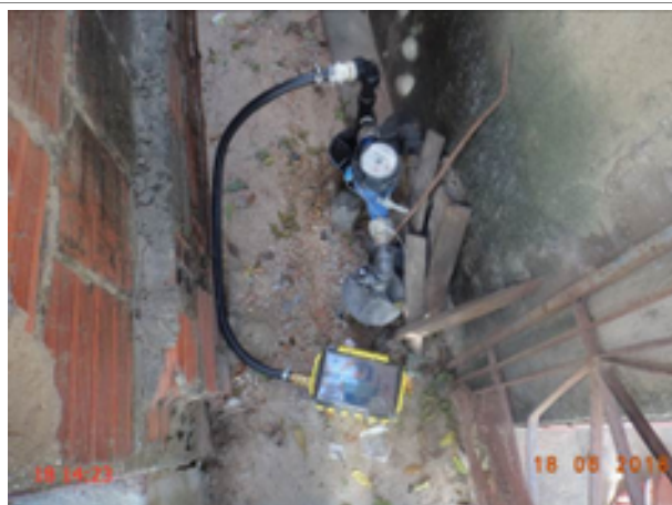
Foto 121 – RDA (Sede): datalogger instalado no endereço Rua da Estrela, nº 499 – Campo Novo.
