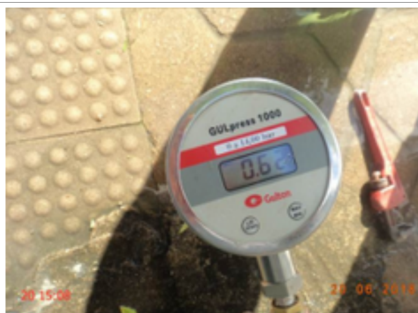
Foto 123 – RDA (Sede): medição instantânea de pressão no endereço Rua José Jucá, nº 523.
