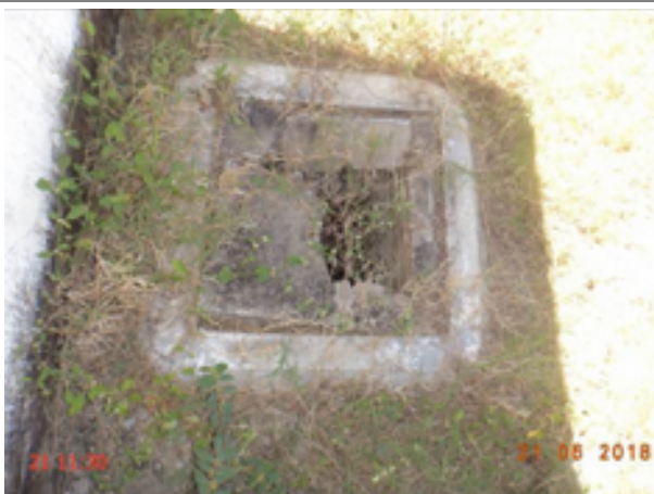
Foto 25 – EEE-03 (SES): caixa de inspeção com a tampa danificada.
