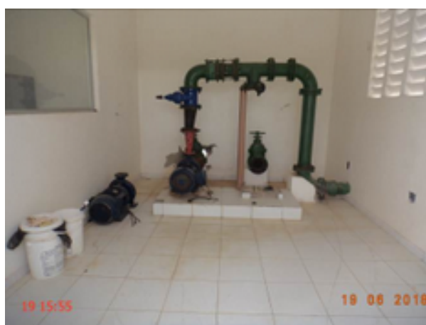
Foto 18 - EEAT-04 (Sede): apenas uma das bombas instaladas..
