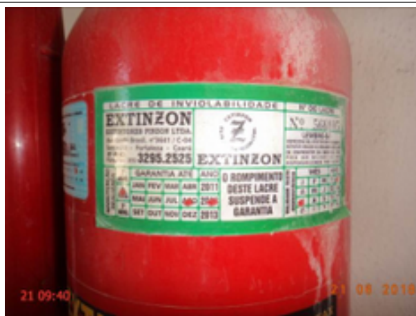
Foto 104 – EEE-05 (Sede): extintor de incêndio com data de validade da recarga vencida.
