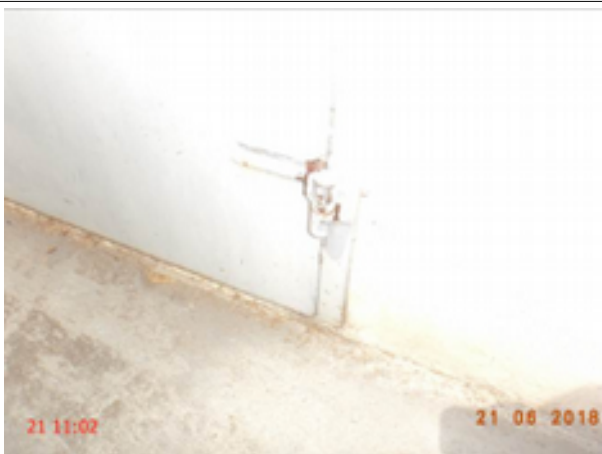
Foto 27 – EEE-01 (SES): portão danificado na casa de abrigo do gerador de energia elétrica.
