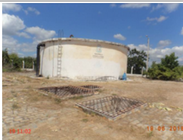
Foto 82 – RSE-01 (Sede): pintura deteriorada.
