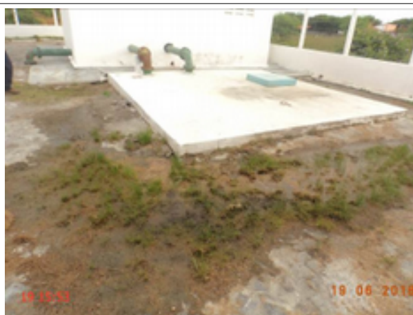
Foto 44 – REN-01(Sede: sem identificação/ sem tubulação de ventilação/ sinais de vazamento.
