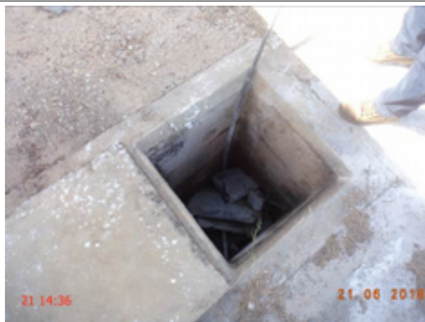
Foto 32 – ETE COHAB: caixa de inspeção sem tampa.
