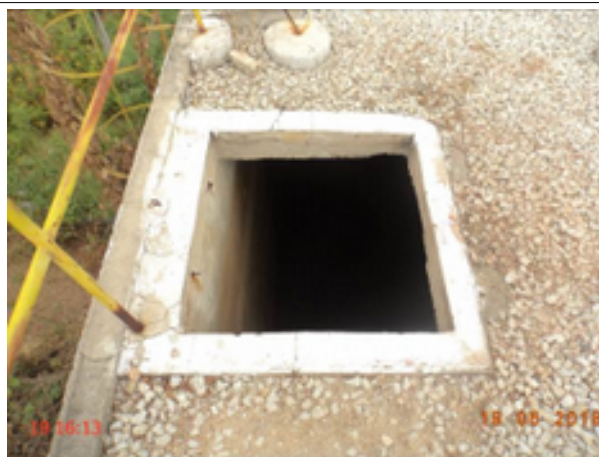
Foto 20 – RAP-03 (Sede): abertura de inspeção sem tampa.
