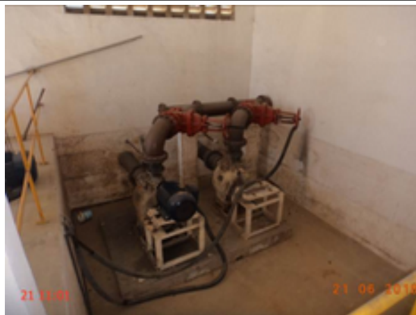
Foto 4 – EEE-01 (Sede): apenas uma das bombas instalada.
