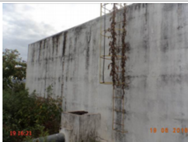
Foto 84 – RAP-03 (Sede): pintura deteriorada/sem identificação.
