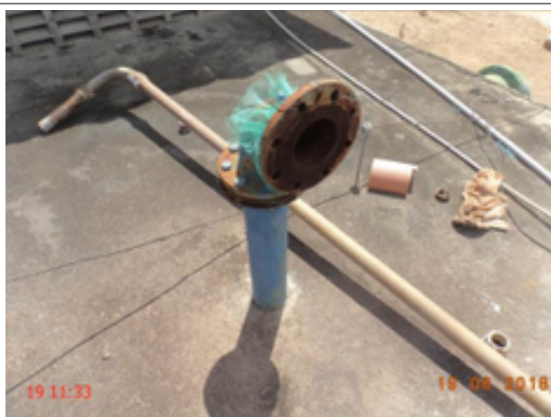
Foto 91 – RSE-01 (Tapuiará): tubulação de ventilação sem tela de proteção.
