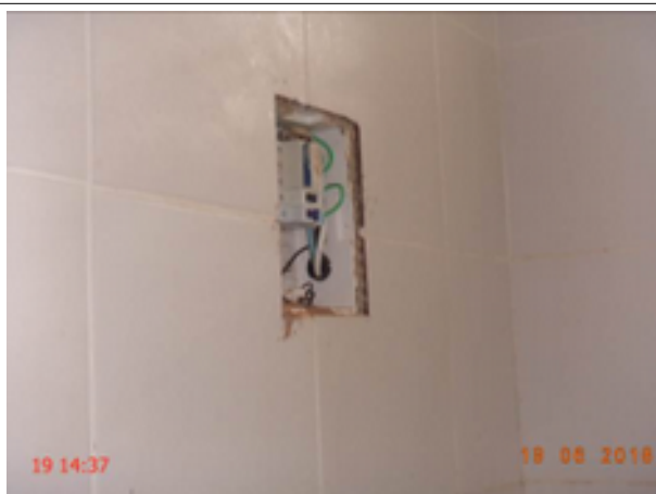
Foto 113 – ETE/Casa de química (Sede): quadro do disjuntor sem tampa.
