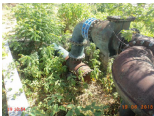
Foto 107 - AAB (Sede): caixa de inspeção sem tampa ou grade de proteção, localizada entre a captação e o reservatório RSE-01.
