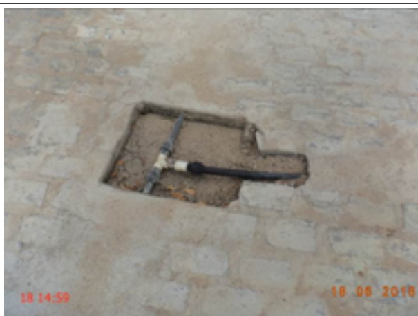
Foto 87 – ETA (Juatama): caixa de inspeção sem tampa ou grade de proteção.
