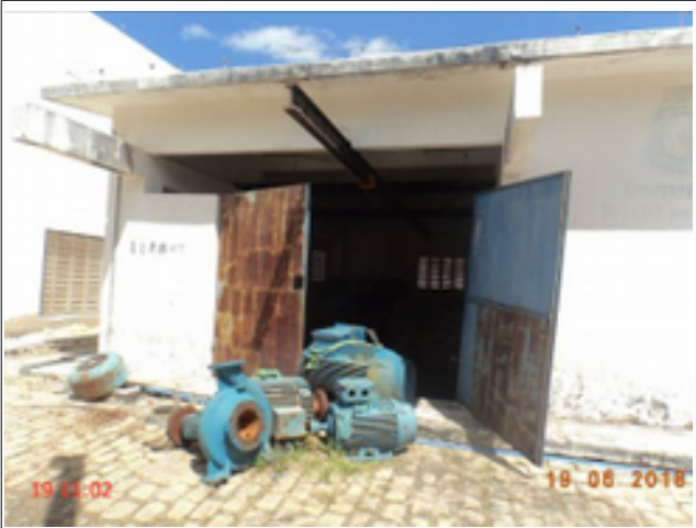
Foto 125 – EEAB-01 (Sede): identificação pouco visível.
