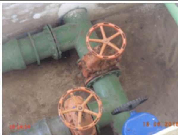
Foto 70 - ETA/Filtração (Sede): F-05 vazamento no registro.
