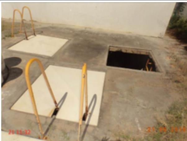
Foto 95 – EEE-03 (Sede): escadas do poço de sucção danificadas. E tampa aberta.
