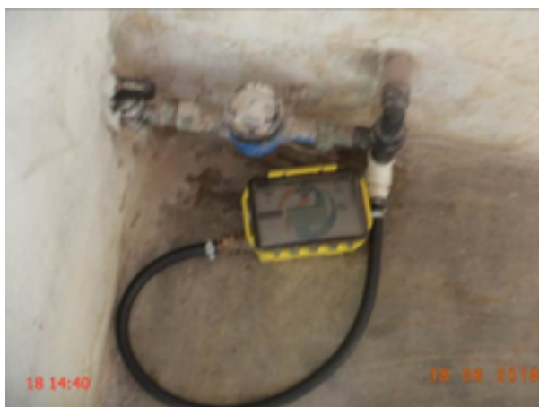
Foto 122 – RDA (Sede): datalogger instalado no endereço Rua Augusto Carloto Ribeiro, nº 314 – COHAB.
