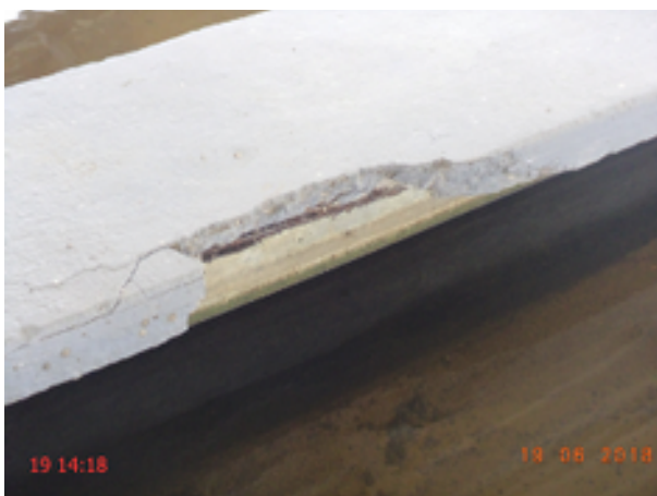
Foto 57 – ETA/Filtração (Sede): F-02 há armaduras expostas.
