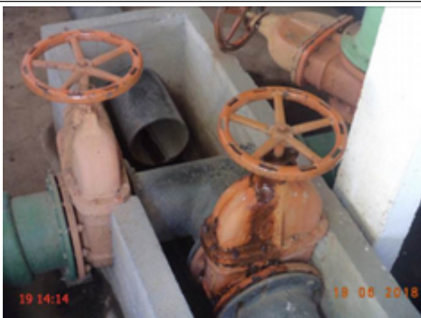
Foto 69 - ETA/Filtração (Sede): F-04 vazamento no registro.
