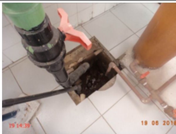
Foto 46 – ETA/Laboratório (Sede): caixa de inspeção sem tampa.
