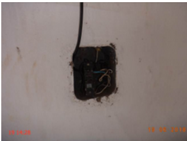
Foto 65 - EEAT-01 (Sede): quadro do disjuntor sem tampa.
