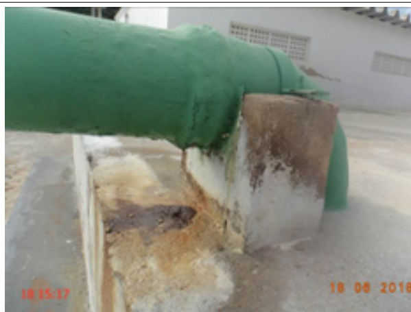
Foto 42 – RSE-01 (Juatama): vazamento na tubulação de entrada de água.
