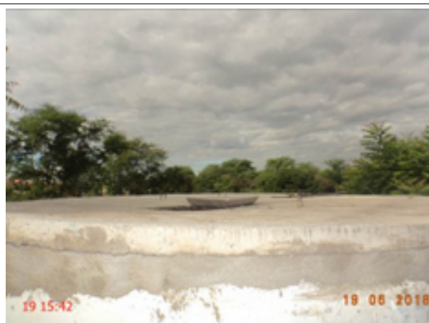
Foto 13 – RAP-04 (Sede): tampa aberta/sem tubulação de ventilação.
