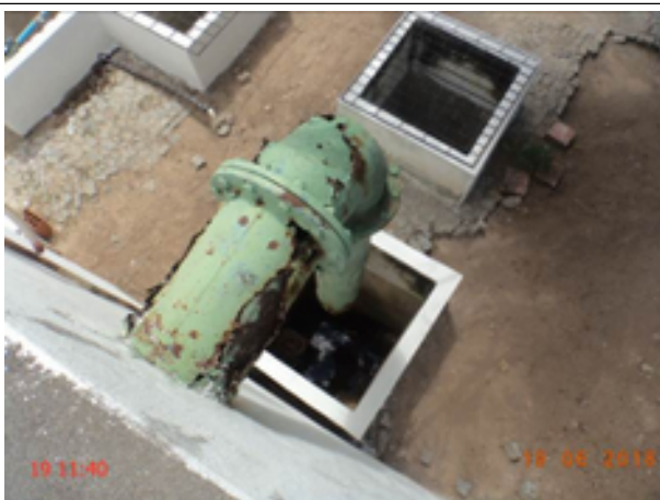
Foto 81 – RSE-02 (Tapuiará): tubo extravasor em processo de corrosão/ caixa de inspeção sem tampa ou grade de proteção.
