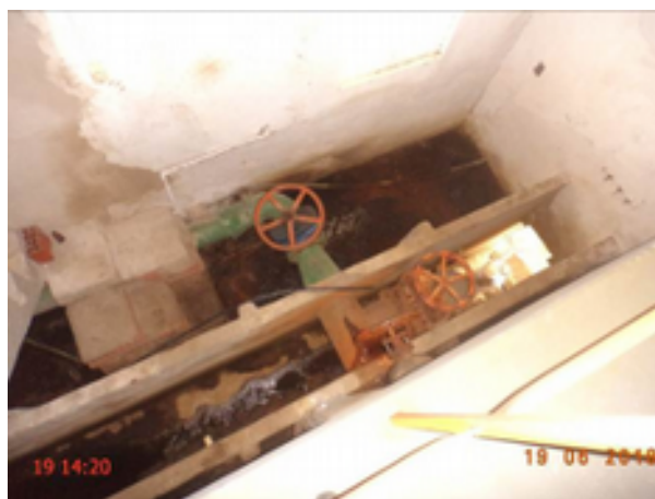
Foto 62 – ETA/Filtração (Sede): F-03 sinais de infiltração de água na parede.
