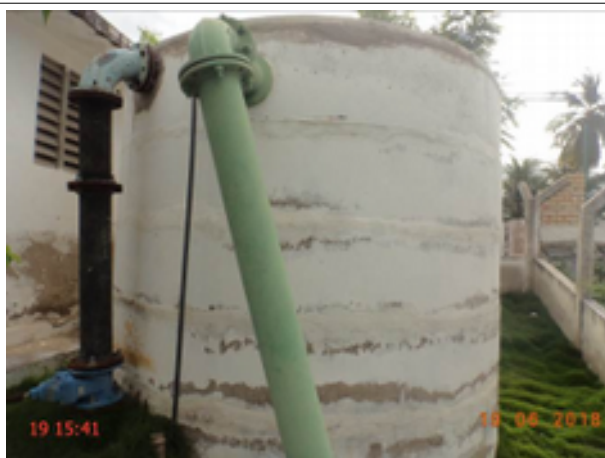
Foto 85 – RAP-04 (Sede): pintura deteriorada/sem identificação.
