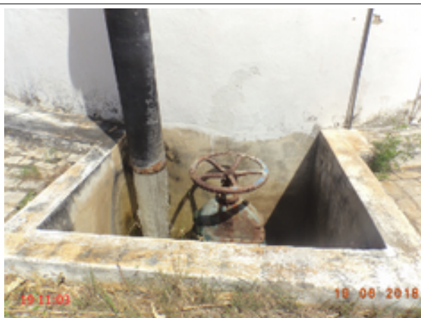
Foto 51 – RSE-01 (Sede): reservatório extravasando.
