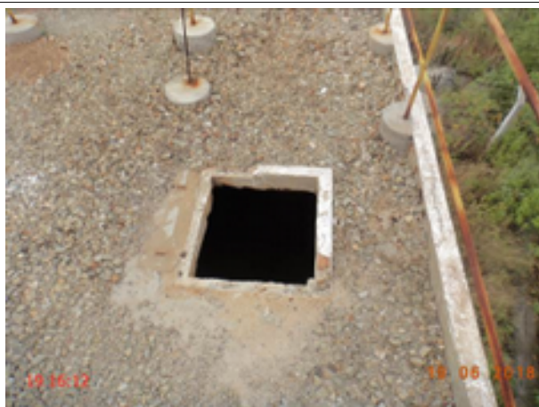
Foto 19 – RAP-02 (Sede): abertura de inspeção sem tampa
