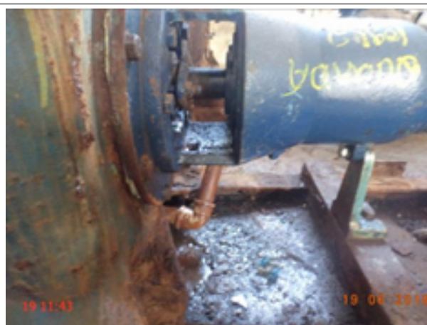
Foto 52 – EELF-01(Tapuiará): vazamento na gaxeta da bomba.
