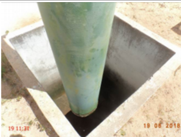
Foto 23 – RSE-01 (Tapuiará): caixa de inspeção sem tampa ou grade de proteção.
