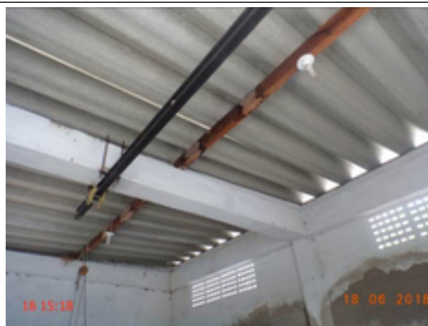
Foto 64 – EEAT-01 (Juatama): lâmpada da casa de abrigo não acendendo.
