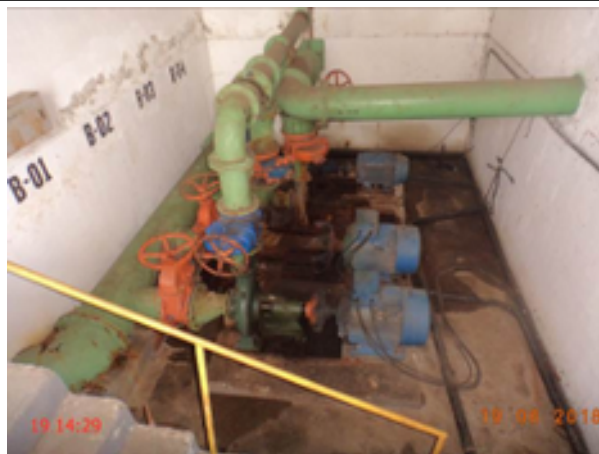
Foto 16 – EEAT-02 (Sede): apenas uma das bombas instaladas.
