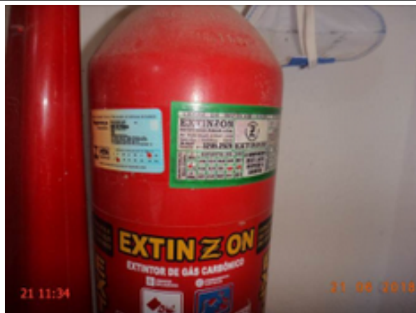
Foto 102 – EEE-03 (Sede): extintor de incêndio com data de validade da recarga vencida.
