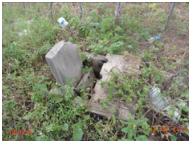
Foto 71 – RDA (Juatama): caixa do registro de descarga da Rua Joaquim Medeiros (2) danificada.
