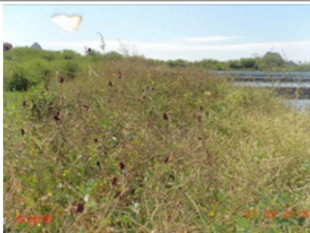
Foto 39 – ETE Herval: vegetação excessiva nos taludes das lagoas de maturação.
