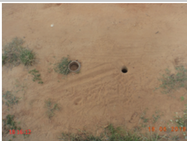
Foto 73 – RDA (Juatama): registro de descarga localizado na CE da Biodisel soterrado.
