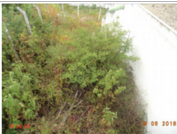
Foto 115 – RAP-03 (Sede): vegetação excessiva.
