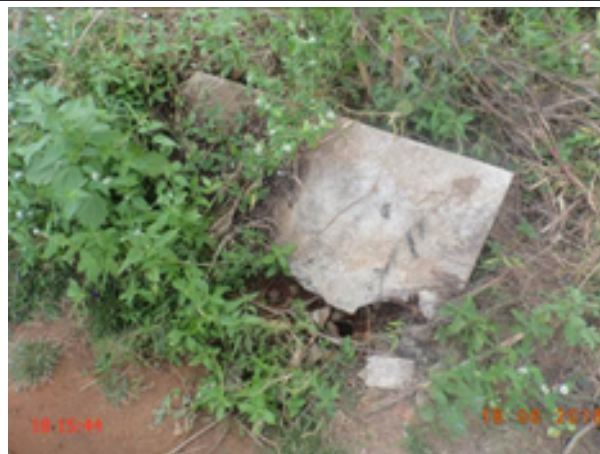
Foto 72 – RDA (Juatama): caixa do registro de descarga da Rua Joaquim Medeiros (3) danificada.
