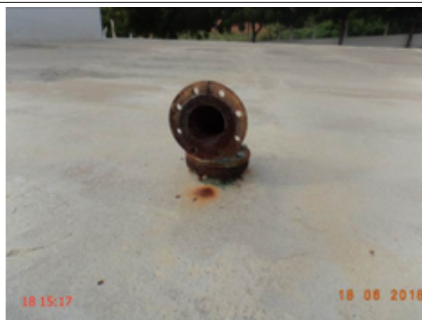
Foto 90 – RSE-01 (Juatama): tubulação de ventilação sem tela de proteção.
