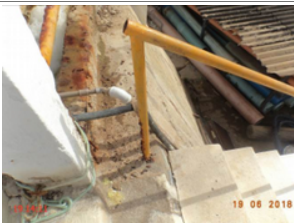
Foto 97 – ETA/Decantação (Sede): guarda corpo da escada de acesso sem fixação adequada e em processo de corrosão.
