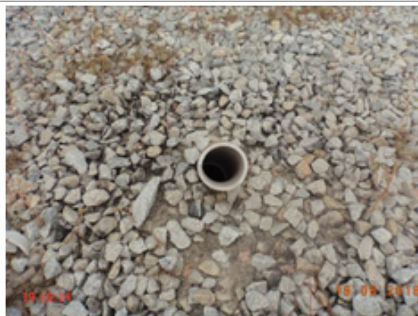
Foto 40 – RAP-02 (Sede): tubulação de ventilação inadequada.
