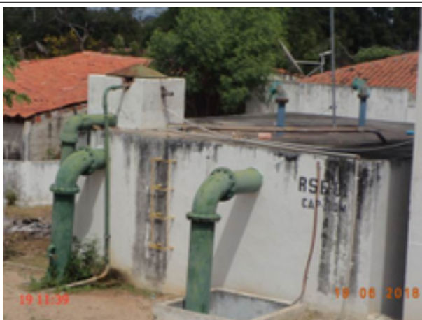
Foto 79 – RSE-01 (Tapuiará): pintura deteriorada.
