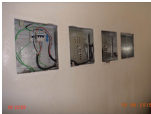
Foto 66 - EEAT-04 (Sede): quadro do disjuntor sem tampa.
