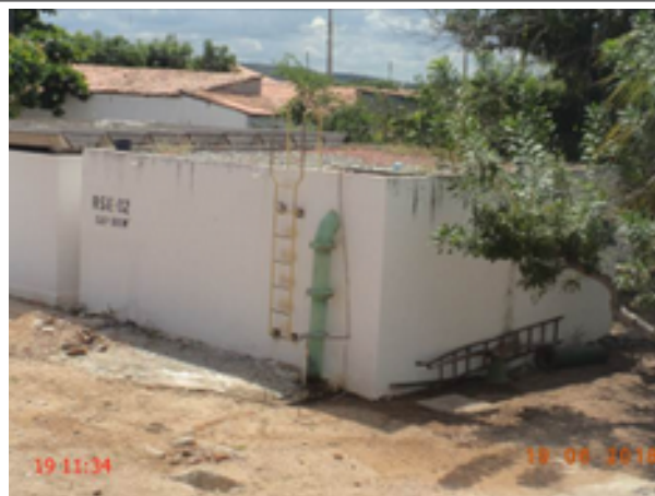
Foto 12 – RSE-02 (Tapuiará): pintura deteriorada e sem tubulação de ventilação.
