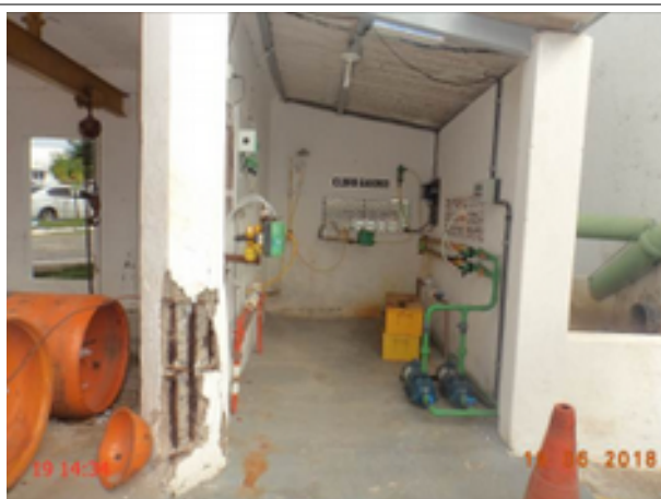
Foto 111 - ETA/Casa de química (Sede): colunas danificadas e com armaduras expostas na área de dosagem do cloro gasoso.
