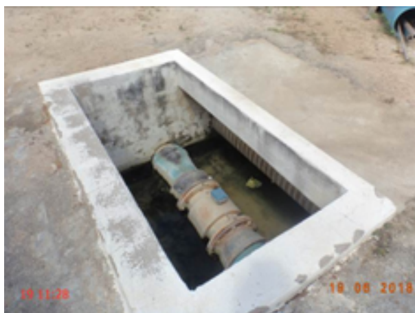
Foto 89 – ETA (Tapuiará): caixa de inspeção sem tampa e alagada.
