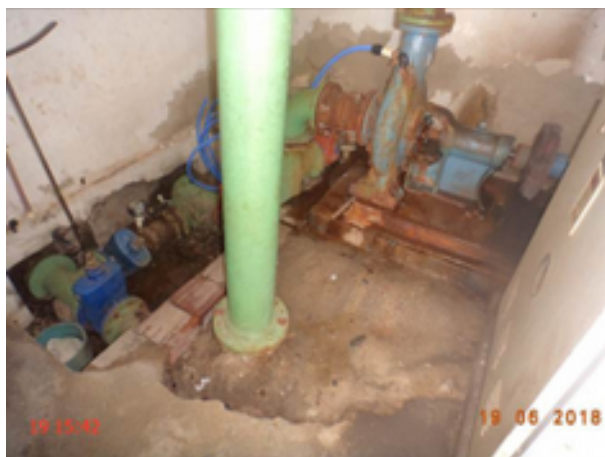
Foto 17 - EEAT-03 (Sede): apenas uma bomba instalada.
