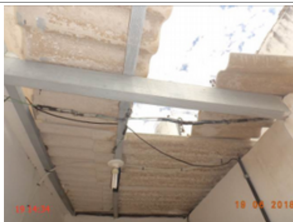
Foto 110 - ETA/Casa de química (Sede): telhado danificado na área de dosagem do cloro gasoso/lâmpada não está acendendo.
