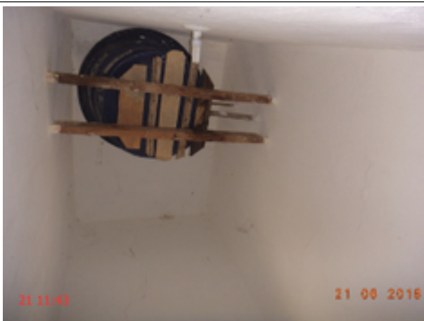
Foto 99 – EEE-02 (Sede): a lâmpada do banheiro não acende
