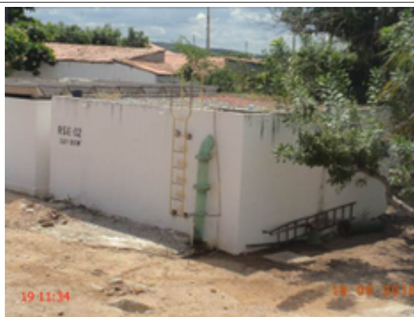
Foto 80 – RSE-02 (Tapuiará): pintura deteriorada.
