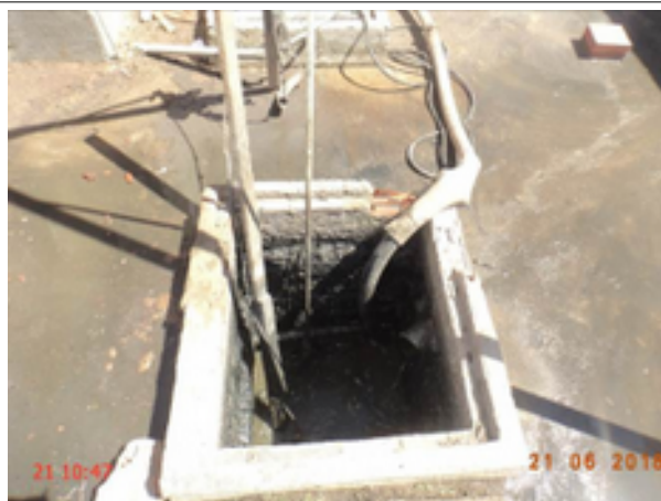
Foto 8 – EEE-06 (Sede): apenas uma das bombas instalada.
