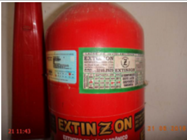
Foto 101 – EEE-02 (Sede): extintor de incêndio com data de validade da recarga vencida.
