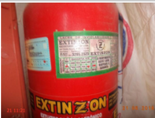
Foto 103 – EEE-04 (Sede): extintor de incêndio com data de validade da recarga vencida.
