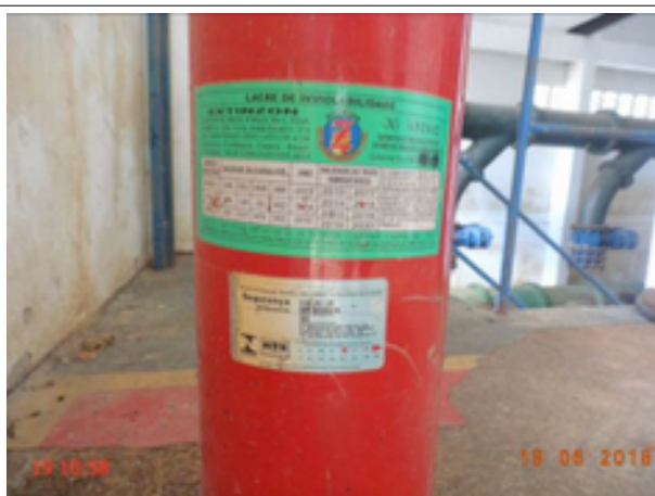
Foto 49 – EEAB-01 (Sede): extintor com data de validade vencida.
