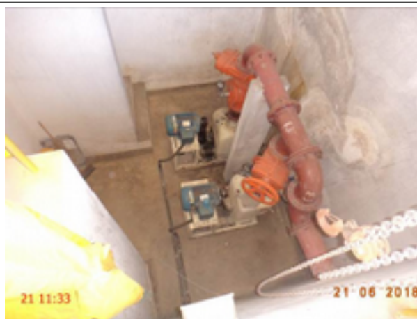
Foto 6 – EEE-03 (Sede): apenas uma das bombas instalada.
