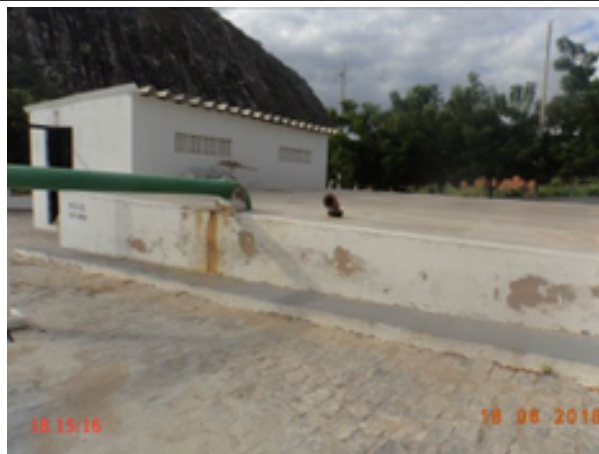
Foto 78 – RSE-01 (Juatama): pintura deteriorada.
