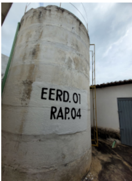
Foto 11 - RAP-04: Escada sem gaiola de proteção.
