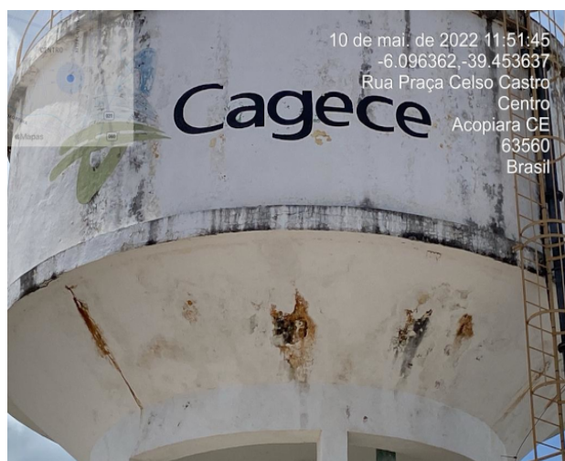
Foto 3 - REL-02: Sinais de corrosão da base.
