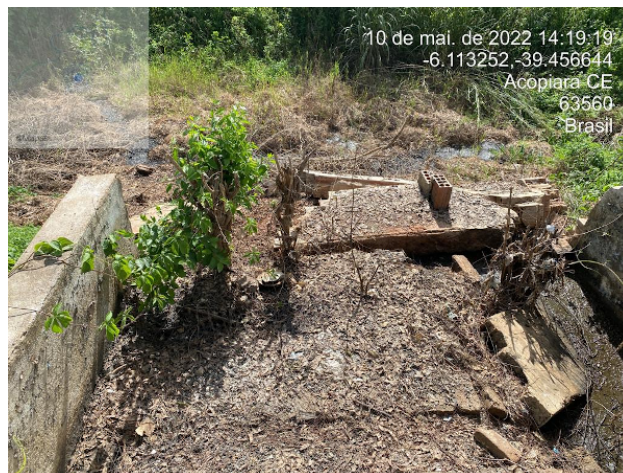
Foto 10 - ETE: Rompimento do leito de secagem.
