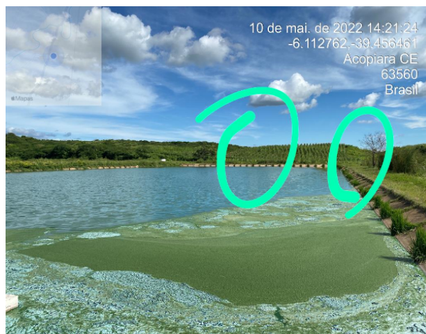
Foto 8 - ETE: Comprometimento de placas dos taludes da LF e LM.
