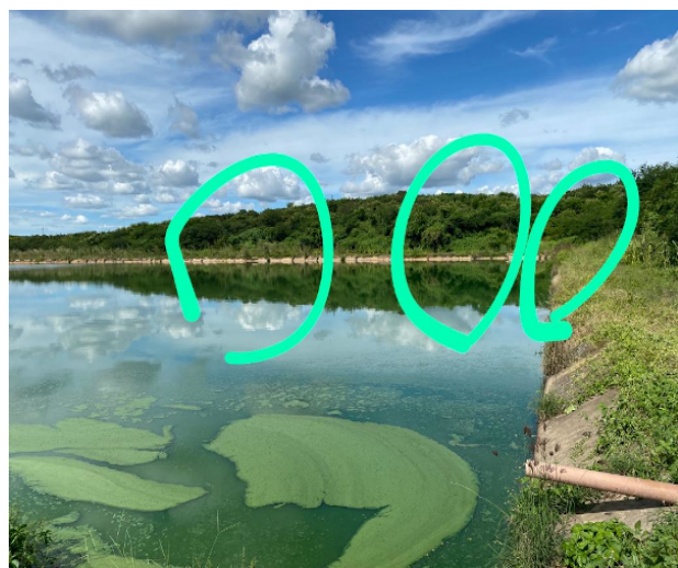
Foto 5 - ETE: Comprometimento de placas dos taludes da LF e LM.
