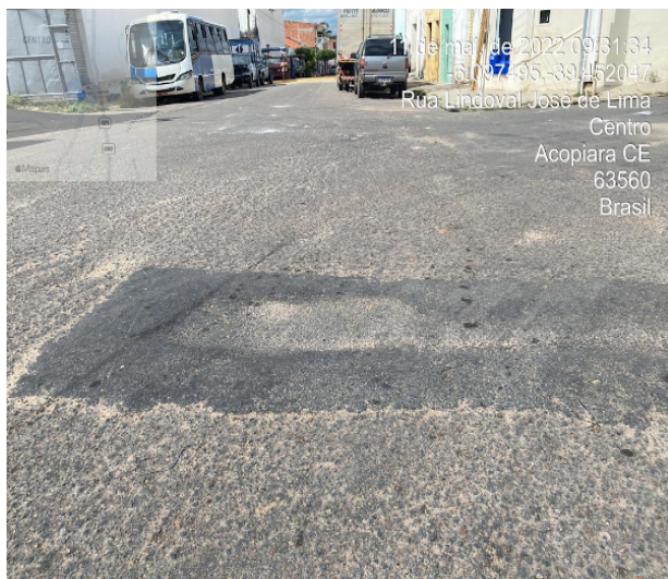
Foto 17 - Rua Lindoval José de Lima, Centro: pavimento sem recuperação.
