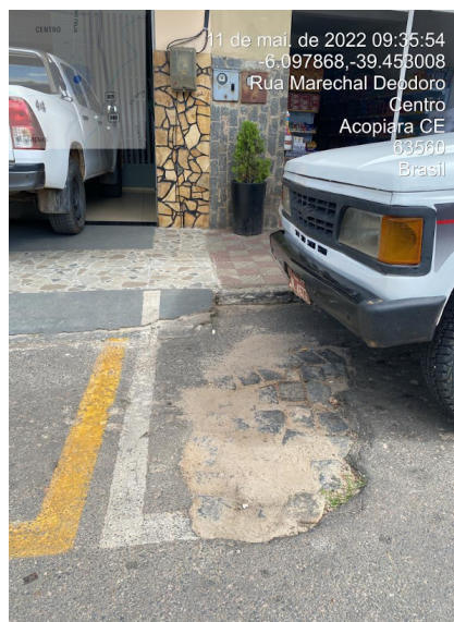
Foto 14 - Rua Marechal Deodoro, Centro: pavimento sem recuperação.
