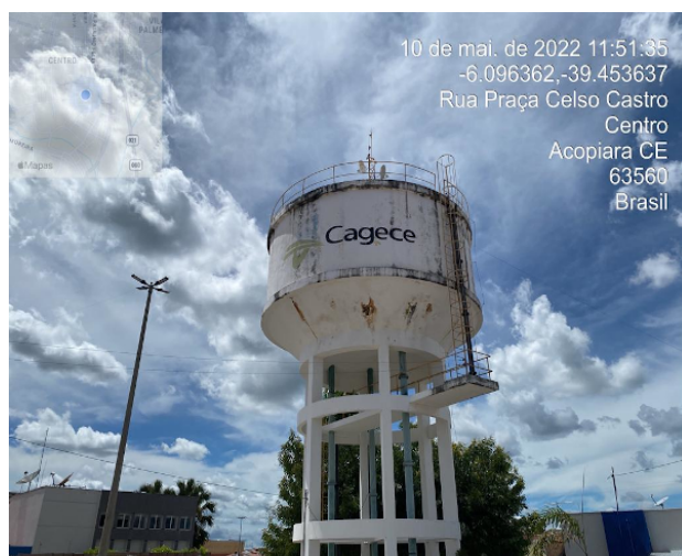
Foto 4 - REL-02: Sinais de corrosão da base.
