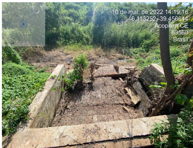
Foto 9 - ETE: Rompimento do leito de secagem.
