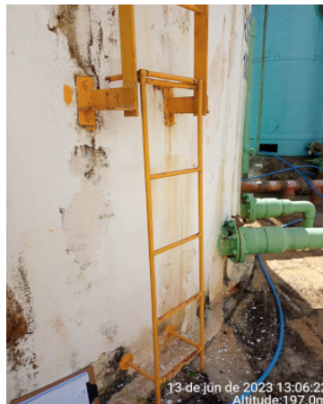
Foto 15 - RSE-01: apresenta vazamentos, pintura deteriorada, escada corroída, amarrada com arame e com a base solta.
