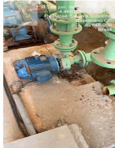
Foto 7 - EEAT-01: não possui bomba reserva e a base está em péssimo estado de conservação.
