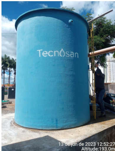
Foto 1 - ETA: Filtro F-06 sem identificação.
