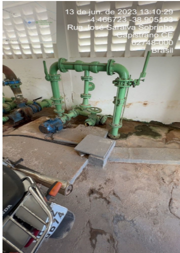
Foto 6 - EEAT-01: não possui bomba reserva e a base está em péssimo estado de conservação.
