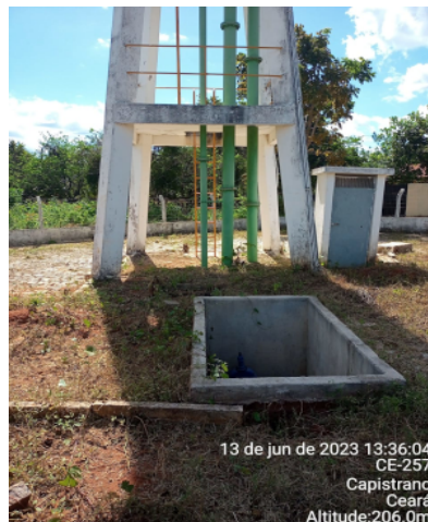
Foto 19 - REL-02: caixas sem tampas.
