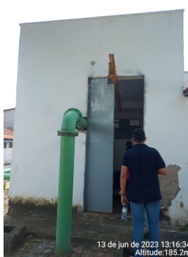
Foto 17 - ETA: casa de bomba com parede deteriorada.
