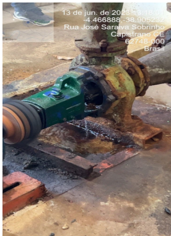
Foto 8 - EEAT-02: bomba com vazamento.
