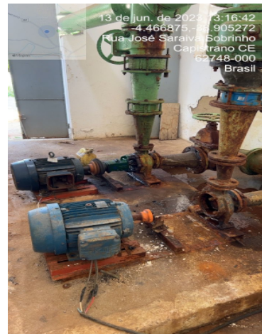
Foto 9 - EEAT-02: bomba reserva fora de operação.
