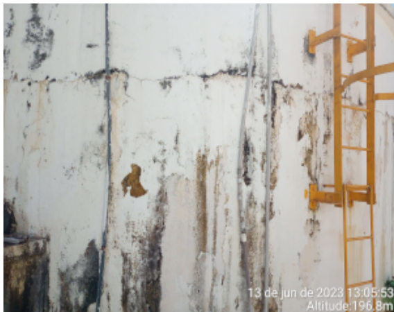
Foto 14 - RSE-01: apresenta vazamentos, pintura deteriorada, escada corroída, amarrada com arame e com a base solta.
