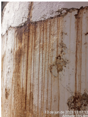
Foto 12 - RSE-01: apresenta vazamentos, pintura deteriorada.
