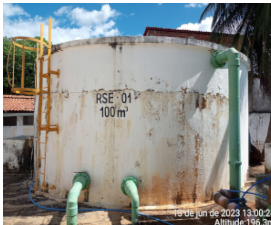
Foto 13 - RSE-01: apresenta vazamentos, pintura deteriorada, escada corroída, amarrada com arame e com a base solta.
