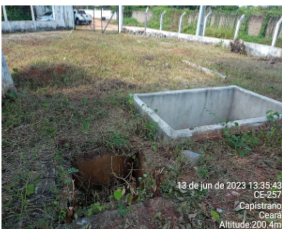
Foto 20 - REL-02: caixa sem tampa.
