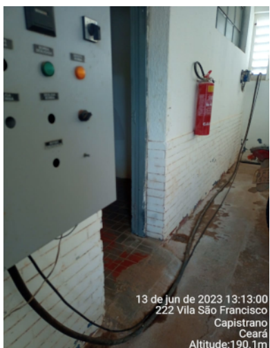
Foto 16 - ETA (EELF): instalações elétricas inadequadas (cabo exposto na passagem).
