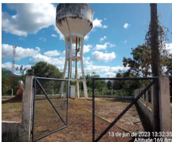
Foto 5 - REL-02: ausência de identificação.
