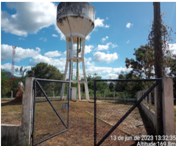
Foto 18 - REL-02: pintura deteriorada.
