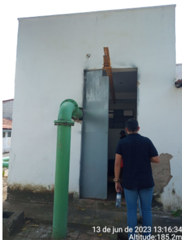
Foto 3 - ETA: sala de bombas sem identificação.
