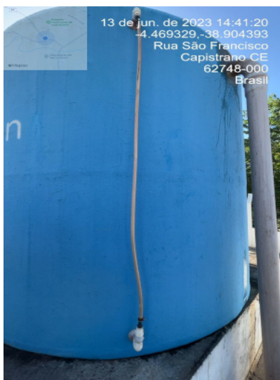
Foto 10 - RAP-02: Mangueira de nível opaca.
