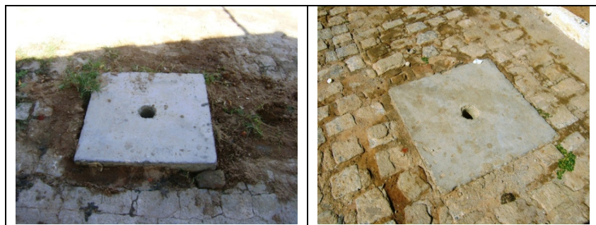
Fotos 52 e 53 – Registros de descarga na Rua Josina Ângelo.
