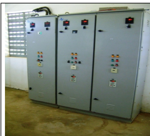
Foto 23 – Quadros de comando da EEAT-01, EE do PT-03 e bomba submersa do RAP-02
