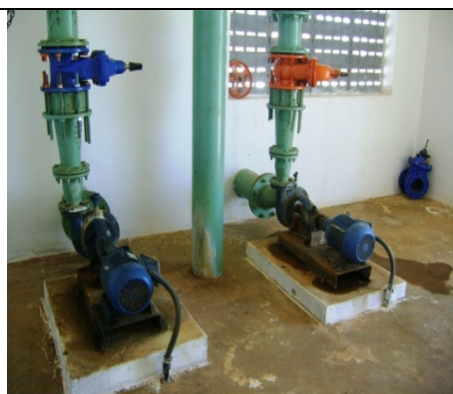
Foto 22 – EEAT-02 – conjuntos motores-bomba.
