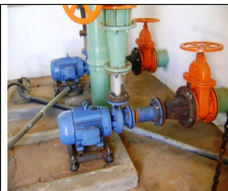
Foto 21 – EEAT-01 – conjuntos motores-bomba.
