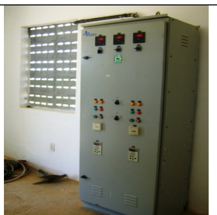
Foto 24 – Quadro de comando da EEAT-02
