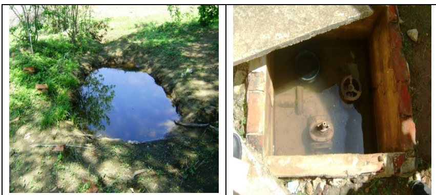
Fotos 40 e 41 – Medidor proporcional e registro na adutora de água tratada.
