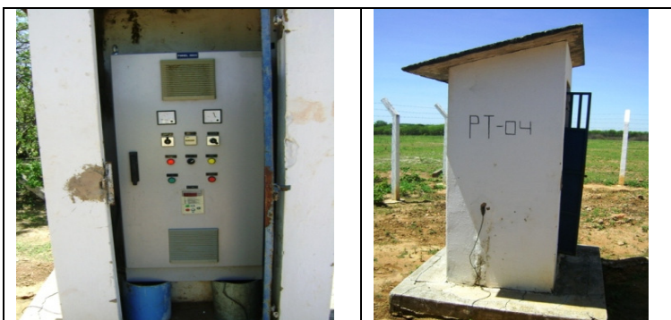
Fotos 25 e 26 – PT-04 - Quadro de comando e casa de proteção.
