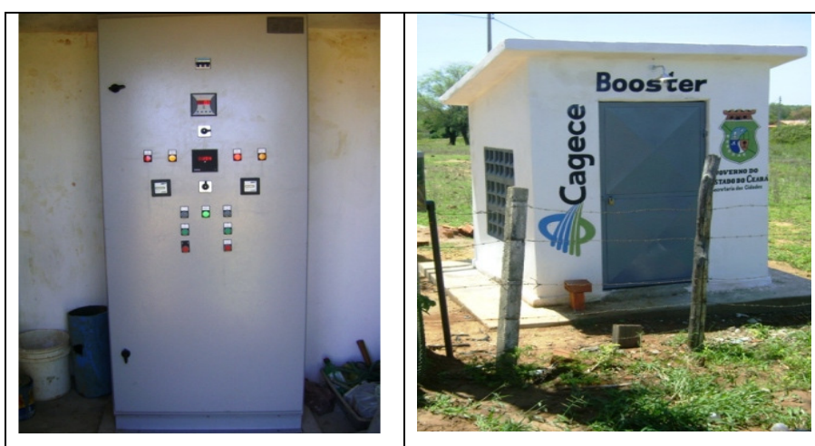
Fotos 27 e 28 – Booster - Quadro de comando e casa de proteção.
