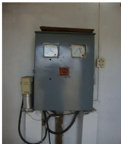
Foto 24 – Quadro de comando do poço PT-06 com horímetro danificado.
