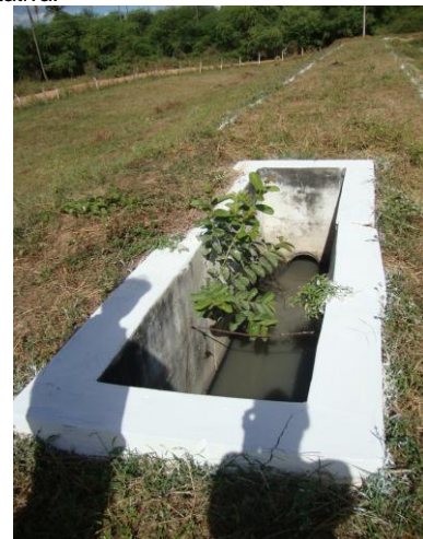
Foto 101 – Poço de recepção de esgoto na lagoa facultativa, sem tampa.
