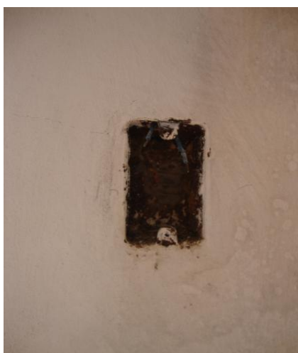
Foto 11 – PT-03 sem interruptor para a luminária interna.
