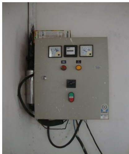
Foto 20 – Quadro de comando do poço PT-05.
