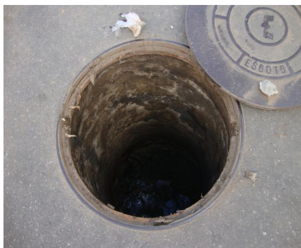
Foto 81 – PV no centro de Mauriti.
