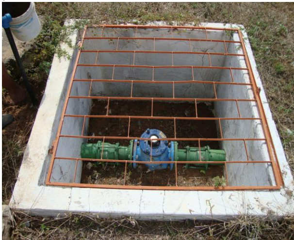
Foto 49 – Caixa de inspeção do macromedidor de água bruta na chegada do REL-03.
