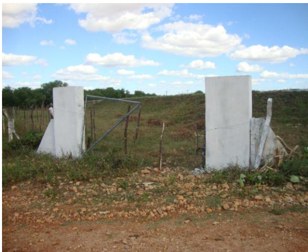
Foto 94 – Entrada da ETE sem placa de identificação e divulgação da licença de operação.
