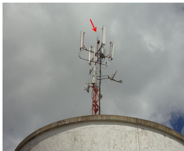
Foto 54 – REL-01 (desativado): com existência de para-raios e sinalizador noturno.
