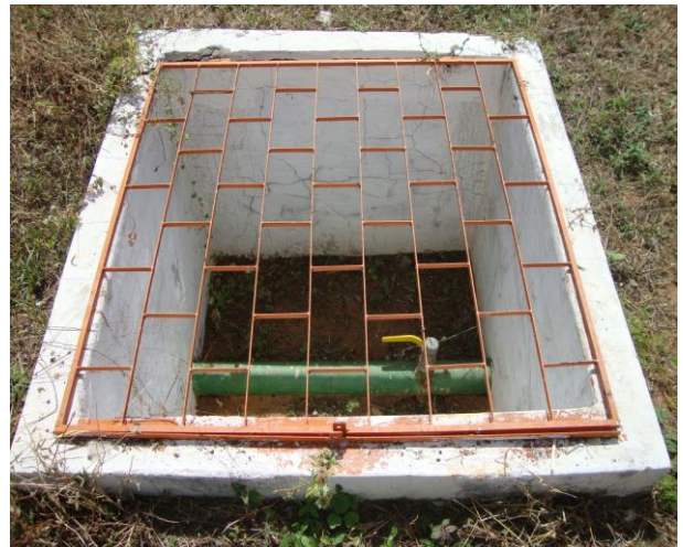
Foto 48 – Estação pitométrica de água bruta na saída do PT-06.
