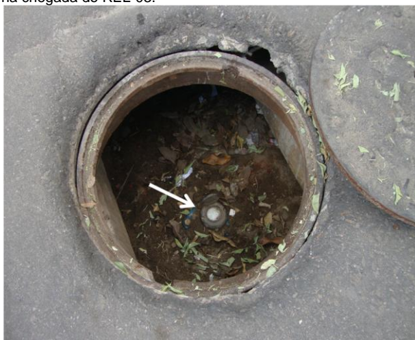
Foto 51 – Caixa de inspeção do macromedidor de água tratada dos poços PT-01, 04 e 05.
