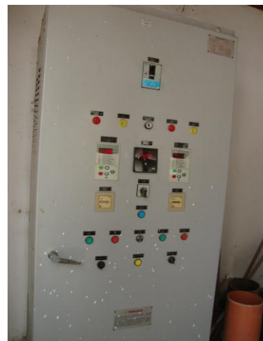
Foto 89 – Quadro de comando das bombas.
