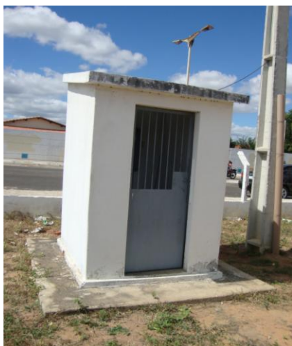
Foto 23 – Casa de abrigo do quadro de comando do PT-06.
