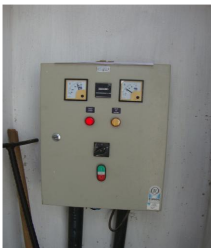
Foto 27 – Quadro de comando do poço PT-07.
