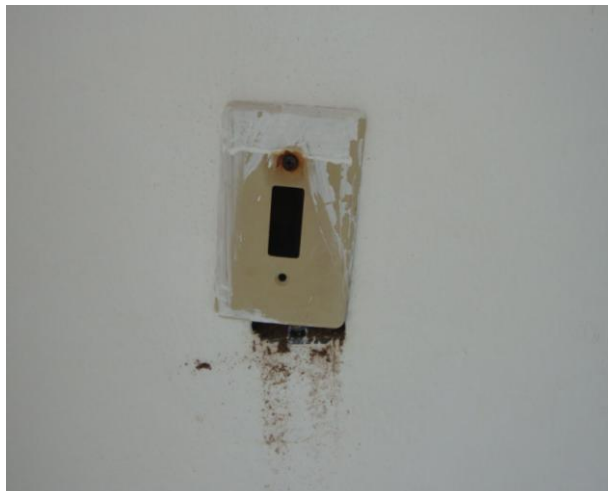
Foto 36 – Casa de química sem interruptor da luminária interna.
