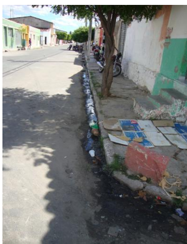
Foto 80 – Lançamento de esgoto a céu aberto em área de cobertura do sistema na Rua Padre Maranhão com Bejamin Constante.
