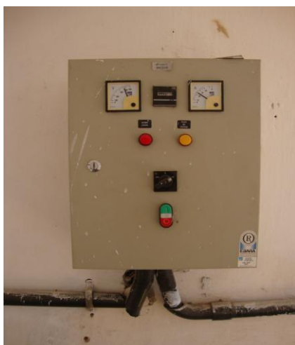
Foto 9 – Quadro de comando do poço PT-03.
