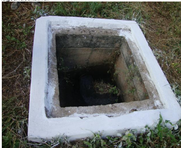
Foto 100 – Poço de recepção de esgoto na lagoa facultativa, sem tampa.
