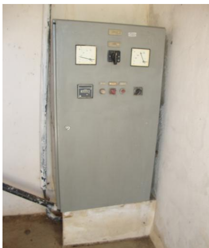
Foto 15 – Quadro de comando do poço PT-04.
