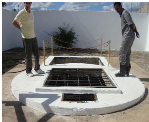
Foto 85 – Vista da EEE-01.
