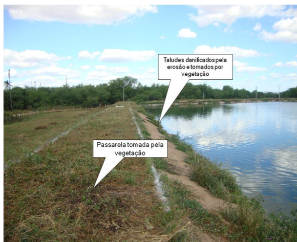
Foto 106 – Taludes danificados pela erosão e passarela tomada pela vegetação.
