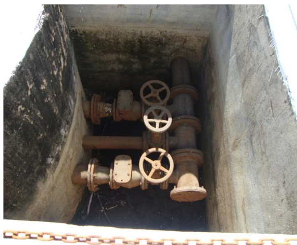
Foto 87 – Registro de controle da EEE-01.
