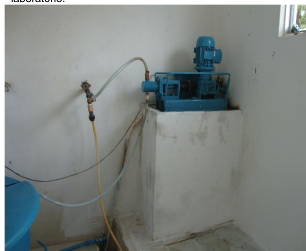
Foto 35 – Casa de química: tanque de dosagem.
