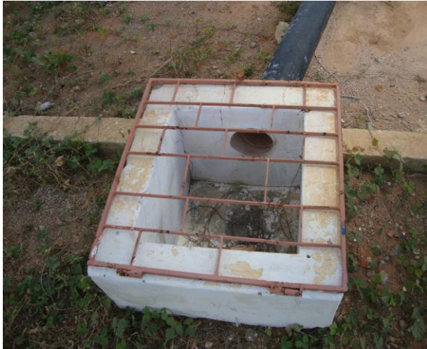
Foto 61 – Caixa de descarga do REL-03.
