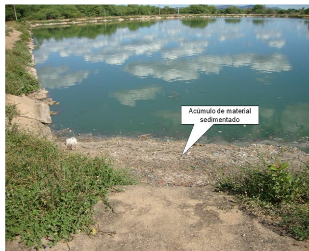
Foto 105 – Erosão no talude e ocorrência de sobrenadante na lagoa facultativa.
