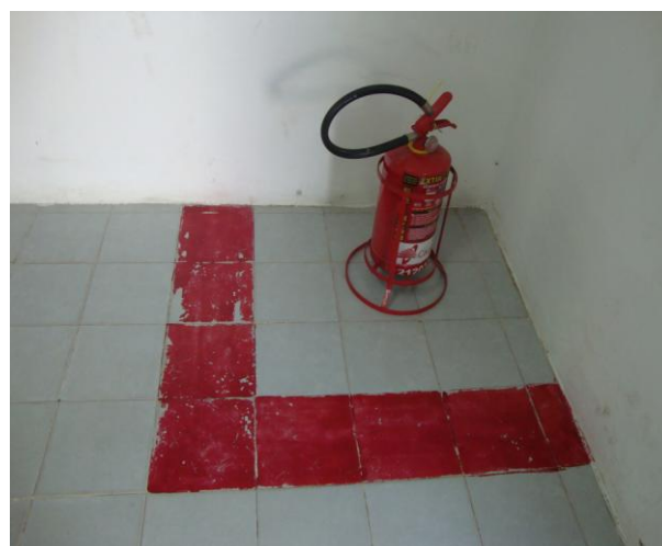
Foto 113 – Extintor de incêndio da loja de atendimento com validade até abr/2017.
