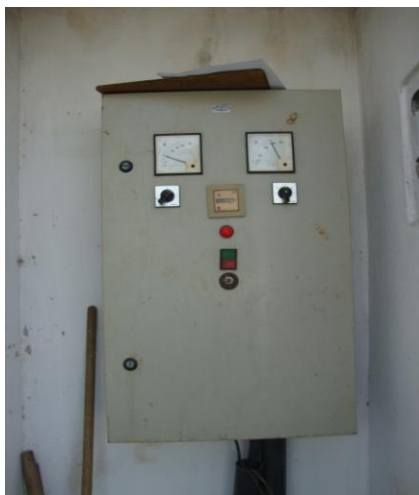
Foto 3 – Quadro de comando do poço PT-01.
