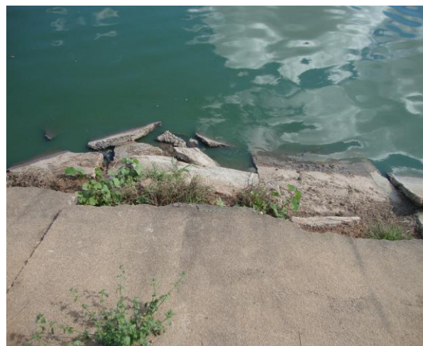
Foto 107 – Taludes danificados pela erosão.
