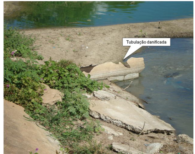
Foto 99 – Tubulação de chegada danificada de esgoto bruto na lagoa facultativa.
