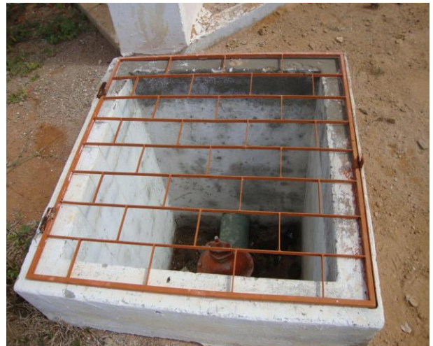
Foto 50 – Registro na chegada do REL-03.
