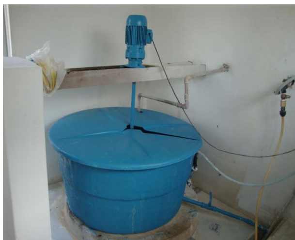
Foto 34 – Casa de química: tanque de dosagem.
