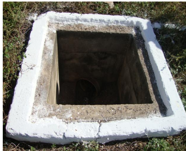
Foto 103 – Poço de saída sem tampa.
