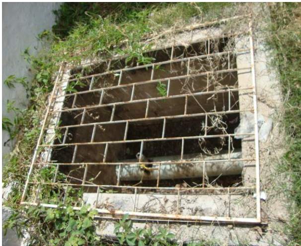
Foto 47 – Estação pitométrica de água bruta na saída do PT-01.
