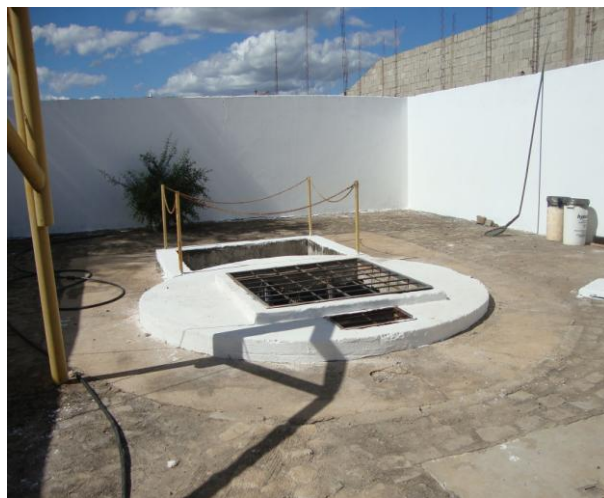
Foto 83 – Vista interna da EEE-01.
