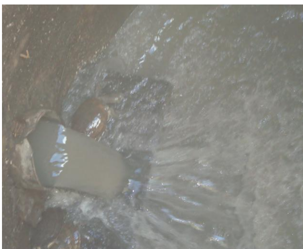
Foto 86 – Poço de sucção.
