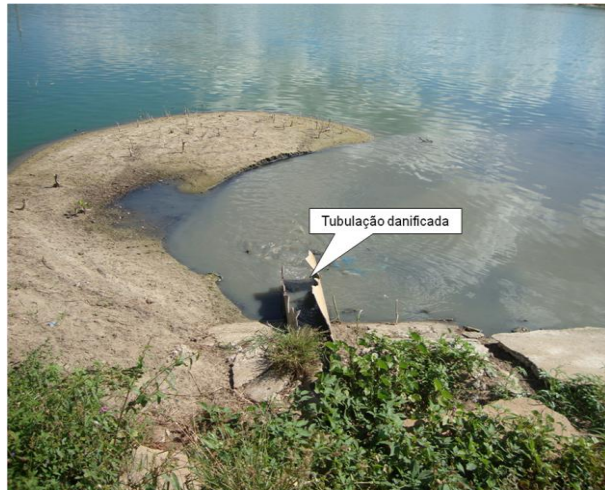
Foto 98 – Tubulação de chegada danificada de esgoto bruto na lagoa facultativa.
