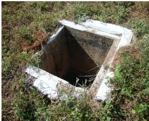
Foto 102 – Poço de saída sem tampa e estrutura danificada.
