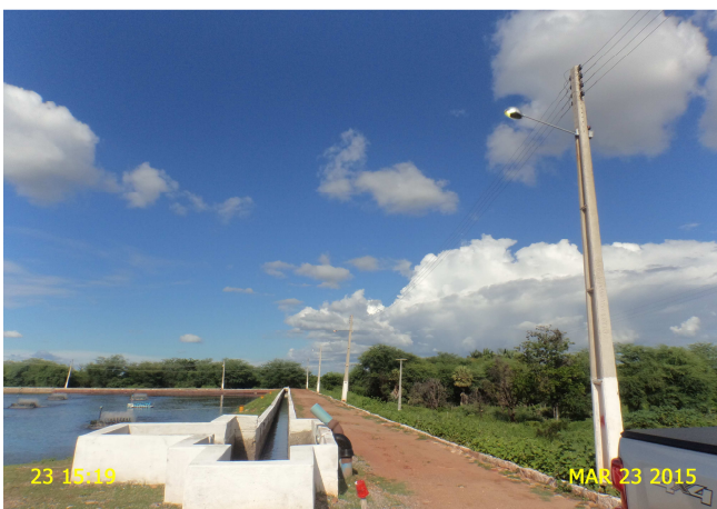
Foto 11 – Postes de iluminação da ETE.
