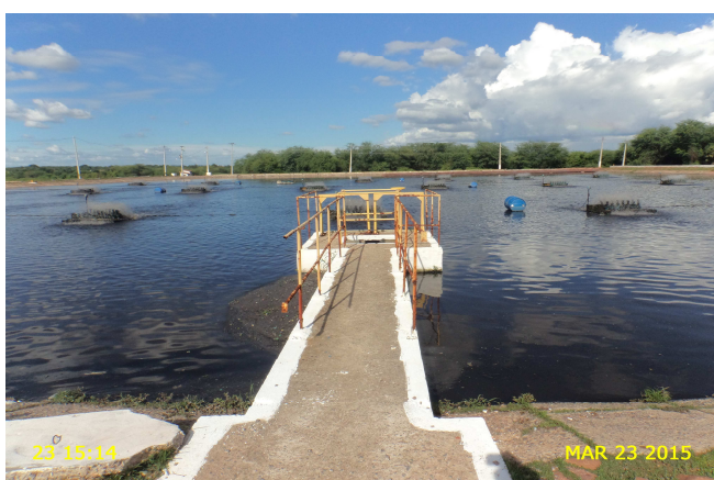
Foto 10 – Lagoa aeróbia 2: Estrutura de inspeção da saída de esgoto em processo de corrosão.
