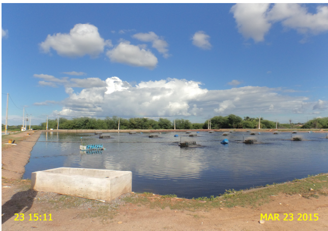
Foto 13 – Lagoa aeróbia 2: aeradores em funcionamento.
