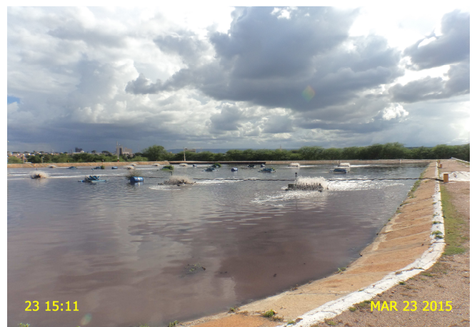
Foto 12 – Lagoa aeróbia 1: aeradores em funcionamento.
