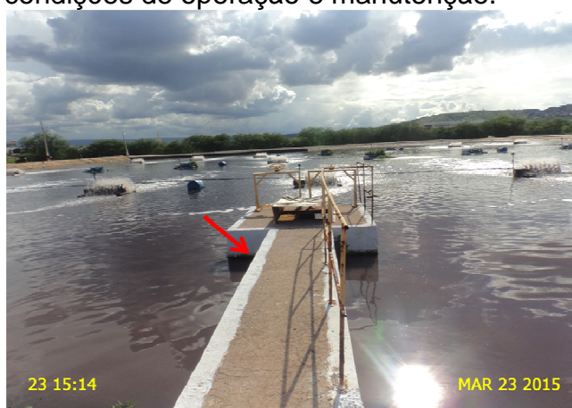
Foto 9 – Lagoa aeróbia 1: Estrutura de inspeção da saída de esgoto com grade de proteção danificada e em processo de corrosão.
