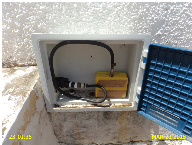
Foto 2 – Datalogger BSA-05 - Medição contínua de pressão na Av. Leandro Bezerra, 535 (CAPs) – Socorro.
