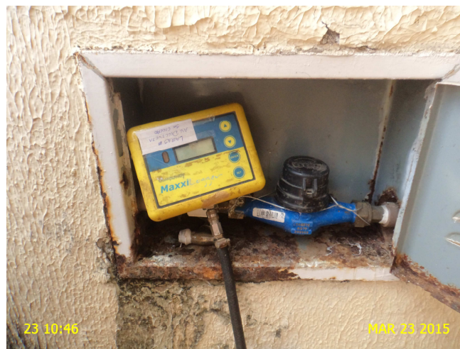
Foto 3 – Datalogger BSA-09 - Medição contínua de pressão na Rua São Francisco, 778 - Centro.
