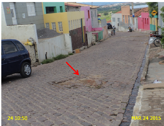
Foto 5 – Pavimento sem recuperação na Rua do Horto.
