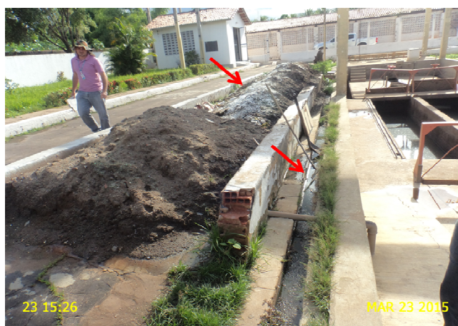
Foto 7 – EEE - Malvas: acúmulo de areia e vala de drenagem em inadequadas condições de operação e manutenção.
