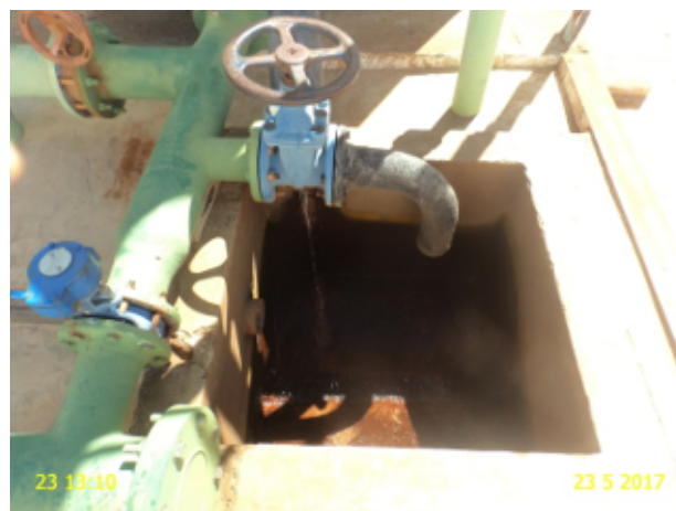
Foto 17 - ETA/Filtração: registro do filtro F-03 sem vedação.
