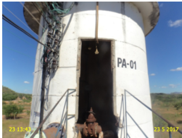
Foto 19 - PA-01: casa de abrigo sem portão.
