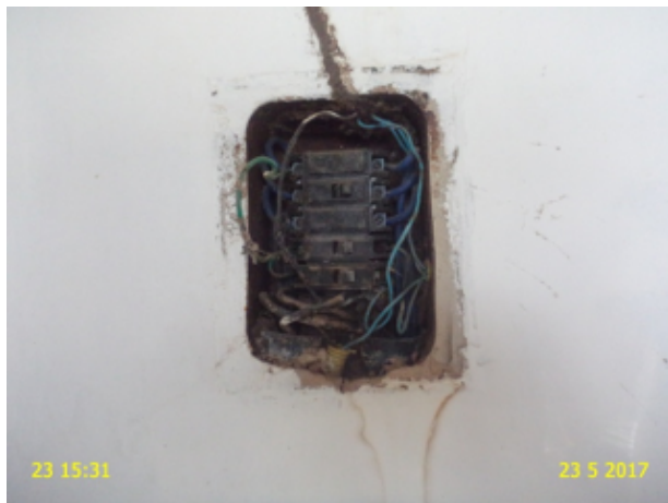
Foto 13 - EEE-01: quadro dos disjuntores sem tampa.
