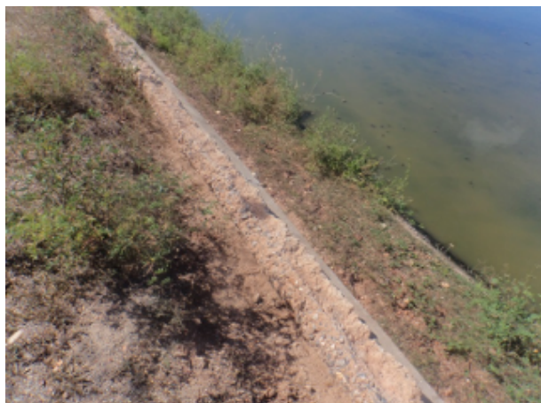
Foto 6 - ETE/LF: taludes danificados.
