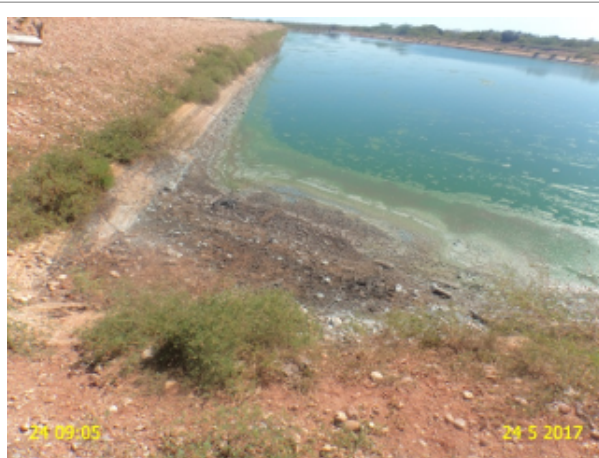
Foto 9 - ETE/LM-02: acúmulo de sobrenadantes.
