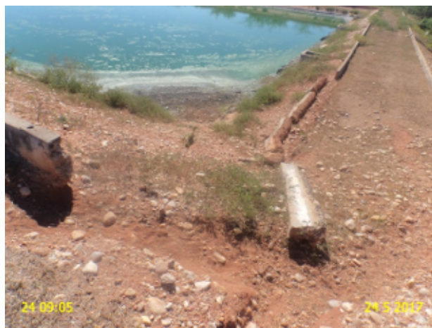
Foto 5 - ETE/LM-02: taludes danificados.
