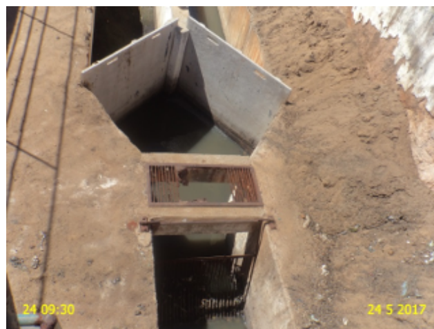
Foto 11 - ETE: gradeamento danificado.
