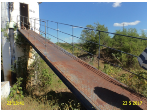
Foto 18 - PA-01: guarda-corpo da rampa de acesso com defeito.
