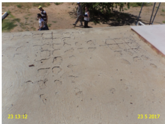
Foto 1 - RSE-01: armaduras expostas na laje de cobertura.
