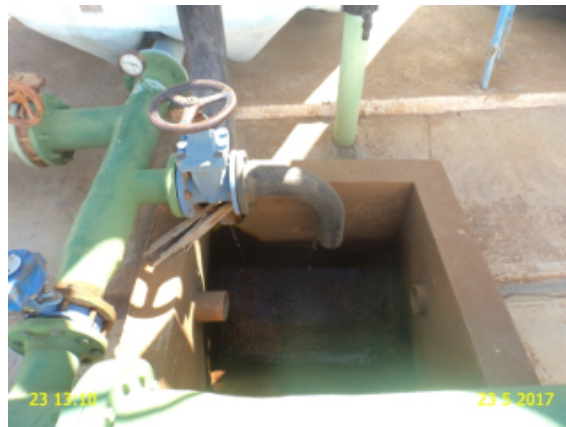
Foto 15 - ETA/Filtração: registro do filtro F-01 sem vedação.
