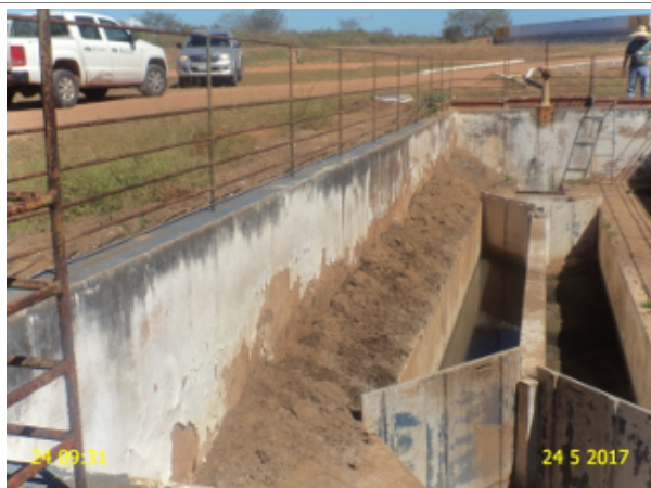
Foto 3 - ETE: ausência de leitos de secagem para dispor areia/materiais retidos no tratamento preliminar.
