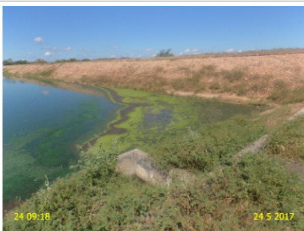
Foto 8 - ETE/LM-01: acúmulo de sobrenadantes.
