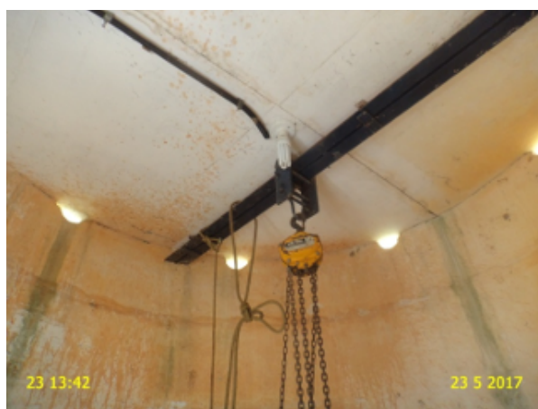
Foto 20 - PA-01: lâmpada com defeito.
