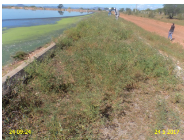
Foto 7 - ETE/LF: vegetação excessiva.
