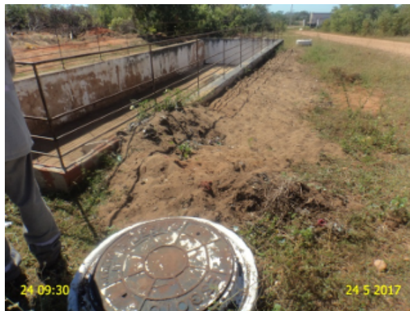
Foto 2 - ETE: ausência de leitos de secagem para dispor areia/materiais retidos no tratamento preliminar.
