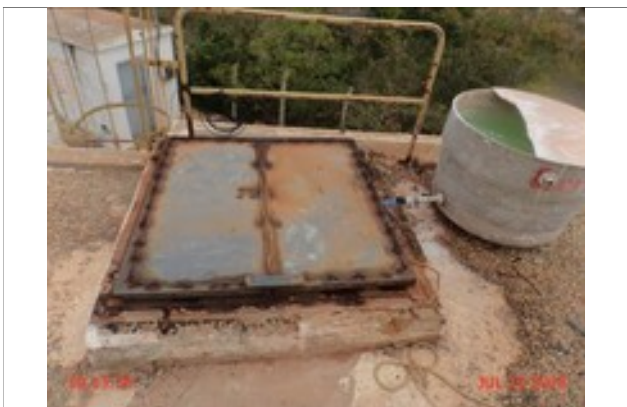
Foto 7 – Reservatório (Sede): A tampa de inspeção do reservatório RAP-11 está em processo de corrosão.
