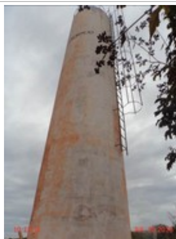
Foto 4 – Reservatório (Sede): O reservatório REL-23 está com a pintura deteriorada.
