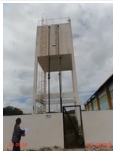
Foto 6 – Reservatório (Localidade Faveira): O reservatório REL-01 está com a pintura deteriorada.
