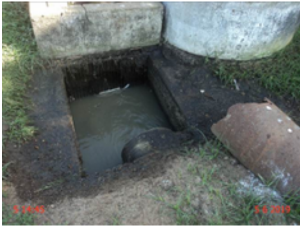
Foto 29 – ETE (Sede): caixa de inspeção sem tampa.
