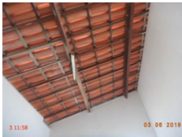
Foto 37 – ETA/Casa de química (Lagoinha): lâmpada com defeito.
