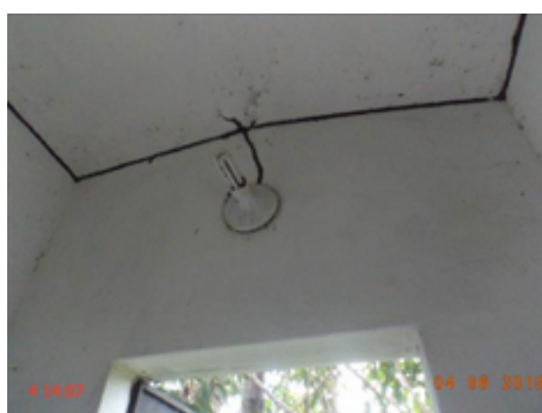
Foto 46 – EECS-01 (Sede): lâmpada com defeito na casa de abrigo do quadro de comando.
