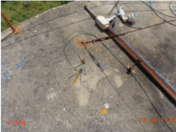
Foto 49 – REL-01 (Lagoinha): captador e lâmpada de sinalização noturna do para-raios danificados.
