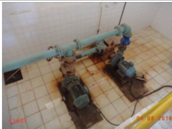
Foto 18 – EEAT-01 (Sede): acúmulo de água no chão.
