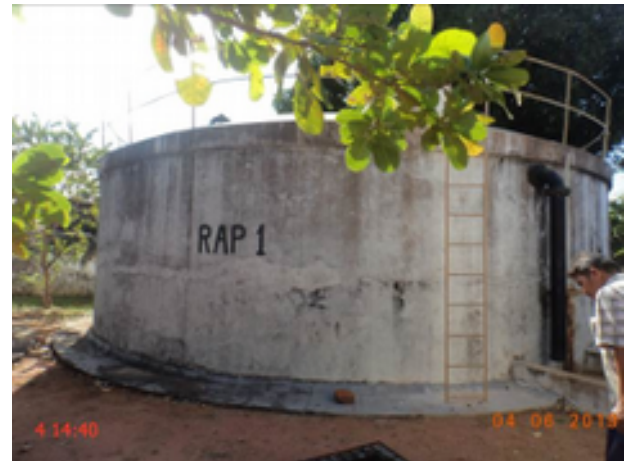
Foto 32 – RAP-01 (Sede): pintura deteriorada.
