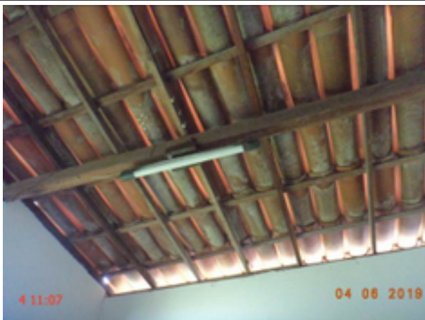
Foto 17 – EEE-02 (Lagoinha): lâmpada da casa de abrigo do quadro de comando com defeito.
