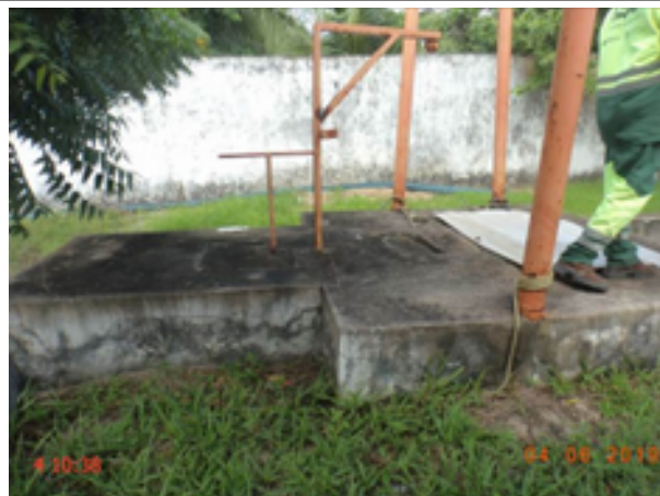
Foto 5 – EEE-03 (Lagoinha): ausência de leito de secagem.
