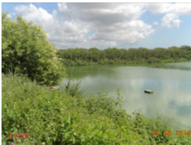
Foto 13 – ETE (Lagoinha): vegetação excessiva na lagoa Facultativa.
