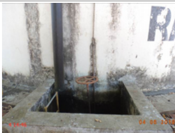
Foto 24 – RAP-02 (Sede): caixa de inspeção sem tampa ou grade de proteção.
