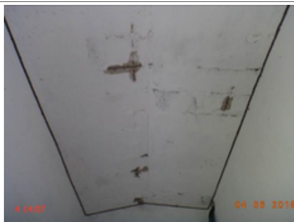
Foto 12 – Captação (Sede): armaduras expostas no teto da casa de abrigo do quadro de comando.
