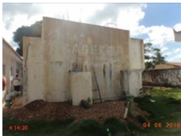
Foto 43 – ETA/Decantação (Sede): pintura deteriorada.
