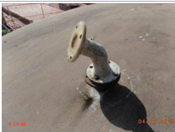
Foto 9 – RAP-02 (Sede): tubulação de ventilação inadequada
