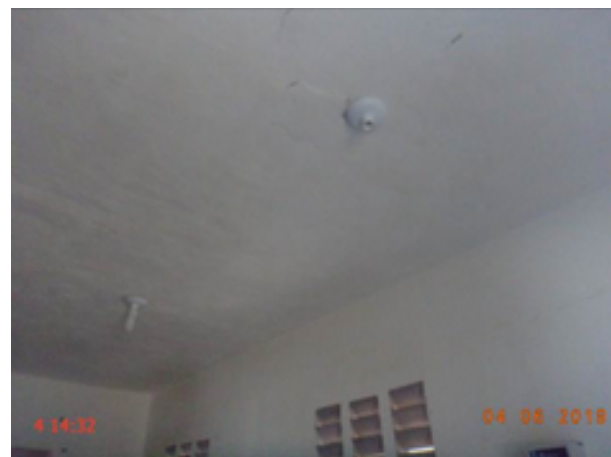
Foto 38 – ETA/Casa de química (Sede): lâmpada não acende.
