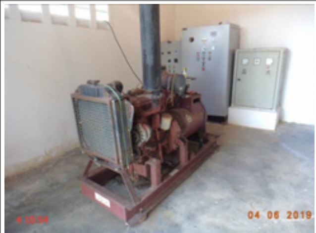
Foto 34 – EEE-01 (Lagoinha): grupo gerador de energia elétrica com defeito.
