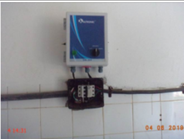
Foto 39 – ETA/Casa de química (Sede): quadro de disjuntores sem tampa.
