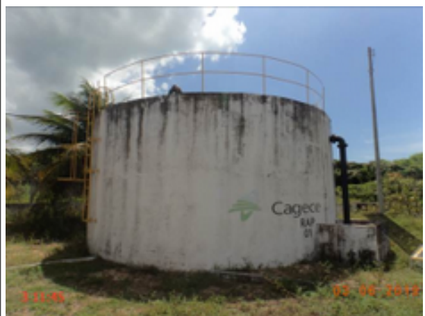
Foto 30 – RAP-01 (Lagoinha): pintura deteriorada.
