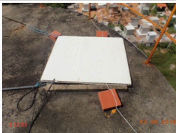
Foto 26 – REL-01 (Lagoinha): tampa sem vedação.
