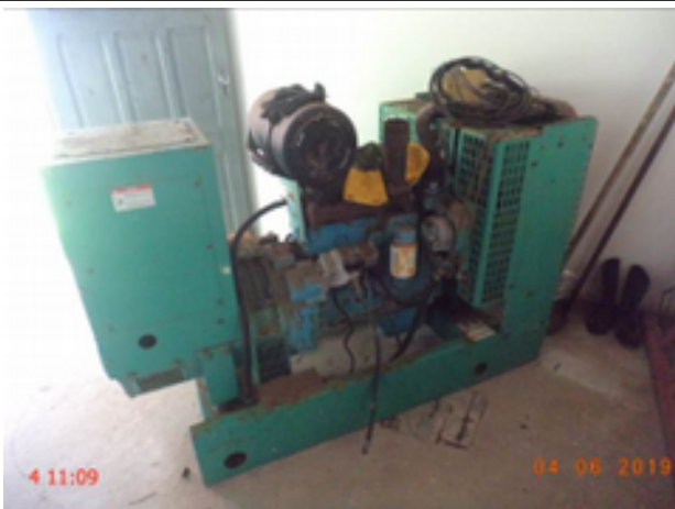
Foto 35 – EEE-02 (Lagoinha): grupo gerador de energia elétrica com defeito.
