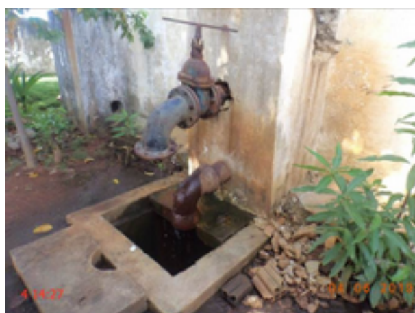
Foto 45 – ETA/Decantação Dec-04 (Sede): registro sem vedação.
