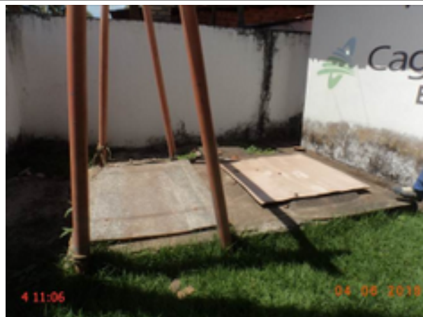
Foto 4 – EEE-02 (Lagoinha): ausência de leito de secagem.
