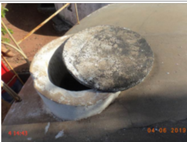
Foto 27 – RAP-01 (Sede): tampa de inspeção aberta.
