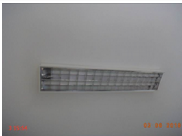
Foto 11 – Escritório/loja de atendimento (Lagoinha): lâmpada com defeito.
