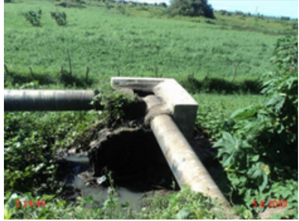
Foto 48 – ETE (Sede): caixa de passagem danificada na chegada do esgoto bruto.
