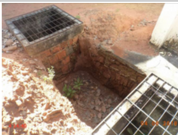
Foto 7 – ETA (Sede): caixa de inspeção inacabada.
