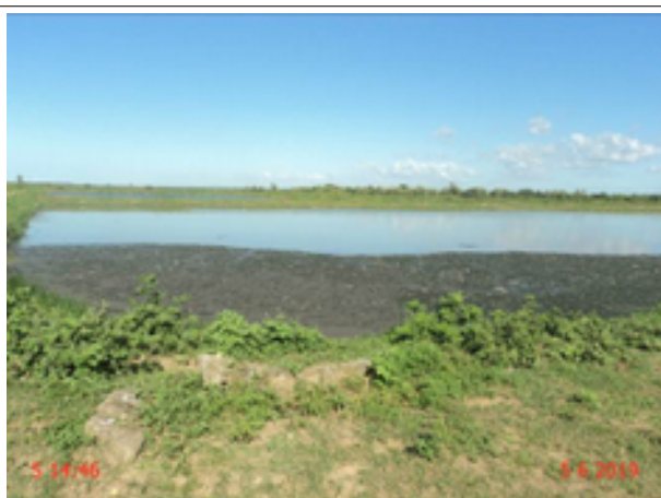
Foto 15 – ETE (Sede): acúmulo de sobrenadantes na lagoa facultativa.
