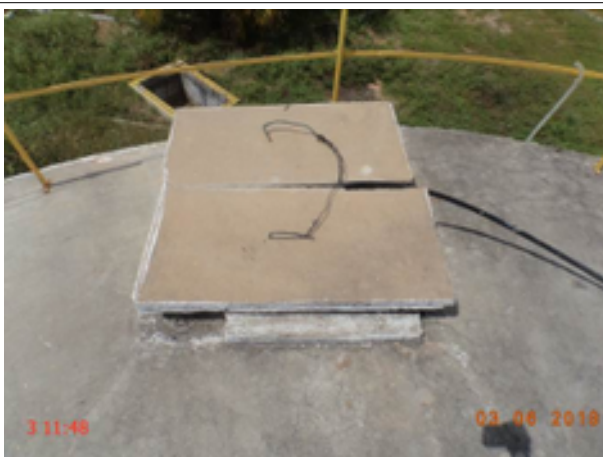
Foto 25 – RAP-01 (Lagoinha): tampa sem vedação.
