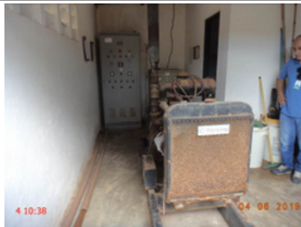
Foto 36 – EEE-03 (Lagoinha): grupo gerador de energia elétrica com defeito.
