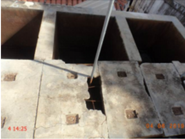
Foto 47 – ETA/Filtração (Sede): tampa do filtro F-07 danificada.
