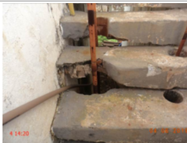
Foto 8 – ETA/Decantação (Sede): escada de acesso com degrau danificado.
