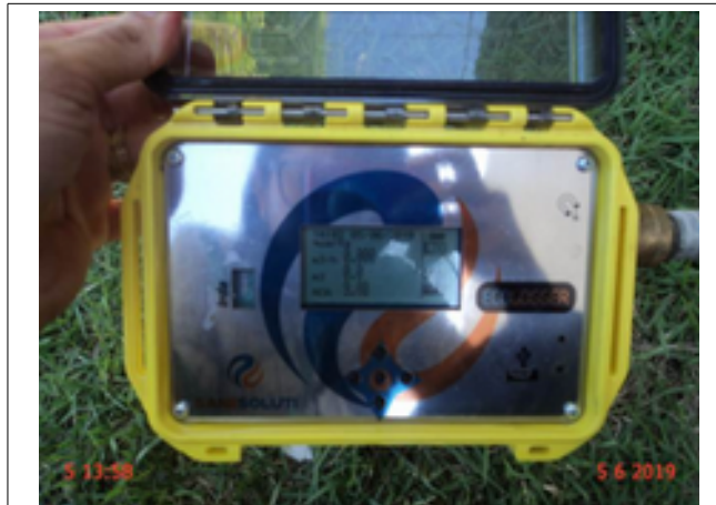
Foto 1 – RDA: medição instantânea de pressão na rede de distribuição no endereço Rua Evaristo Gomes, nº 161, Hospital Municipal.
