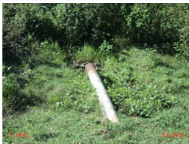
Foto 42 – ETE (Sede): tubulação de saída danificada.
