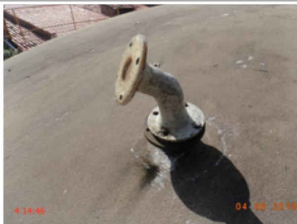
Foto 22 – RAP-02 (Sede): tubulação de ventilação sem tela de proteção.
