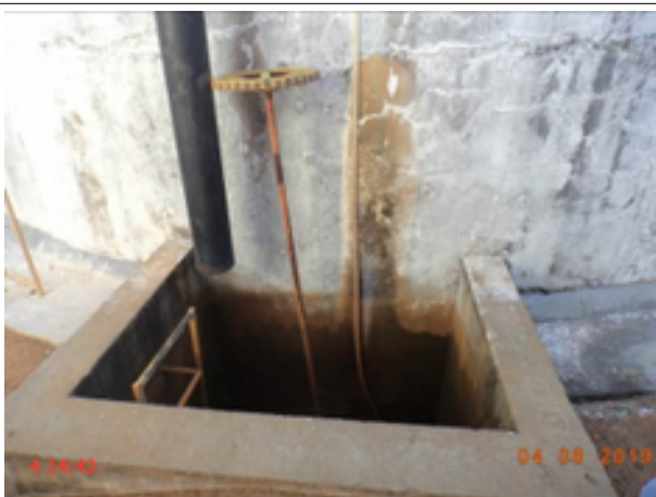
Foto 23 – RAP-01 (Sede): caixa de inspeção sem tampa ou grade de proteção.
