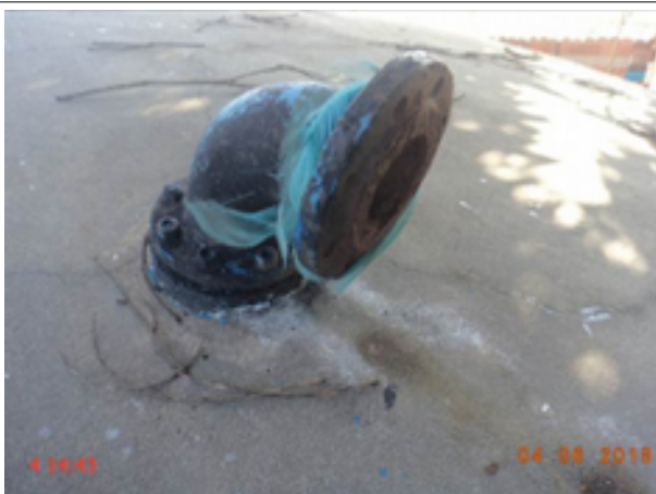
Foto 21 – RAP-01 (Sede): tubulação de ventilação inadequada e tela de proteção danificada.
