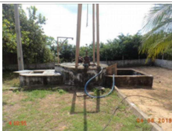
Foto 3 – EEE-01 (Lagoinha): ausência de leito de secagem.
