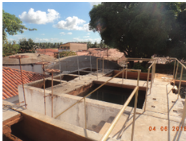
Foto 44 – ETA/Decantação (Sede): Dec-01, Dec-02, Dec-03 e Dec-04 estão com pintura deteriorada.
