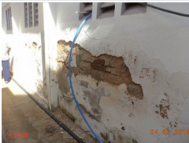
Foto 40 – ETA/casa de química (Sede): reboco danificado.
