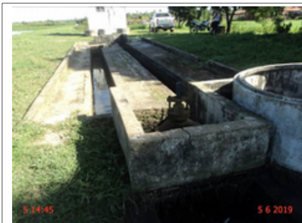
Foto 2 – ETE (Sede): ausência de guarda-corpo na área do tratamento preliminar da ETE.
