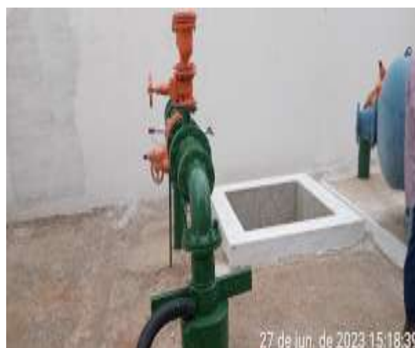
Foto 42 - PT-23: caixa sem tampa.
