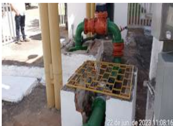
Foto 5 - PT-15: caixas de macromedidores estão danificadas.
