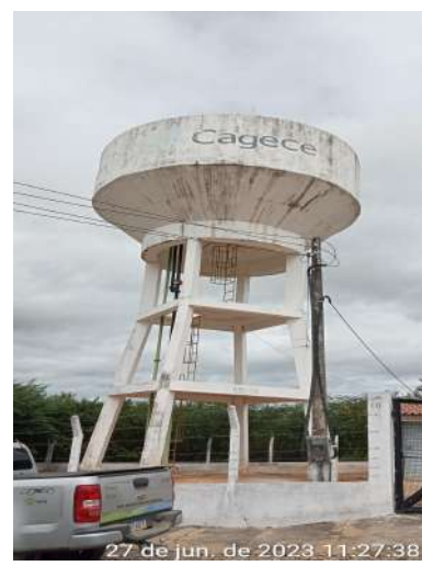
Foto 26 - REL-14: pintura deteriorada.
