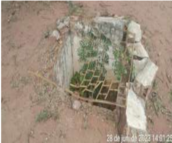
Foto 63 - PT-29/PT-30: entulhos na área do entorno do poço e caixas danificadas.
