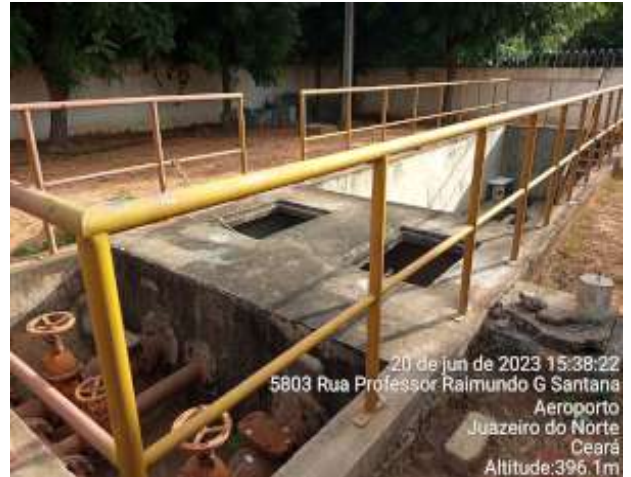
Foto 82 - ETE MCMV: ausência de tampas do poço de bombeamento.
