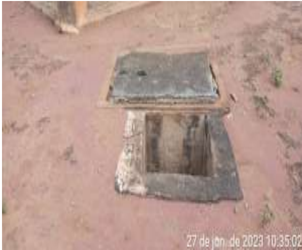
Foto 21 - REL-06: caixa sem tampa.
