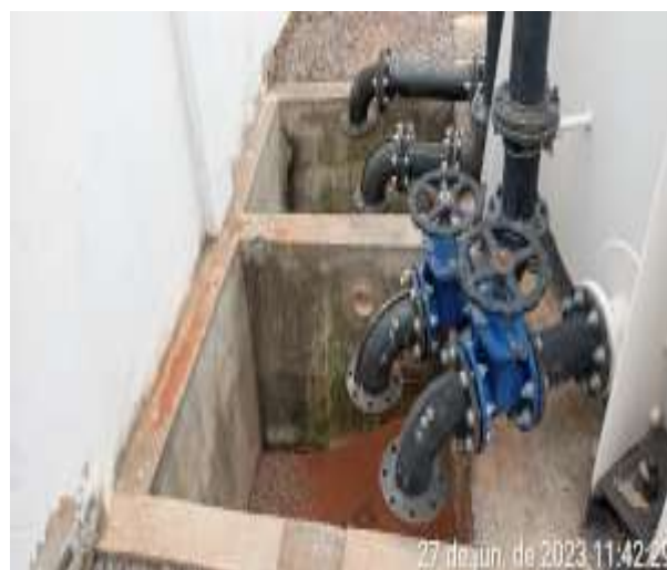
Foto 30 - REL-23: caixas sem tampas.
