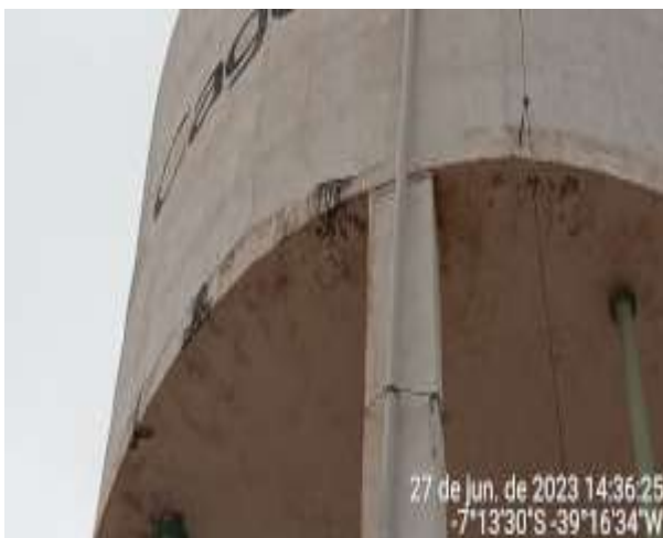
Foto 35 - REL-15: pintura desgastada, fiação inadequada ao redor da estrutura e apresenta vazamento.
