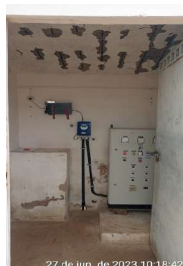
Foto 14 - EEAT-15: casa do quadro de comando com pintura deteriorada e laje de cobertura com ferragem exposta em processo de corrosão.
