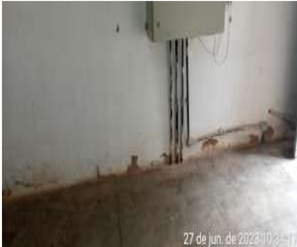
Foto 15 - EEAT-15: casa de bomba apresenta revestimento da parede e pintura deteriorada.
