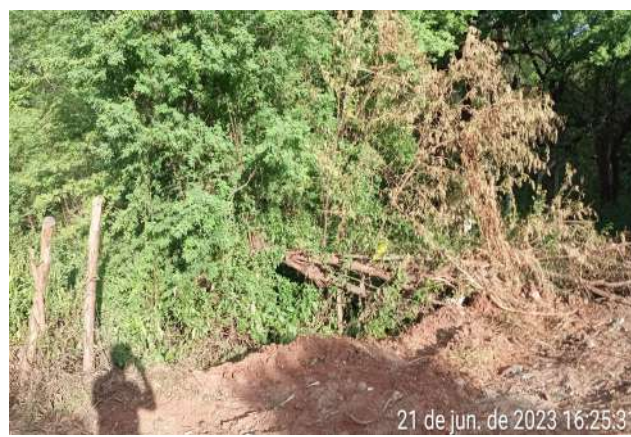
Foto 102 - ETE - Malvas: área das lagoas com cerca de proteção e isolamento deteriorados e presença de fezes de animais de grande porte nos taludes.
