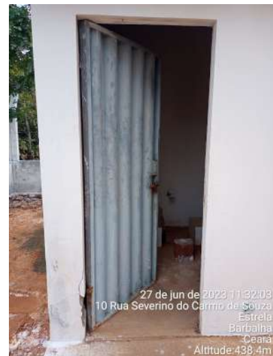
Foto 78 - PT-48 / REL-14: casa do cloro sem identificação e com rachadura na base.
