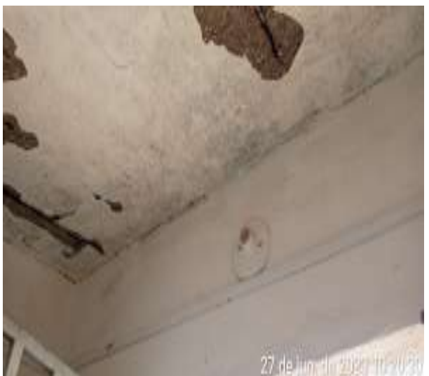
Foto 13 - EEAT-15: casa do quadro de comando com pintura deteriorada e laje de cobertura com ferragem exposta em processo de corrosão.
