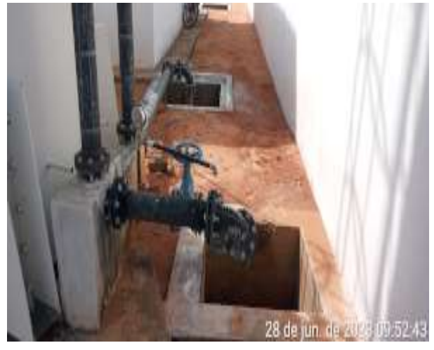
Foto 58 - REL-27/RAP-44: caixa sem tampa.
