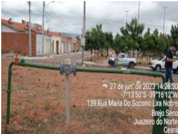
Foto 105 - PT-56: poço instalado sem infraestruturas de isolamento e proteção ainda não instalados.
