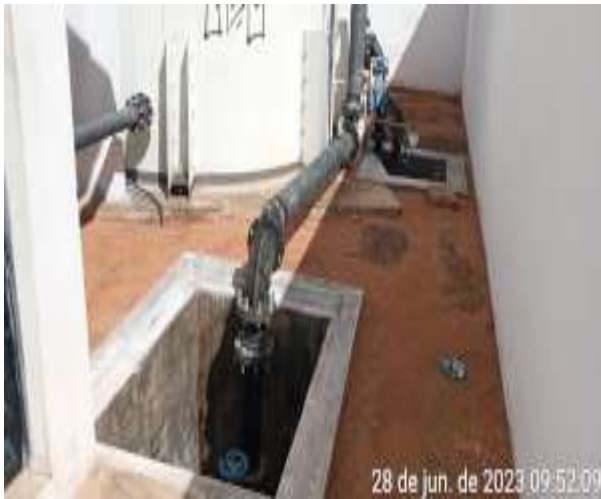
Foto 57 - REL-27/ RAP-44: caixa sem tampa.
