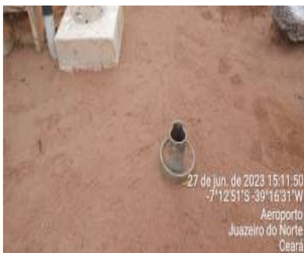
Foto 41 - PT-18: registro sem caixa de proteção.
