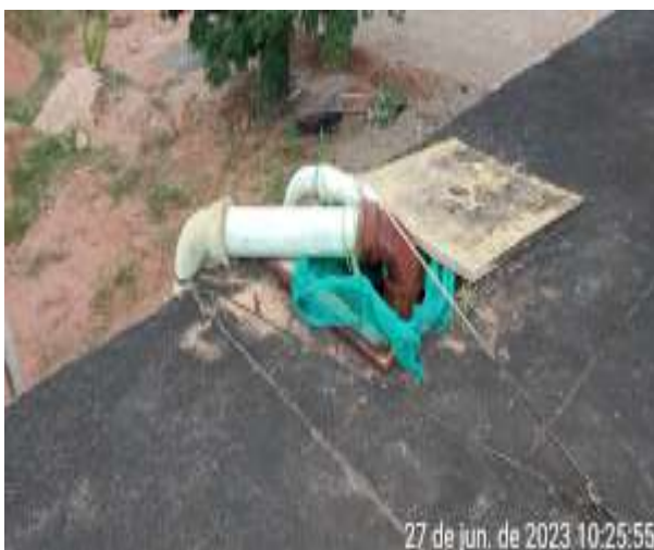
Foto 19 - RAP-08: abertura de inspeção obstruída por tubulação de alimentação de água.
