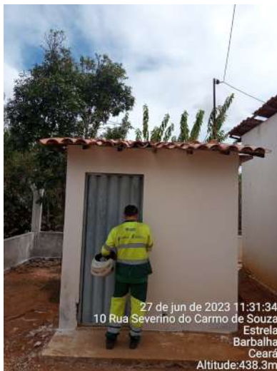
Foto 77 - PT-48 / REL-14: casa do cloro sem identificação e com rachadura na base.
