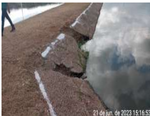
Foto 97 - ETE Malvas: placas dos taludes da lagoa estão deterioradas.
