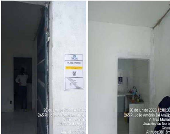
Foto 81 - ETE Três Marias: identificação ilegíveis da casa de bomba e do laboratório.
