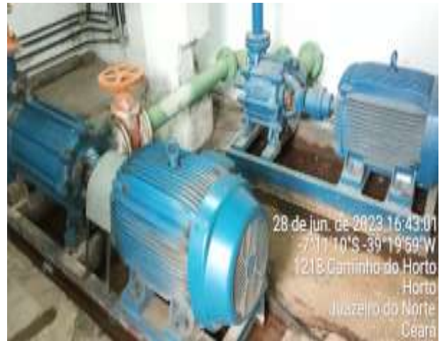
Foto 76 - EEAT-02: dreno das bombas entupidos.
