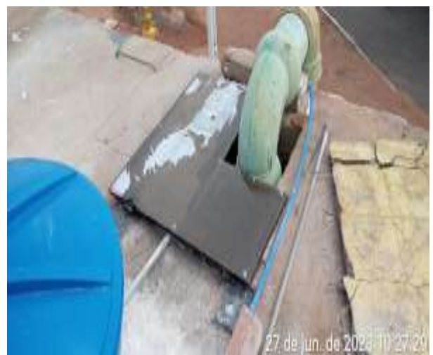
Foto 20 - RAP-08: abertura de inspeção obstruída por tubulação de alimentação de água.
