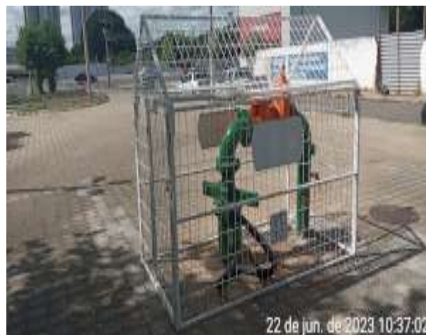
Foto 4 - PT-10: falta logomarca de identificação da CAGECE
