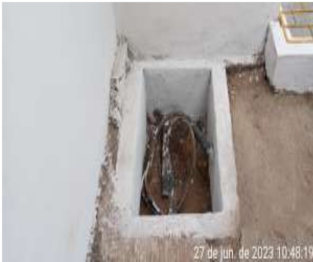
Foto 23 - PT-60: caixa de passagem de energia sem tampa.
