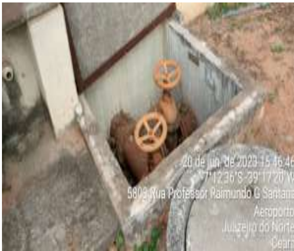
Foto 83 - ETE MCMV: caixas sem tampas.
