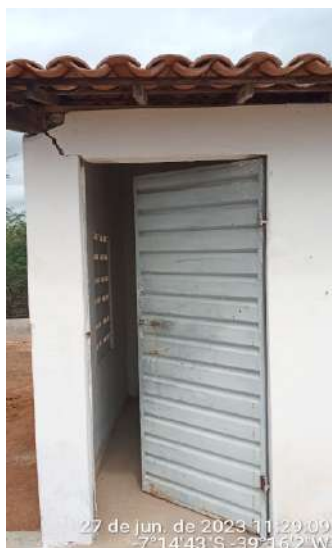
Foto 27 - REL-14: rachadura na casa do quadro de comando e porta danificada.
