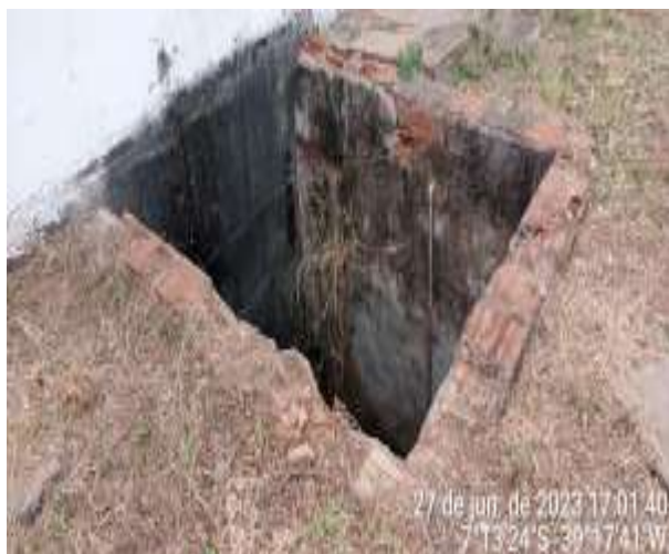
Foto 51 - RAP-07: caixa sem tampa.
