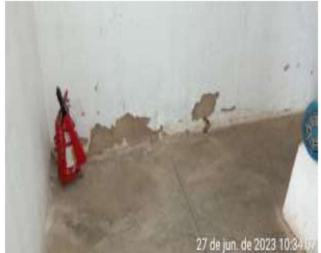
Foto 16 - EEAT-15: casa de bomba apresenta revestimento da parede e pintura deteriorada.
