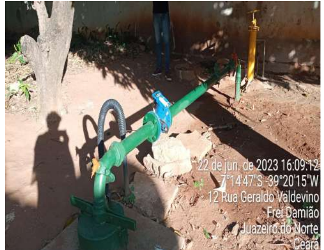
Foto 10 - PT-19: caixa com tampa deteriorada ou inadequada.
