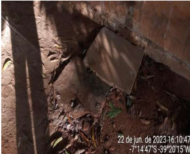
Foto 9 - PT-19: caixa com tampa deteriorada ou inadequada.
