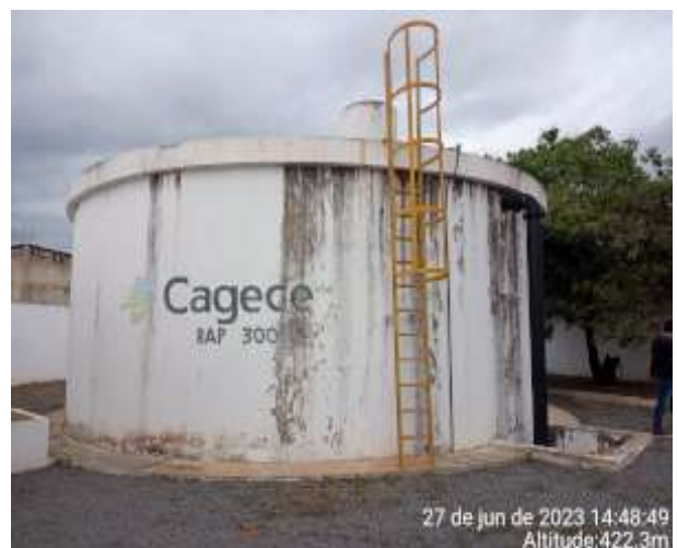
Foto 38 - RAP-38: Pintura desgastada.
