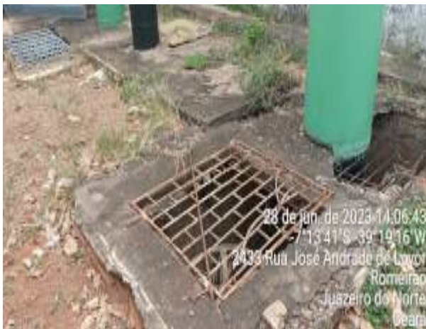
Foto 65 - EEAT-12/RAP-02/RAP-03: caixas de inspeção danificadas.
