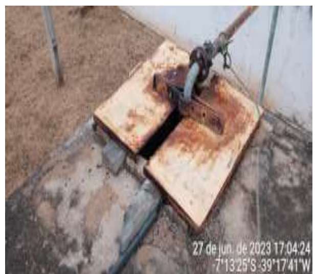
Foto 50 - RAP-07: caixa deteriorada.
