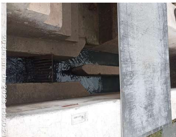
Foto 79 - ETE Três Marias: falta comporta das divisórias das caixas de areia.
