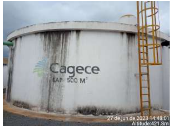
Foto 110 - RAP-39: ausência de identificação.
