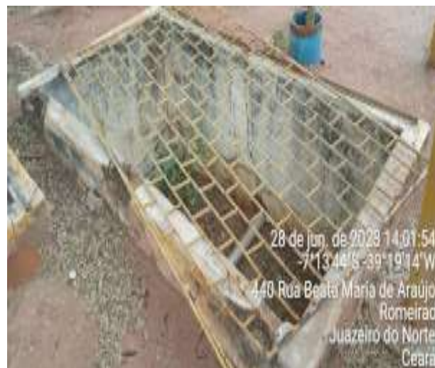
Foto 61 - PT-29/PT-30: entulhos na área do entorno do poço e caixas danificadas.
