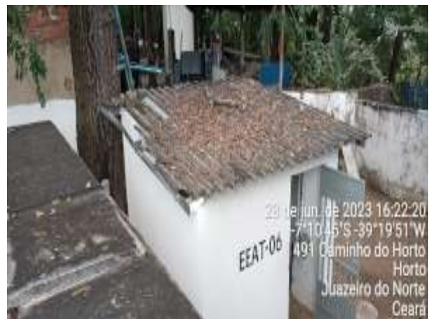
Foto 74 - EEAT-06: telhado necessita de manutenção e limpeza.
