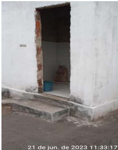
Foto 93 - EEE-SN (Vila de Fátima): casa de apoio dos operadores inacabada.
