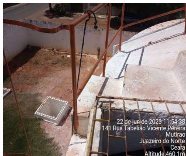
Foto 8 - RAP-16: fixação do guarda-corpo está danificada.
