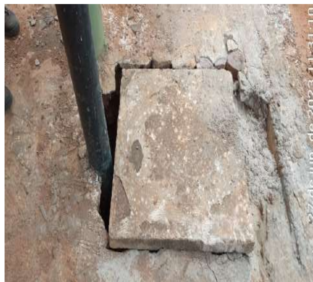
Foto 28 - REL-14: caixa de descarga danificada.
