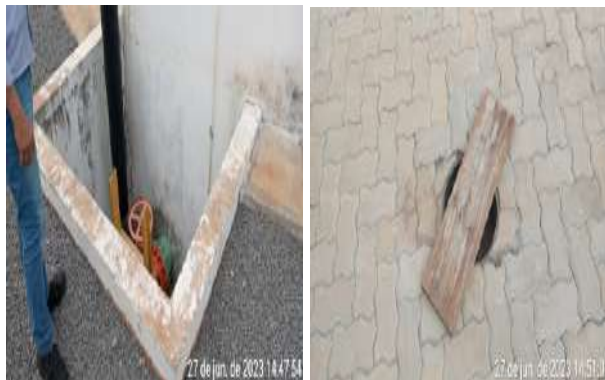
Foto 39 - RAP-38: caixa sem tampa ou tampa inadequada.
