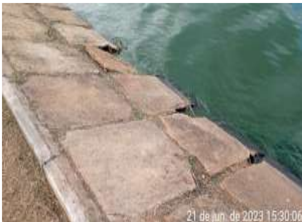
Foto 99 - ETE Malvas: placas dos taludes da lagoa estão deterioradas.
