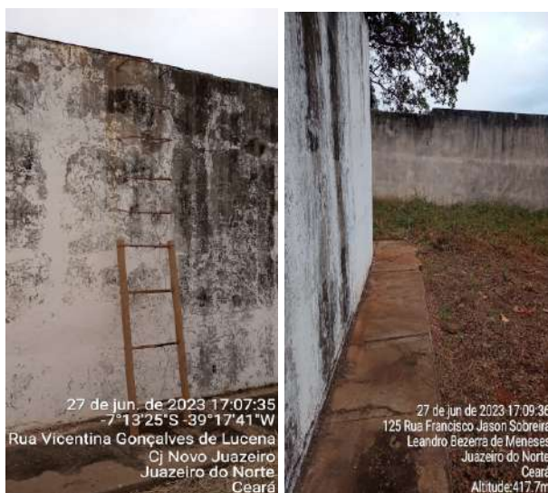
Foto 53 - RAP-07: pintura desgastada, calçada danificada e escada inadequada.
