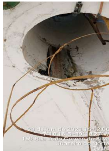
Foto 72 - REL-18: vazamento na infraestrutura e escada em processo de corrosão.
