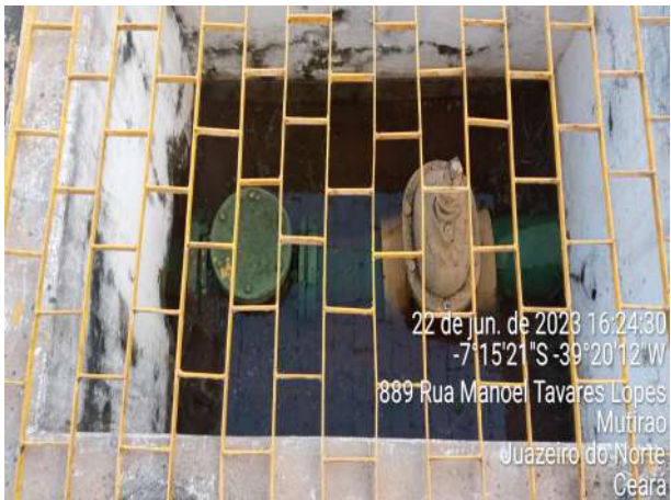
Foto 11 - PT-22: vazamento na válvula de retenção.
