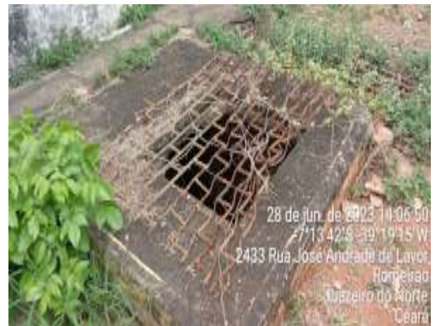
Foto 66 - EEAT-12/RAP-02/RAP-03: caixas de inspeção danificadas.
