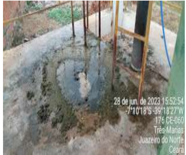
Foto 70 - REL-18: vazamento na infraestrutura.
