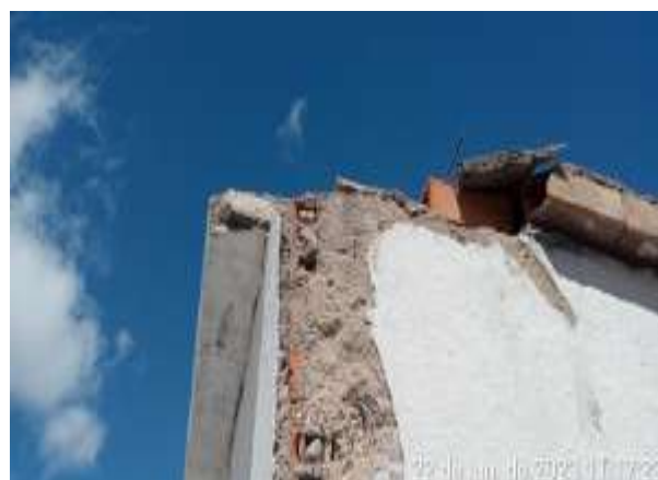
Foto 6 - PT-13: laje de cobertura do quadro de comando está danificada.
