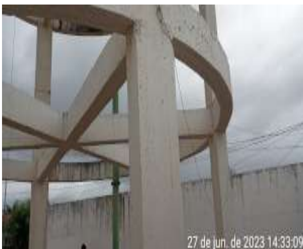
Foto 37 - REL-15: pintura desgastada, fiação inadequada ao redor da estrutura e apresenta vazamento.
