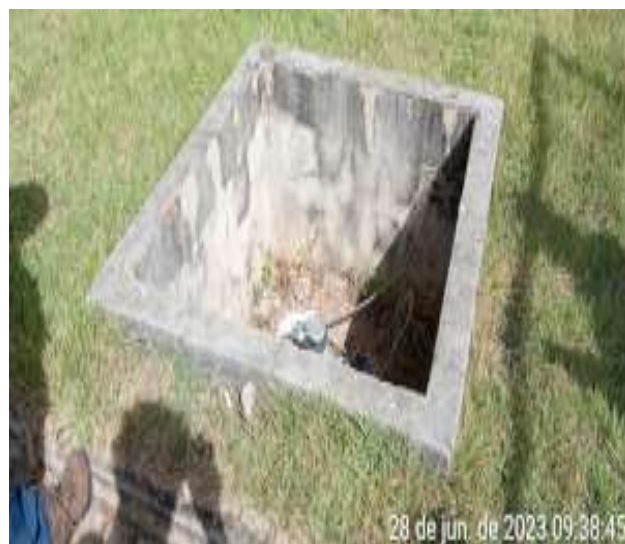
Foto 54 - PT-44: caixa sem tampa.
