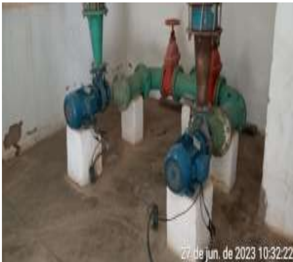
Foto 17 - EEAT-15: casa de bomba apresenta revestimento da parede e pintura deteriorada.
