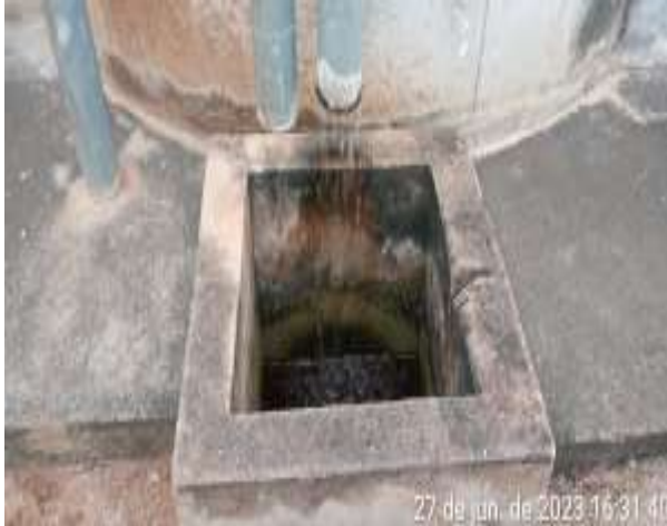
Foto 45 - REL-08: vazamento na tubulação de limpeza.
