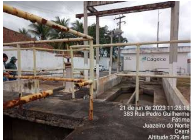
Foto 88 - EEE-SN (Vila de Fátima): corrimões corroídos
