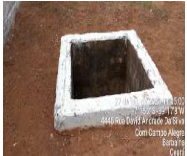
Foto 24 - PT-39: caixa sem tampa.
