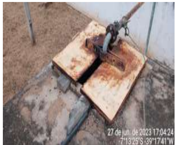
Foto 48 - RAP-07: caixa deteriorada.
