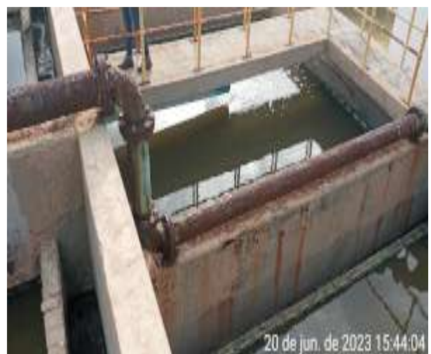
Foto 86 - ETE MCMV: infraestrutura metálica em processo adiantado de corrosão (tubulações, registros e outros) .
