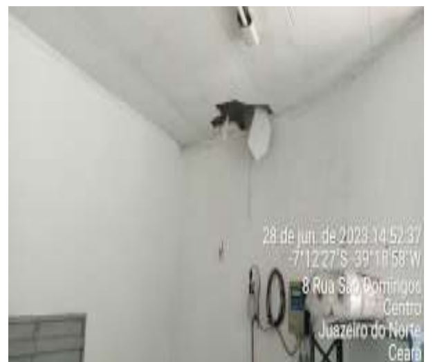
Foto 68 - REL-01: Forro do teto desabando e instalações elétricas inadequadas.
