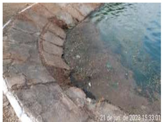
Foto 98 - ETE Malvas: placas dos taludes da lagoa estão deterioradas.
