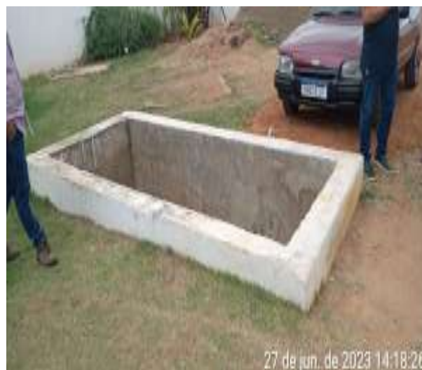
Foto 32 - PT-55: caixa sem tampa
