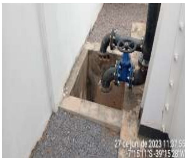
Foto 29 - REL-22: caixa sem tampa.
