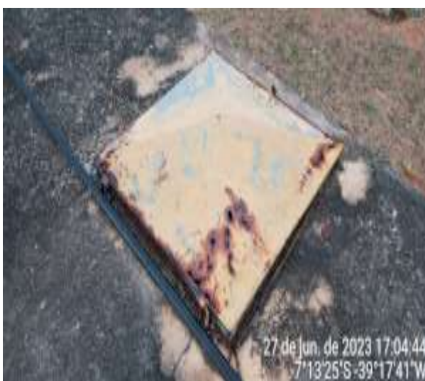
Foto 49 - RAP-07: caixa deteriorada.
