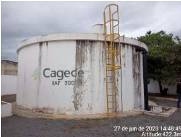
Foto 109 - RAP-38: ausência de identificação.
