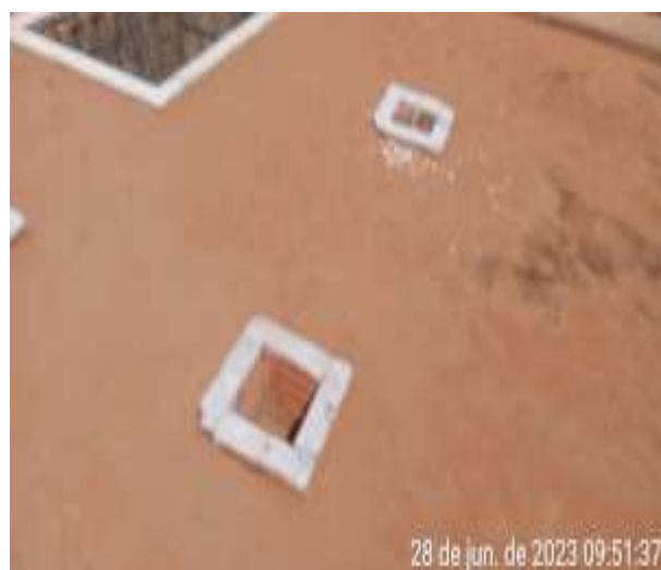
Foto 56 - REL-27/RAP-44: caixa sem tampa.
