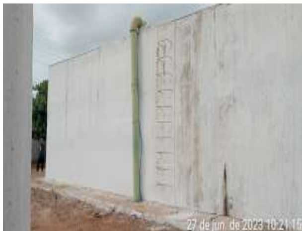
Foto 1 - RAP-05 - escada inadequada, com componentes mínimos requeridos como, por exemplo, gaiola de proteção (altura > 2m) e guarda corpo ou corrimão de apoio acima do patamar da estrutura.
