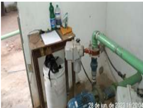
Foto 73 - EEAT-06: não há casa de apoio com banheiro para o operador.
