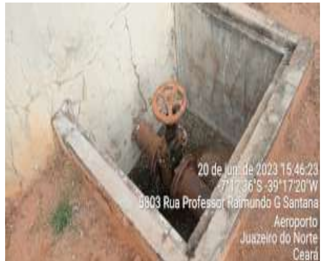
Foto 84 - ETE MCMV: caixas sem tampas.
