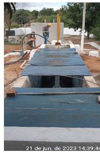
Foto 96 - EEE-SN (Almino Loyola): tampas do tratamento preliminar estão deterioradas, falta tampa do poço de sucção.
