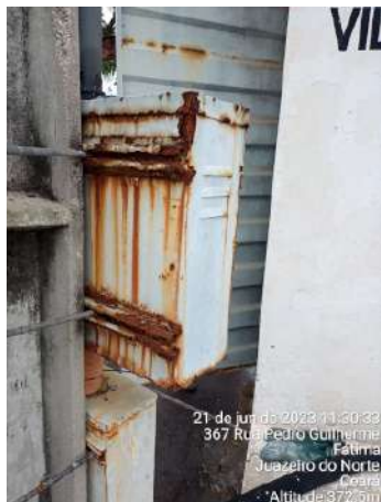
Foto 91 - EEE-SN (Vila de Fátima): quadro de energia corroído.
