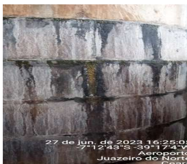
Foto 44 - RAP-20: apresenta vazamento.
