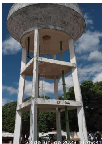
Foto 7 - REL-04: pintura deteriorada.
