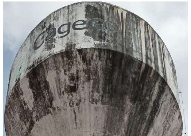
Foto 12 - REL-06: pintura deteriorada.
