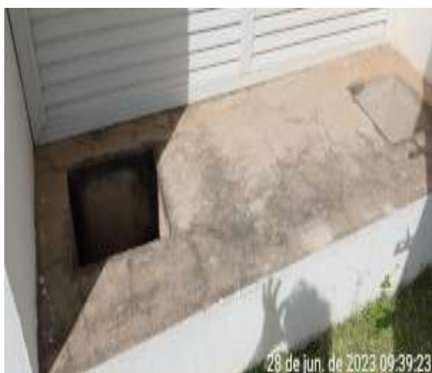
Foto 55 - PT-44: caixa sem tampa.
