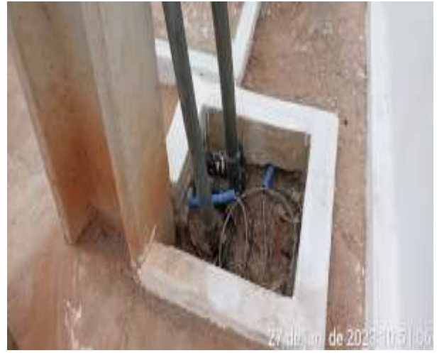
Foto 22 - PT-38: caixa de passagem de energia sem tampa.
