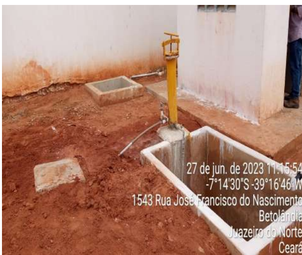
Foto 25 - PT-46: caixas sem tampas.
