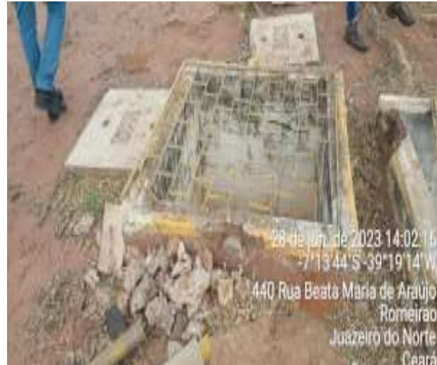
Foto 62 - PT-29/PT-30: entulhos na área do entorno do poço e caixas danificadas.
