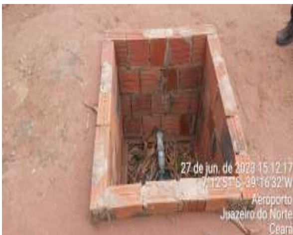
Foto 107 - PT-18: caixa do hidrômetro inacabada e sem tampa.
