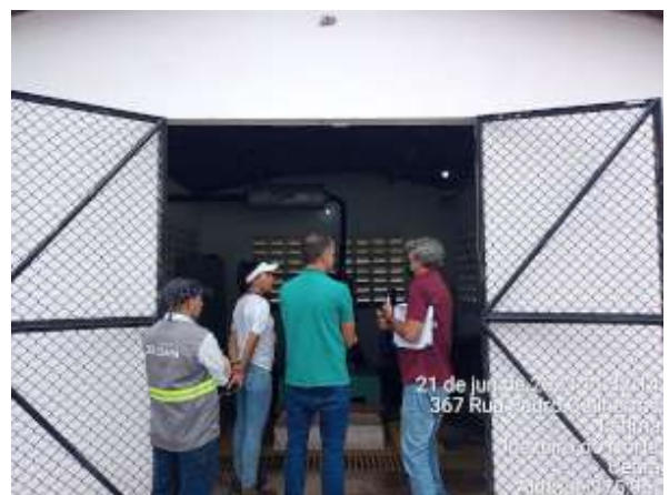
Foto 114 - EEE (Vila de Fátima): a casa do gerador não possui identificação.
