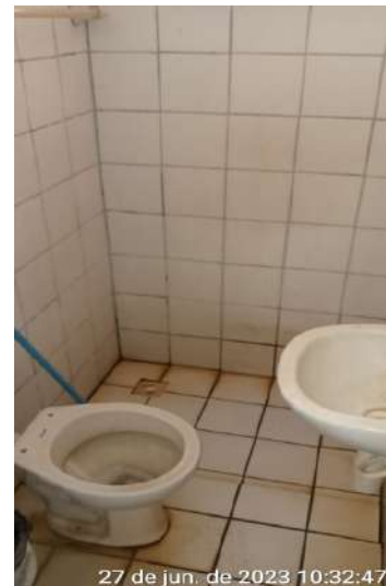
Foto 18 - EEAT-15: banheiro necessitando de manutenção.
