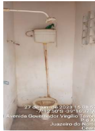
Foto 106 - PT-18: Banheiro sem revestimento lavável.
