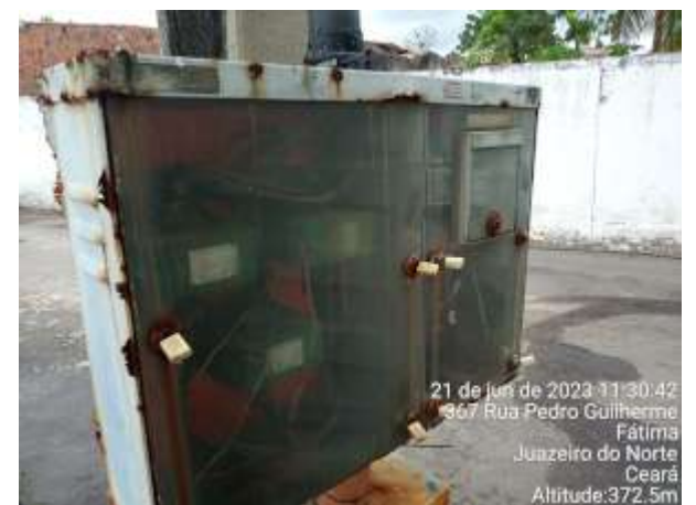
Foto 90 - EEE-SN (Vila de Fátima): quadro de energia corroído.
