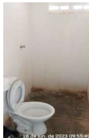
Foto 108 - REL-27/RAP-44: banheiro sem revestimento lavável.
