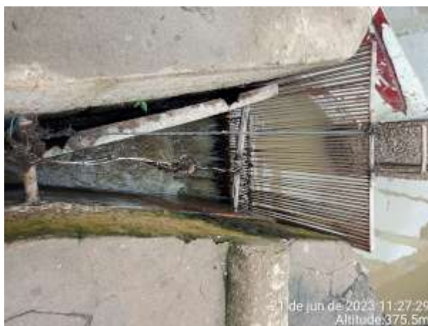
Foto 89 - EEE-SN (Vila de Fátima): grade da calha do poço inadequada (escorada com pau e amarrada com fio).
