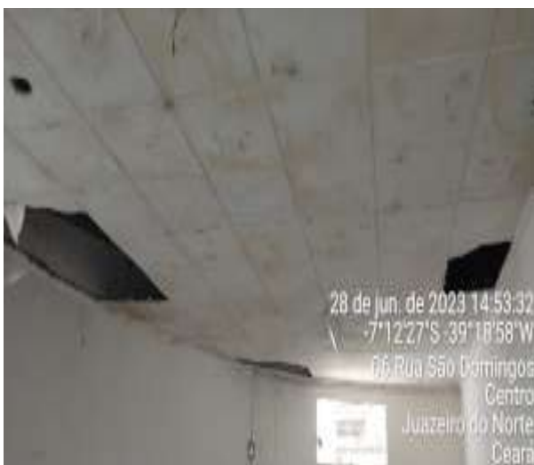
Foto 67 - REL-01: Forro do teto desabando.
