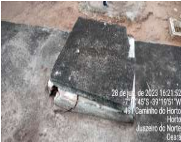
Foto 75 - RAP-14: abertura de inspeção danificada na borda e tampa.
