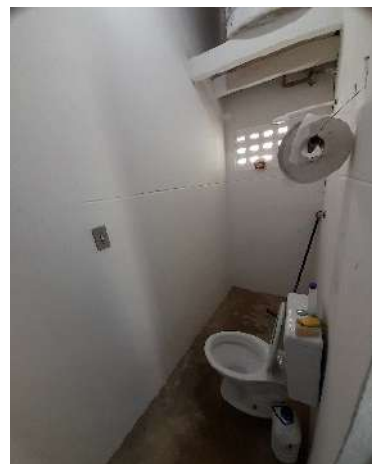
Foto 112 - EEE-SN (Almino Loyola): banheiro inacabado, sem instalações e revestimento laváveis.
