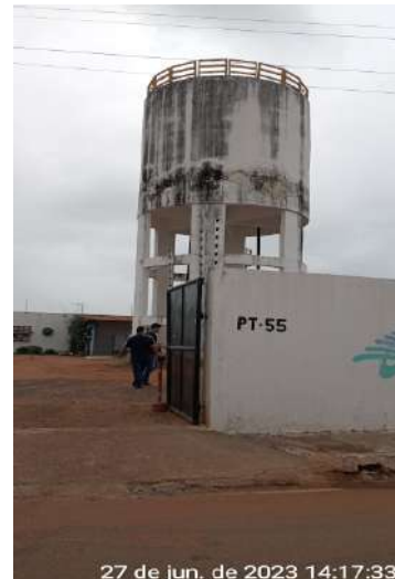
Foto 34 - REL-19: pintura desgastada.
