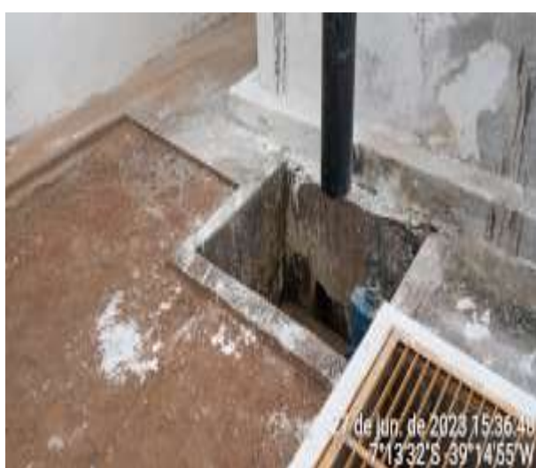
Foto 43 - RAP-42: caixa sem tampa.
