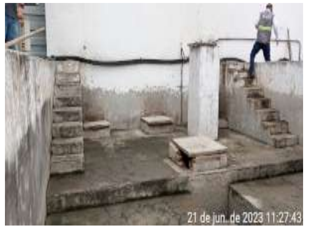
Foto 92 - EEE-SN (Vila de Fátima): escadas sem corrimões.
