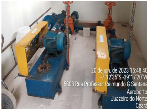
Foto 87 - ETE MCMV: grupo gerador e sopradores parados.
