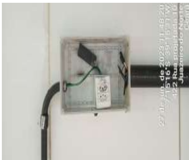
Foto 31 - PT-66 caixa de passagem elétrica sem tampa.
