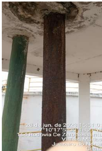
Foto 71 - REL-18: tubulação em processo avançado de corrosão e vazamento na infraestrutura.
