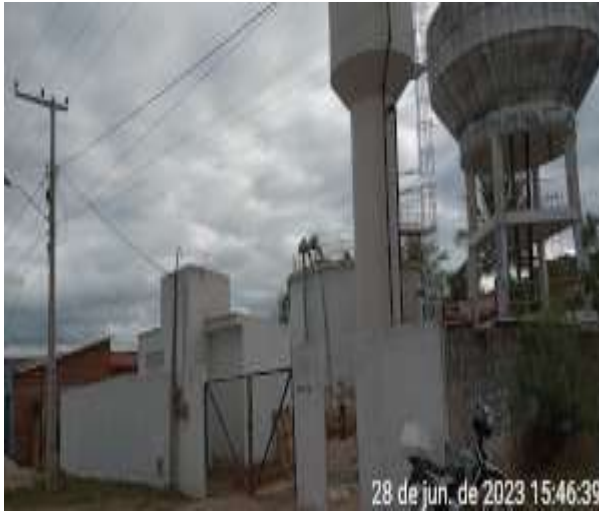
Foto 69 - REL-18: pintura deteriorada.
