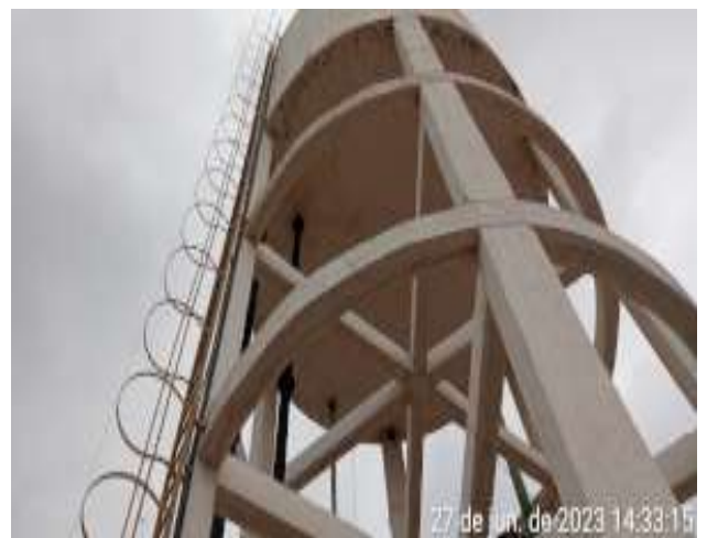
Foto 36 - REL-15: pintura desgastada, fiação inadequada ao redor da estrutura e apresenta vazamento.
