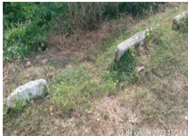
Foto 100 - ETE Malvas: erosão do talude da lagoa facultativa.
