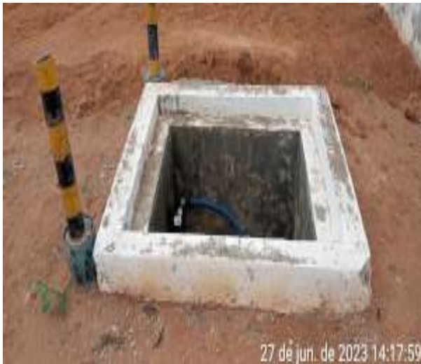
Foto 33 - PT-55: caixa sem tampa.
