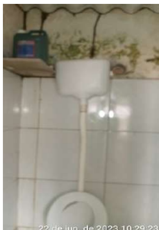
Foto 3 - RAP-05: casa de apoio dos operadores está com banheiro sobre ação de cupim e pintura deteriorada
