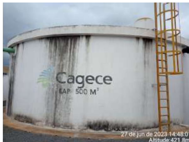
Foto 40 - RAP-39: pintura desgastada.
