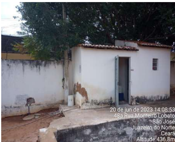
Foto 111 - ETE PROURB: casa do clorador sem identificação.
