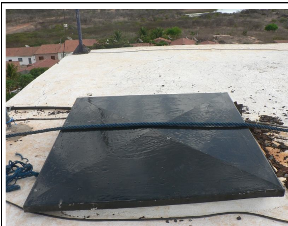
Foto 07 – REL-01: abertura de inspeção com fechamento hermético.
