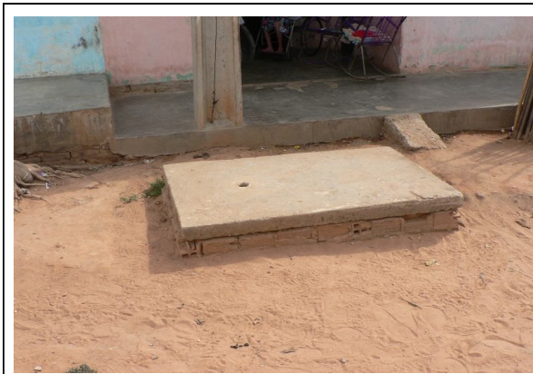
Foto 10 – Registro de descarga localizado na travessa Serafim.
