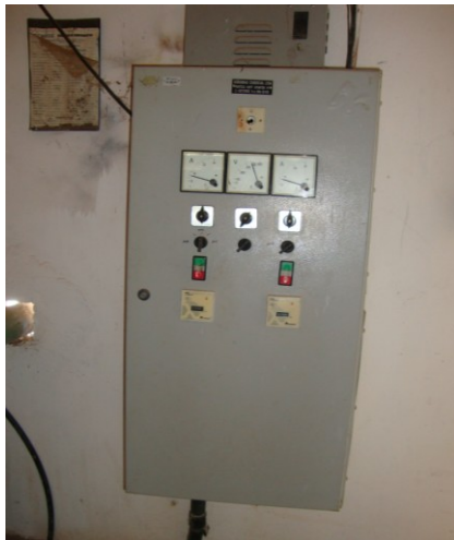
Foto 26 – Quadro de comando da EE-01.
