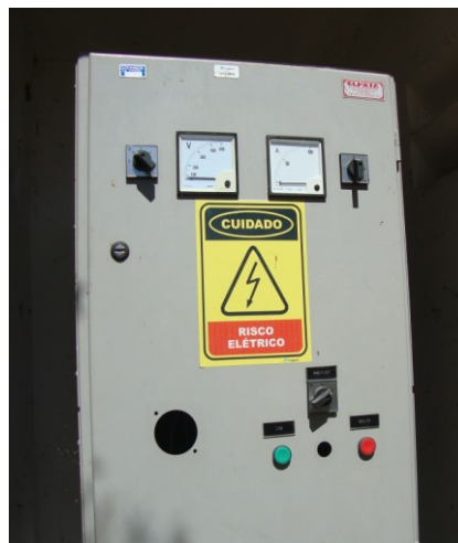
Foto 4 – Quadro de comando do poço PT-01.
