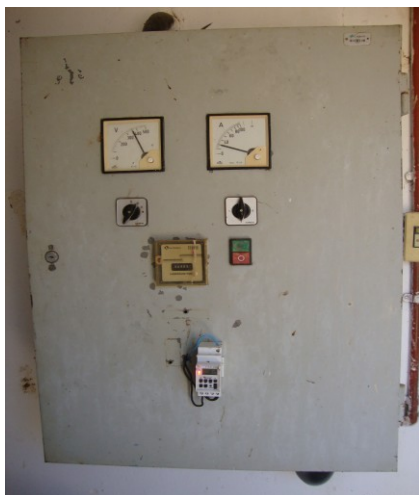
Foto 7 – Quadro de comando do poço PT-02.
