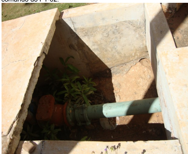
Foto 22 – Caixa de proteção da ventosa na adutora de água tratada no interior da ETA.
