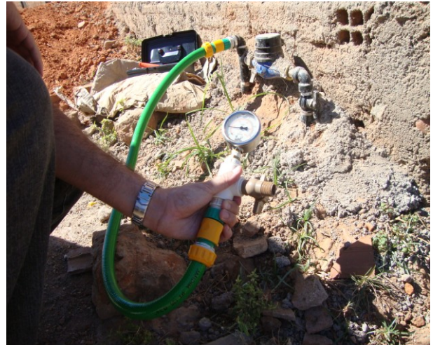
Foto 41 – Medição de pressão instantânea na Rua SDO 01, s/n.
