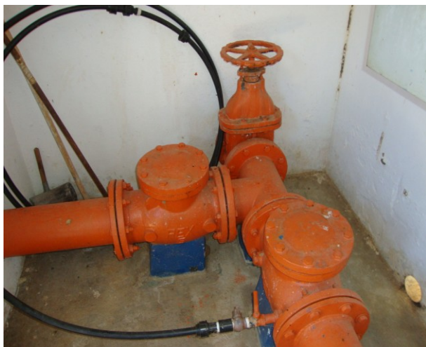
Foto 20 – Ventosas e registro na adutora de água bruta, localizadas no interior da casa de abrigo do quadro de comando do PT-02.
