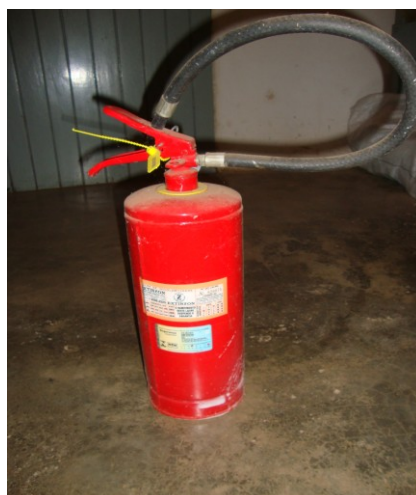
Foto 49 – Extintor de incêndio com prazo de validade até abr/2017.
