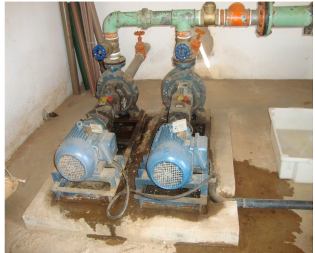
Foto 25– Elevatória EE-01 com 1 conjunto motor- bomba.
