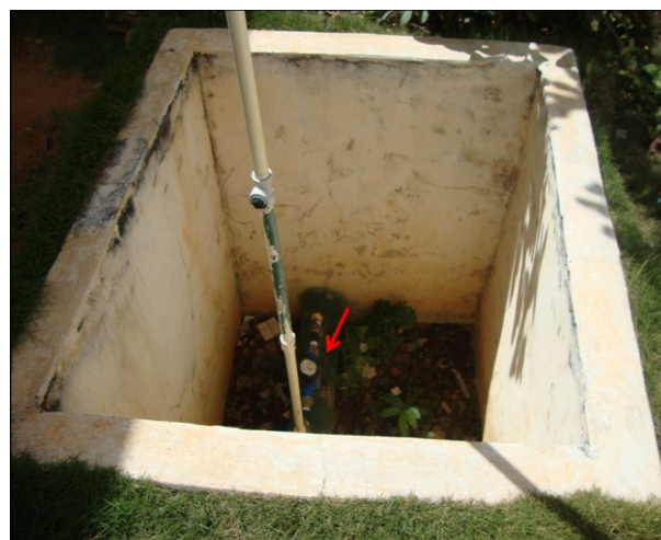
Foto 23 – Macromedidor de água bruta.
