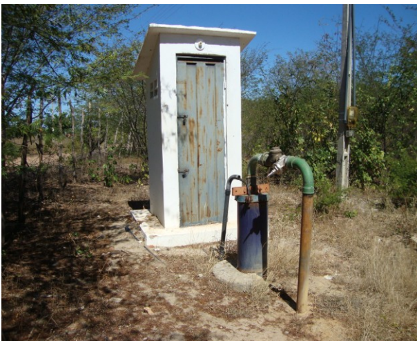
Foto 3 – Vista da casa de abrigo do quadro de comando do PT-01.
