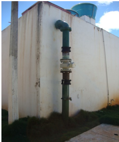
Foto 31 – RAP-01: Tubo extravasor.
