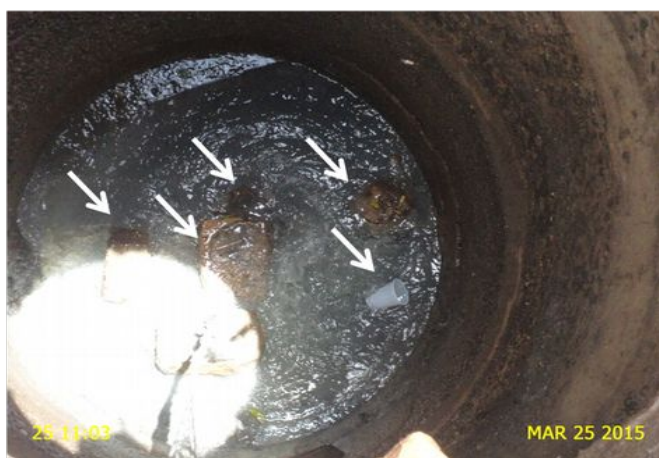
Foto 18 – Rede Coletora de Esgoto: pv localizado entre a Rua Augusto Saraiva Leão e Av. Brasília apresenta inadequada condições de limpeza.
