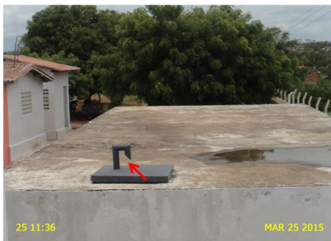
Foto 23 – RAP-01: tubulação de ventilação sem tela de proteção.
