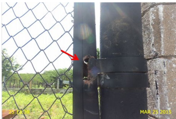
Foto 9 – PT-02: portão de acesso em processo de corrosão.
