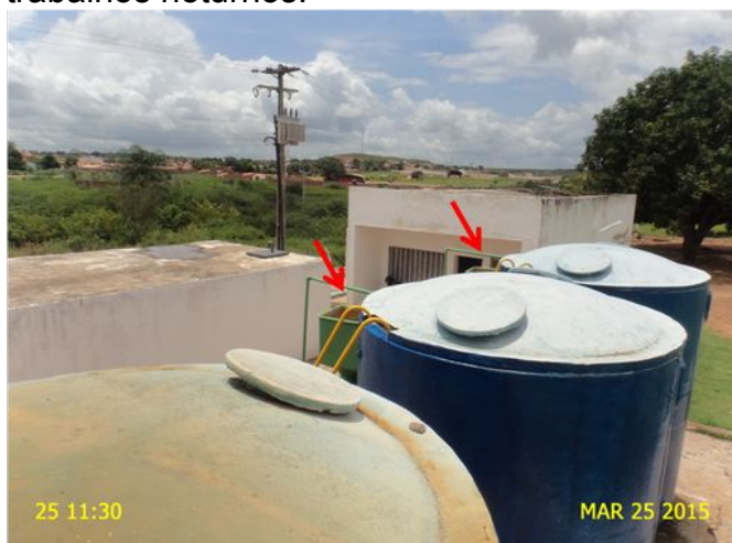
Foto 3 - ETA: nos filtros 01, 02 e 03, verificou-se ausência de tampa de proteção nas caixas de saída da água tratada.
