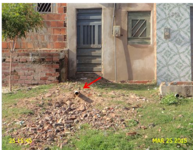
Foto 34 – RAP-03: tubo extravasador.
