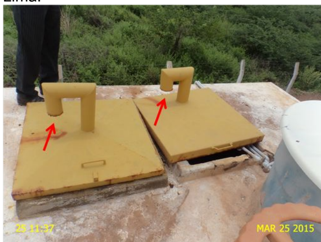
Foto 24 - RAP-01: tubulação de ventilação sem tela de proteção e tampa de inspeção em condições inadequadas de vedação.
