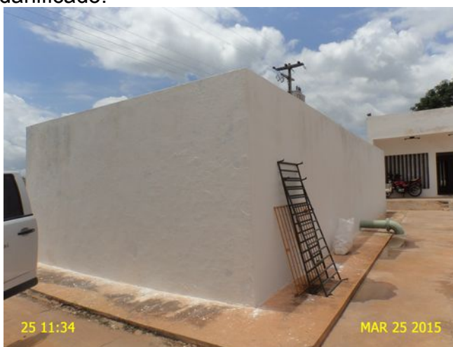
Foto 29 – RAP-02: sem escada de acesso e sem identificação.
