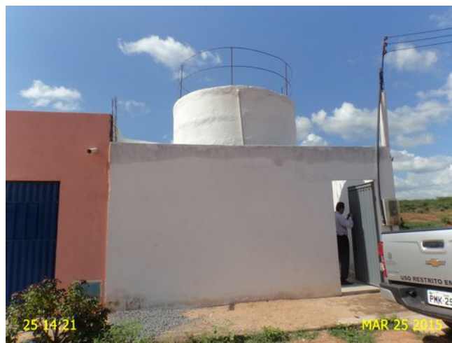
Foto 28 – RAP-04: sem identificação.
