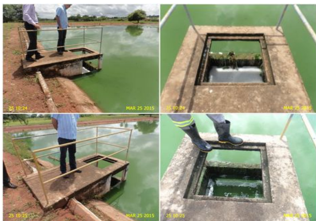
Foto 15 – ETE: saídas do efluente desniveladas.
