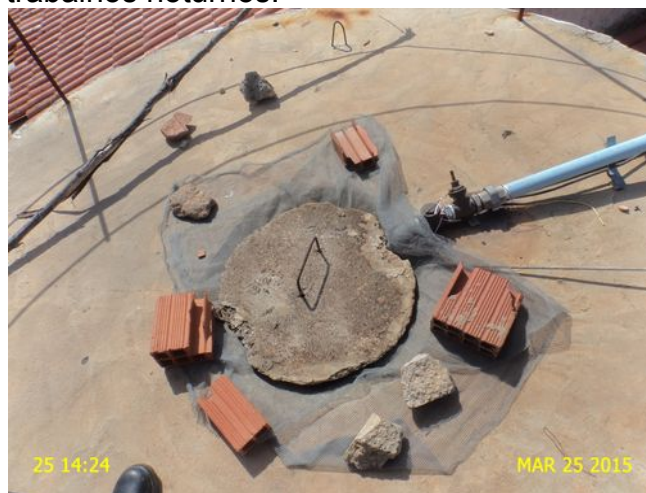
Foto 4 – RAP-04: sem tubulação de ventilação e com tampa de inspeção inadequada.
