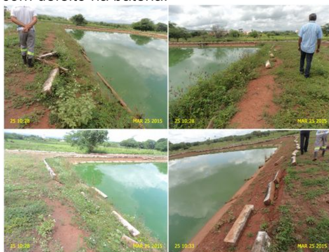
Foto 14 – ETE: Placas de proteção dos taludes danificadas, presença de vegetação na área das LM.
