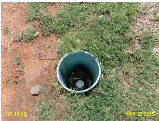
Foto 5 – PT-04: sem caixa de proteção no macromedidor.
