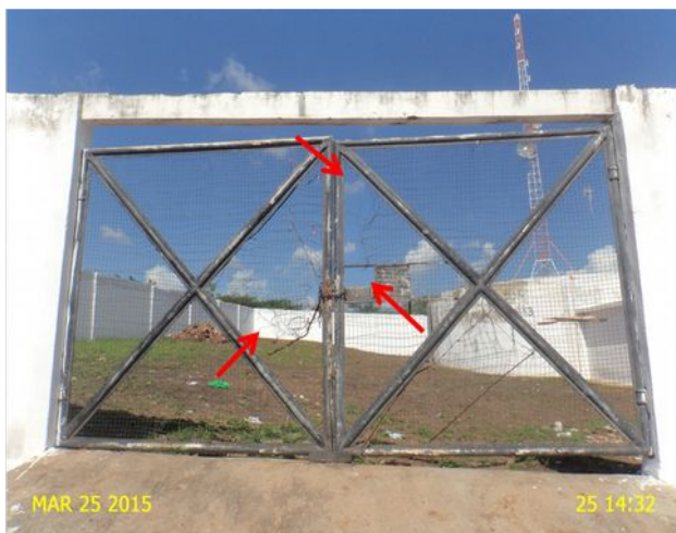
Foto 27 – RAP-03: portão de acesso danificado.
