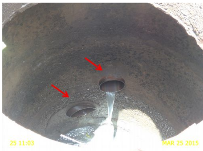
Foto 31 – Tubulação de chegada de efluentes e águas pluviais no Pv localizado entre a Rua Augusto Saraiva Leão e Av. Brasília
