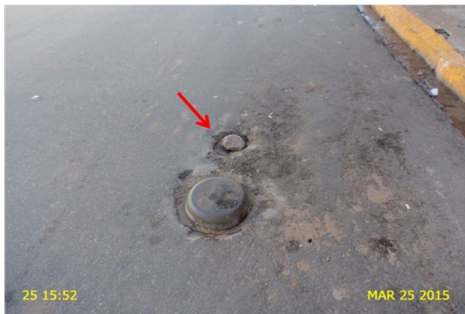
Foto 21 - RDA: registro de descarga sem caixa localizado na Rua Padre Felix.
