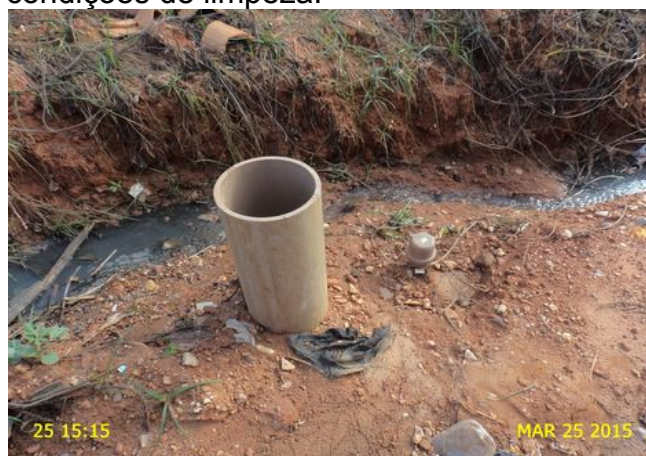
Foto 20 - RDA: registro de descarga sem caixa e próximo a esgoto a céu aberto localizado na Rua São Vicente de Paulo.
