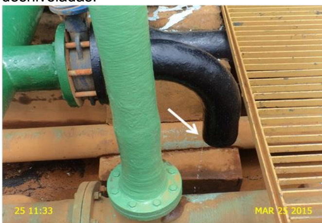
Foto 17 – ETA: filtro F-02 sem vedação adequada.
