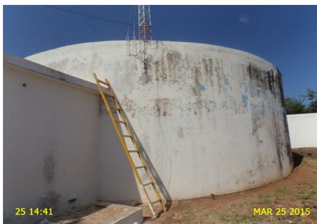
Foto 33 - RAP-03: sem escada fixa.
