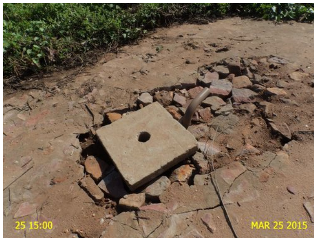
Foto 32 – RDA: registro de descarga com pavimento danificado localizado na Rua José Mariano da Silva.
