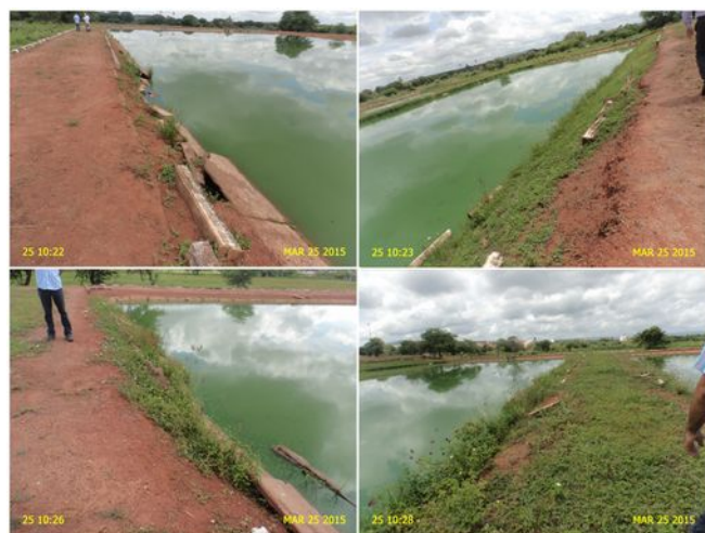
Foto 13 – ETE: Placas de proteção dos taludes danificadas, presença de vegetação na área da LF.
