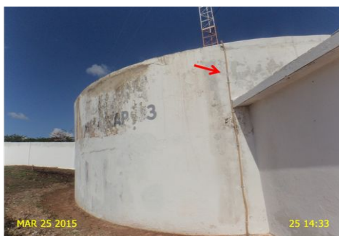
Foto 25 – RAP-03: medidor de nível sem visibilidade e pintura deteriorada.
