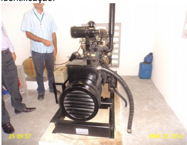
Foto 12 – EEE-01: grupo gerador parado com defeito na bateria.
