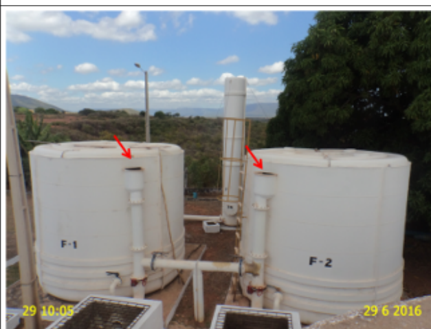
Foto 4 – ETA: calha de saída sem tampa de inspeção nos filtros F-1 e F-2.
