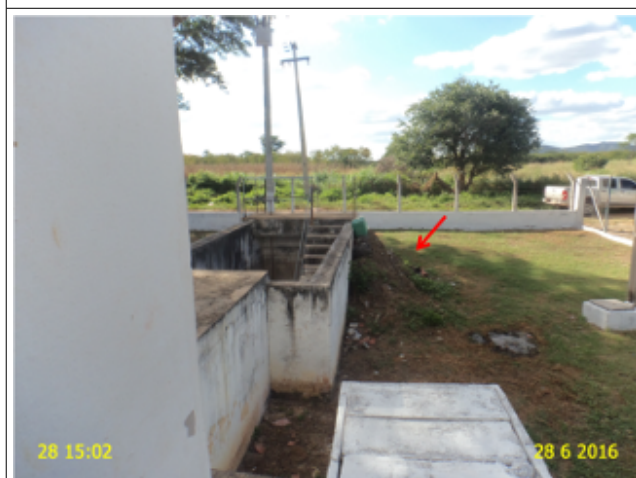
Foto 3 – EEE-01: ausência de leito de secagem.
