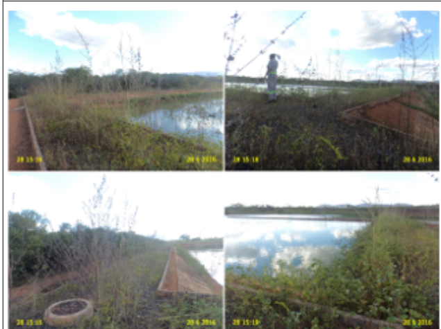
Foto 9 – ETE: excesso de vegetação nos diques da lagoa de maturação LM2.
