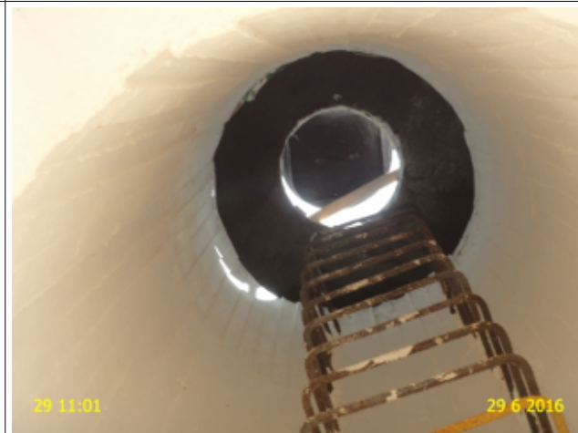
Foto 10 – REL-02: tampa sem fechamento adequado.
