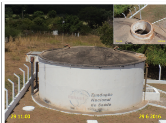
Foto 1 – RAP-02: ausência de tampa de inspeção e sem identificação
