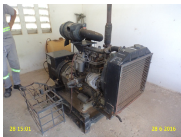
Foto 6 – EEE-01: grupo gerador com defeito.
