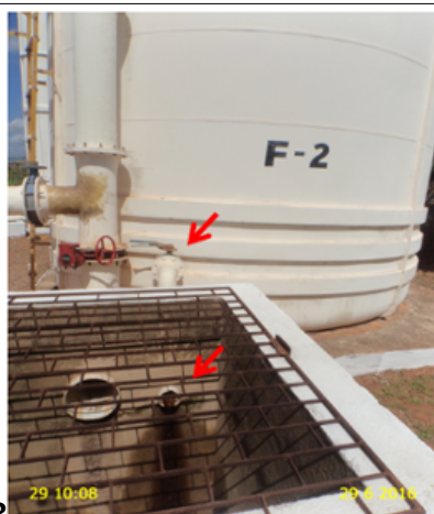
Foto 13 – ETA: vazamento no registro do filtro F-2
