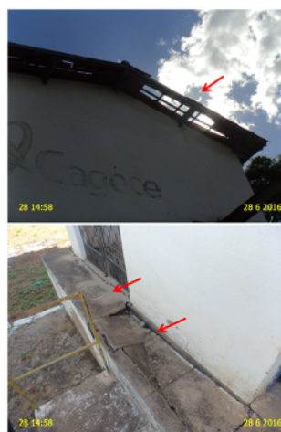
Foto 14 – EEE-01: telhado e calçada danificados.
