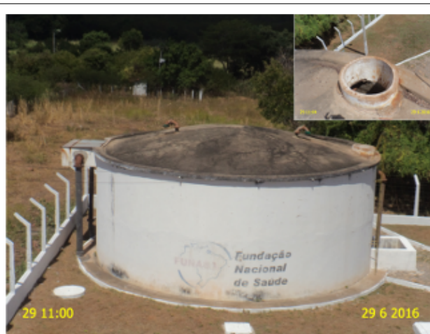
Foto 12 – RAP-02: sem identificação
