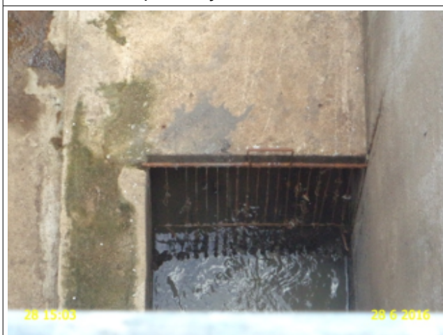
Foto 7 – EEE-01: gradeamento com corrosão.
