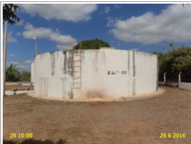
Foto 11 – RAP-01: pintura deteriorada.
