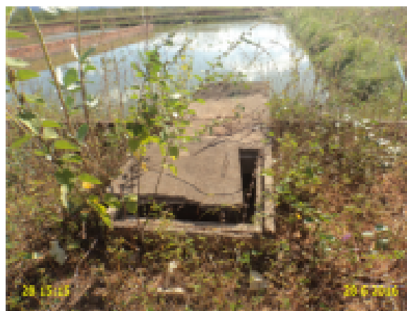
Foto 16 – ETE: poço de inspeção da LM2 esta com tampa danificada.
