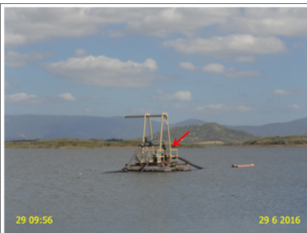
Foto 2 – EECS-01: ausência de bomba reserva.
