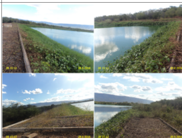
Foto 8 – ETE: excesso de vegetação dentro da lagoa facultativa e nos diques.
