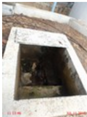
Foto 18 – Filtros: As caixas de passagem dos filtros F-01, F-02 e F-03 não estão dotadas de tampas ou grades de proteção.
