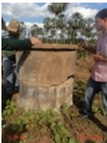
Foto 15 – PT-01: A laje de cobertura do poço PT-01 está danificada.
