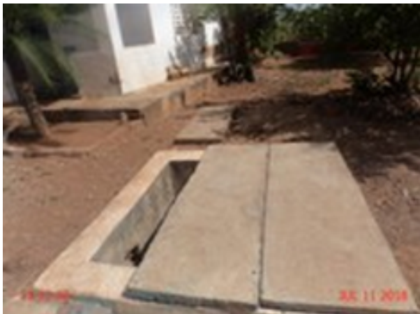
Foto 7 – ETA: A tampa do macromedidor de água bruta está sem tampa ou grade de proteção.
