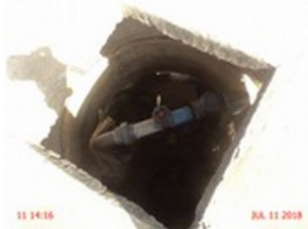
Foto 14 – PT-01: O poço PT-01 está danificada.
