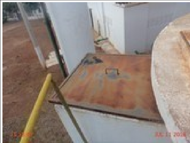
Foto 8 – Filtros: A tampa do filtro F-01 está em processo de corrosão.
