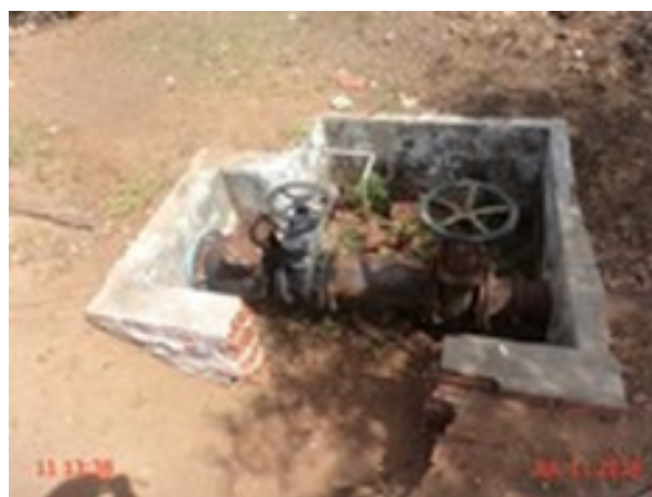
Foto 16 – ETA: A caixa do registro está quebrada e sem tampa ou grade de proteção.
