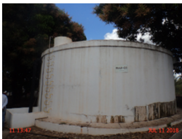
Foto 12 – Reservatórios: O Reservatório RAP-1 está com a pintura deteriorada.
