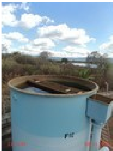
Foto 5 – Filtros: O filtro F-02 não é dotado de tampa.
