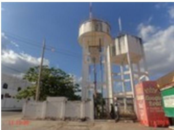
Foto 13 – Reservatórios: Os reservatórios REL -01 e REL-02 estão com a pintura deteriorada.
