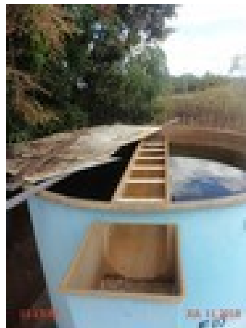
Foto 6 – Filtros: O filtro F-03 não é dotado de tampa.
