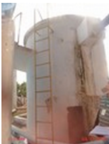
Foto 17- Filtros: O filtro F-01 está com a pintura deteriorada.
