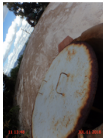
Foto 10 – Reservatório: A tampa de inspeção do RAP-01 não garante vedação e está em processo de corrosão.
