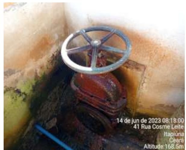
Foto 15 - Filtros F-01 e F-02 (Sede): apresentam vazamentos.
