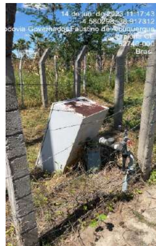
Foto 6 PT-08 (Sede): não possui laje de proteção.
