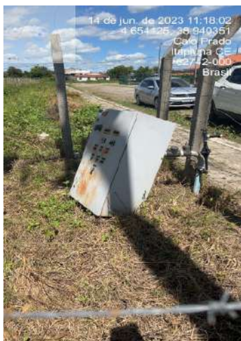
Foto 14- PT-08 (Sede): quadro de comando escorrido no chão.
