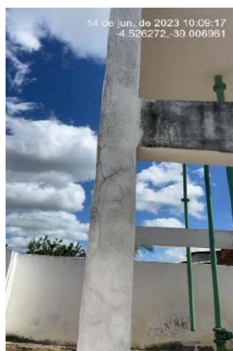
Foto 20 - REL-01 (Palmatória): reservatório vazio e com fissuras na estrutura.
