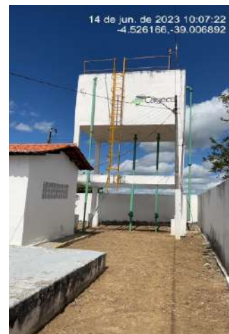
Foto 19 - REL-01 (Palmatória): reservatório vazio e com fissuras na estrutura.
