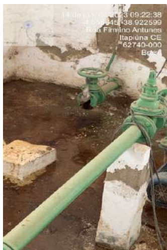
Foto 12- EERD-01 (Sede): instalação inadequada para a bomba reserva.
