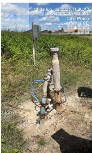
Foto 7 PT-09 (Sede): não possui laje de proteção.
