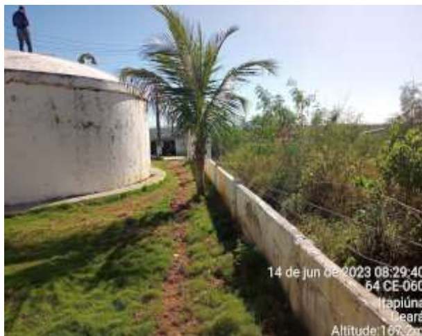
Foto 18 - ETA (Sede): cerca deteriorada.
