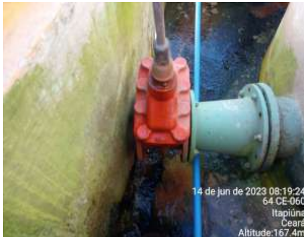
Foto 16 - F-01 e F-02 (Sede): apresentam vazamentos.
