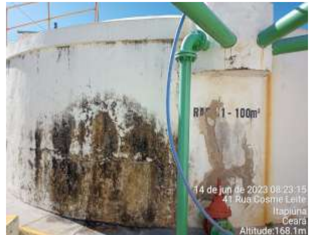
Foto 17 - RAP-01 (Sede): pintura e identificação deteriorada.
