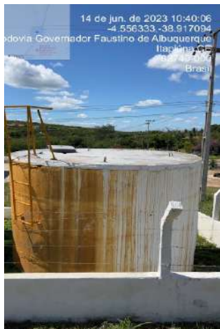
Foto 5 - RAP-09 (Sede): ausência de identificação.
