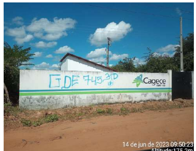
Foto 13 - EEAT-03 (Sede): pintura do muro danificada.
