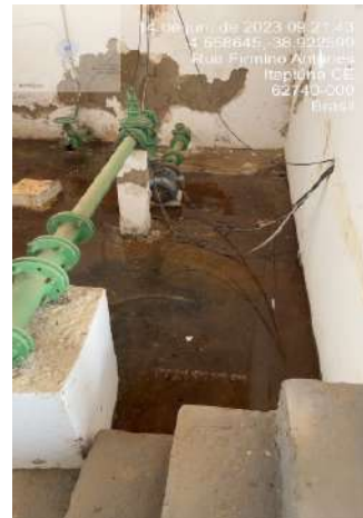
Foto 11- EERD-01 (Sede): vazamento na bomba.
