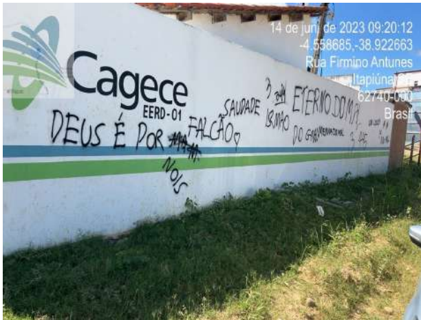
Foto 10- EERD-01 (Sede): pintura do muro danificada.
